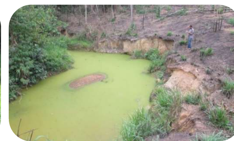
Travessia de drenagem com processos erosivos e evidência de lançamento de efluentes (km 351,9) em Ji-Paraná/RO
