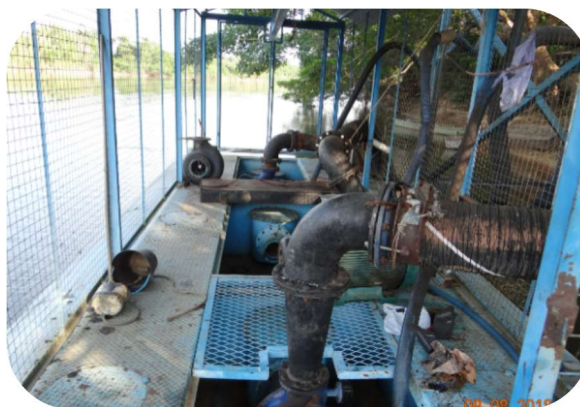
Captação de águas no rio Machado para abastecimento de Cacoal
