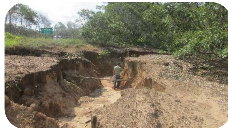
Processos erosivos lineares do tipo voçoroca, adjacentes BR-364 em área de ocorrências dos arenitos. Acima km 1313, em Comodoro/MT
