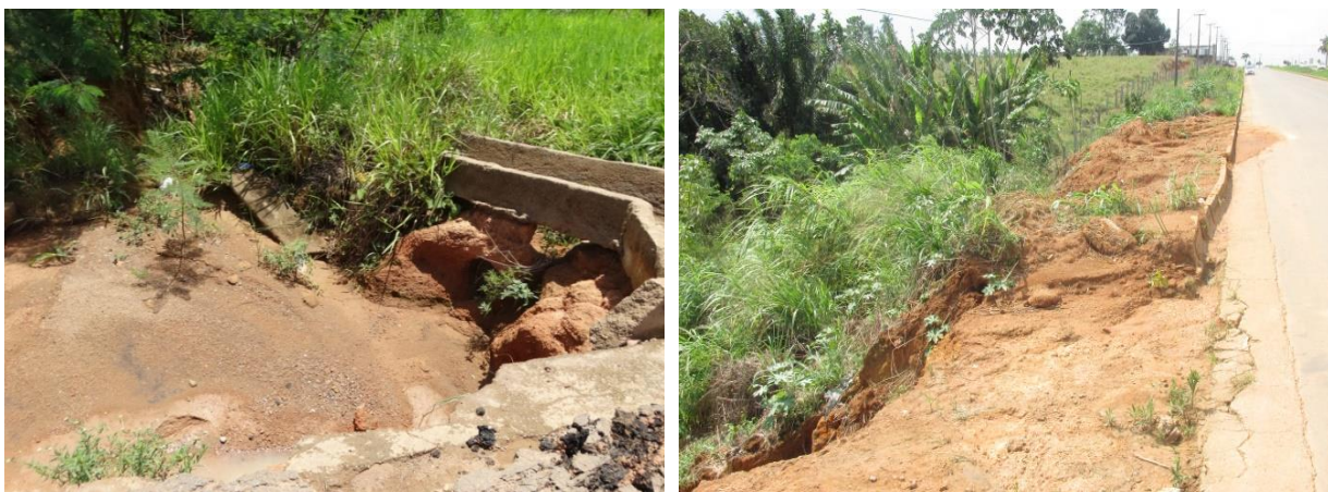
Figura 4: Processos erosivos em talude de travessia de drenagem em áreas urbanas de Ariquemes resultando em destruição de canaletas e meio fio, ao longo da rodovia BR-364 MT/RO.
