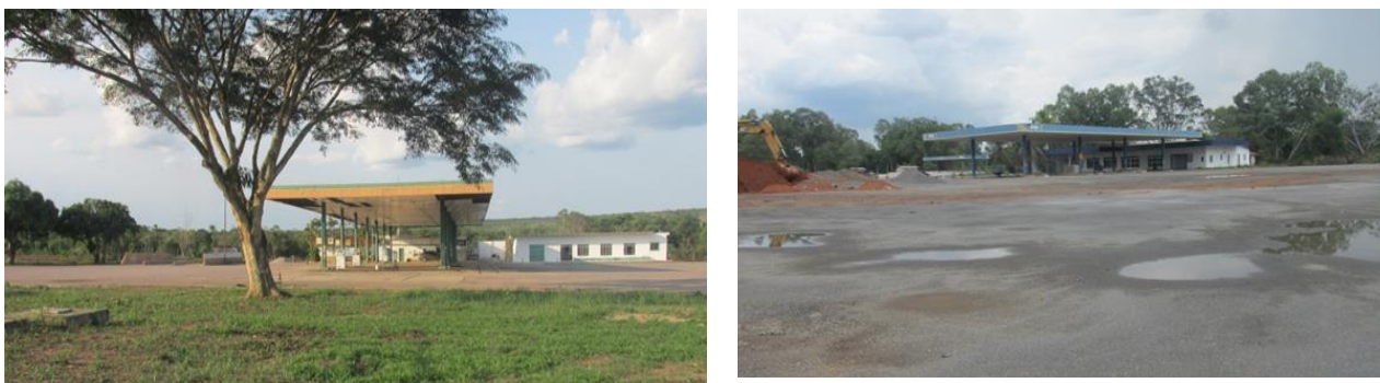
Figura 16: Postos de combustíveis desativados e/ou em obras e com presença de tanques sobre o solo em área descoberta, além de outras estruturas abandonadas, constituindo áreas com potencial de contaminação, em Comodoro (foto à esquerda) e Vilhena (foto à direita), localizados ao longo da BR364 MT/RO.
