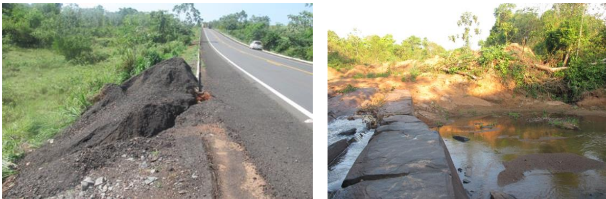
Figura 17: À esquerda, local de implantação de escada hidráulica inacabada com materiais de obra e meio fio erodidos, em Pimenta Bueno. À direita, área lateral a corpo d'água utilizado como canteiro de obras não recuperado onde observam-se pilhas de materiais excedentes, restos de asfalto e brita, além restos vegetais, em Cacoal.
