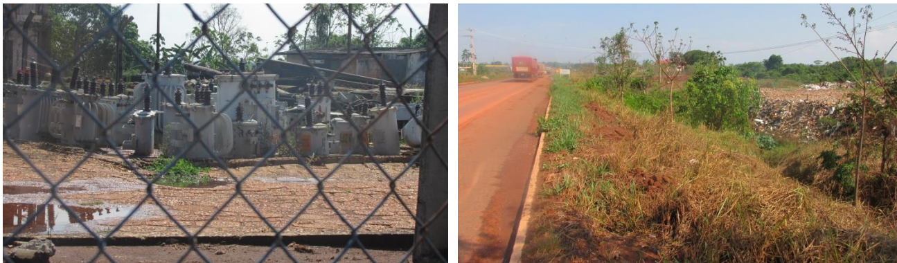
Figura 15: Em Pimenta Bueno, áreas com materiais dispostos de forma inadequada constituindo passivo de áreas com potencial de contaminação. À esquerda transformadores com sinais de oxidação, dispostos a céu aberto e sem bacia de contenção; e, à direita, área de disposição irregular de resíduos sólidos em parte da faixa de domínio.
