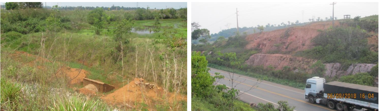
Figura 8: Área alagada a montante com assoreamento e talude com processos erosivos em travessia de afluente do Igarapé São Marcos (foto à esquerda) e processos erosivos em corte, ambos ao longo da rodovia 363-MT/RO em Candeias do Jamari.
