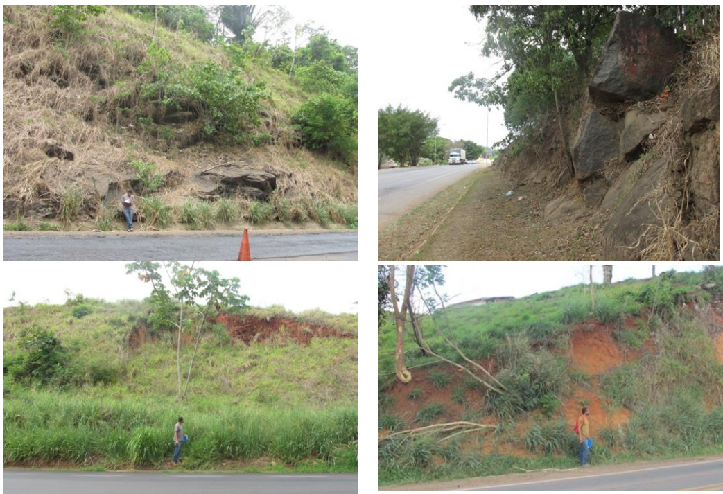
Figura 48: Movimentos de Massas em taludes de corte ao longo da rodovia BR-364 MT/RO, com blocos rolados nos trechos de Jarú/Theobroma (foto acima e à esquerda) e Ouro Preto d'Oeste (acima à direita) e escorregamentos rotacionais em trechos de Cacaupônia/Ariquemes (foto abaixo e à esquerda) e Ariquemes (foto abaixo e à direita)
