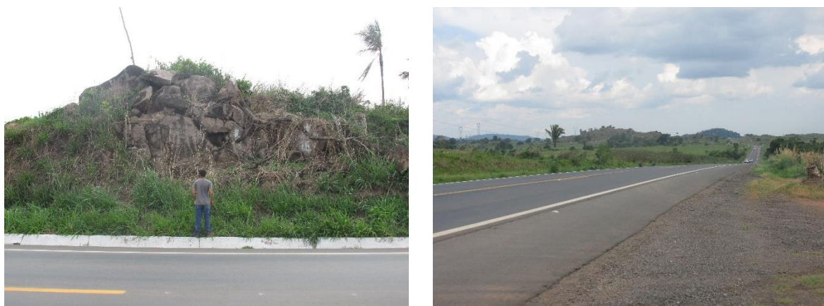
Figura 47: À esquerda, notam-se blocos instáveis em corte (km 402) e à direita vista da travessia da BR-364 em relevo de Colinas dissecadas e morros baixos (km 399), ambos em município de Ouro Preto do Oeste
