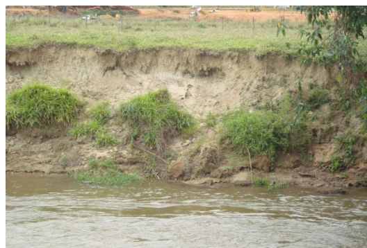
Foto 59. Margem desabada do Rio Novo
