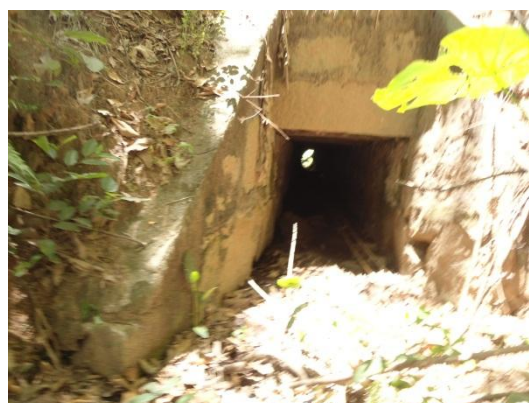
Foto 53. Drenagem seca - Jusante
