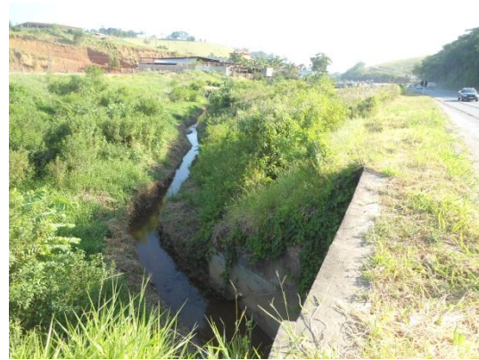
Foto 43. Vista do córrego a jusante da rodovia, demonstrando o leito do rio mais "encaixado".
