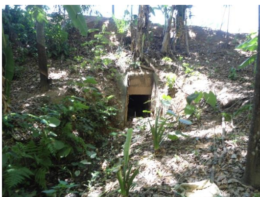
Foto 52. Drenagem seca - Montante
