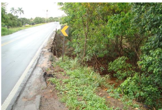
Foto 23. Ponte com barreira de proteção danificada
