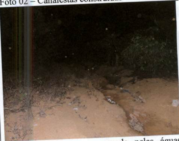
Foto 04 – Voçoroca causada pelas águas oriundas da caixa de drenagem
