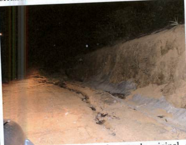
Foto 06 – Destruição da estrada vicinal e canaleta de drenagem, por mim construída.
