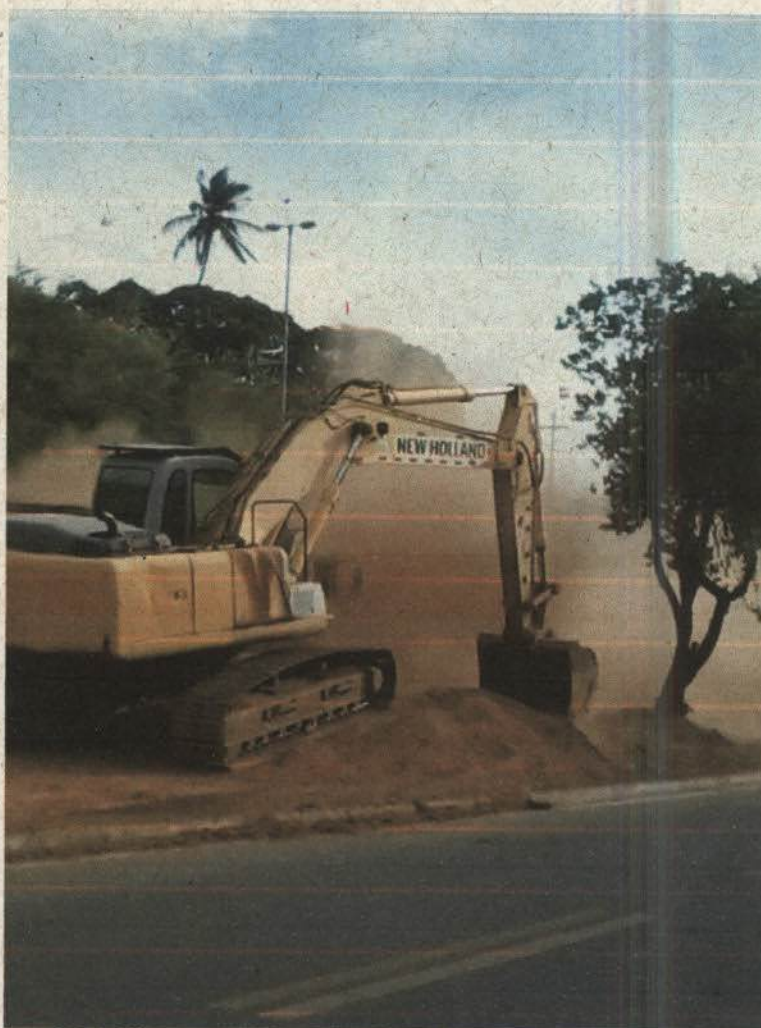
Foto 06: Início das obras sem auxílio do carro-pipa para umectação das vias e minimização da emissão de particulados.
