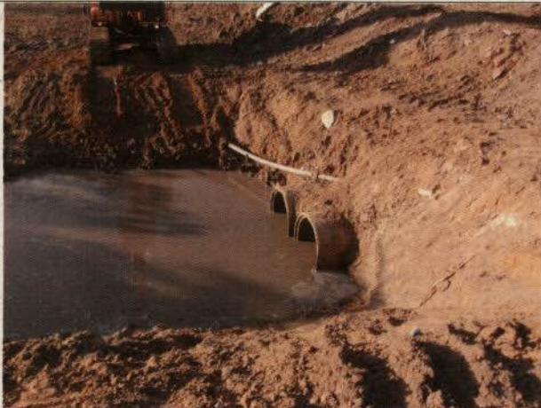
Foto n°01 – Vista da área onde colocação 04 manilhas, com o intuito de construir a estrada as margens da BR 101.
