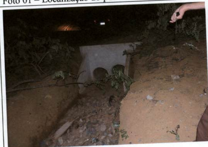
Foto 03 – Caixa de Drenagem
