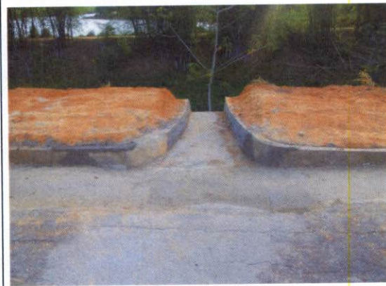
Foto 10: Vista do sistema de drenagem instalado no Km 035+940.
