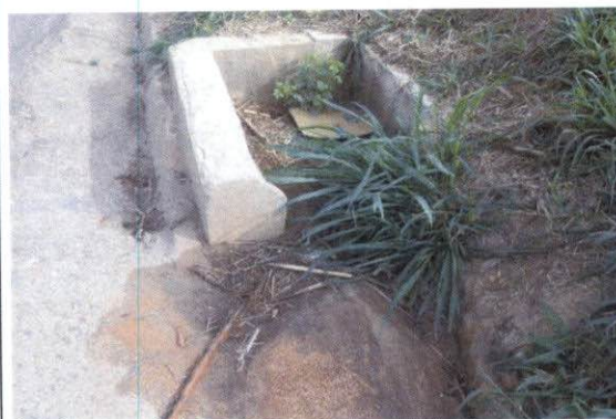
Foto 11: Sistema de drenagem obstruído no Km 040+600.
