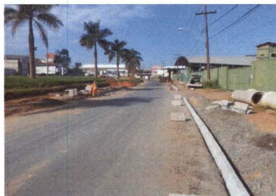
Foto 05: Implantação das via marginal pista Norte no Km 297+700 no município de Viana.
