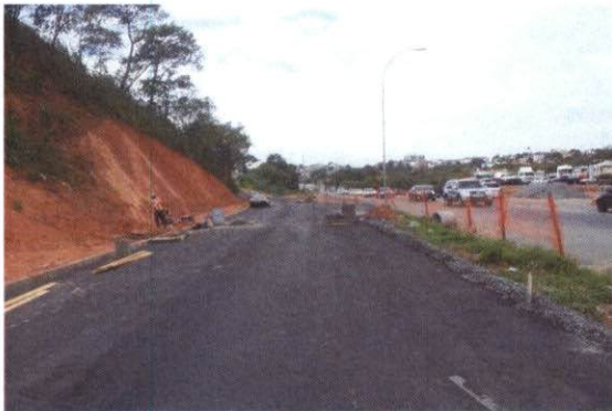
Foto 01: Visão das obras de implantação da marginal pista Norte no município de Serra - Km 255+300.
