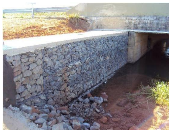
Figura 5.420- Passagem de fauna tipo galeria instalada na rodovia SP-300/BR. Foto: http://www.viarondon.com.br
