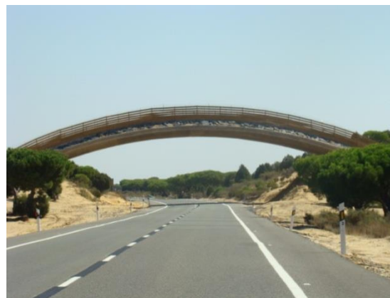
Figura 5.428- Ecoduto instalado na rodovia A-494/Espanha. Foto: Flávia Peter.
