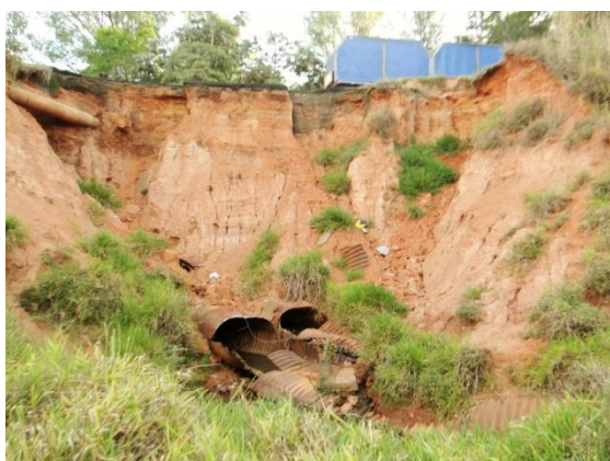
Figura 5.248 - Córrego sem nome, no ponto interceptado pela rodovia, onde se vê a erosão do talude.
