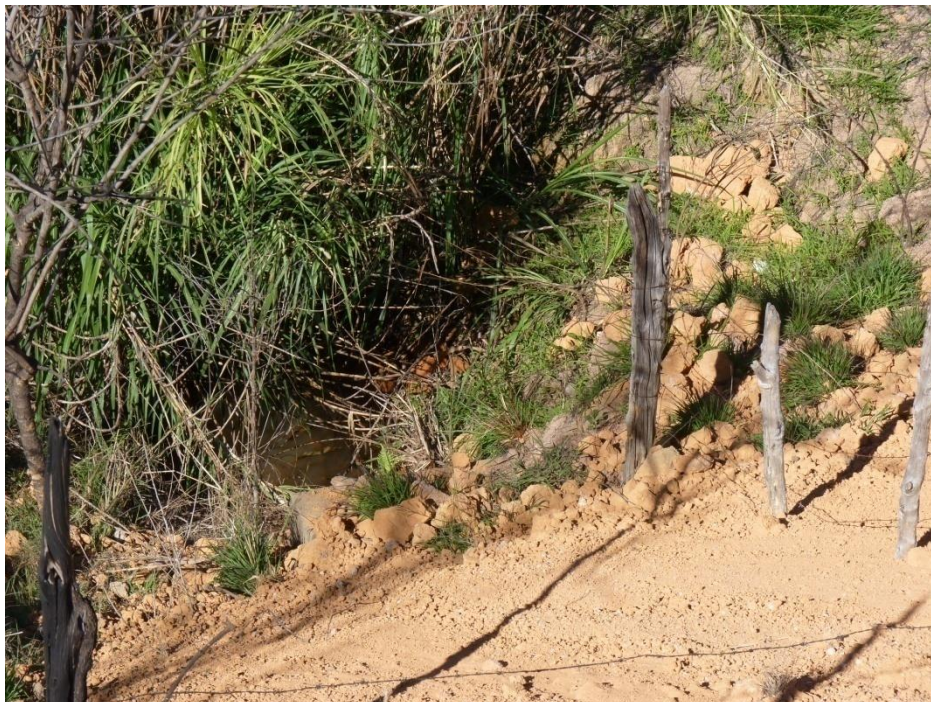
Figura 5.217 - Pequeno corpo d'água interceptado pela BR-262, já assoreado pela erosão do talude da rodovia.
