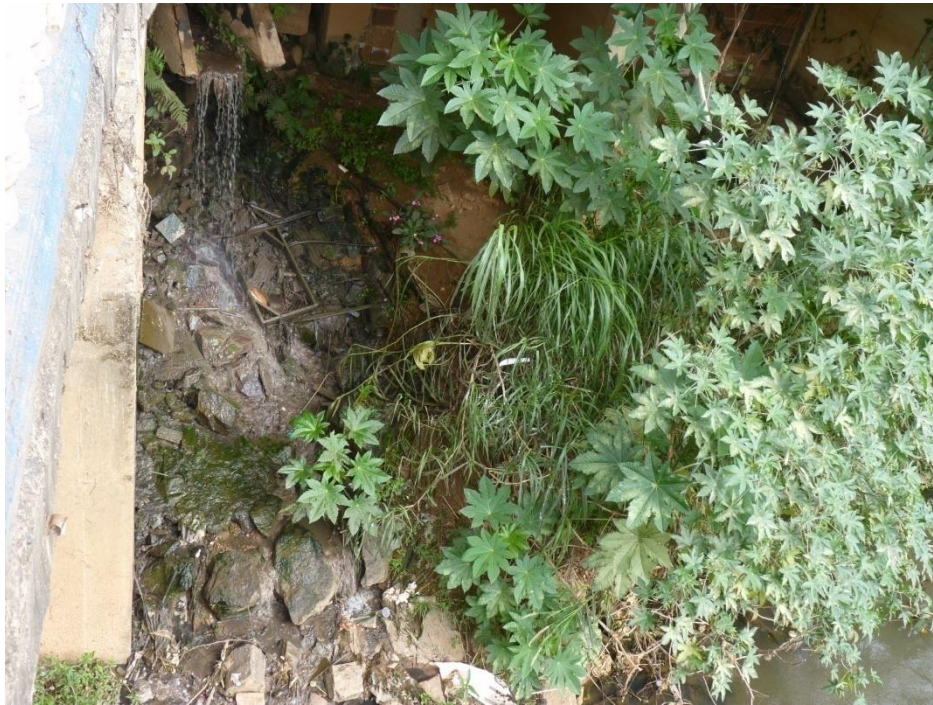
Figura 5.214 - Despejo de esgoto no rio Manhuaçu.
