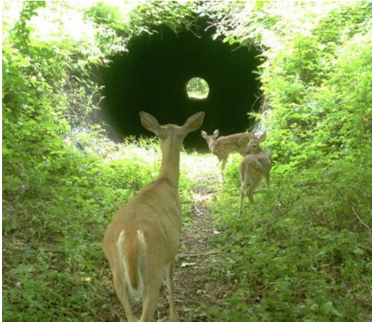
Figura 5.421- Passagem de fauna “inferior” instalada na rodovia I-80/New Jersey/EUA. Foto: http://philly.com
