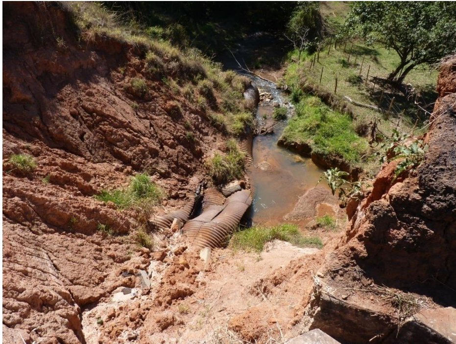
Figura 5.216 - Pequeno corpo d'água interceptado pela BR-262, assoreado pela erosão do talude da rodovia.
