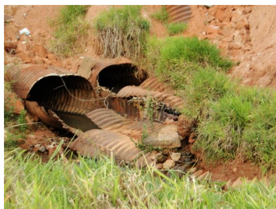
Figura 5.249 - Tubulação deteriorada na saída do bueiro, bloqueando parcialmente o fluxo de água do córrego
