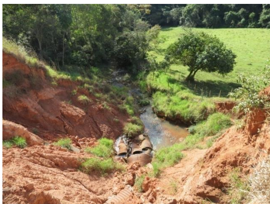
Figura 5.246 - Córrego sem nome, no ponto interceptado pela rodovia, onde se vê a erosão do talude.
