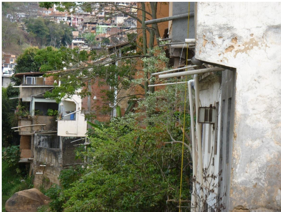
Figura 5.215 - Detalhe dos canos das residências voltados para despejo do esgoto diretamente no rio Manhuaçu.
