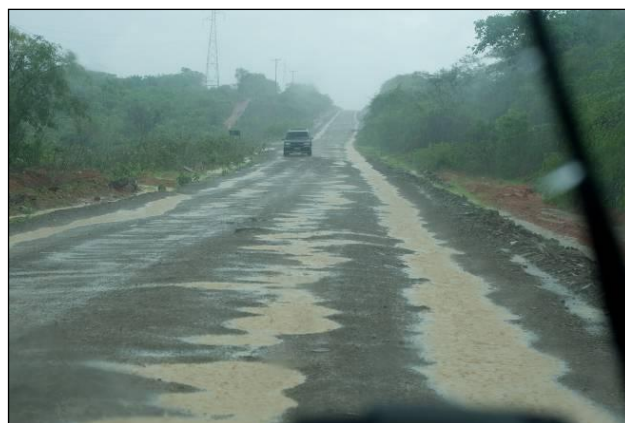
Figura 5.13: Trecho da BR-135 em dia de chuva.
