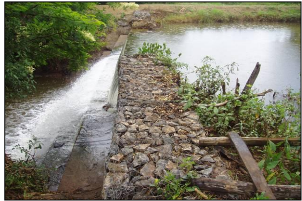
Figura 5.91: Barramento a jusante do trecho da BR-135 com captação de água para uso agrícola.
