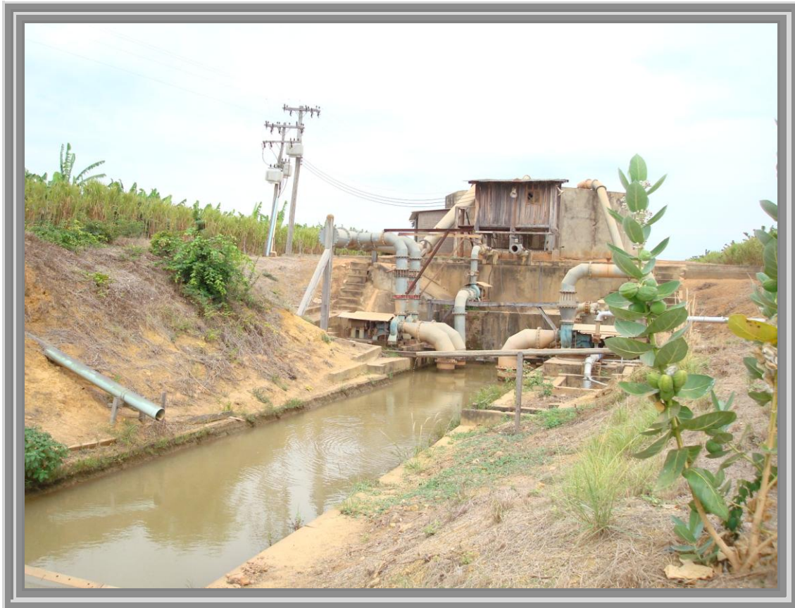
Itacarambi. Fazenda ICIL, canal e bomba de irrigação, junto da plantação de banana. Água bombeada diretamente do rio São Francisco.
