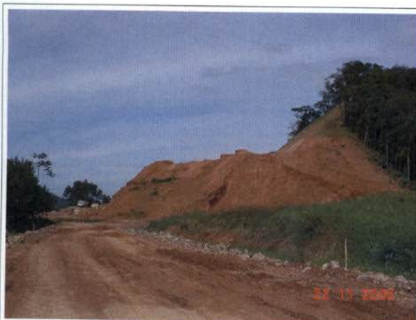
Figura 8.15 - Ilustração - Talude recebendo a proteção vegetal antes de terminar os trabalhos construtivos
