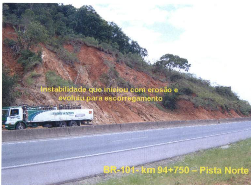
Figura 5.37 - Exemplo de um talude de corte com altura superior a 8m, que sofreu erosão e evoluiu para um escorregamento.
