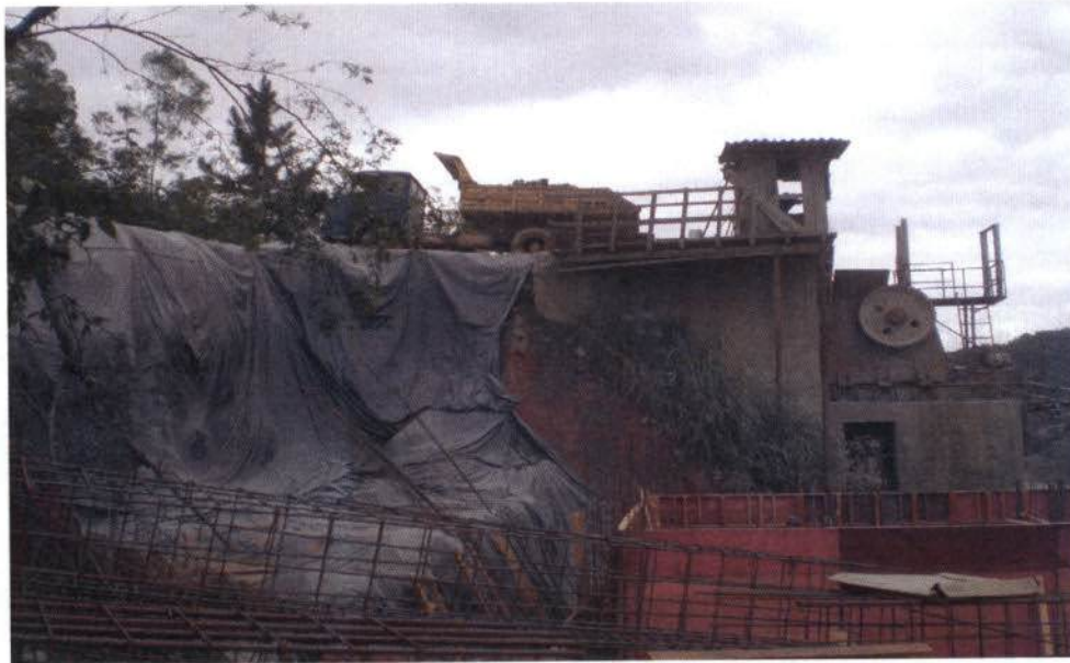
Figura 5.44 - Instalações da Britagem Gaspar: britador utilizado pela pedreira para a realização do processo de britagem.
