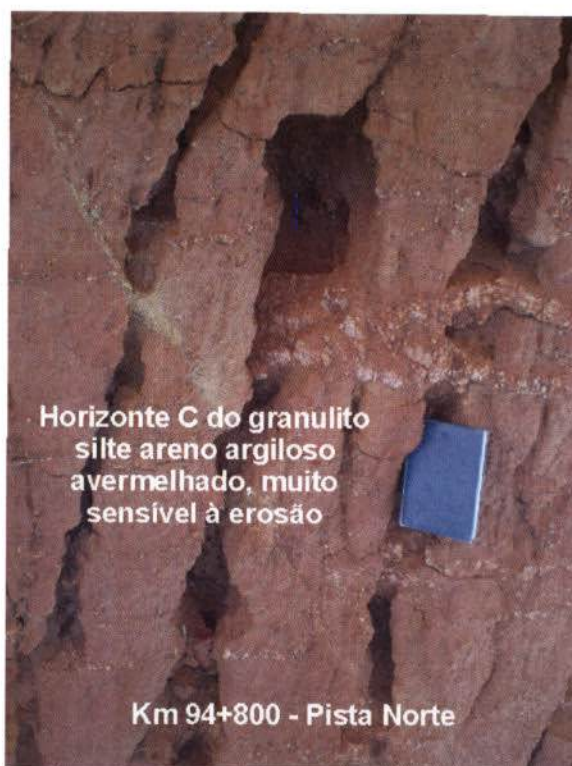
Figura 5.36 - Sulcos provocados pela erosão em um talude de corte, no horizonte C do granulito, evidenciando sua sensibilidade à erosão
