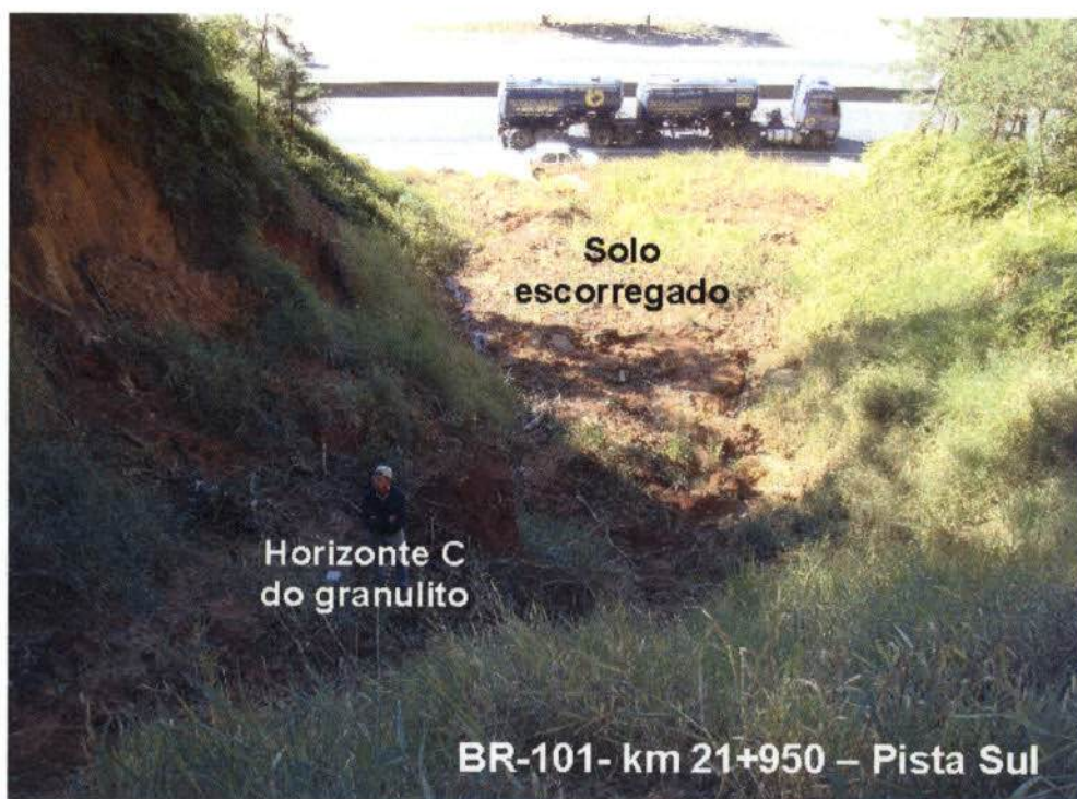
Figura 5.38 - Significativa erosão no talude do corte, em horizonte C do granulito.
