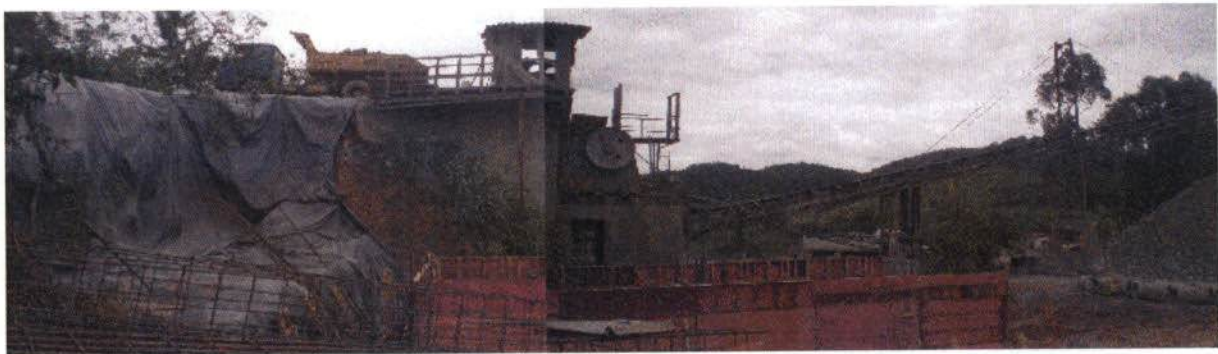
Figura 5.45 - Vista geral do britador.
