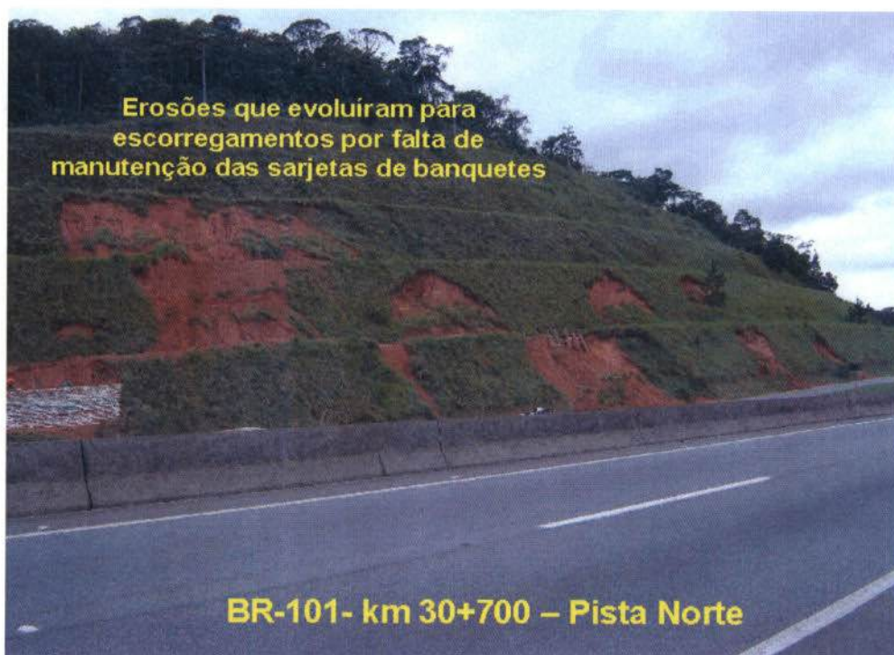
Figura 5.39 - A falta de manutenção das sarjetas das banquetas, provocou a descida da água pelo talude do corte em horizonte C do granulito, ocasionando sua erosão.
