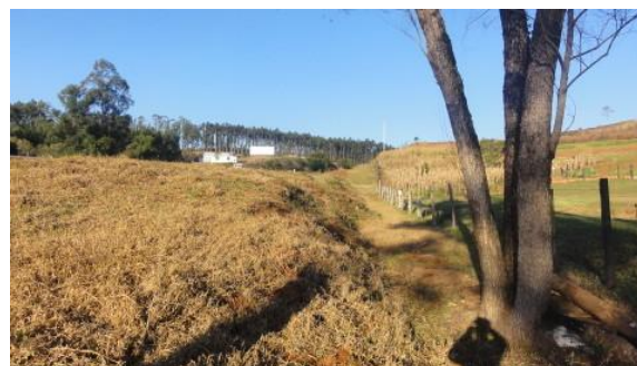
Talude do bota fora (desnível) próximo a cerca da propriedade lindeira. 21/06/12.
