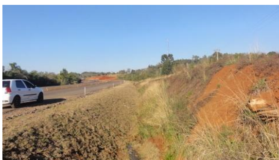
Pista em construção, talude de aterro, vala de drenagem e bota fora. 28/06/12.
