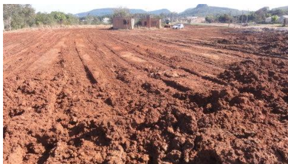
Vista do canteiro central, sendo utilizado como aterro, observando-se na direita pista da BR-386/RS. 21/06/12.
