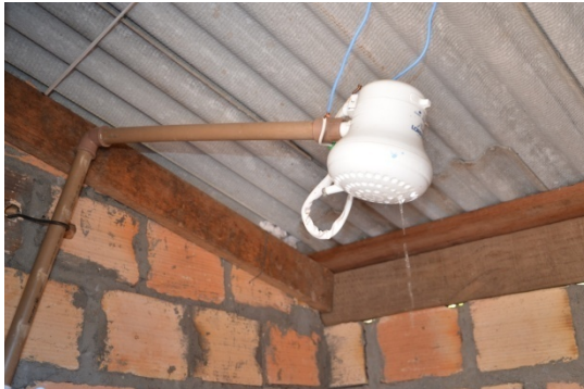
Detalhe - chuveiro elétrico
