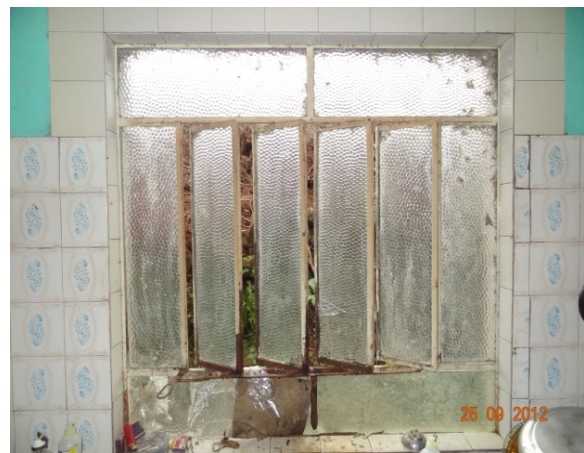
Detalhe – Janela cozinha (25/09/2012, 09:54h)
