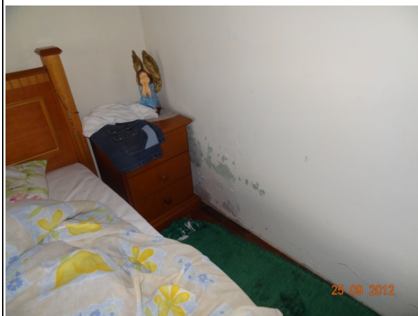
Patologia – parede quarto (25/09/2012, 09:37h)
