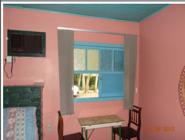
Detalhe – Janela Quarto (25/09/2012, 09:59h)
