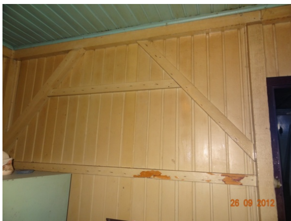
Patologias – parede cozinha (26/09/2012, 11:31h)
