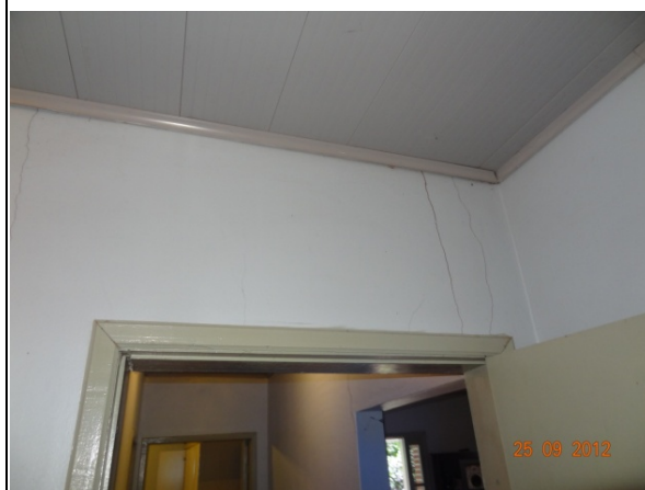
Fissura – Porta Quarto (25/09/2012, 10:38h)
