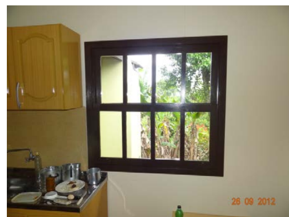
Detalhe – Janela cozinha (26/09/2012, 11:23h)
