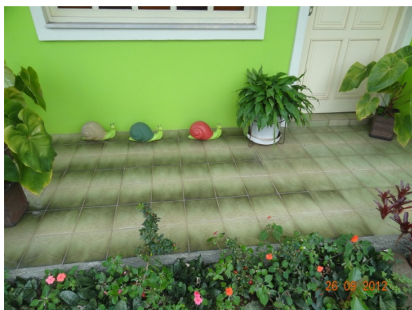
Detalhe – Piso Varanda (26/09/2012, 10:51h)
