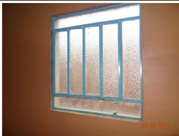
Detalhe – Janela Quarto (25/09/2012, 10:03h)
