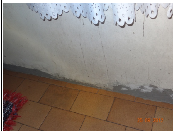
Patologia – parede cozinha (25/09/2012, 14:35h)
