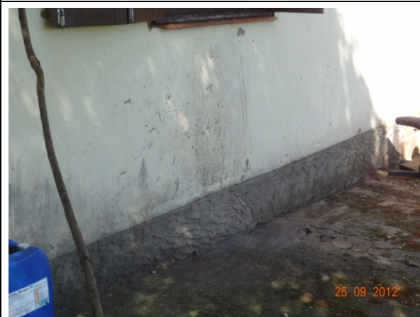
Detalhe – parede fundos (25/09/2012, 14:29h)
