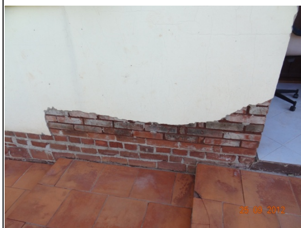
Patologia - parede fachada (25/09/2012, 14:26h)
