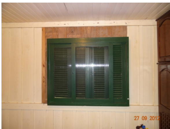
Detalhe – Janela Quarto (27/09/2012, 14:42h)
