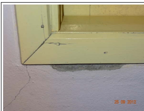
Detalhe – Patologia janela (25/09/2012, 09:38h)
