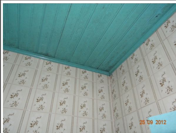
Forro - Banheiro (25/09/2012, 09:59h)
