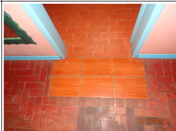
Detalhe – Piso Varanda (25/09/2012, 09:58h)
