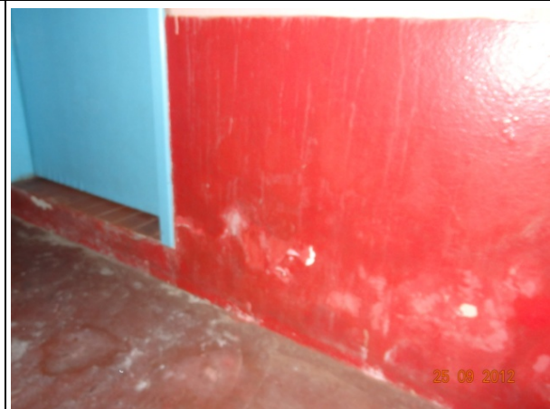
Patologia– Paredes Garagem (25/09/2012, 09:58h)
