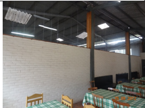
Parede refeitório (25/09/2012, 11:38h)
