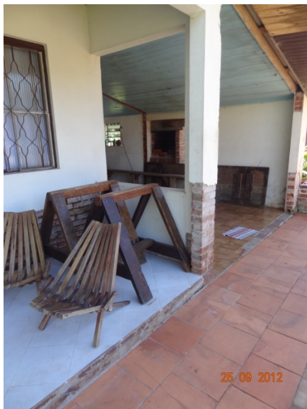
Detalhe – patologia varanda (25/09/2012, 14:27h)
