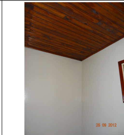
Forro Quarto (25/09/2012, 09:38h)
