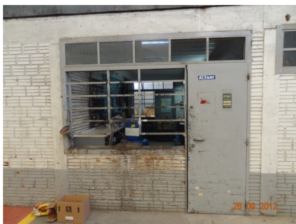
Detalhe – patologia – vidros e pintura (26/09/2012, 16:15h)
