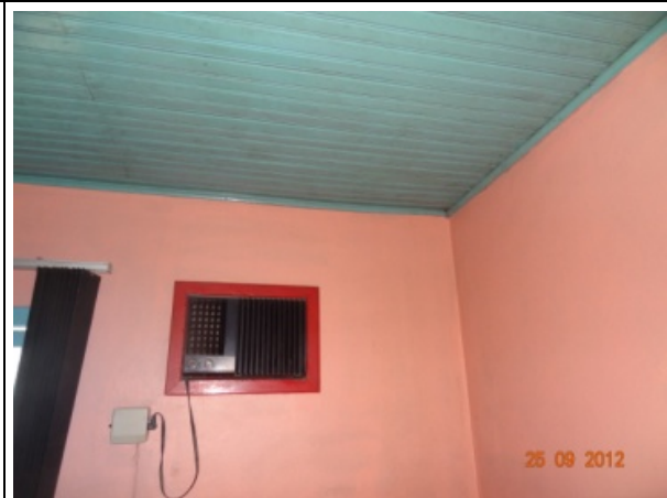
Forro Quarto (25/09/2012, 10:03h)
