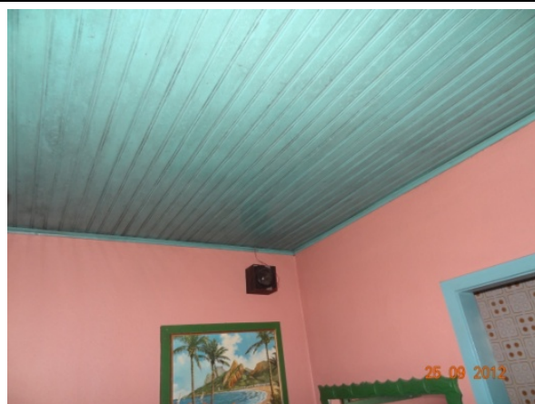
Forro – Quarto (25/09/2012, 10:04h)
