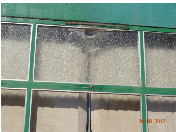
Patologia Janela Fachada (26/09/2012, 15:34h)
