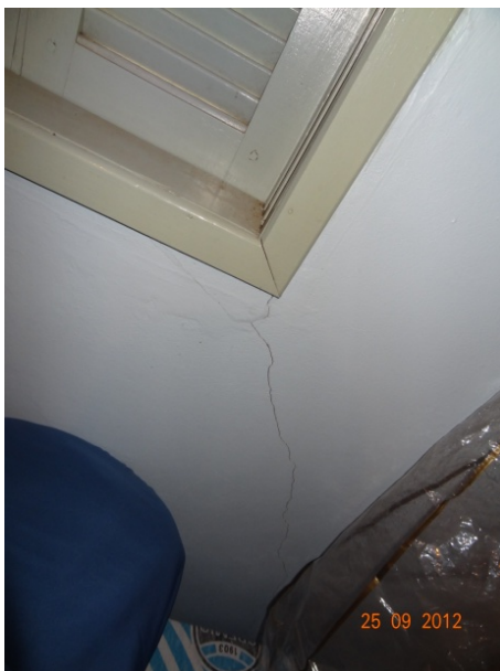
Fissura Janela – Quarto (25/09/2012, 10:37h)
