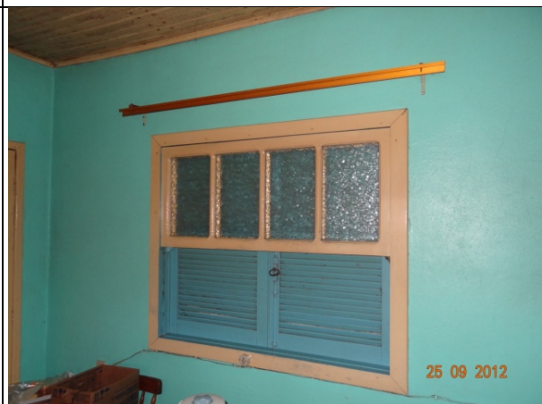
Detalhe – Janela Quarto (25/09/2012, 09:56h)
