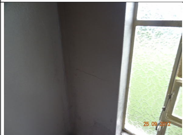
Patologia– Paredes Interna (25/09/2012, 09:28h)
