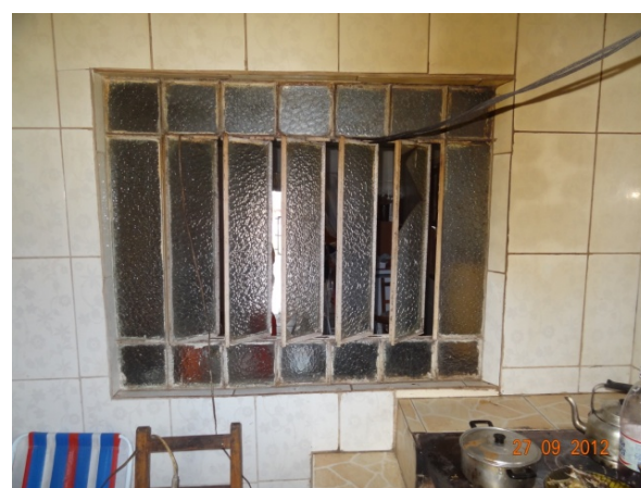
Detalhe – Janela cozinha (27/09/2012, 14:35h)
