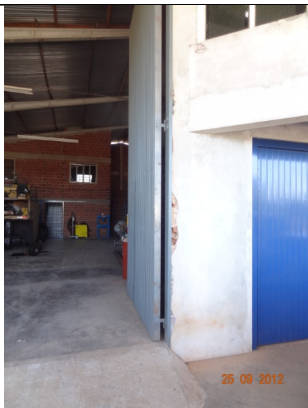
Patologia – portão (25/09/2012, 14:52h)
