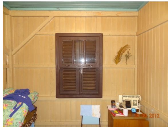
Detalhe – janela quarto (26/09/2012, 11:32h)
