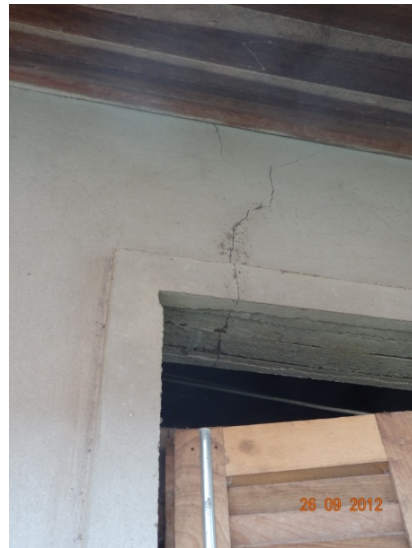
Fissura – Janela Construção (26/09/2012, 10:37h)
