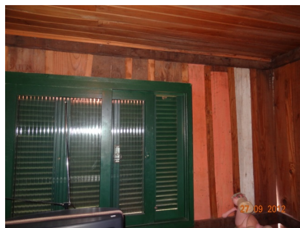
Detalhe – Janela quarto (27/09/2012, 14:42h)
