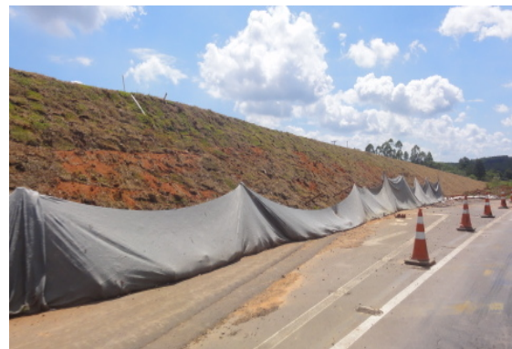
Contenção de material com barreira de manta geotêxtil. E:16+380 em 20/11/12 -29,5903264S - 51,8271797W
