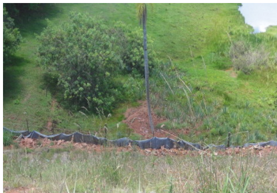
Contenção de assoreamento com barreira de manta geotêxtil. E:9+20 em 20/11/12 -29,558495S - 51,8865014W
