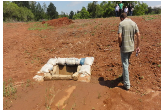
Proteção de posso de coleta de água em canteiro central (barreira de sacos com terra) sendo vistoriada por técnico do IBAMA, LD. 5.10.12.
