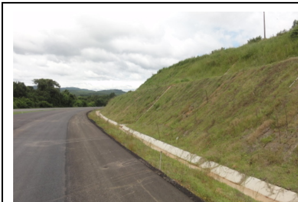
Km 23+180, conformação de taludes com bancadas, revestidos com leivas e com implantação de descida de água e canaletas de drenagem. Situação em 21.3.13.
