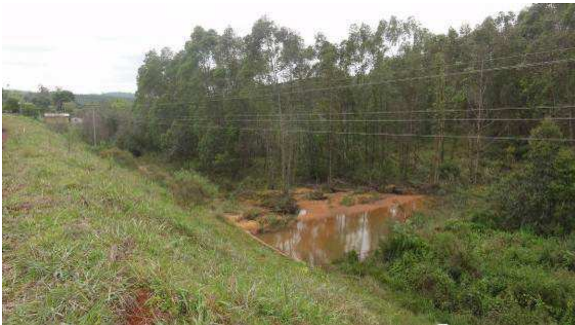
Figura 29 - Abertura da drenagem (passafauna) com acúmulo de água.
