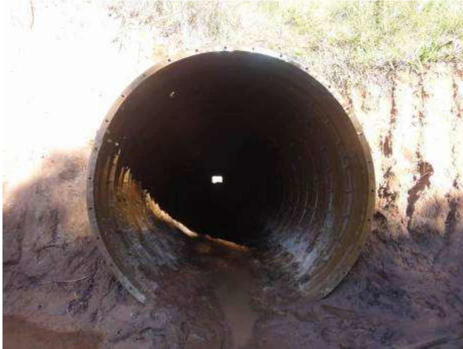
Figura 56 - Interior de drenagem (tubo armado).
