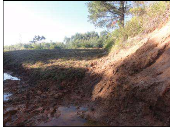
Detalhe de bota-fora na margem direita do curso d'água a jusante do bueiro armico.
