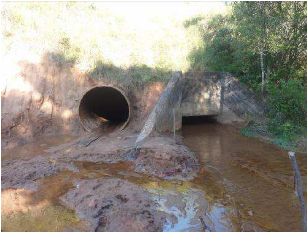
Figura 54 - Drenagem dupla: bueiro ármico e simples, com acúmulo de água e sedimento.
