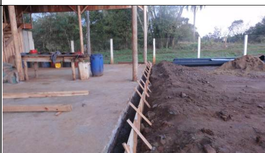
Construção de canaletas para retenção de óleo - galpão da área de apoio, km 14+500 LD. 27/07/11.
