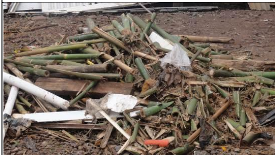
Resíduos de taquaras disposta em montes para recolhimento - área de apoio às obras de terraplenagem, km 14+500 LD. 21/06/11.
