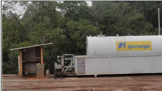
Tanque de combustível e bacia de retenção de óleo diesel - área de apoio às obras de terraplenagem, km 14+500 LD. 21/06/11.
