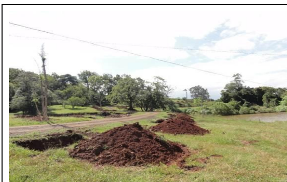
Sítio do Rui, acesso no km 6+400 LD da obra. Covas abertas para receber vegetais transplantados. 30/03/11.
