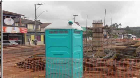
Banheiro químico na área de construção do Viaduto de Fazenda Vila Nova. 21/06/11.
