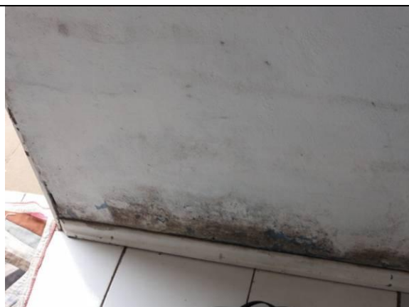
Sala – Paredes 1 e 4 com muita umidade e mofo (DSC03745, 23/02/2011, 10:22h)
