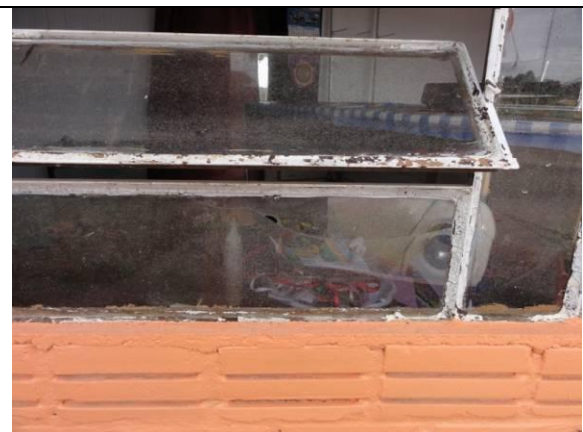
Fachada – Janelas com vidros rachados e quebrados (DSC03697, 23/02/2011, 10:08h)
