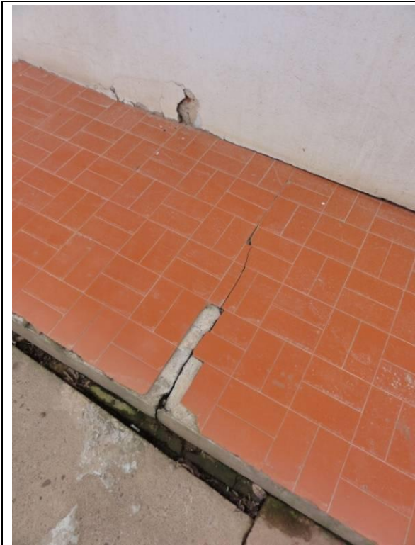
Lateral Esquerda- Parede B (DSC04752, 24/02/2011, 11:13h)
