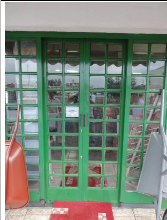
Fachada - Vidraças (DSC04096, 23/02/2011, 16:33h)
