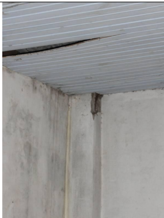
Quarto 1 – Paredes com muita umidade, mofo e fissuras no reboco (DSC03663, 23/02/2011, 09:57h)
