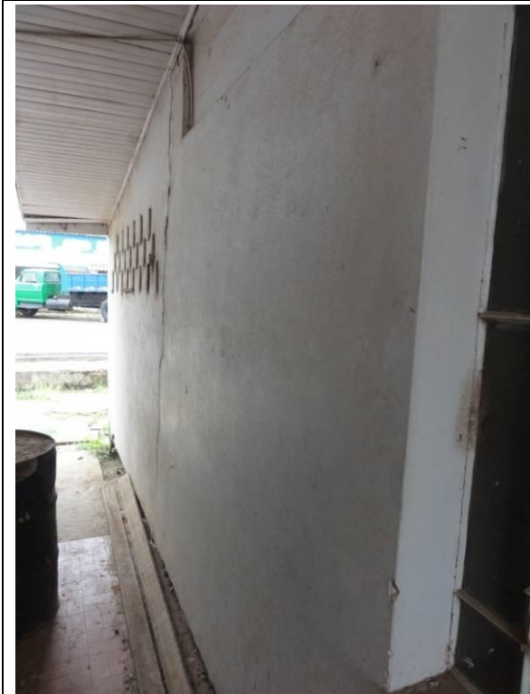
Lateral Direita – Parede D (DSC04728, 24/02/2011, 11:10h)
