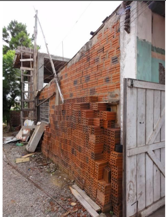
Lateral Direito – Parede D (DSC03633, 23/02/2011, 09:53h)
