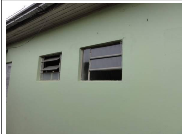
Lateral Direita- parede D (DSC04316, 23/02/2011, 17:31h)
