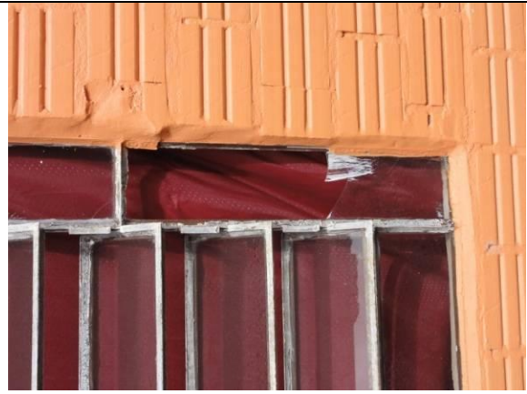
Fachada – Janelas com vidros rachados e quebrados (DSC03691, 23/02/2011, 10:07h)
