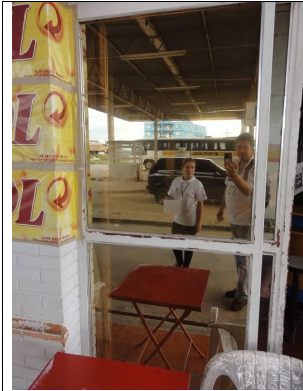
Fachada – Janela com vidros quebrados (DSC04706, 24/02/2011, 11:07h)
