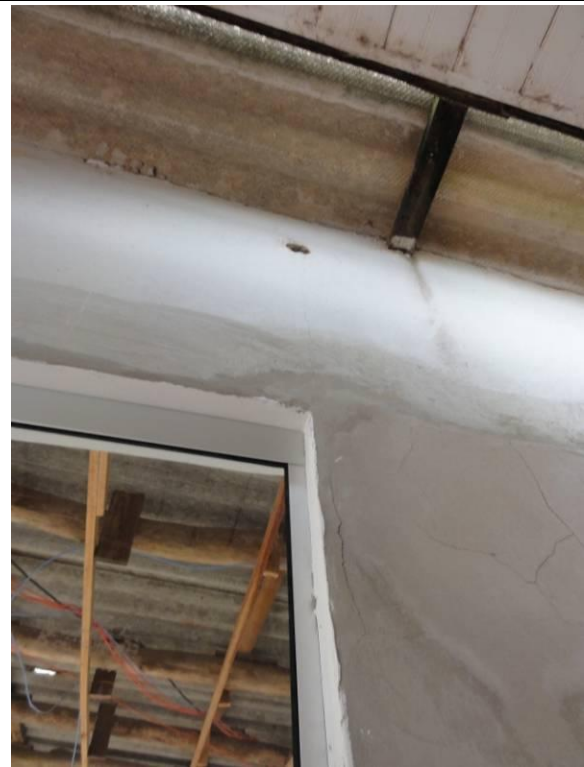
Lateral Direita – Parede D (DSC04725, 24/02/2011, 11:10h)
