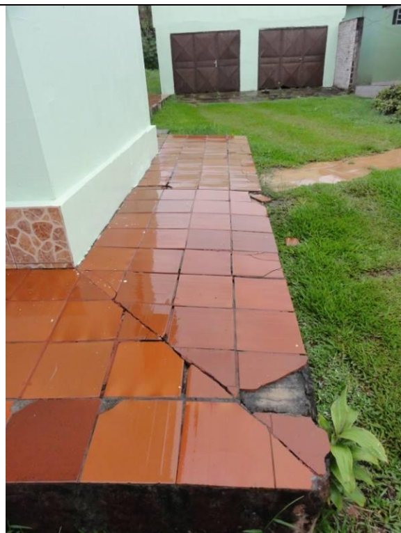
Lateral Esquerda – Parede B (DSC04258, 23/02/2011, 17:17h)
