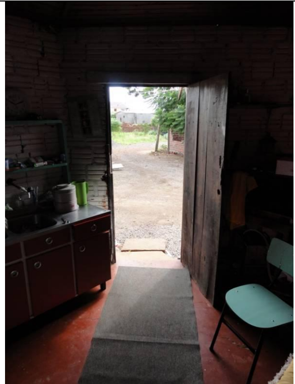
Sala – Piso de concreto com rachaduras (DSC03715, 23/02/2011, 10:11h)
