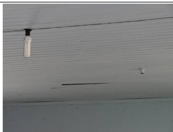
Salão – Teto com forro de madeira com algumas partes cedendo (DSC04596, 24/02/2011, 10:08h)
