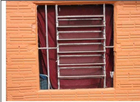
Fachada – Janelas com vidros rachados e quebrados (DSC03690, 23/02/2011, 10:07h)
