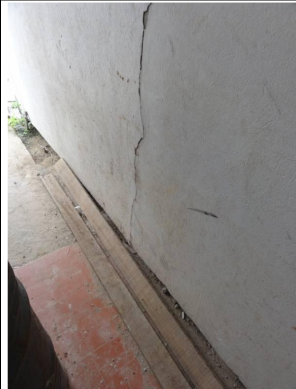
Lateral Direita – Parede D (DSC04732, 24/02/2011, 11:10h)
