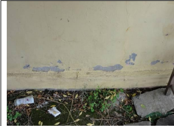
Fachada – Parede com reboco descascando (DSC03725, 23/02/2011, 10:19h)
