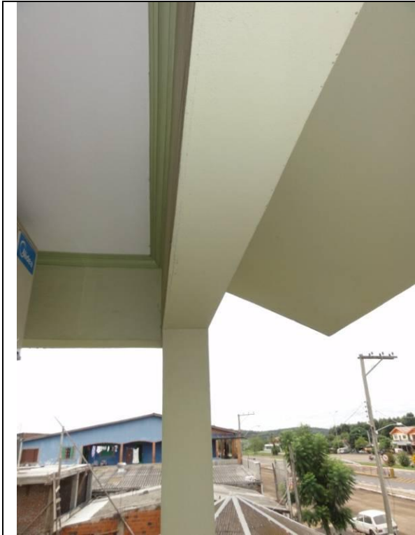
Piso Superior - Sacada (DSC03955, 23/02/2011, 11:16h)
