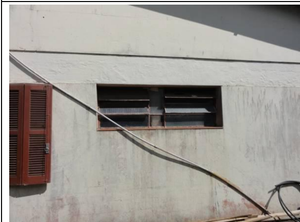
Lateral Direita – Parede D (DSC04562, 24/02/2011, 10:03h)
