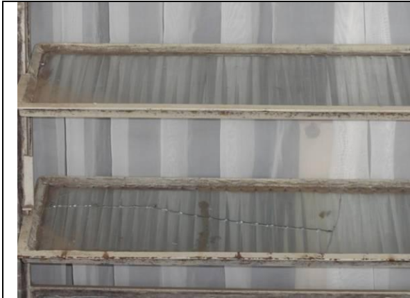
Fachada – Basculante com vidro rachado (DSC03620, 23/02/2011, 09:51h)
