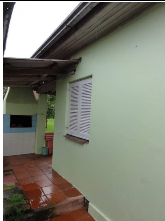
Lateral Direita- parede D (DSC04319, 23/02/2011, 17:31h)
