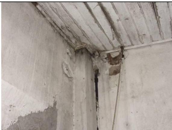
Sala 1 Mecânica – Teto com forro de madeira cedendo (DSC03648, 23/02/2011, 09:55h)
