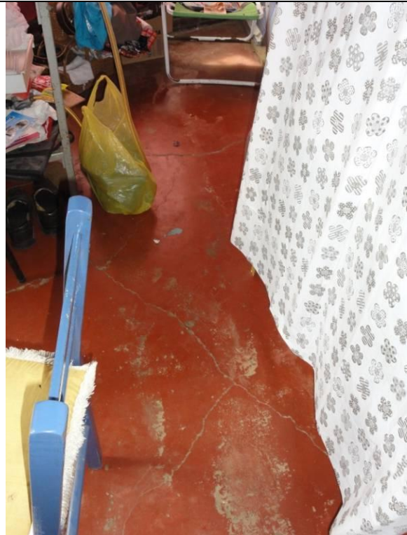
Sala – Piso de concreto com rachaduras (DSC03719, 23/02/2011, 10:11h)
