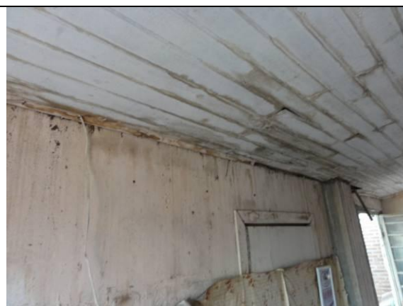
Sala / Cozinha – Teto com forro de madeira cedendo (DSC03655, 23/02/2011, 09:56h)
