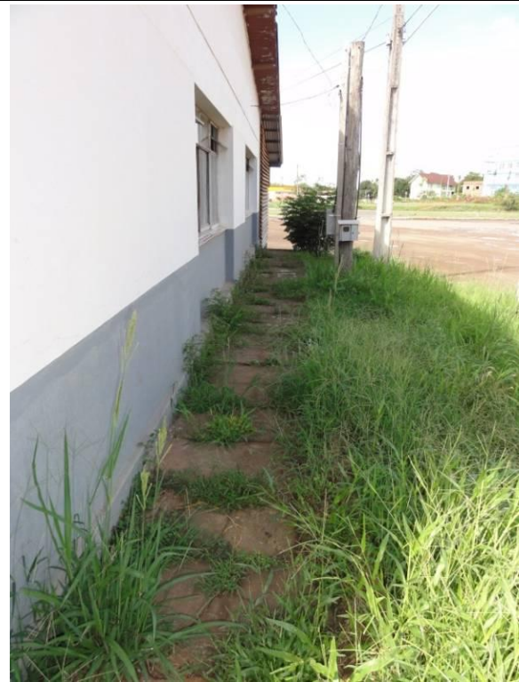
Lateral Esquerda - Parede (DSC04537, 24/02/2011, 09:55h)
