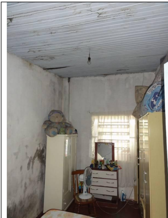
Quarto 1 – Paredes com muita umidade, mofo e fissuras no reboco (DSC03660, 23/02/2011, 09:57h)
