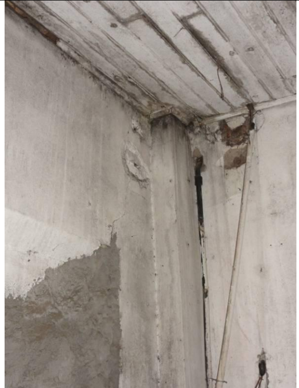
Sala 1 Mecânica – Teto com forro de madeira cedendo (DSC03647, 23/02/2011, 09:55h)
