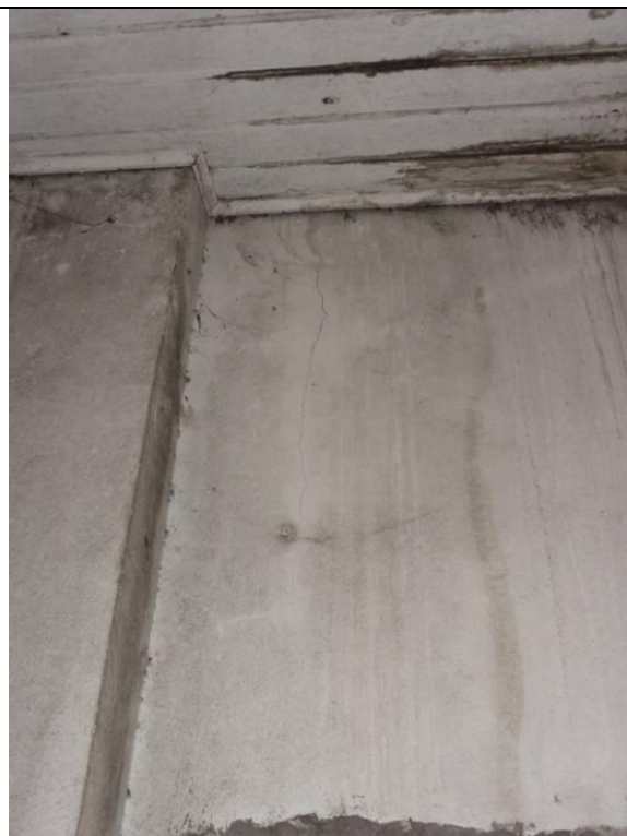
Sala 1 Mecânica – Teto com forro de madeira cedendo (DSC03645, 23/02/2011, 09:55h)
