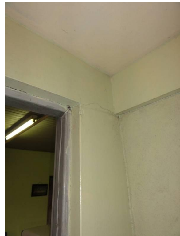
Quarto 1 – paredes com bastante umidade (DSC04285, 23/02/2011, 17:22h)
