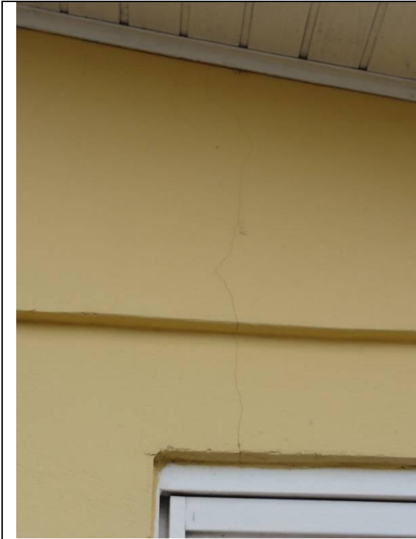
Fachada – Fissuras no reboco próximos a janela (DSC03729, 23/02/2011, 10:20h)
