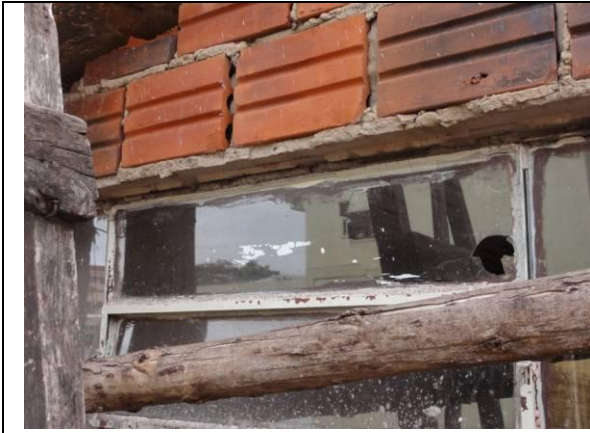
Lateral Direito – Parede D – Vidro rachado (DSC03636, 23/02/2011, 09:54h)
