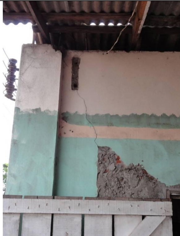
Fachada – Parede A com algumas fissuras no reboco (DSC03629, 23/02/2011, 09:53h)
