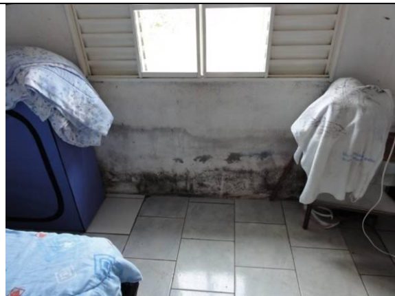
Quarto 1 – Paredes 6 e 7 com muita umidade e mofo (DSC03752, 23/02/2011, 10:23h)
