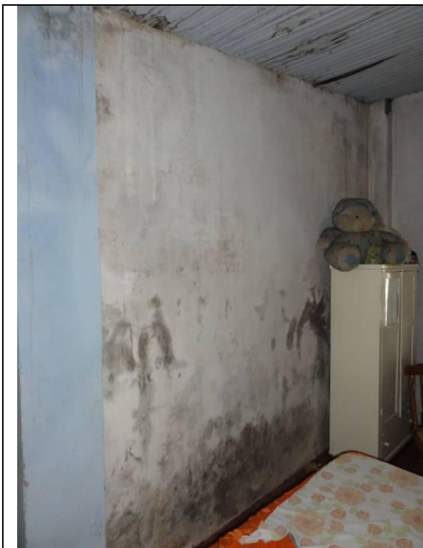
Quarto 1 – Paredes com muita umidade, mofo e fissuras no reboco (DSC03662, 23/02/2011, 09:57h)
