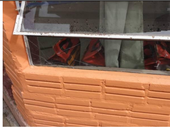
Fachada – Janelas com vidros rachados e quebrados (DSC03687, 23/02/2011, 10:06h)
