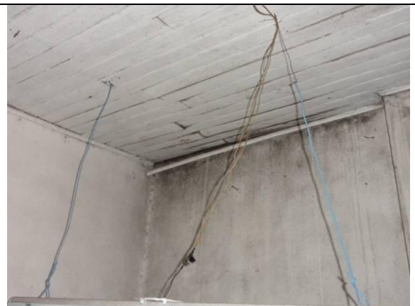
Sala 1 Mecânica – Teto com forro de madeira cedendo (DSC03649, 23/02/2011, 09:55h)
