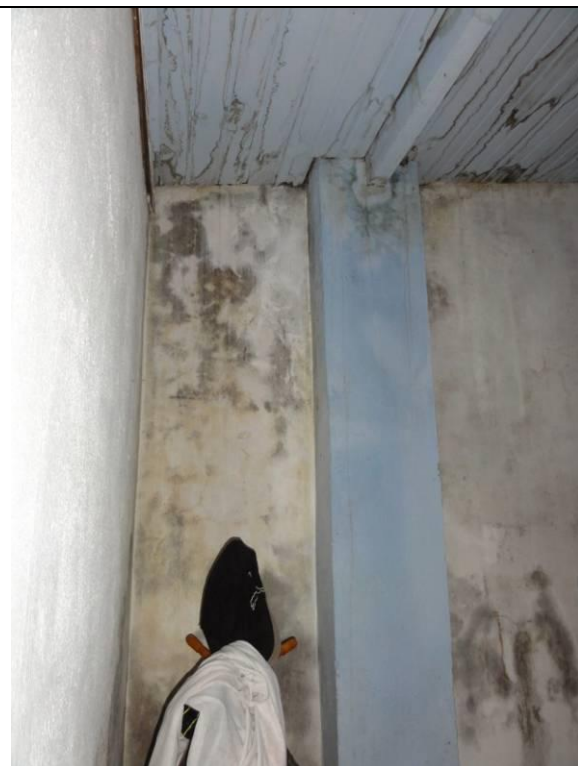
Quarto 1 – Paredes com muita umidade, mofo e fissuras no reboco (DSC03661, 23/02/2011, 09:57h)
