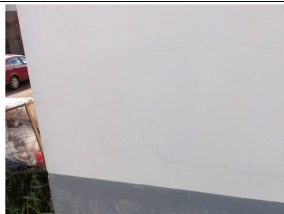
Lateral Esquerda - Parede (DSC04533, 24/02/2011, 09:54h)
