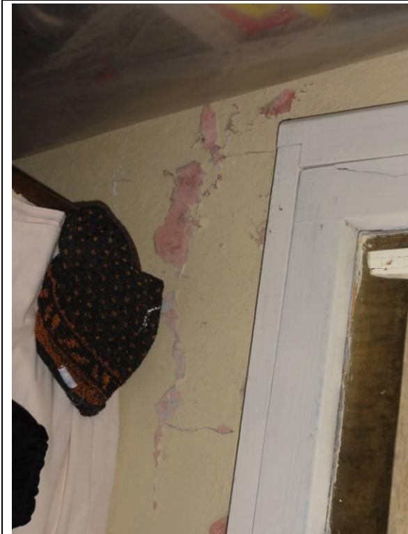
Quarto 4 – Reboco caindo próximo a janela (DSC04210, 23/02/2011, 16:59h)
