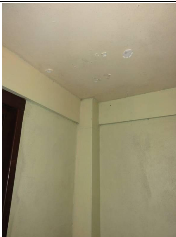
Quarto 1 – paredes com bastante umidade (DSC04280, 23/02/2011, 17:21h)
