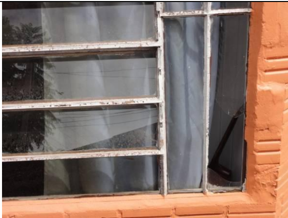
Fachada – Janelas com vidros rachados e quebrados (DSC03688, 23/02/2011, 10:06h)
