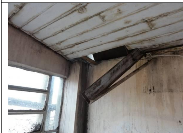
Sala / Cozinha – Teto com forro de madeira cedendo (DSC03654, 23/02/2011, 09:56h)
