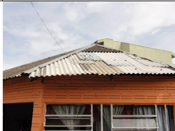
Fachada - Teto (DSC03685, 23/02/2011, 10:06h)
