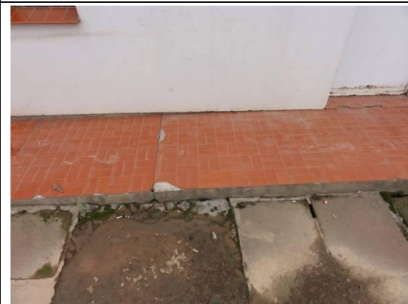
Lateral Esquerda- Parede B (DSC04763, 24/02/2011, 11:14h)
