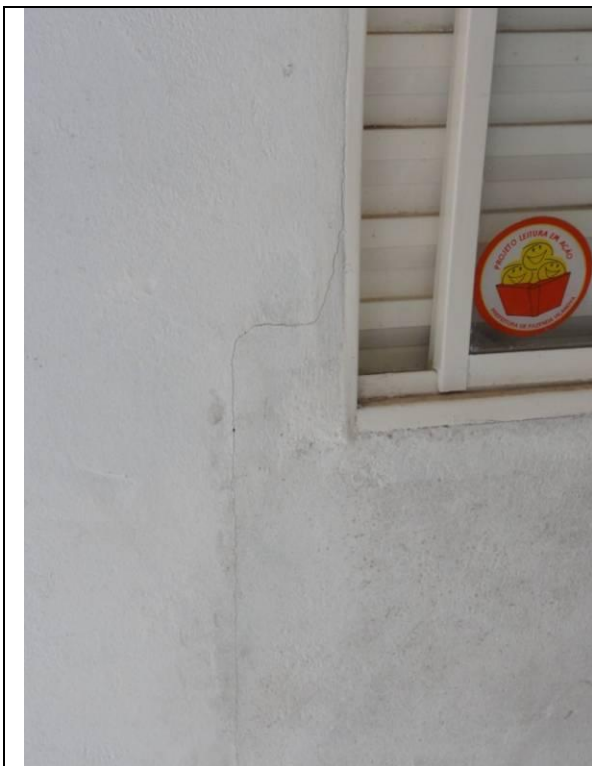
Sala – Paredes 1 e 4 com muita umidade e mofo (DSC03743, 23/02/2011, 10:22h)
