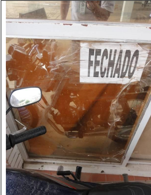
Fachada – Janela com vidros quebrados (DSC04710, 24/02/2011, 11:07h)
