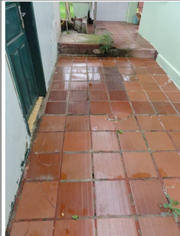
Lateral Esquerda – Parede B (DSC04351, 24/02/2011, 09:18h)
