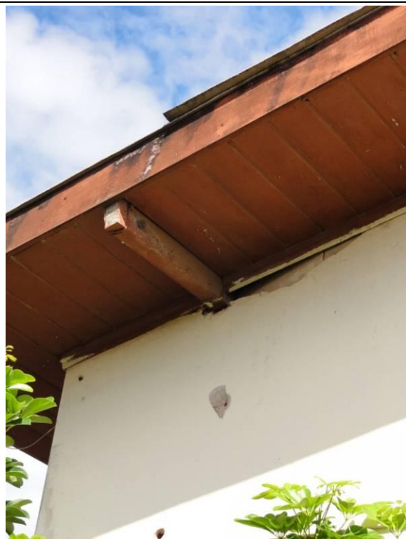
Lateral Direita – Parede D (DSC04555, 24/02/2011, 10:02h)
