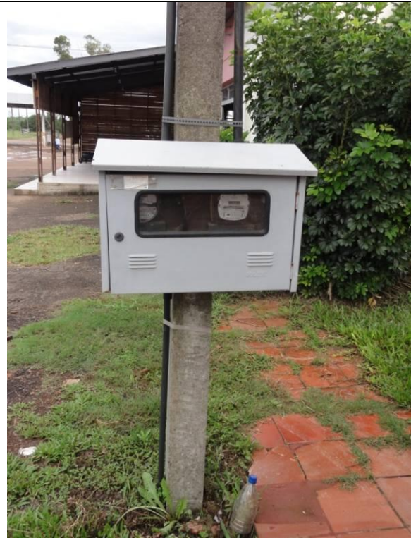
Caixa de luz (DSC04330, 24/02/2011, 09:13h)
