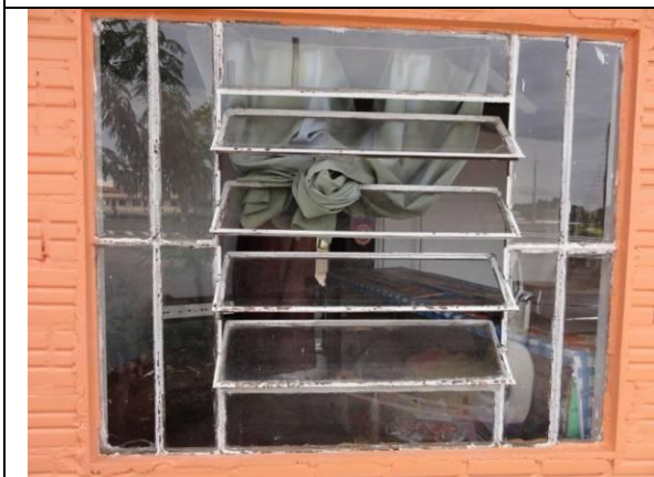
Fachada – Janelas com vidros rachados e quebrados (DSC03696, 23/02/2011, 10:08h)
