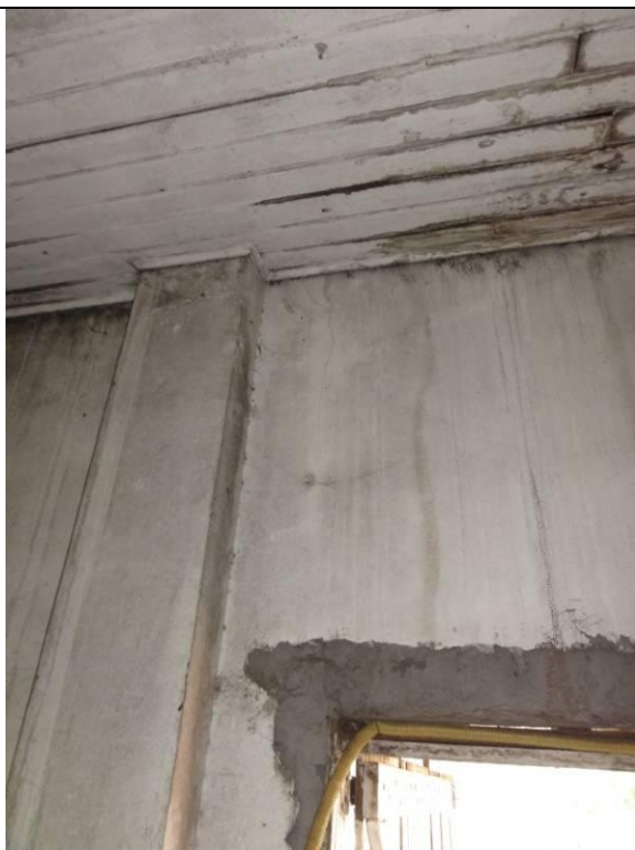
Sala 1 Mecânica – Teto com forro de madeira cedendo (DSC03644, 23/02/2011, 09:55h)
