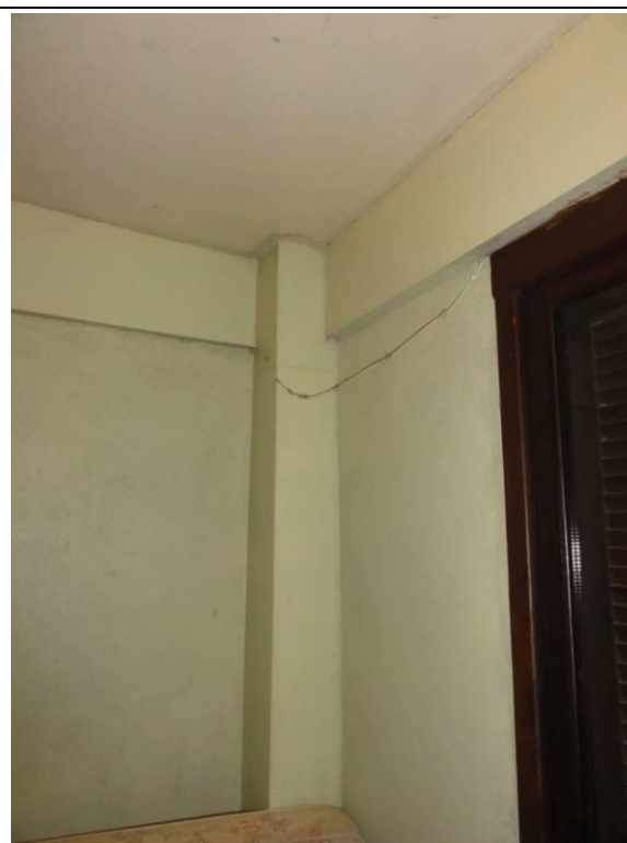
Quarto 1 – paredes com bastante umidade (DSC042820, 23/02/2011, 17:21h)
