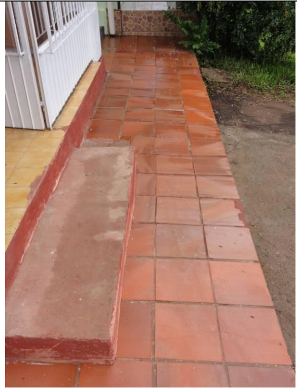
Fachada – Calçada com muitas pelas rachadas (DSC04332, 24/02/2011, 09:14h)
