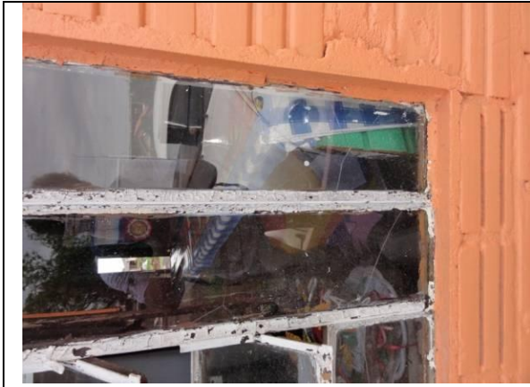
Fachada – Janelas com vidros rachados e quebrados (DSC03698, 23/02/2011, 10:08h)
