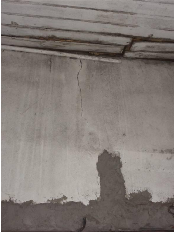
Sala 1 Mecânica – Teto com forro de madeira cedendo (DSC03646, 23/02/2011, 09:55h)
