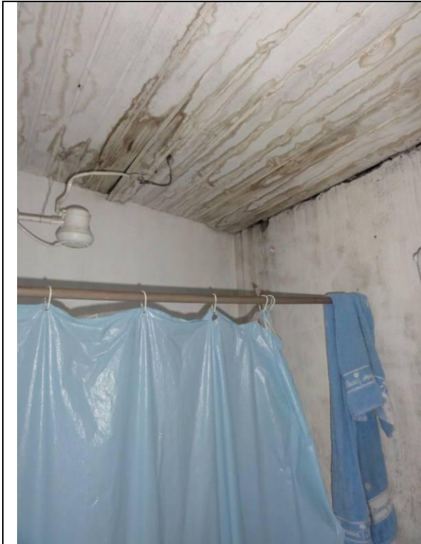
Wc 1 – Teto com forro de madeira com muita umidade (DSC03667, 23/02/2011, 09:58h)
