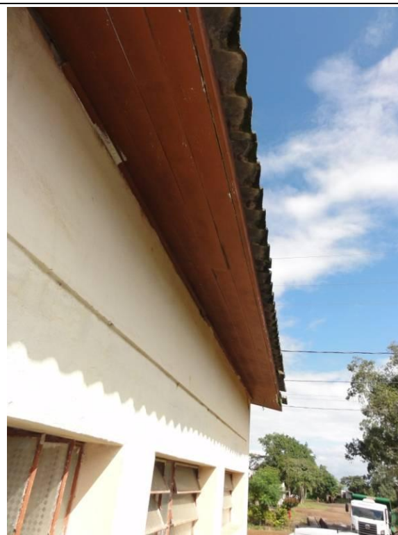
Fundos – Marquise com forro de madeira com algumas partes quebradas (DSC04545, 24/02/2011, 09:56h)
