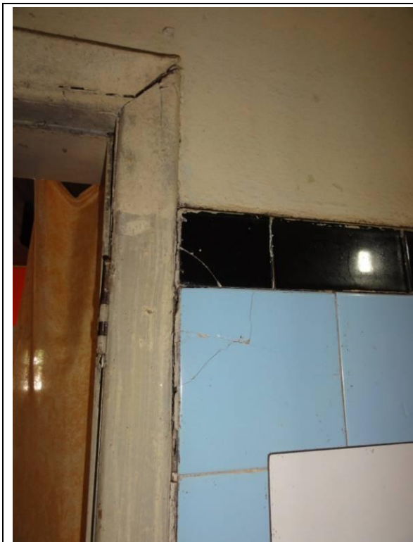
Cozinha 1 – Azulejos quebrados e rachados (DSC04619, 24/02/2011, 10:12h)
