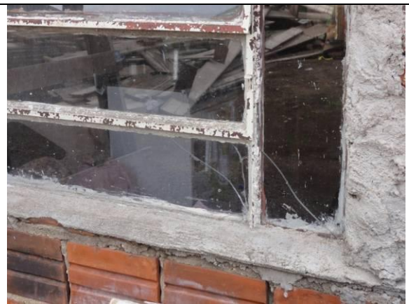
Lateral Direito – Parede D – Vidro rachado (DSC03635, 23/02/2011, 09:53h)
