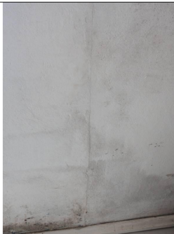
Sala – Paredes 1 e 4 com muita umidade e mofo (DSC03744, 23/02/2011, 10:22h)
