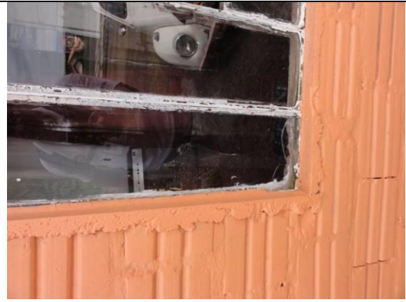
Fachada – Janelas com vidros rachados e quebrados (DSC03699, 23/02/2011, 10:08h)
