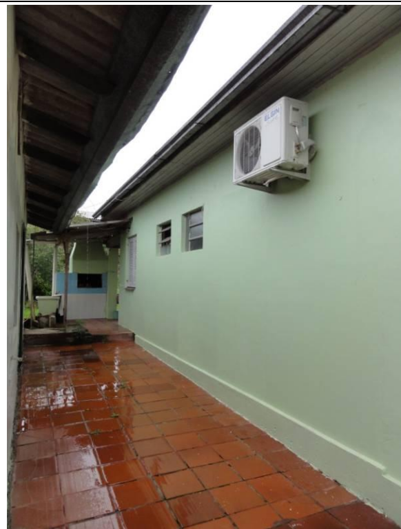
Lateral Direita- parede D (DSC04315, 23/02/2011, 17:31h)
