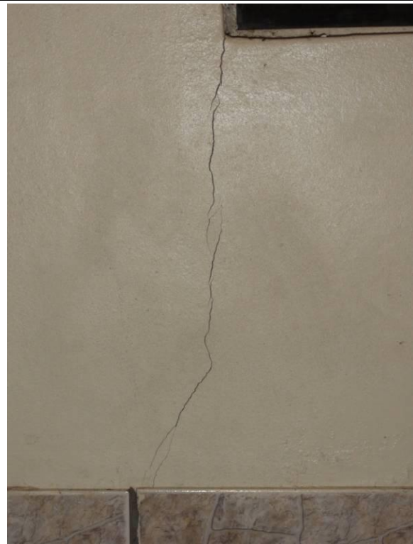
Loja – WC – Parede 9 com duas fissuras próximo ao basculante (DSC04125, 23/02/2011, 16:40h)
