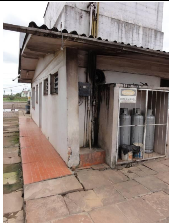
Lateral Esquerda- Parede B (DSC04747, 24/02/2011, 11:12h)
