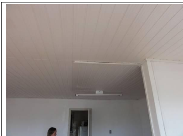
Sala – Teto com forro PVC com alguns furos (DSC04443, 24/02/2011, 09:29h)
