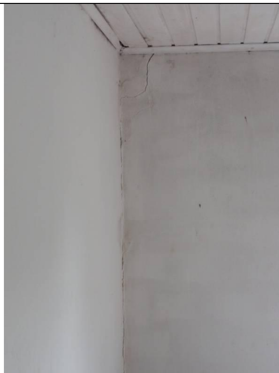
Quarto 3 – Parede 14 rachadura próximo ao teto (DSC03784, 23/02/2011, 10:28h)
