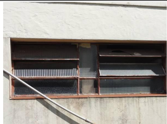
Lateral Direita – Parede D (DSC04564, 24/02/2011, 10:03h)
