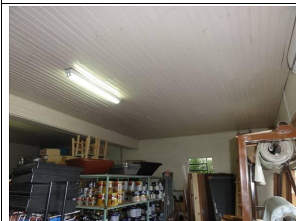
Loja - Teto com forro de madeira com algumas partes cedendo (DSC04104, 23/02/2011, 16:35h)
