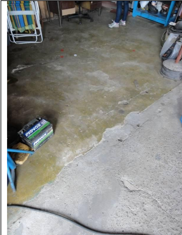
Sala 1 Mecânica – Piso de concreto (DSC03640, 23/02/2011, 09:54h)
