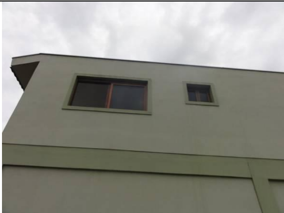
Lateral Direito – Parede D (DSC04066, 23/02/2011, 16:15h)
