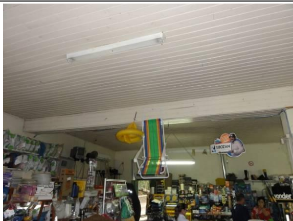
Loja - Teto com forro de madeira com algumas partes cedendo (DSC04106, 23/02/2011, 16:35h)
