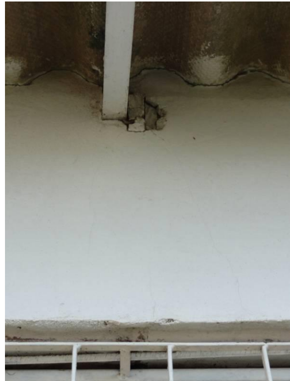
Lateral Direito – Parede D (DSC04386, 24/02/2011, 09:22h)
