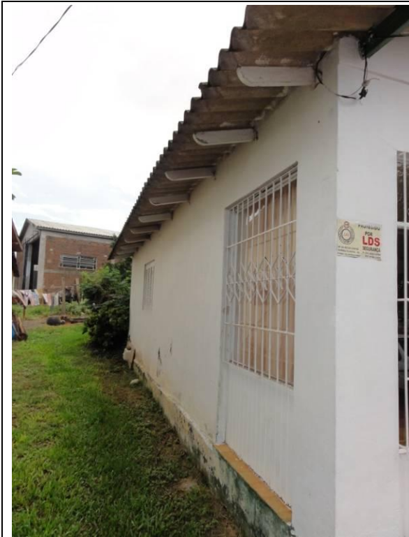
Lateral Direito – Parede D (DSC04381, 24/02/2011, 09:22h)
