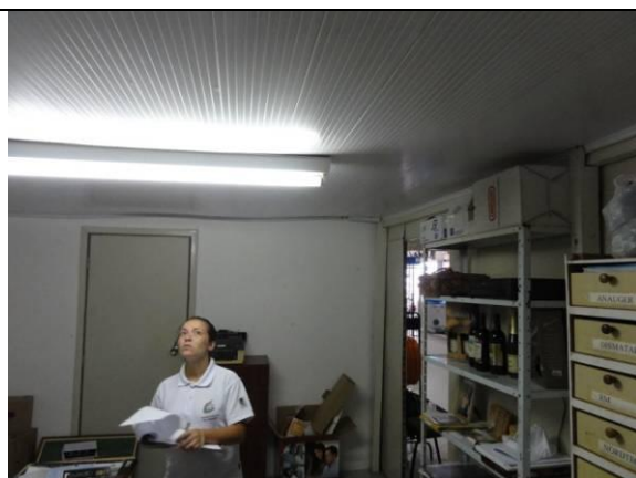
Piso Inferior – Loja – Sala 1 – Teto com forro PVC cedendo (DSC03873, 23/02/2011, 11:02h)
