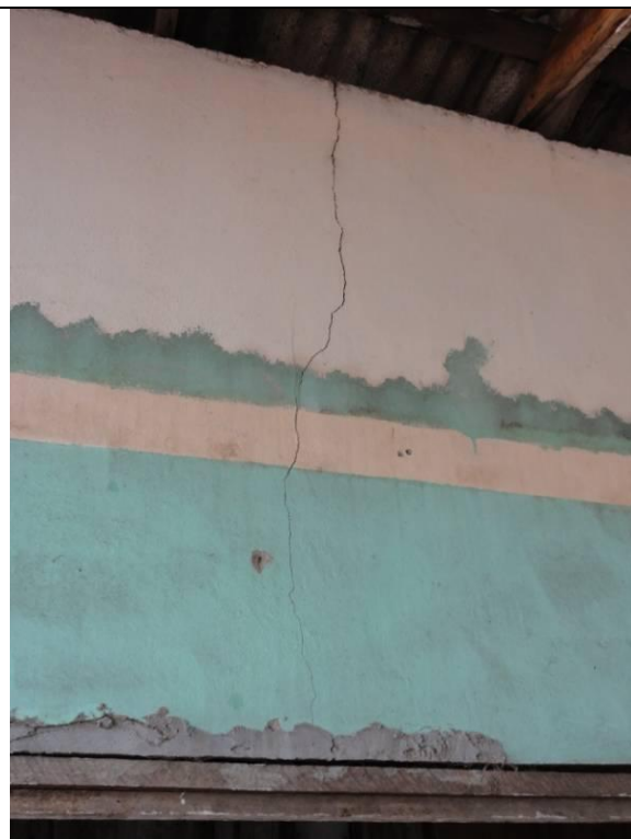
Fachada – Parede A com algumas fissuras no reboco (DSC03631, 23/02/2011, 09:53h)
