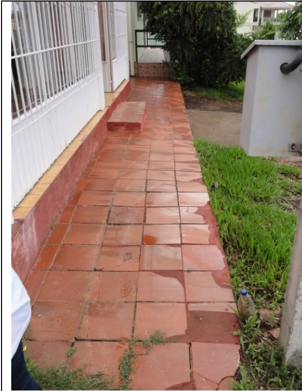
Fachada – Calçada com muitas pelas rachadas (DSC04331, 24/02/2011, 09:14h)
