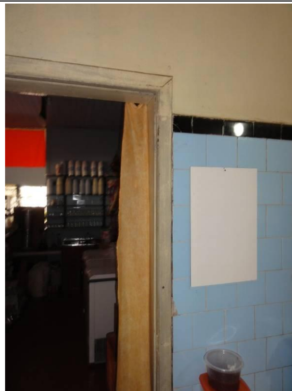
Cozinha 1 – Azulejos quebrados e rachados (DSC04618, 24/02/2011, 10:12h)
