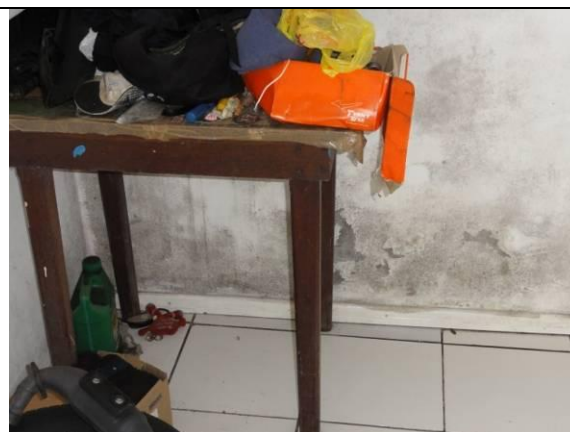
Sala – Paredes 1 e 4 com muita umidade e mofo (DSC03746, 23/02/2011, 10:22h)
