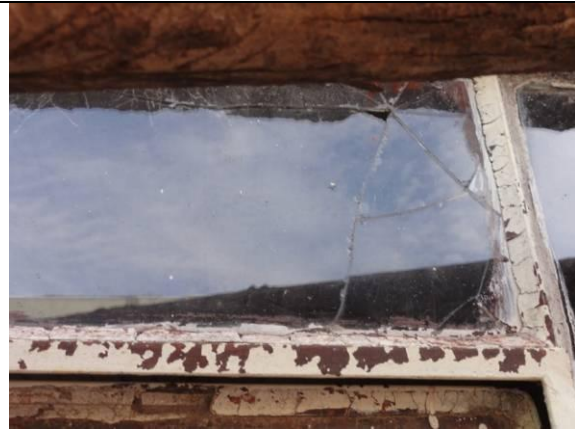
Lateral Direito – Parede D – Vidro rachado (DSC03637, 23/02/2011, 09:54h)
