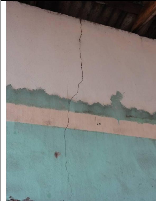
Fachada – Parede A com algumas fissuras no reboco (DSC03632, 23/02/2011, 09:53h)
