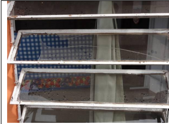
Fachada – Janelas com vidros rachados e quebrados (DSC03686, 23/02/2011, 10:06h)
