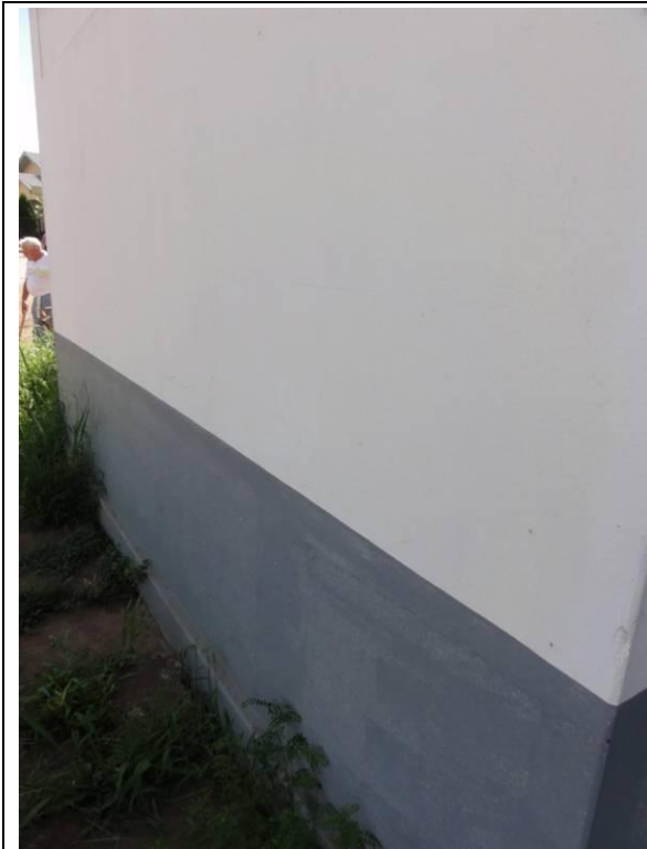
Lateral Esquerda - Parede (DSC04530, 24/02/2011, 09:54h)
