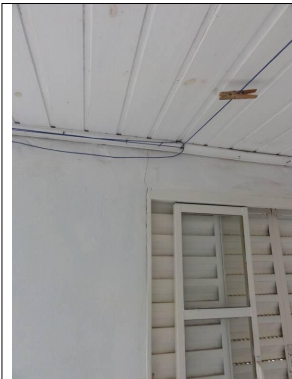
Sala – Paredes 1 e 4 com muita umidade e mofo (DSC03741, 23/02/2011, 10:22h)
