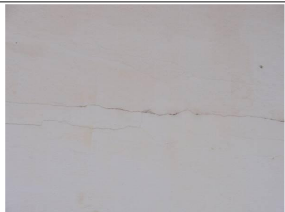
Parede B com várias fissuras no reboco (DSC04509, 24/02/2011, 09:52h)
