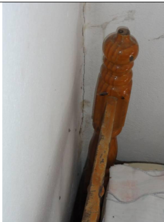
Quarto 3 – Parede com fissura no reboco entre as paredes 15 e 16 (DSC03786, 23/02/2011, 10:28h)
