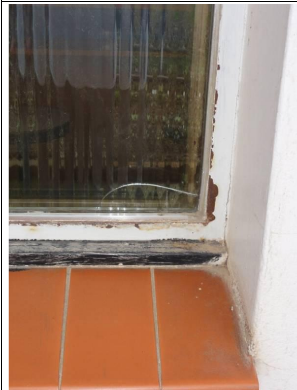
Lateral Esquerda- Parede B (DSC04766, 24/02/2011, 11:15h)
