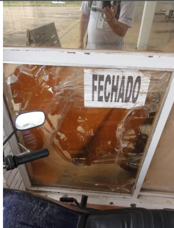
Fachada – Janela com vidros quebrados (DSC04709, 24/02/2011, 11:07h)
