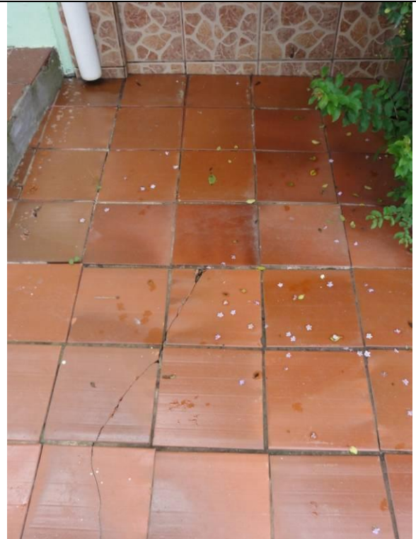
Fachada – Calçada com muitas pelas rachadas (DSC04334, 24/02/2011, 09:14h)
