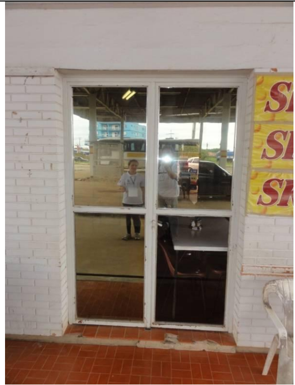
Fachada – Janela com vidros quebrados (DSC04707, 24/02/2011, 11:07h)
