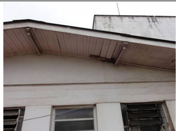
Lateral Esquerda- Parede B (DSC04759, 24/02/2011, 11:14h)
