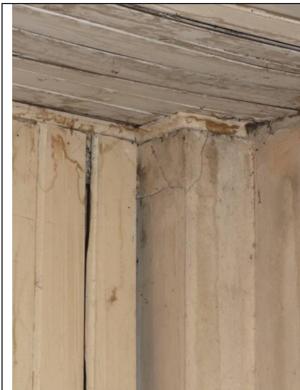
Sala / Cozinha – Teto com forro de madeira cedendo (DSC03658, 23/02/2011, 09:57h)
