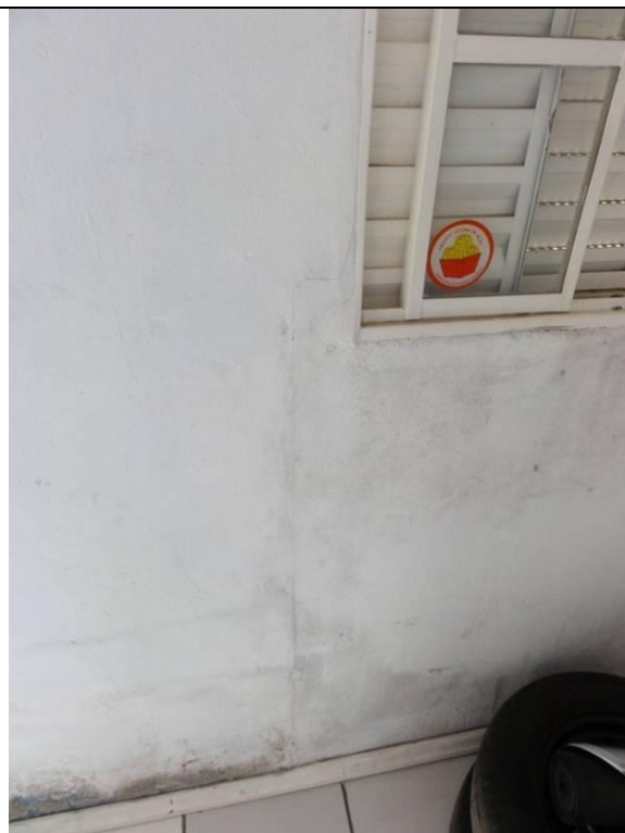
Sala – Paredes 1 e 4 com muita umidade e mofo (DSC03740, 23/02/2011, 10:22h)
