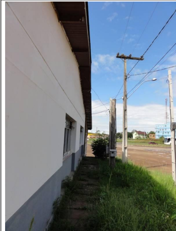
Lateral Esquerda - Parede (DSC04536, 24/02/2011, 09:55h)
