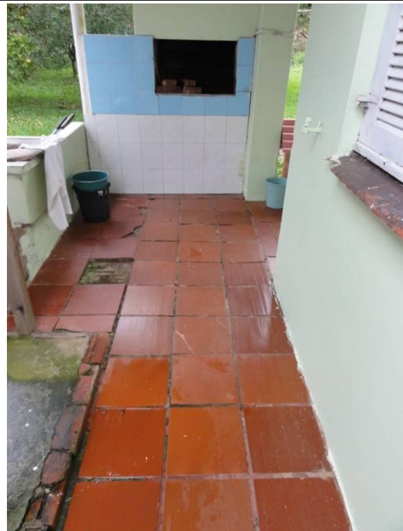
Lateral Direita- parede D (DSC04321, 23/02/2011, 17:32h)
