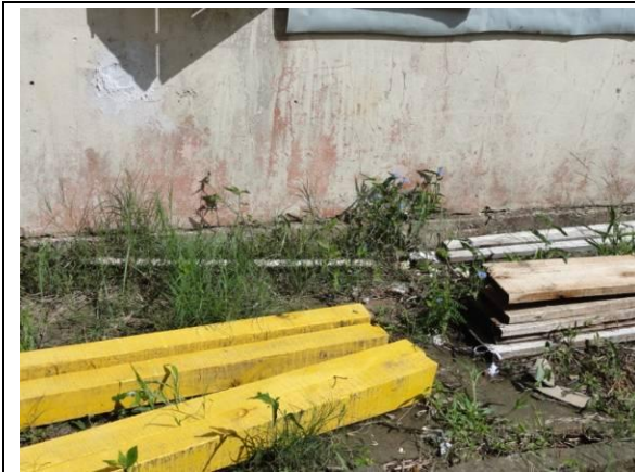
Lateral Direita – Parede D (DSC04575, 24/02/2011, 10:04h)
