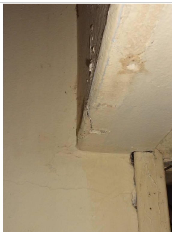
Cozinha 1 – Parede com muita umidade e mofo (DSC04616, 24/02/2011, 10:12h)
