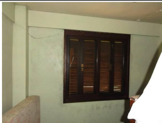
Quarto 1 – paredes com bastante umidade (DSC04278, 23/02/2011, 17:20h)
