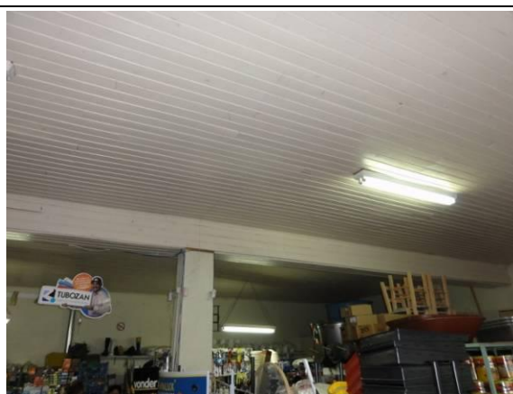
Loja - Teto com forro de madeira com algumas partes cedendo (DSC04105, 23/02/2011, 16:35h)
