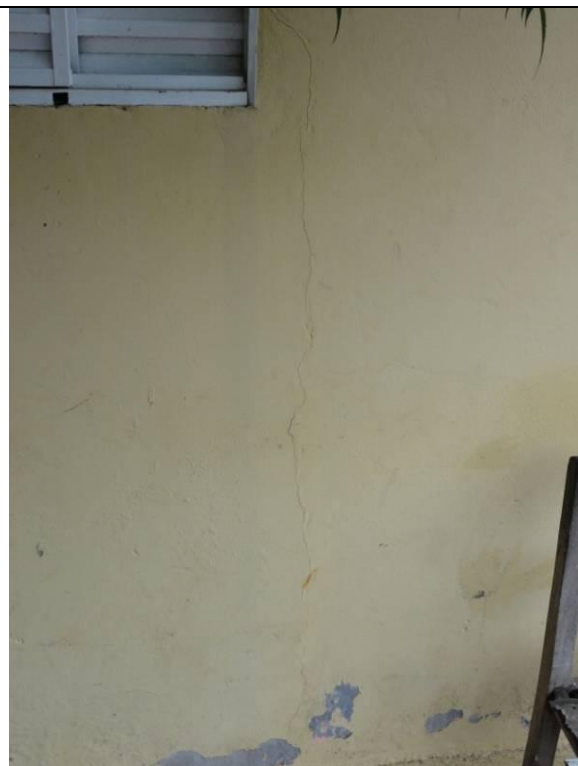
Fachada – Parede com reboco descascando (DSC03724, 23/02/2011, 10:19h)
