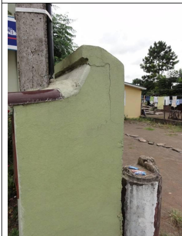
Fachada – Muro com caixa de luz (DSC03821, 23/02/2011, 10:53h)
