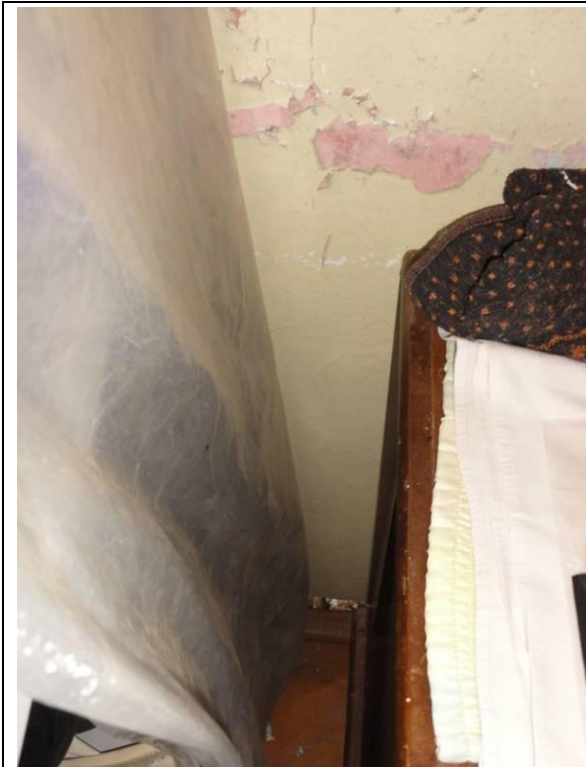
Quarto 4 – Reboco caindo próximo a janela (DSC04212, 23/02/2011, 16:59h)
