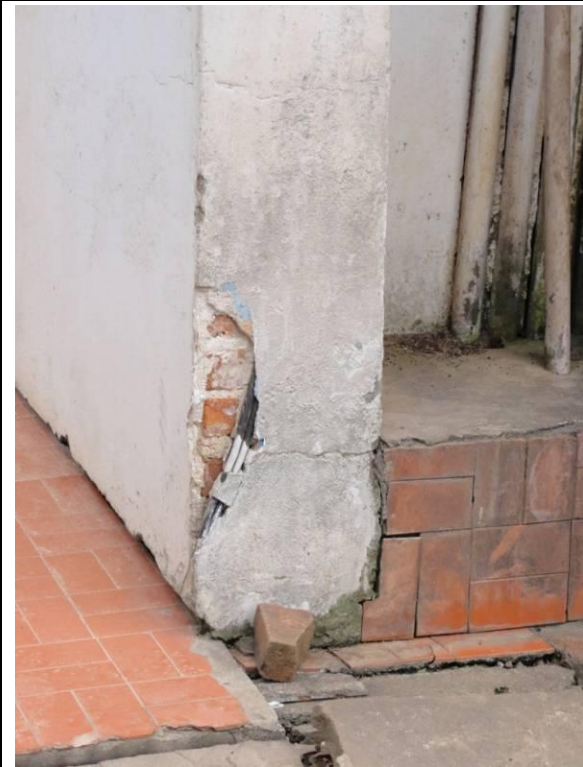
Lateral Esquerda- Parede B (DSC04748, 24/02/2011, 11:13)
