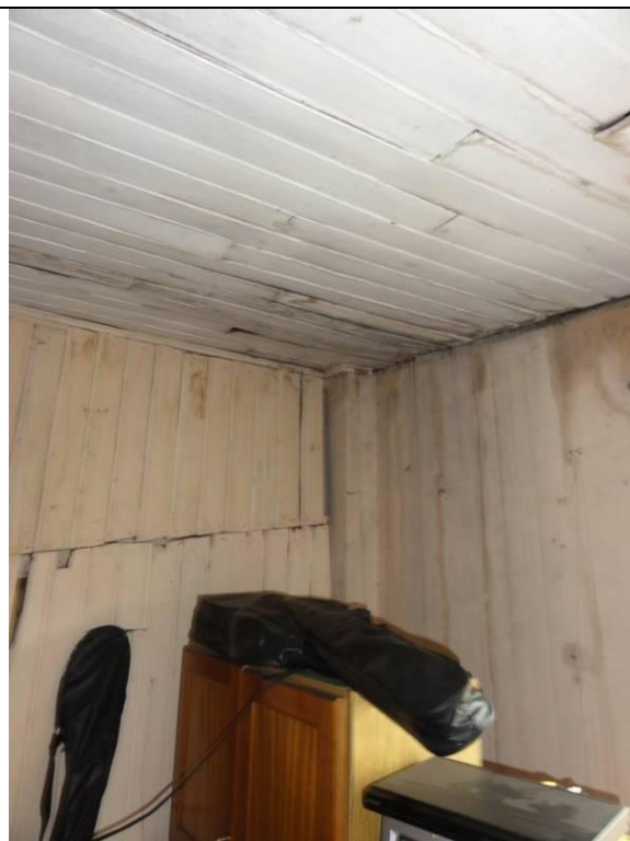
Sala / Cozinha – Teto com forro de madeira cedendo (DSC03657, 23/02/2011, 09:56h)
