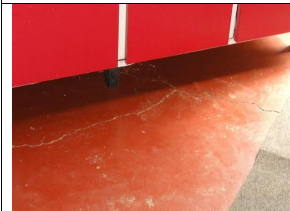
Sala – Piso de concreto com rachaduras (DSC03716, 23/02/2011, 10:11h)
