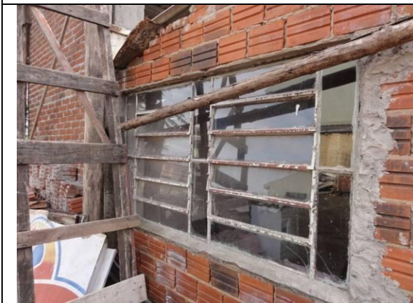
Lateral Direito – Parede D – Vidro rachado (DSC03634, 23/02/2011, 09:53h)
