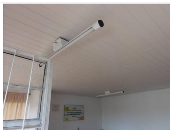
Sala – Teto com forro PVC com alguns furos (DSC04444, 24/02/2011, 09:29h)
