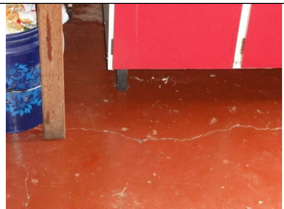
Sala – Piso de concreto com rachaduras (DSC03717, 23/02/2011, 10:11h)
