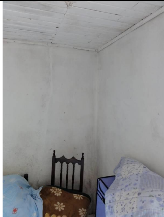
Quarto 1 – Paredes 6 e 7 com muita umidade e mofo (DSC03754, 23/02/2011, 10:23h)
