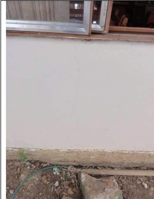
Lateral Direita – Parede D (DSC02783, 22/02/2011, 09:34h)
