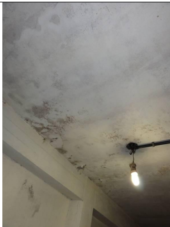
Parte 2 – Piso inferior – Lanchonete – Teto em geral com muita umidade e mofo (DSC02552, 21/02/2011, 16:55h)
