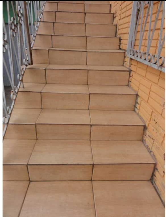
Lateral Direto – Escada – Piso cerâmico com algumas peças quebradas e rachadas (DSC02299, 21/02/2011, 16:00h)
