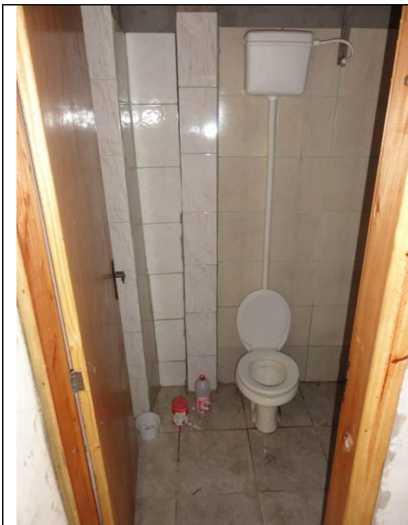
Piso Inferior – Salão 1 – WC (DSC03504, 23/02/2011, 09:24h)
