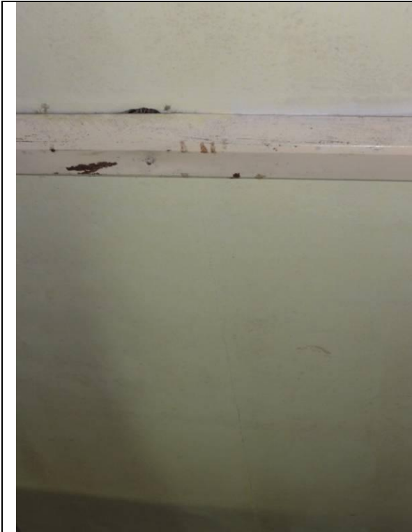
Piso Inferior – Fábrica - Teto (DSC03153, 22/02/2011, 16:40h)
