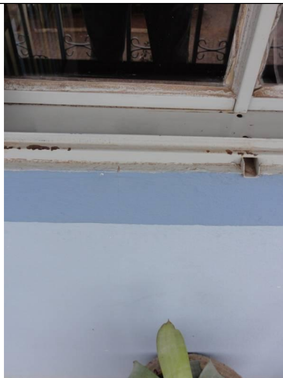
Piso superior – Sacada – Fissuras no reboco próximo a janela (DSC02341, 21/02/2011, 16:07h)
