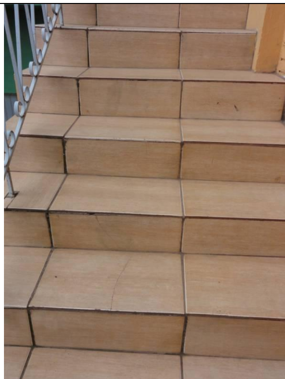
Lateral Direto – Escada – Piso cerâmico com algumas peças quebradas e rachadas (DSC02301, 21/02/2011, 16:00h)
