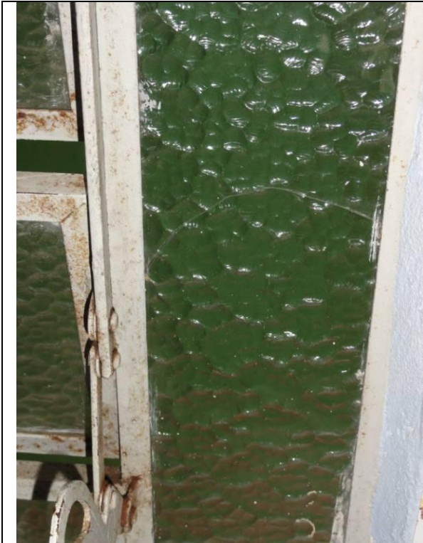
(Piso superior - Area de Serviço – Vidro rachado (DSC02438, 21/02/2011, 16:33h)
