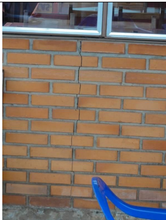
Piso inferior – Hall – Parede 2 de tijolo a vista com rachadura no tijolo (DSC02808, 22/02/2011, 09:39h)
