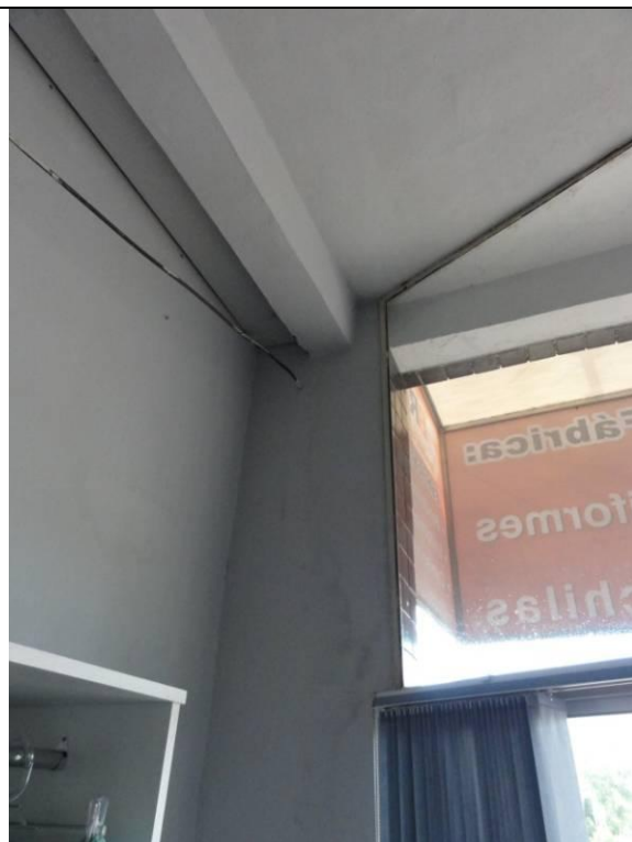
Piso Inferior – Loja – Parede 2 com muita umidade e mofo (DSC03383, 23/02/2011, 08:57h)
