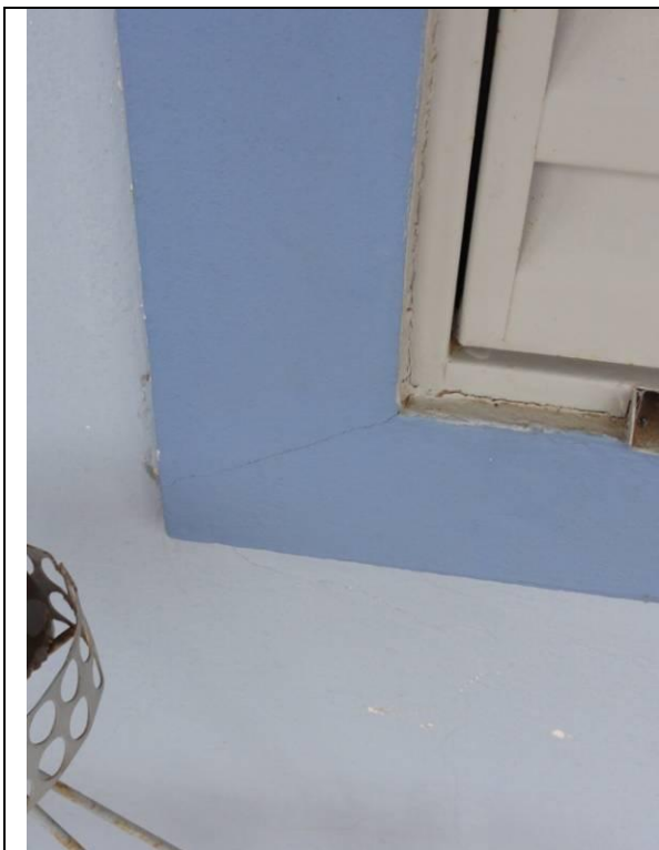
Piso superior – Sacada – Fissuras no reboco próximo a janela (DSC02344, 21/02/2011, 16:08h)
