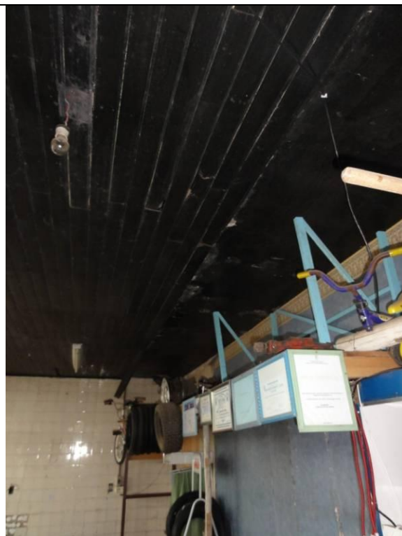
Piso Inferior – Borracharia – Teto com forro de madeira com algumas partes quebradas e outras cedendo (DSC03053, 22/02/2011, 11:00h)
