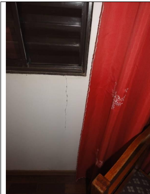
Piso superior - Sala 2 – Rachaduras próximas a janela (DSC02396, 21/02/2011, 16:19h)
