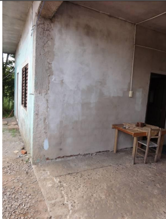
Garagem (DSC02608, 21/02/2011, 17:14h)
