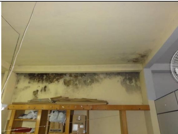
Piso Inferior – Loja – Parede com bastante mofo (DSC03406, 23/02/2011, 09:01h)
