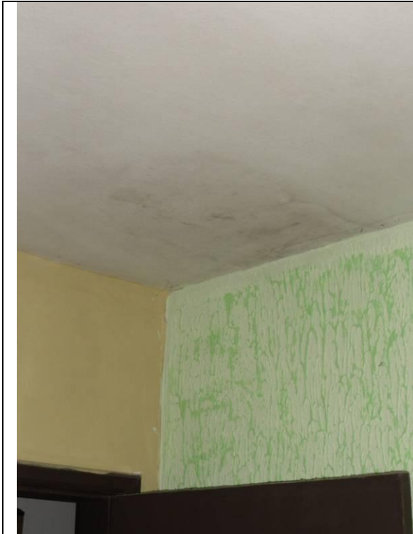
Piso superior – Quarto 2 – Teto com umidade (DSC02370, 21/02/2011, 16:13h)
