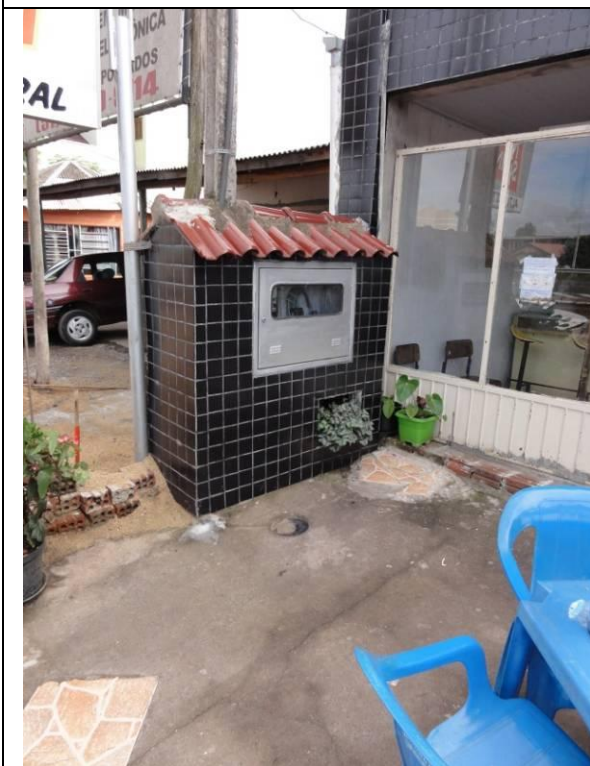
Fachada – Muro com caixa de luz (DSC03480, 23/02/2011, 09:20h)
