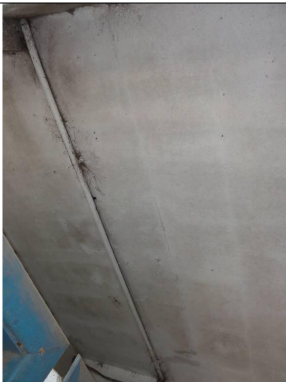
Piso Inferior – Fábrica – Teto e paredes em geral com muita umidade, mofo e fissuras no reboco (DSC03089, 22/02/2011, 11:23h)
