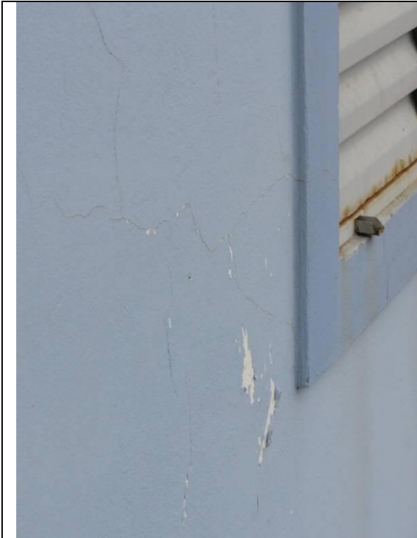
Piso superior – Fissuras no reboco próximo a janela (DSC02352, 21/02/2011, 16:09h)
