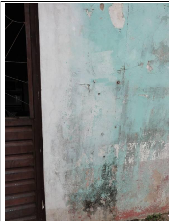
Fachada – Paredes com muito mofo, tinta descascado e fissuras (DSC02615, 21/02/2011, 17:15h)
