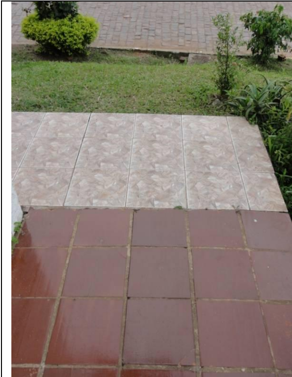
Fachada – Piso cerâmico (DSC02234, 21/02/2011, 15:49h)
