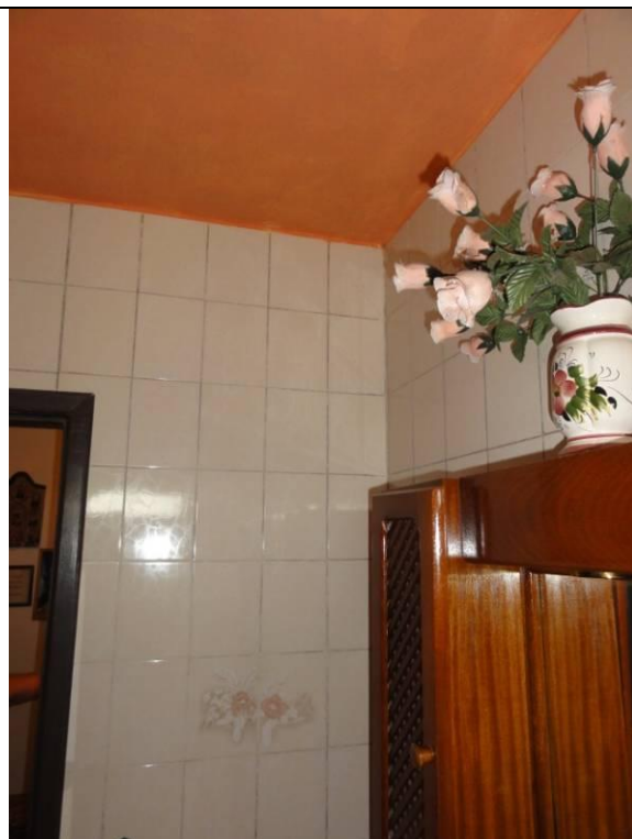
Piso superior – WC 1 – Alguns azulejos soltos (DSC02379, 21/02/2011, 16:15h)
