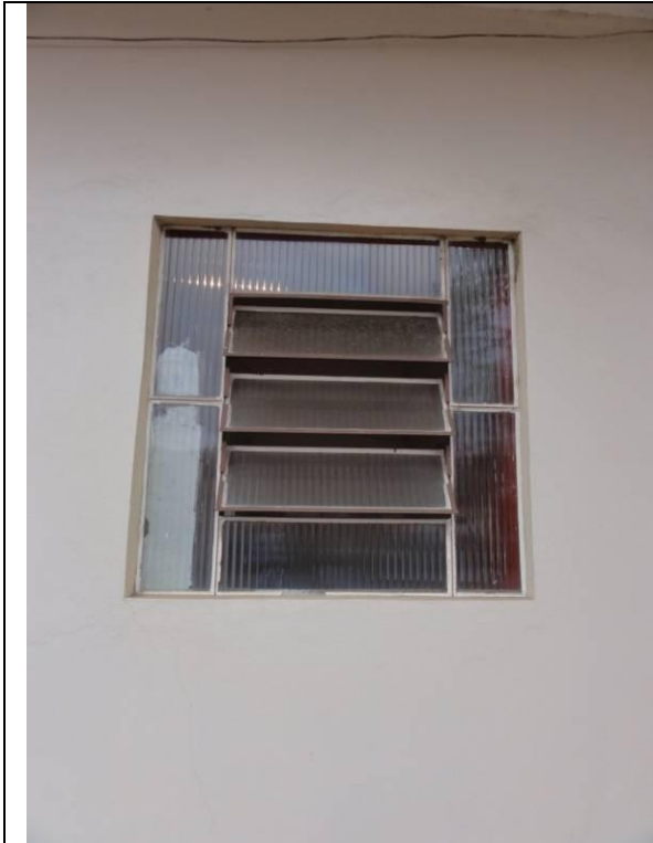
Lateral Direita – Parede D (DSC02785, 22/02/2011, 09:34h)
