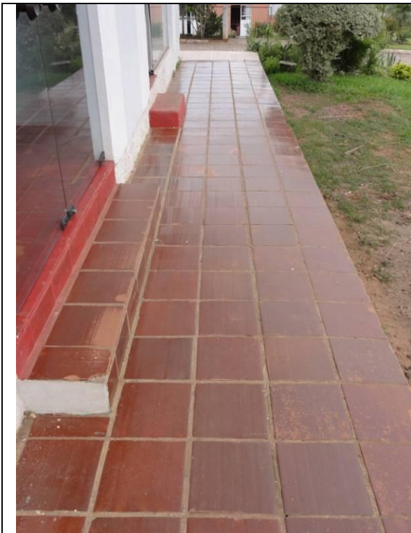
Fachada – Piso cerâmico (DSC02232, 21/02/2011, 15:49h)
