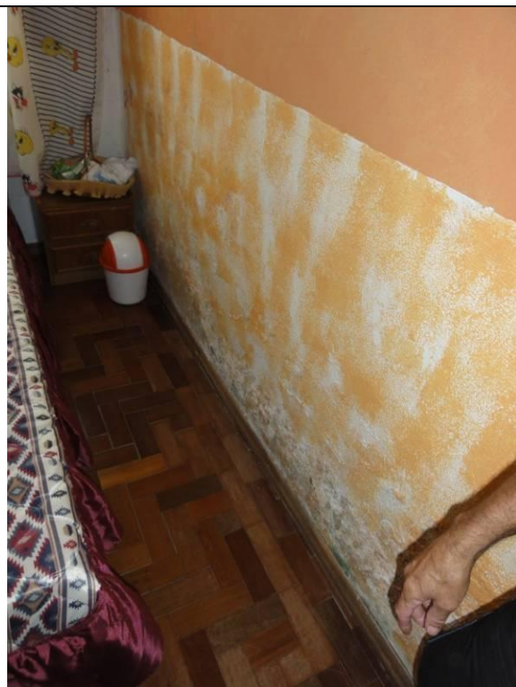
Piso superior - Quarto 3 – Parede ao lado do banheiro com muita umidade, mofo, tinta descascando (DSC02385, 21/02/2011, 16:16h)
