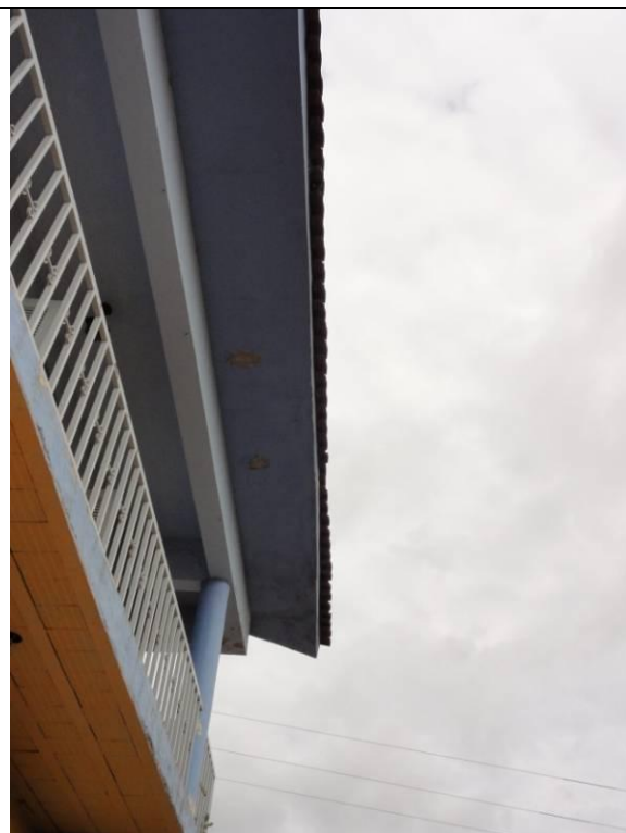
Parte 1 - Marquise (DSC02469, 21/02/2011, 16:39h)
