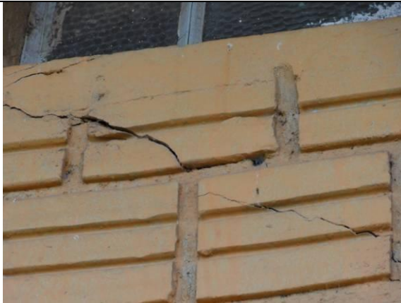
Lateral Esquerda – parede B – Rachaduras no tijolo (DSC02242, 21/02/2011, 15:50h)
