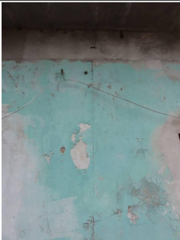
Fachada – Paredes com muito mofo, tinta descascado e fissuras (DSC02617, 21/02/2011, 17:15h)
