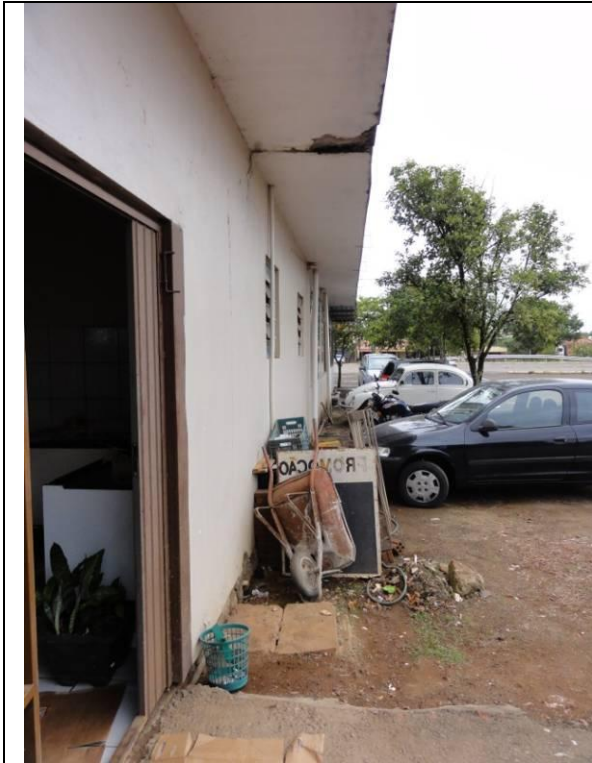
Lateral Direita – Parede D (DSC02799, 22/02/2011, 09:36h)
