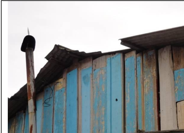
Fundos – Telhado quebrado (DSC02746, 22/02/2011, 09:22h)
