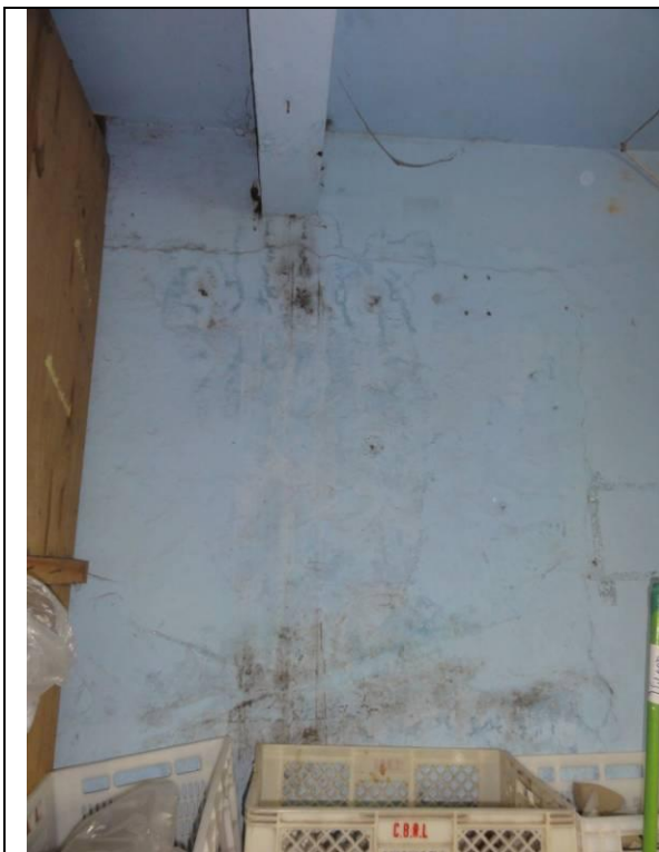
Piso Inferior – Fábrica – Parede com bastante umidade e mofo (DSC03103, 22/02/2011, 11:26h)
