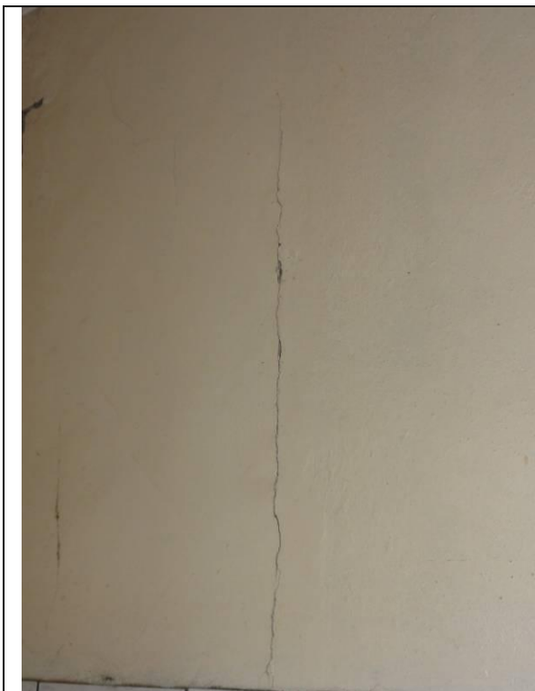
Piso inferior – Cozinha – Rachadura na parede 24 (DSC02865, 22/02/2011, 09:51h)
