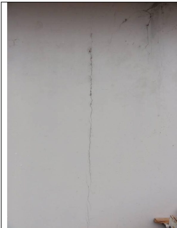
Lateral Direita – Parede D – Fissura no reboco (DSC02795, 22/02/2011, 09:35h)
