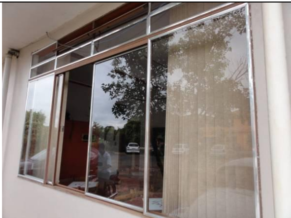
Lateral Direita – Parede D (DSC02779, 22/02/2011, 09:33h)
