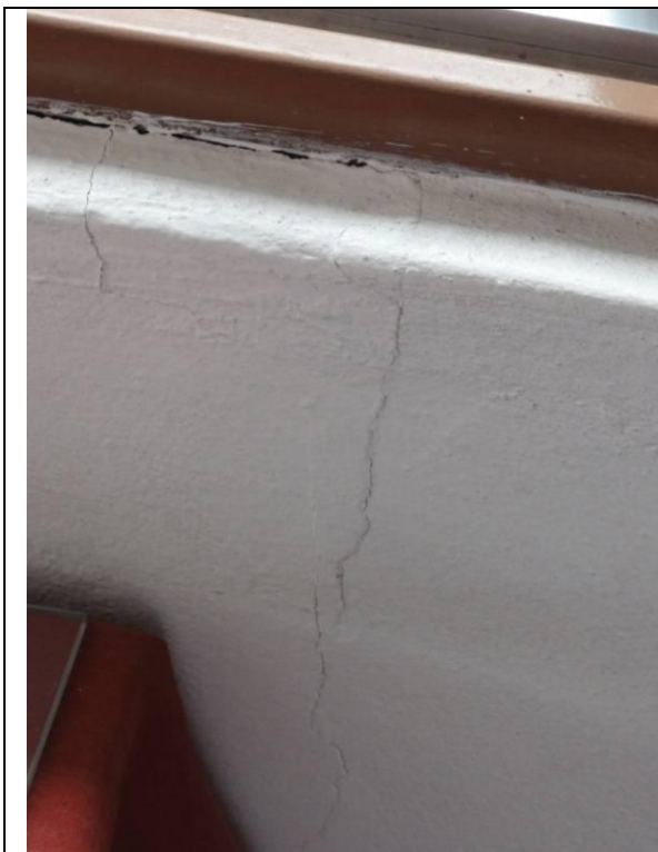
Piso inferior – Hall – Fissuras no reboco próximo a janela (DSC02815, 22/02/2011, 09:40h)
