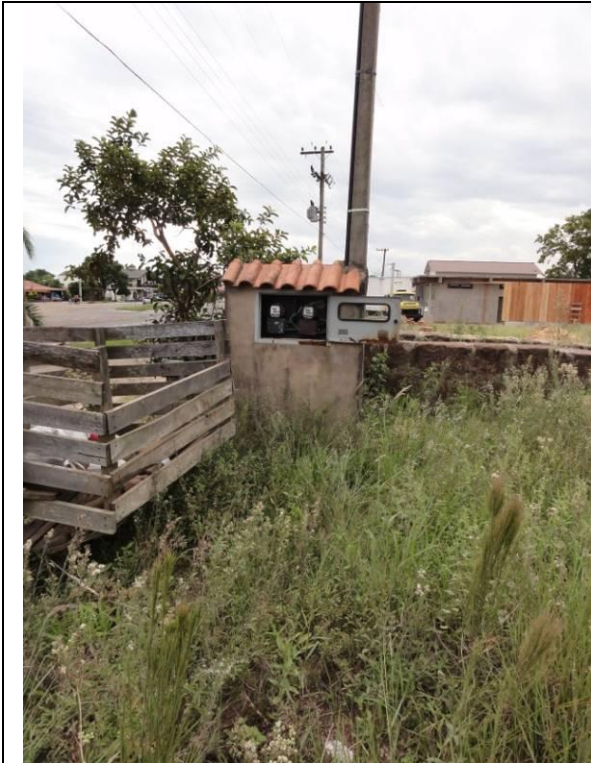
Fachada – Muro com caixa de luz (DSC02597, 21/02/2011, 17:12h)
