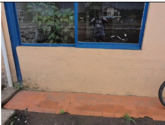
Fachada – Paredes com algumas fissuras no reboco (DSC03024, 22/02/2011, 10:55h)
