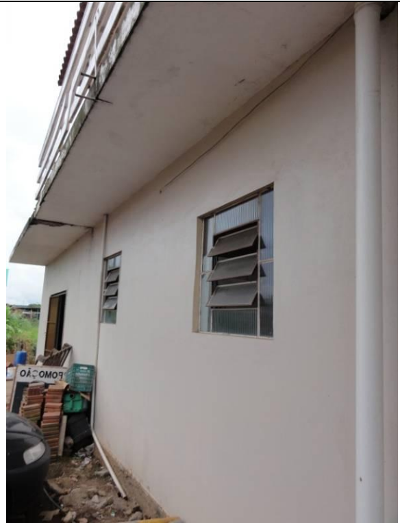
Lateral Direita – Parede D (DSC02784, 22/02/2011, 09:34h)
