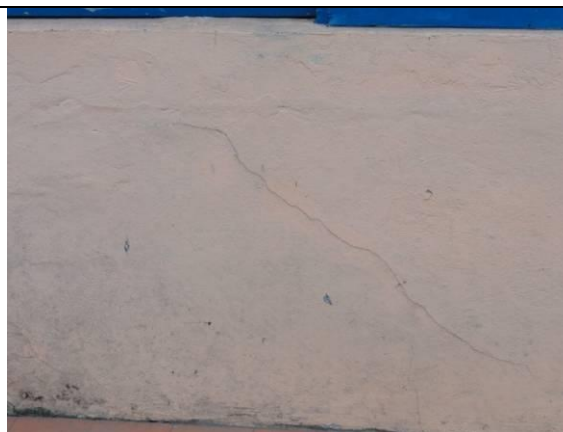
Fachada – Paredes com algumas fissuras no reboco (DSC03025, 22/02/2011, 10:56h)
