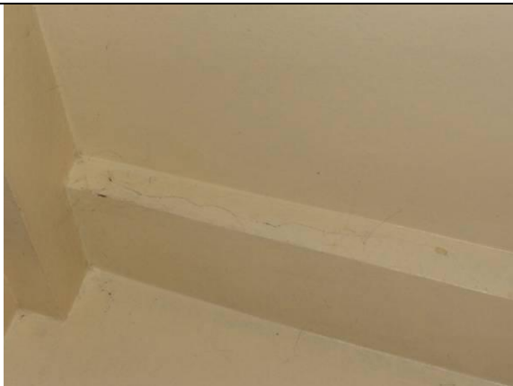
Piso inferior – Sala 1 – Teto com algumas fissuras (DSC02847, 22/02/2011, 09:47h)
