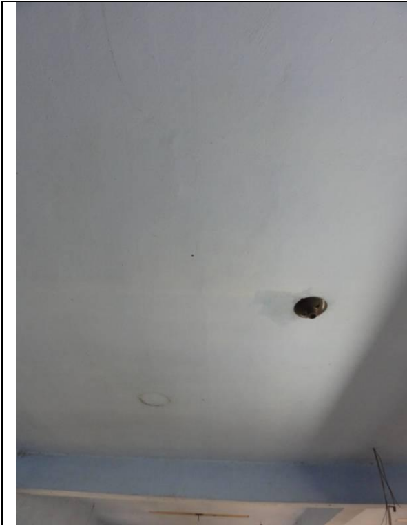
Piso Inferior – Fábrica – Teto com bastante umidade e mofo (DSC03107, 22/02/2011, 11:27h)
