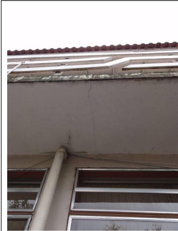
Marquise – Fissura no reboco (DSC02777, 22/02/2011, 09:32h)
