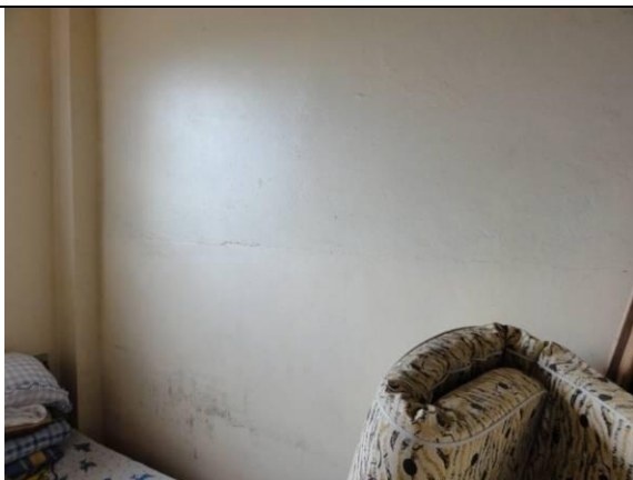
Piso inferior – Sala 1 - Paredes com algumas fissuras no reboco (DSC02837, 22/02/2011, 09:46h)
