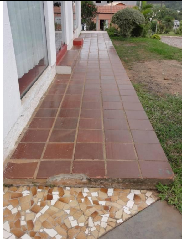
Fachada – Piso cerâmico (DSC02231, 21/02/2011, 15:49h)
