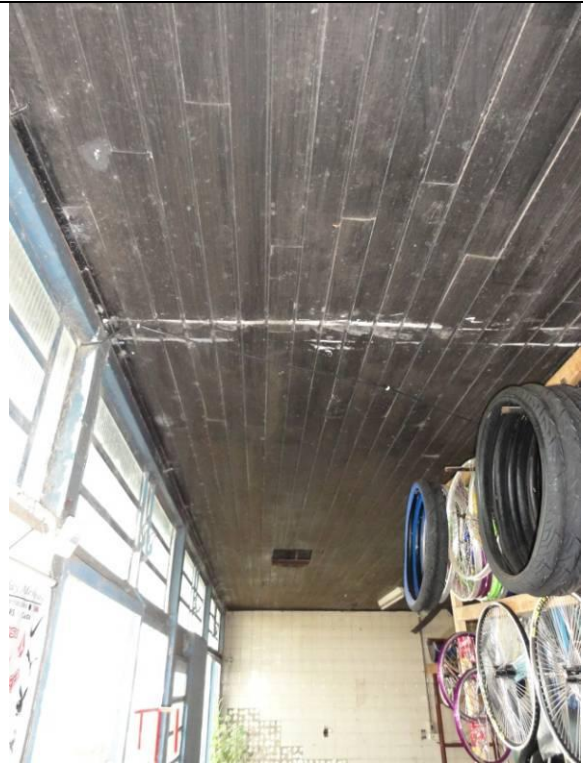
Piso Inferior – Borracharia – Teto com forro de madeira com algumas partes quebradas e outras cedendo (DSC03051, 22/02/2011, 10:59h)
