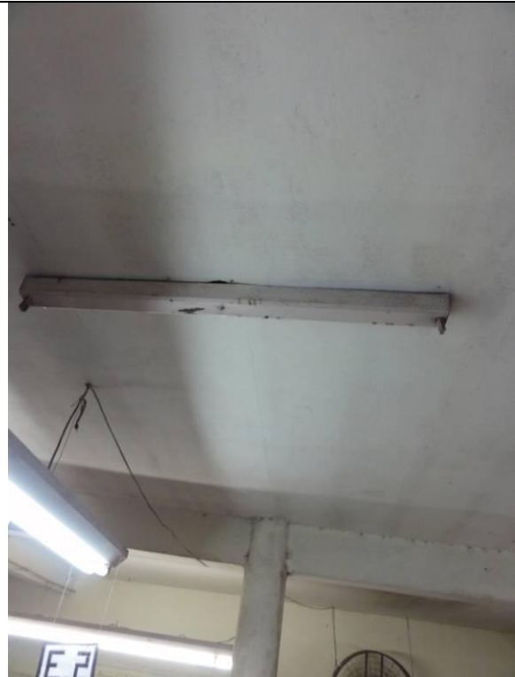
Piso Inferior – Fábrica - Teto (DSC03154, 22/02/2011, 16:40h)
