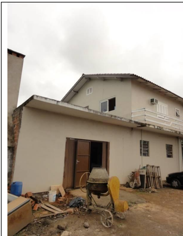
Lateral Direita – Parede D – Portão (DSC02801, 22/02/2011, 09:37h)
