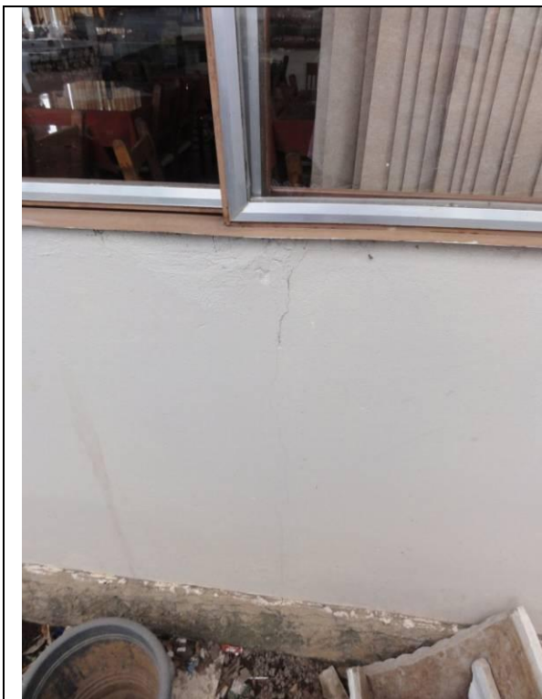
Fachada – Parede A – Fissura no reboco próximo a janela (DSC02773, 22/02/2011, 09:32h)
