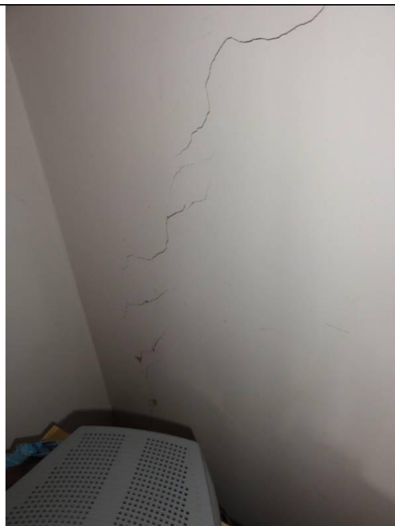
Piso superior - Sala 2 – Rachaduras próximas a janela (DSC02399, 21/02/2011, 16:20h)
