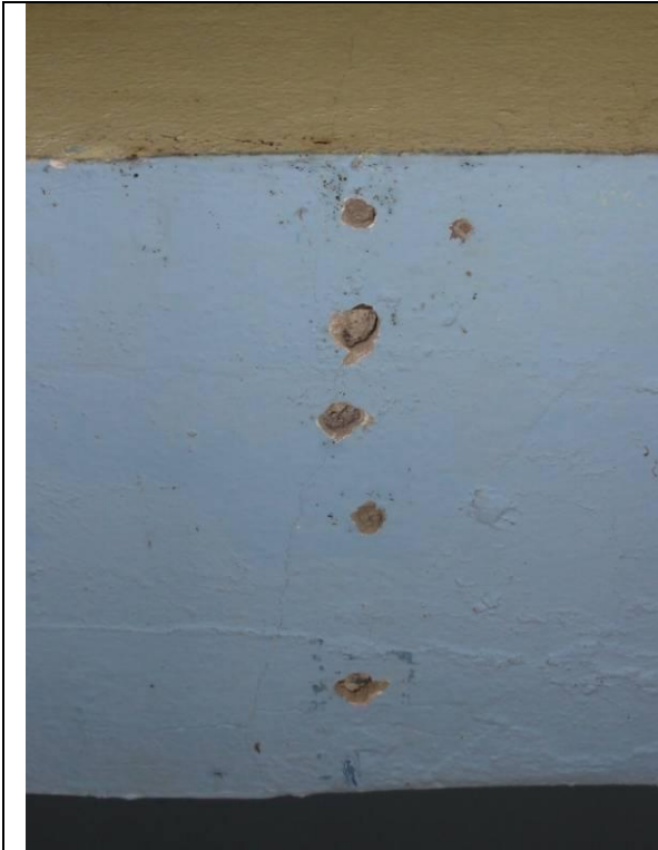
Piso Inferior – Fábrica - Teto (DSC03149, 22/02/2011, 16:39h)
