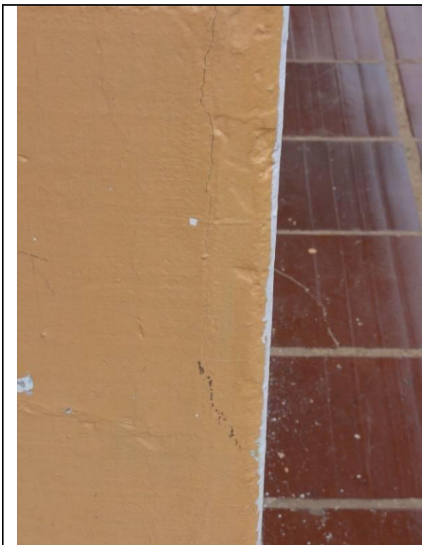
Lateral Direto – Parede D – Fissuras no reboco (DSC02280, 21/02/2011, 15:56h)
