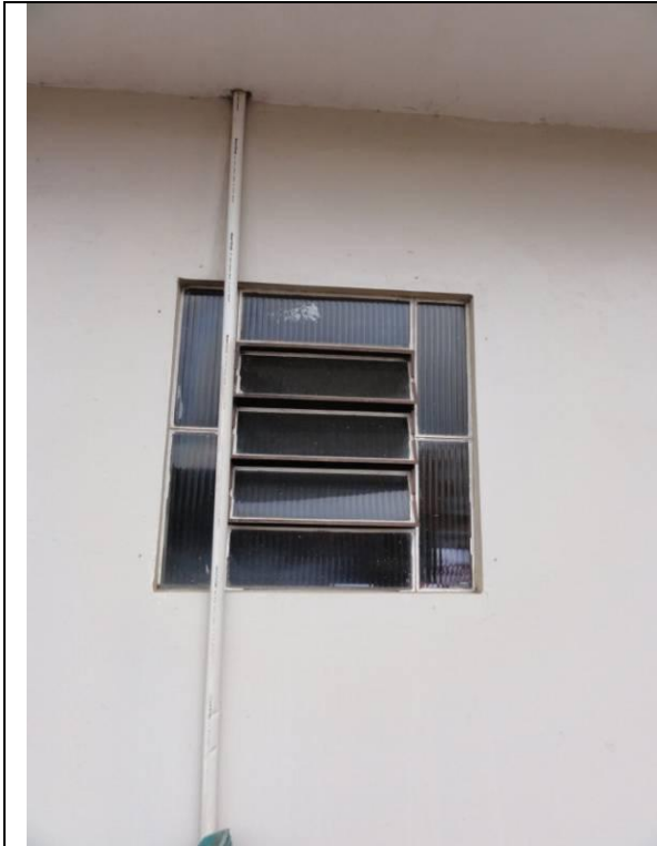
Lateral Direita – Parede D (DSC02787, 22/02/2011, 09:34h)
