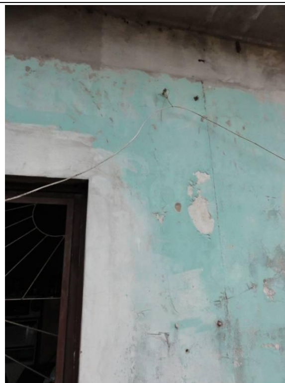
Fachada – Paredes com muito mofo, tinta descascado e fissuras (DSC02616, 21/02/2011, 17:15h)
