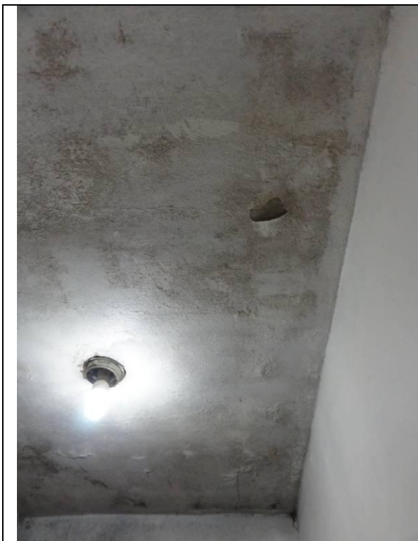
Parte 2 – Piso inferior – Lanchonete – Teto em geral com muita umidade e mofo (DSC02541, 21/02/2011, 16:53h)
