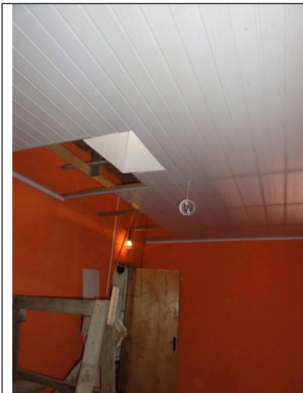
Piso Inferior – Salão 1 – Quarto 1 – Teto (DSC03510, 23/02/2011, 09:25h)
