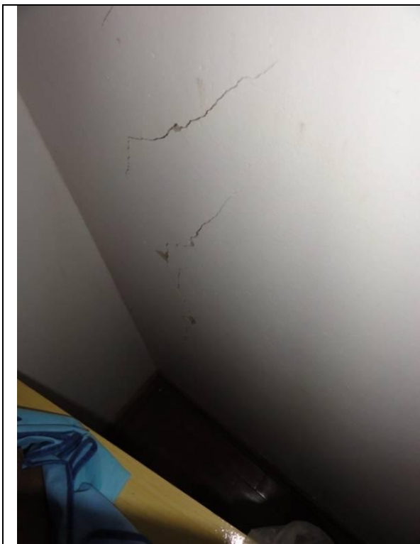
Piso superior - Sala 2 – Rachaduras próximas a janela (DSC02400, 21/02/2011, 16:20h)
