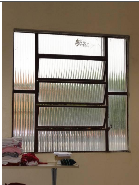
Piso inferior – Sala 1 - Janela com vidro quebrado (DSC02836, 22/02/2011, 09:45h)
