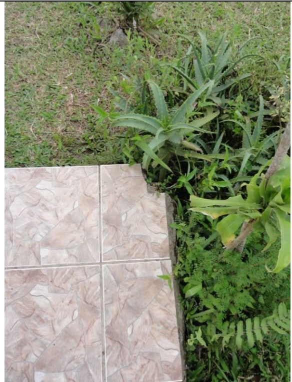
Fachada – Piso cerâmico quebrado (DSC02235, 21/02/2011, 15:49h)
