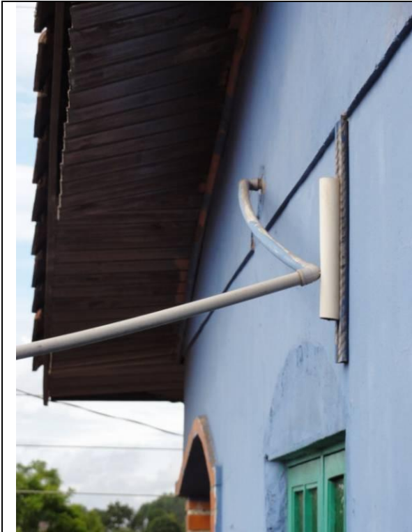
Piso Superior – Sacada – Marquise com forro de madeira cedendo (DSC03588, 23/02/2011, 09:38h)
