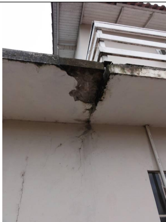
Lateral Direita – Parede D – Marquise com reboco descascando, umidade e rachadura (DSC02792, 22/02/2011, 09:35h)
