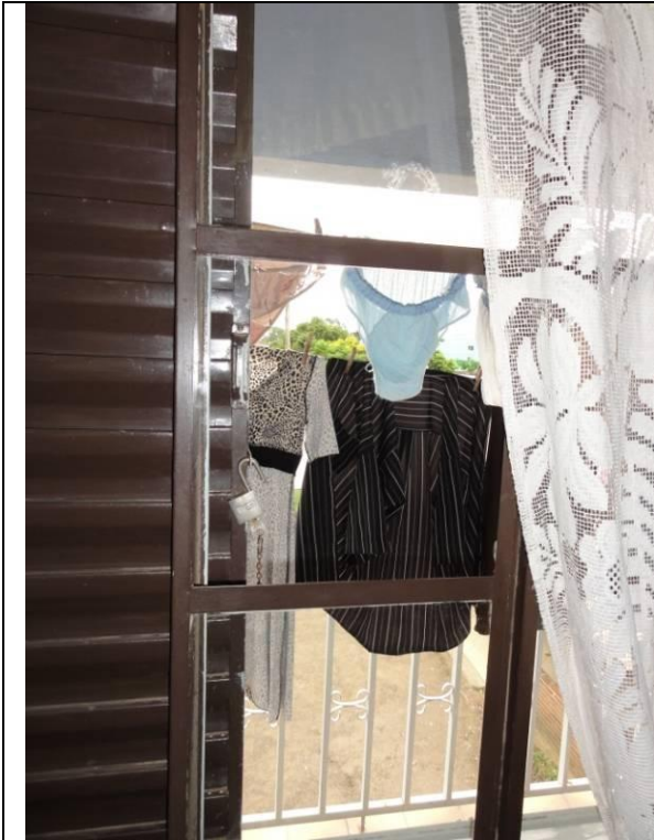
Piso superior – Quarto 1 – Janela com vidro quebrado (DSC02358, 21/02/2011, 16:10h)
