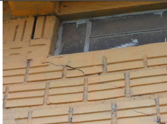
Lateral Esquerda – parede B – Rachaduras no tijolo (DSC02243, 21/02/2011, 15:50h)
