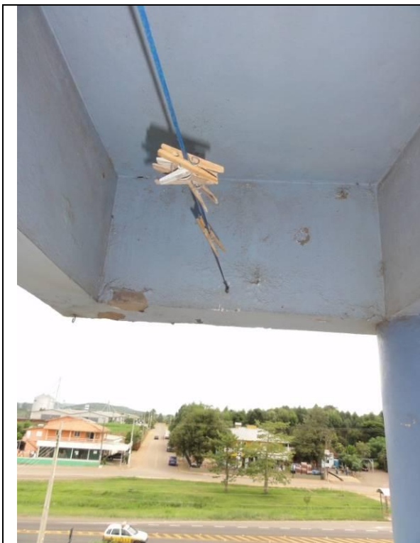
Piso superior –Sacada – Marquise – Umidade com reboco e tinta descascando (DSC02356, 21/02/2011, 16:09h)
