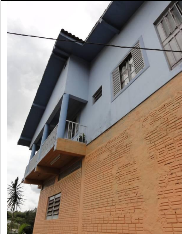
Lateral Esquerda – parede B (DSC02252, 21/02/2011, 15:51h)
