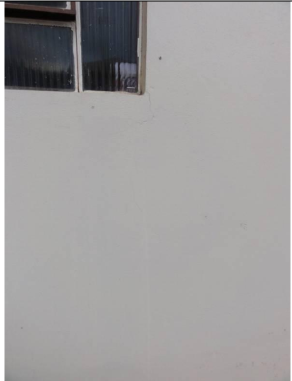
Lateral Direita – Parede D (DSC02788, 22/02/2011, 09:34h)
