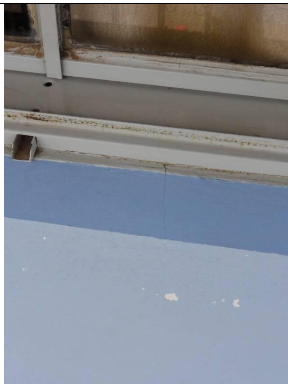
Piso superior – Sacada – Fissuras no reboco próximo a janela (DSC02343, 21/02/2011, 16:07h)
