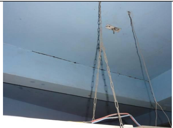
Piso Inferior – Fábrica – Teto (DSC03122, 22/02/2011, 11:30h)
