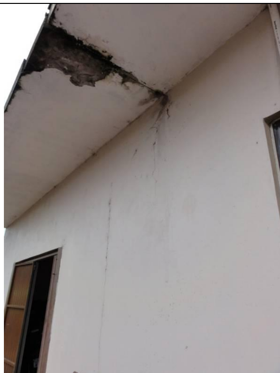
Lateral Direita – Parede D – Marquise com reboco descascando (DSC02790, 22/02/2011, 09:35h)
