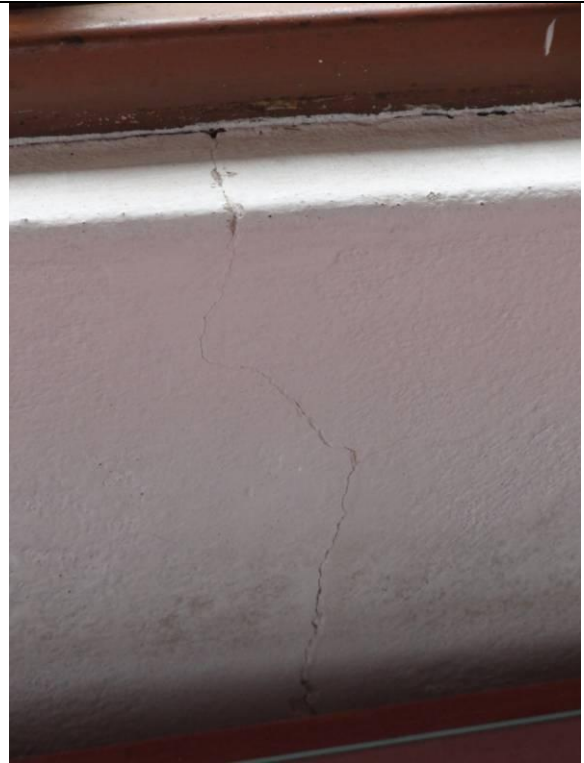
Piso inferior – Hall – Fissuras no reboco próximo a janela (DSC02818, 22/02/2011, 09:41h)
