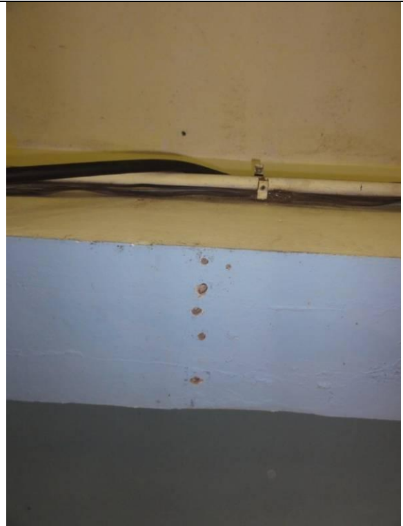
Piso Inferior – Fábrica - Teto (DSC03150, 22/02/2011, 16:40h)
