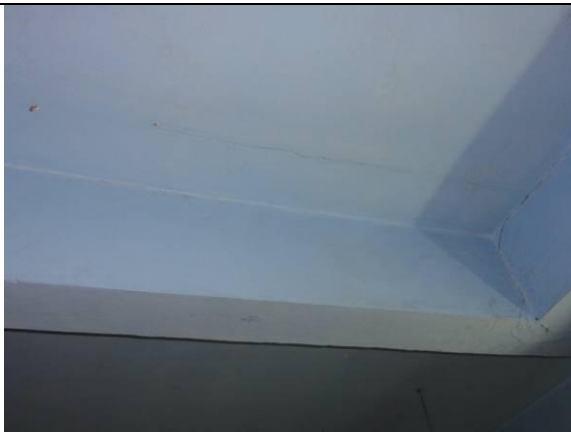
Piso Inferior – Fábrica – Teto (DSC03121, 22/02/2011, 11:29h)
