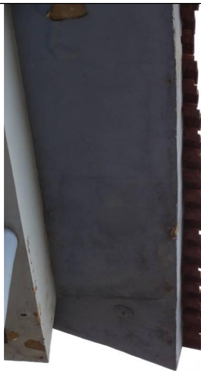
Parte 1 - Marquise (DSC02471, 21/02/2011, 16:39h)
