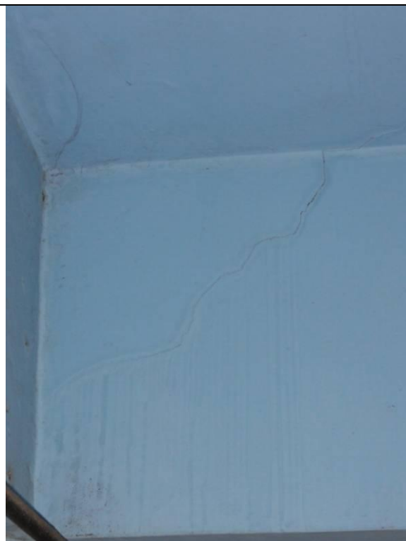
Piso Inferior – Fábrica – Teto com bastante umidade e mofo (DSC03112, 22/02/2011, 11:28h)
