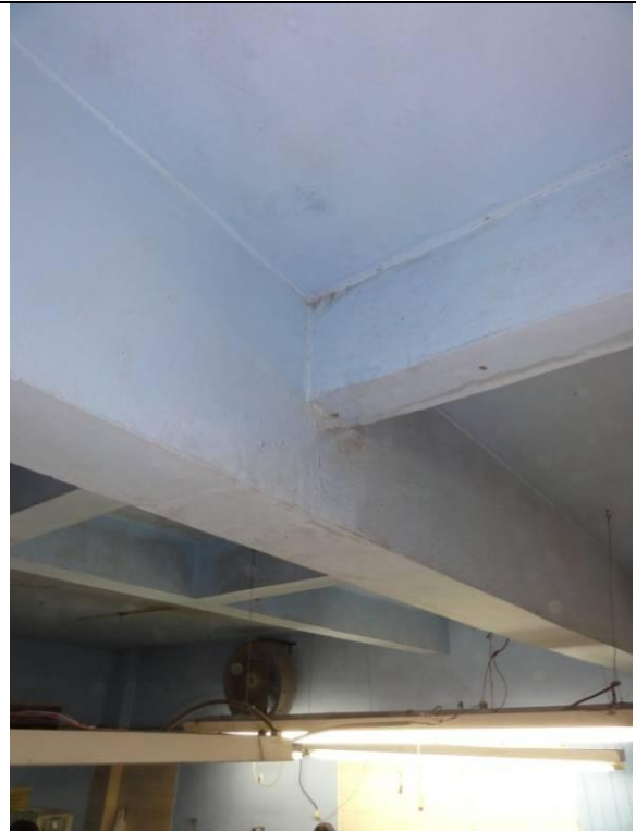
Piso Inferior – Fábrica – Teto com bastante umidade e mofo (DSC03108, 22/02/2011, 11:27h)
