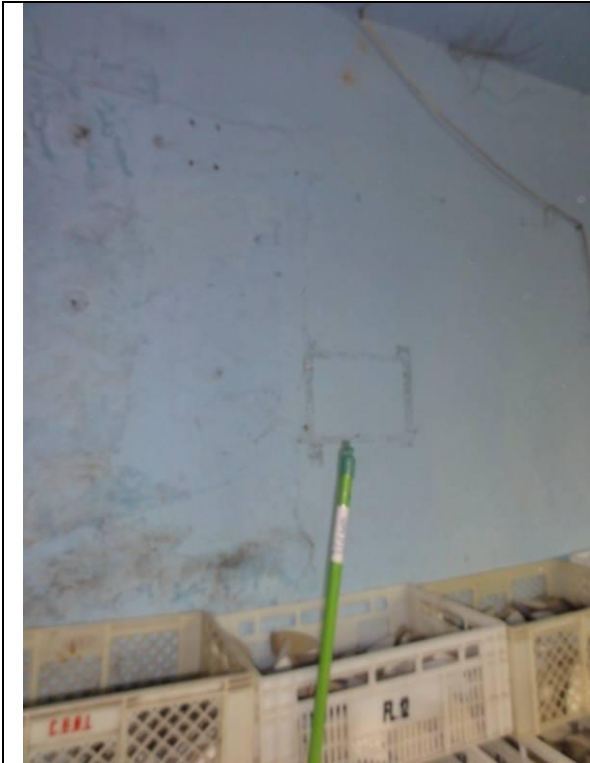
Piso Inferior – Fábrica – Parede com bastante umidade e mofo (DSC03105, 22/02/2011, 11:26h)
