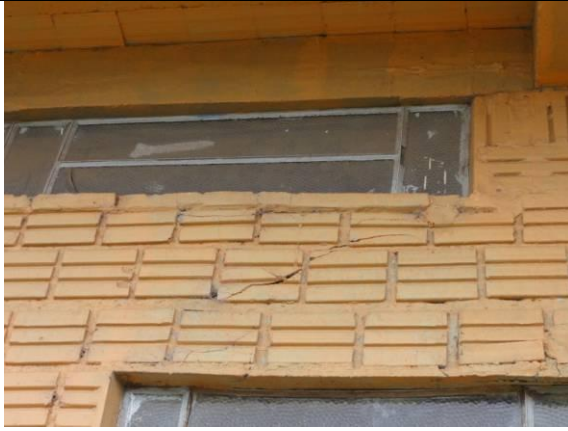
Lateral Esquerda – parede B – Rachaduras no tijolo (DSC02240, 21/02/2011, 15:50h)
