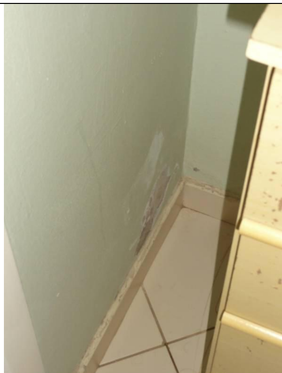
Piso superior – Quarto 3 – Reboco descascado (DSC03001, 22/02/2011, 10:25h)
