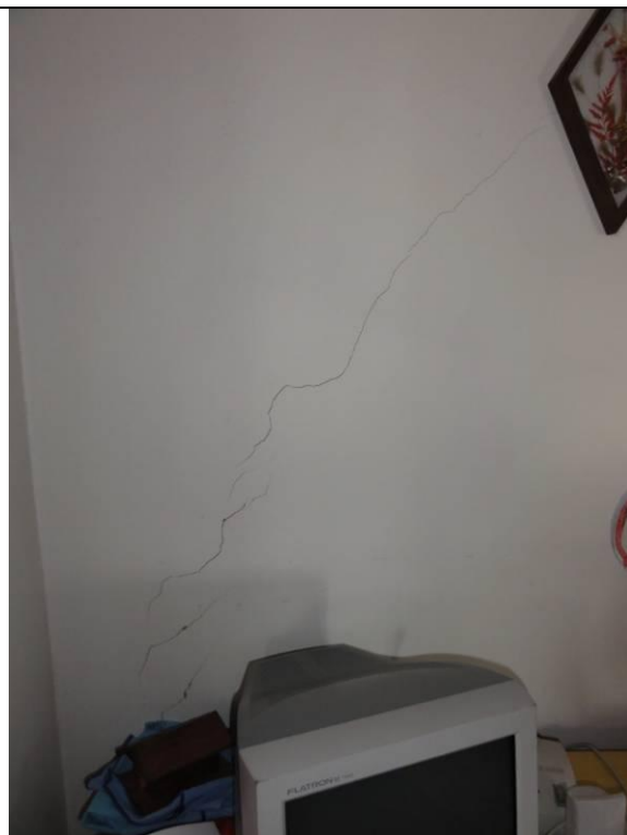
Piso superior - Sala 2 – Rachaduras próximas a janela (DSC02396, 21/02/2011, 16:19h)
