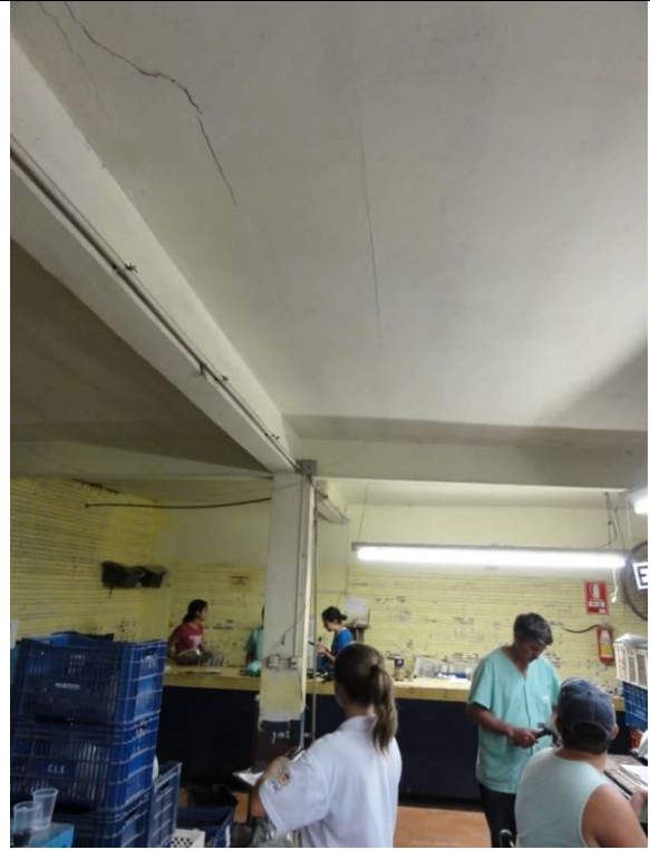
Piso Inferior – Fábrica - Teto (DSC03165, 22/02/2011, 16:42h)
