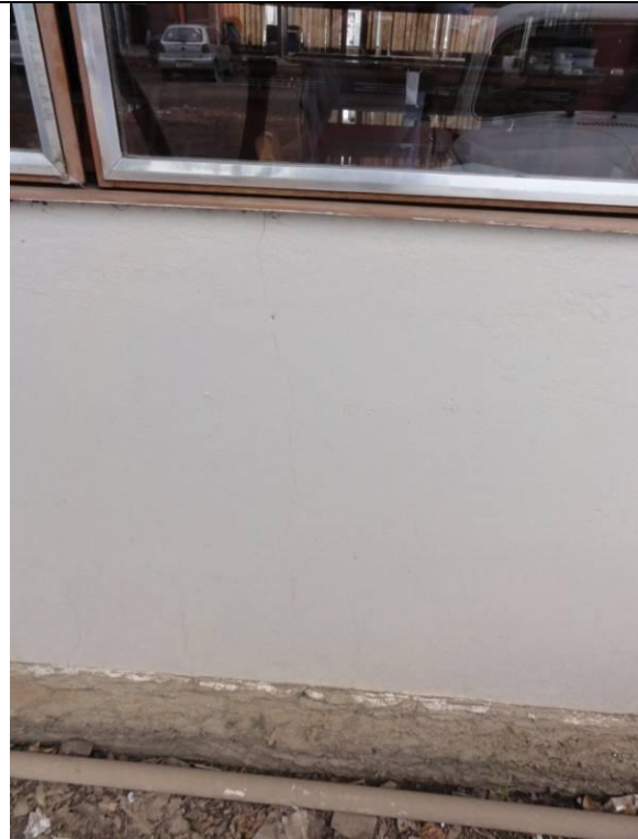
Lateral Direita – Parede D (DSC02782, 22/02/2011, 09:33h)
