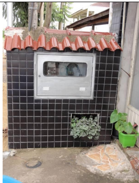
Fachada – Muro com caixa de luz (DSC03481, 23/02/2011, 09:20h)
