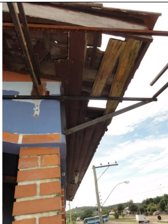
Piso Superior – Sacada – Marquise – Forro de madeira com partes caindo (DSC03537, 23/02/2011, 09:32h)
