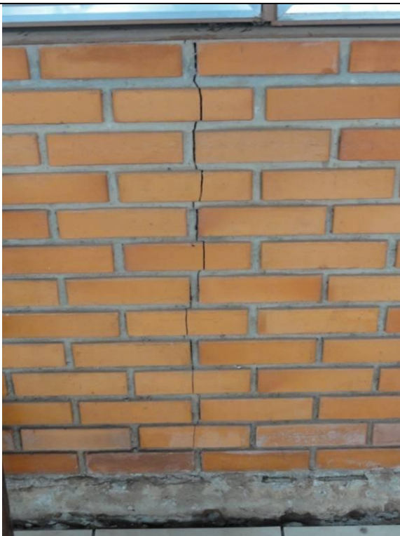
Piso inferior – Hall – Parede 2 de tijolo a vista com rachadura no tijolo (DSC02809, 22/02/2011, 09:39h)
