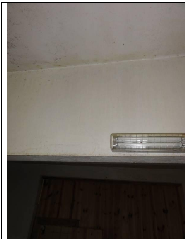
Parte 2 – Piso inferior – Lanchonete – Teto em geral com muita umidade e mofo (DSC02529, 21/02/2011, 16:50h)
