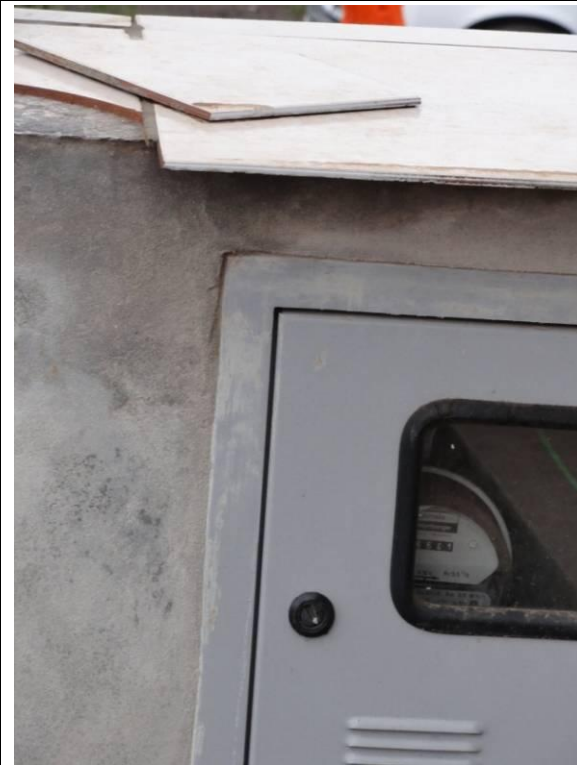
Fachada - Muro com caixa de luz (DSC02727, 22/02/2011, 09:18h)
