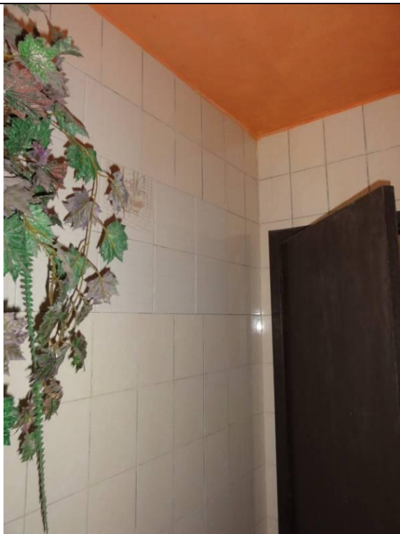
Piso superior – WC 1 – Alguns azulejos soltos (DSC02380, 21/02/2011, 16:15h)
