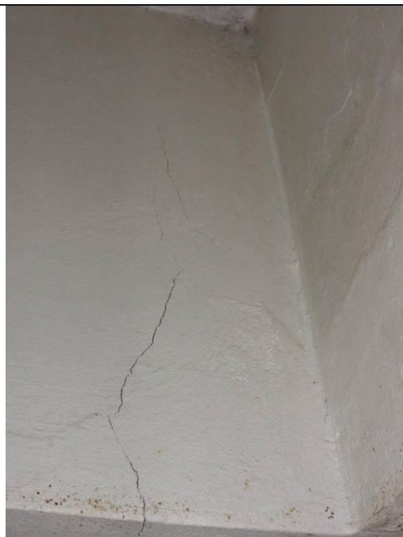
Parte 2 – Piso inferior – Lanchonete – Teto em geral com muita umidade e mofo (DSC02540, 21/02/2011, 16:53h)
