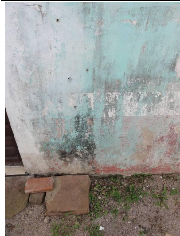
Fachada – Paredes com muito mofo, tinta descascando e fissuras (DSC02619, 21/02/2011, 17:15h)
