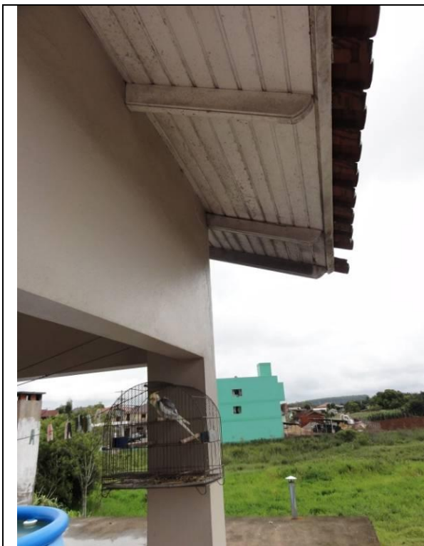
Piso superior - Sacada - Marquise (DSC02906, 22/02/2011, 10:07h)
