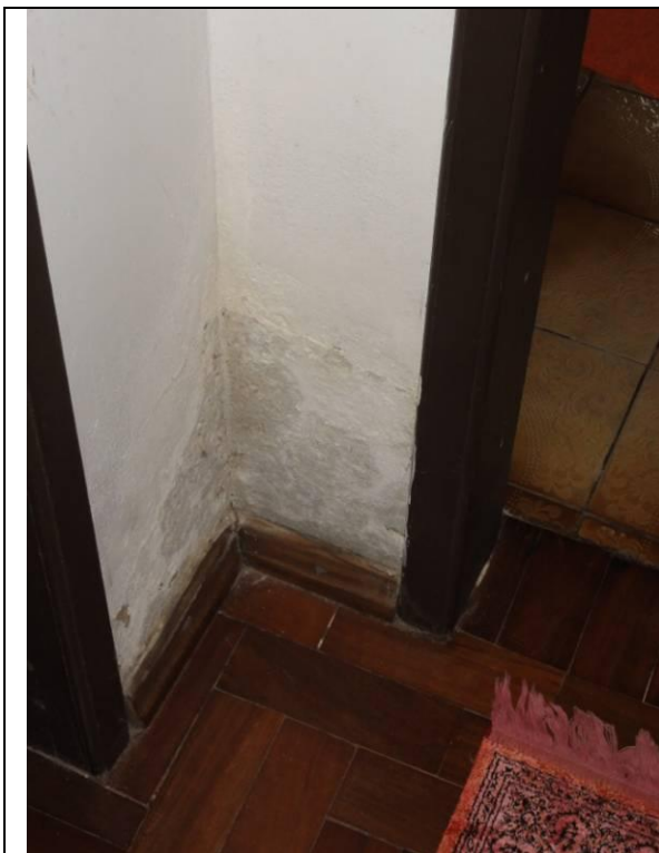
Piso superior – Hall – Paredes com umidade, mofo e algumas fissuras no reboco (DSC02372, 21/02/2011, 16:14h)
