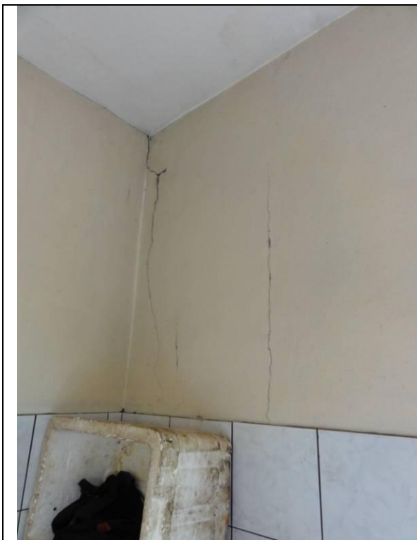
Piso inferior – Cozinha – Rachadura na parede 24 (DSC02863, 22/02/2011, 09:51h)
