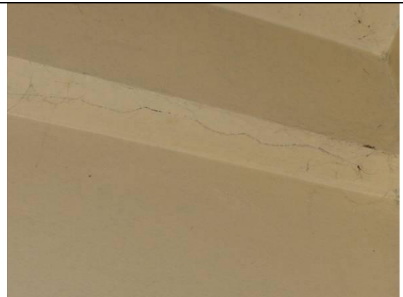
Piso inferior – Sala 1 – Teto com algumas fissuras (DSC02848, 22/02/2011, 09:47h)
