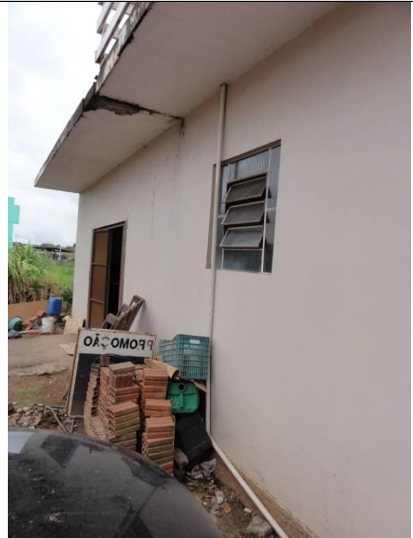
Lateral Direita – Parede D (DSC02786, 22/02/2011, 09:34h)
