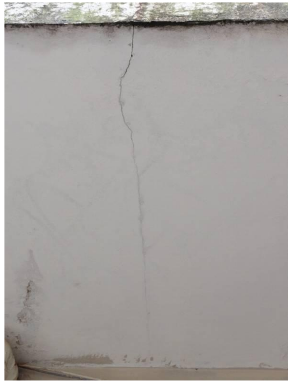
Marquise – Fissura no reboco (DSC02778, 22/02/2011, 09:32h)
