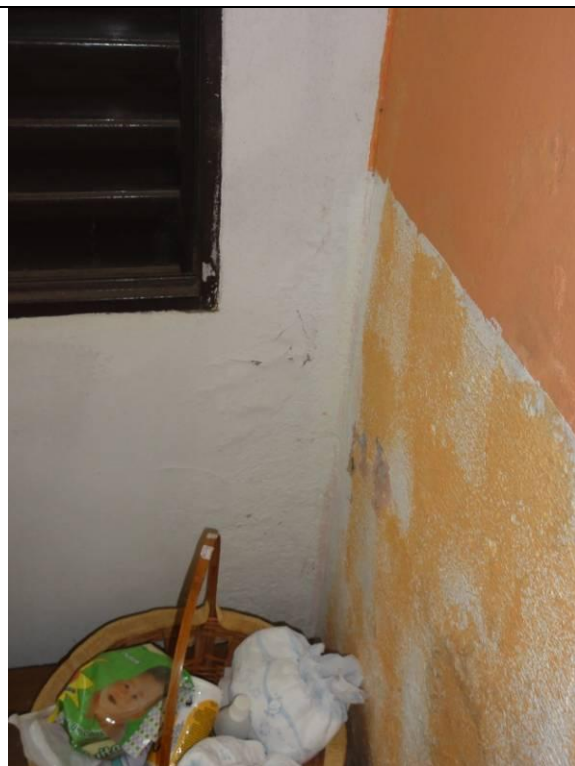
Piso superior - Quarto 3 – Parede ao lado do banheiro com muita umidade, mofo, tinta descascando (DSC02389, 21/02/2011, 16:17h)
