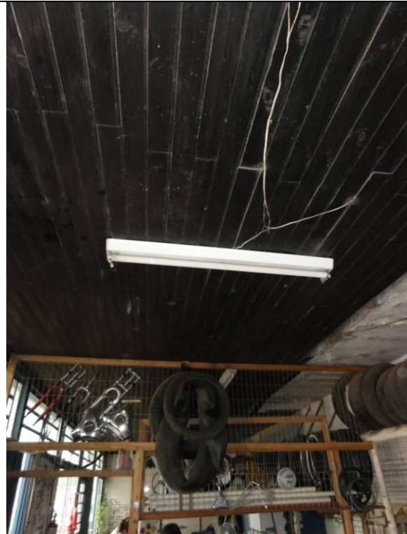
Piso Inferior – Borracharia – Teto com forro de madeira com algumas partes quebradas e cedendo (DSC03049, 22/02/2011, 10:59h)
