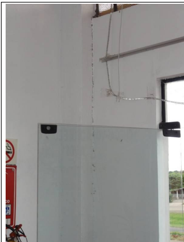
Parte 1 – Piso inferior – Igreja – Fissura no reboco (DSC02692, 21/02/2011, 17:45h)
