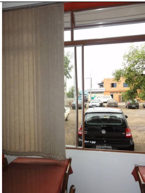
Piso inferior – Hall – Fissuras no reboco próximo a janela (DSC02816, 22/02/2011, 09:40h)
