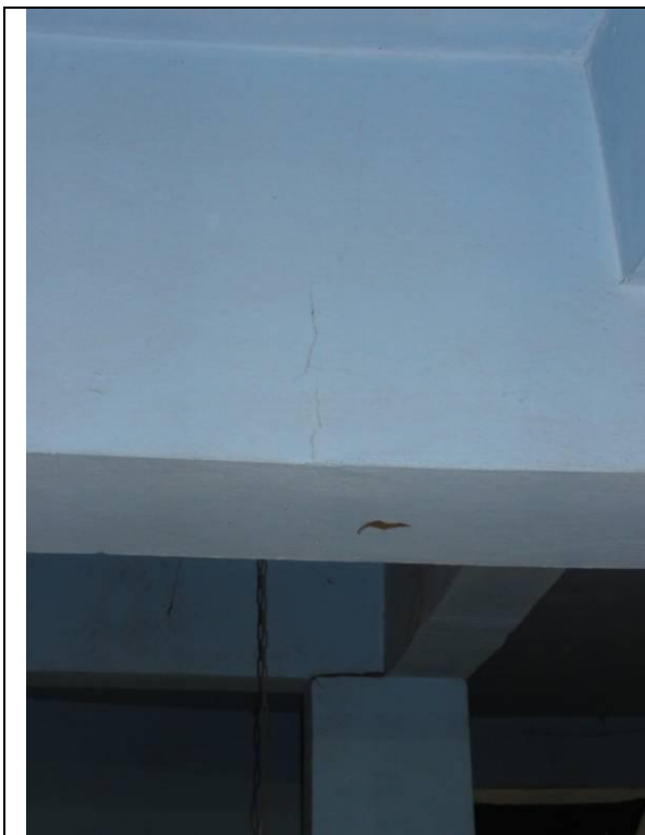
Piso Inferior – Fábrica – Teto (DSC03117, 22/02/2011, 11:29h)
