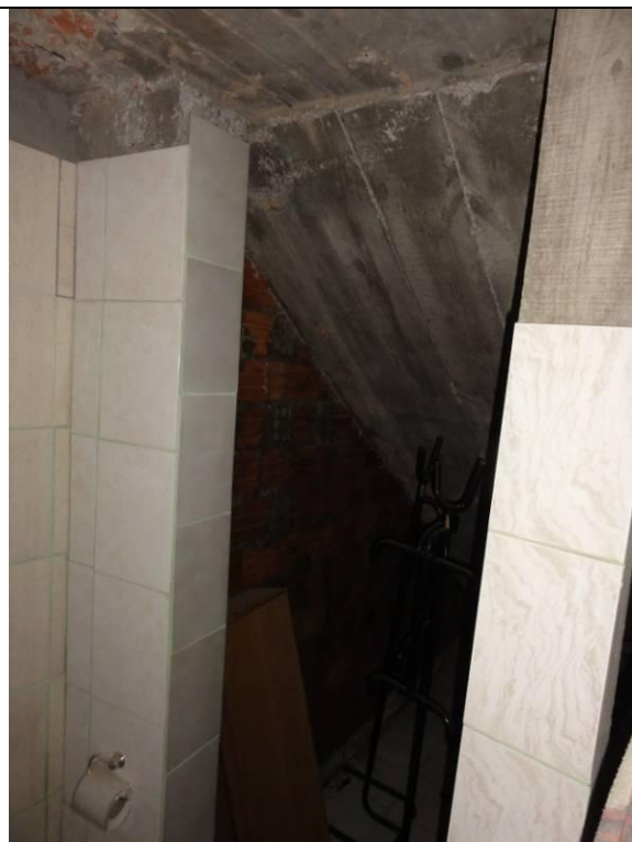
Piso Inferior – Salão 1 – WC (DSC03505, 23/02/2011, 09:24h)
