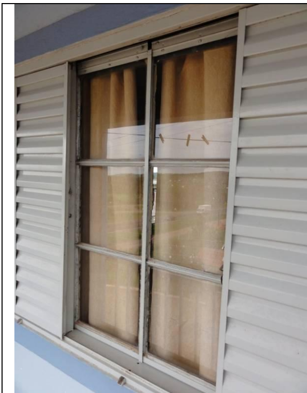
Piso superior – Sacada – Fissuras no reboco próximo a janela (DSC02342, 21/02/2011, 16:07h)
