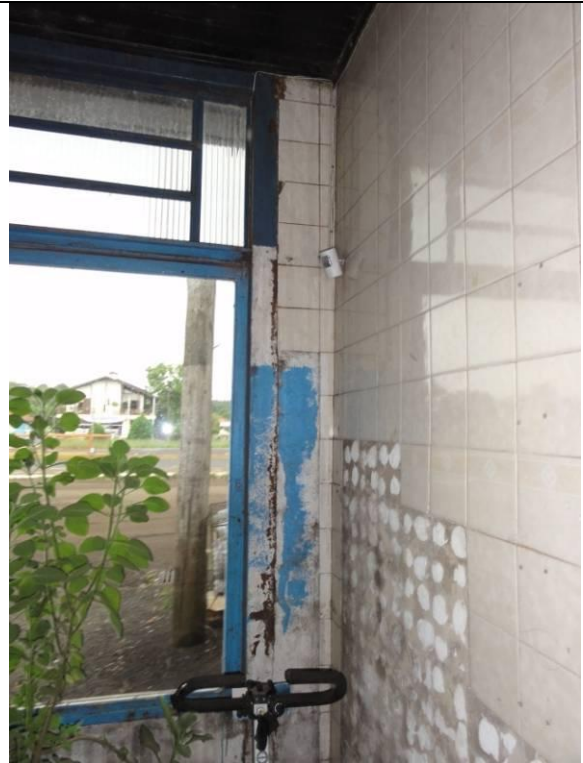
Piso Inferior – Borracharia – Parede 4 com azulejos soltos e faltantes (DSC03063, 22/02/2011, 11:01h)
