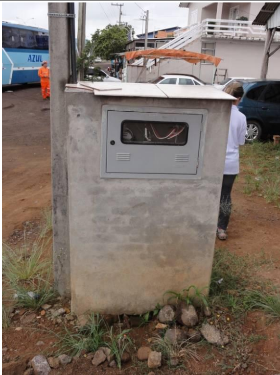
Fachada - Muro com caixa de luz (DSC02726, 22/02/2011, 09:18h)
