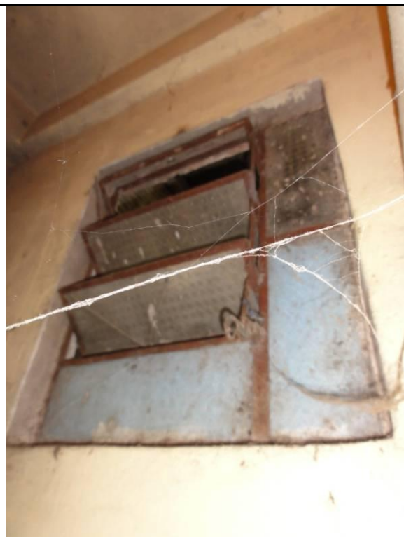
Piso Inferior – Fábrica – Parte 2 - WC – Vidros quebrados (DSC03200, 22/02/2011, 16:50h)
