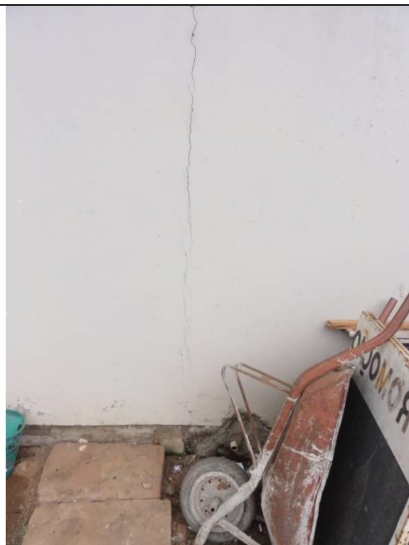
Lateral Direita – Parede D – Fissura no reboco (DSC02796, 22/02/2011, 09:36h)
