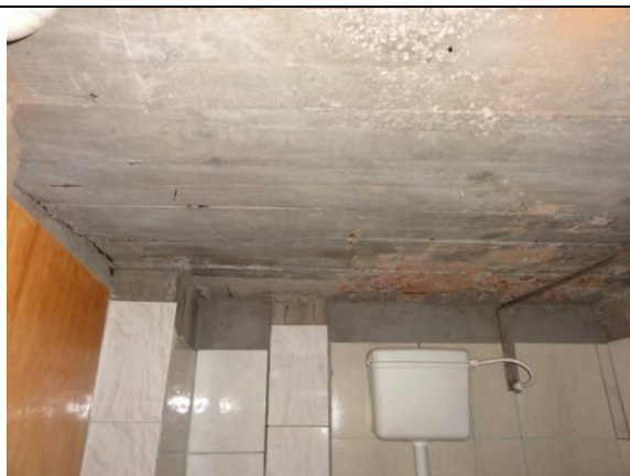
Piso Inferior – Salão 1 – WC (DSC03506, 23/02/2011, 09:24h)
