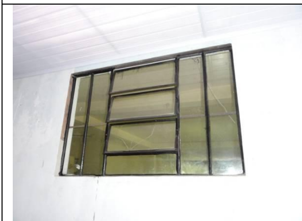
Piso Inferior – Salão 1 – Janela com vidro rachado (DSC03500, 23/02/2011, 09:23h)
