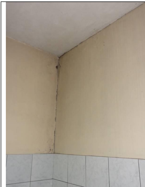
Piso inferior – Cozinha – Rachadura entre as paredes 20 e 21 (DSC02853, 22/02/2011, 09:49h)
