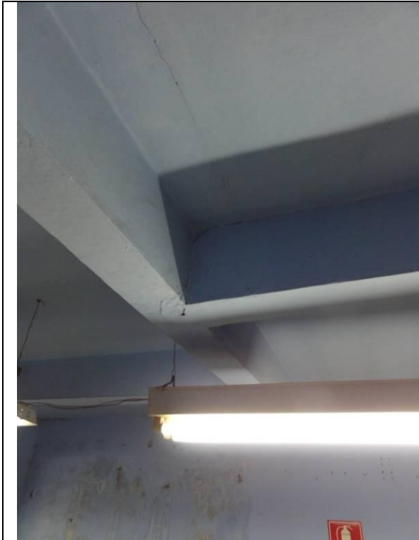
Piso Inferior – Fábrica – Teto (DSC03119, 22/02/2011, 11:29h)
