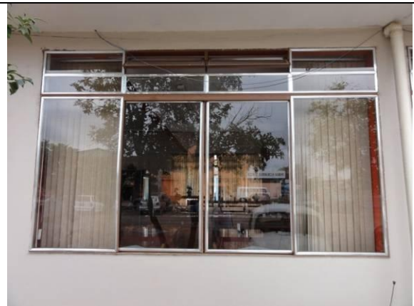
Lateral Direita – Parede D (DSC02780, 22/02/2011, 09:33h)
