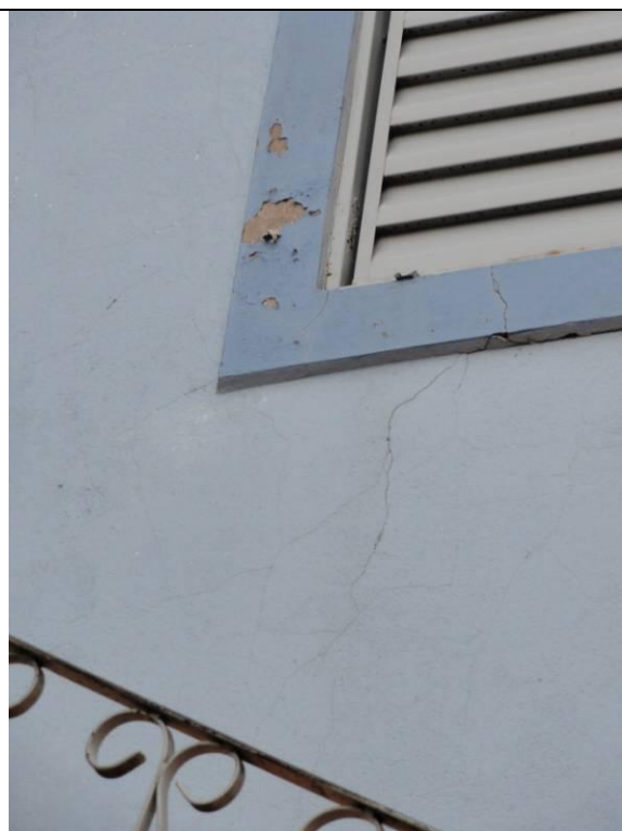
Lateral Direto – Parede D – Fissuras no reboco próximo a janela (DSC02291, 21/02/2011, 15:58h)
