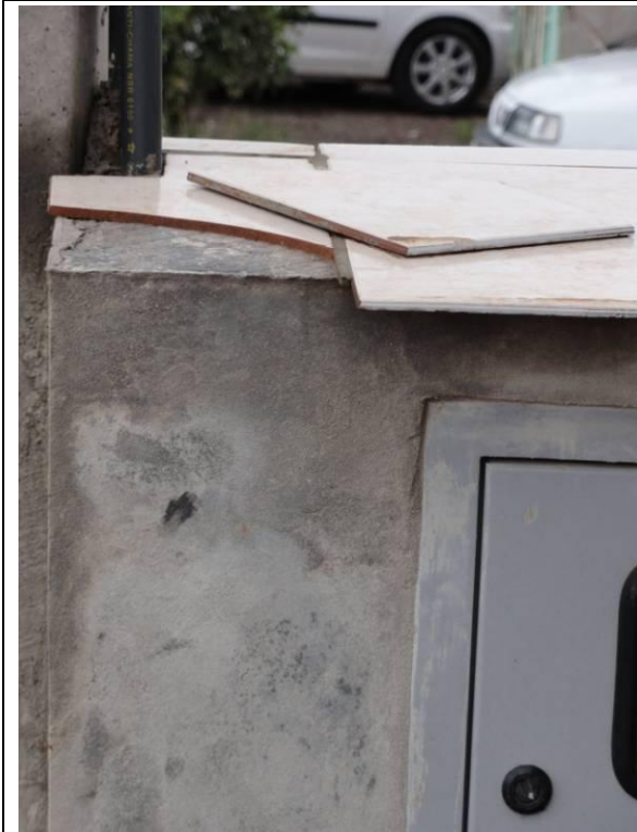
Fachada - Muro com caixa de luz (DSC02728, 22/02/2011, 09:19h)
