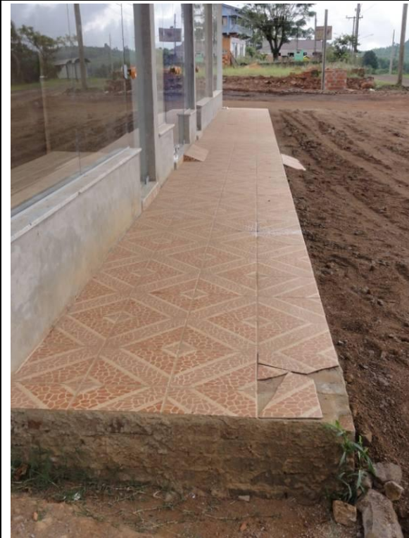
Fachada – Calçada com alguns pisos quebrados (DSC02738, 22/02/2011, 09:20h)
