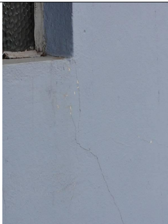
Piso superior – Fissuras no reboco próximo a janela (DSC02351, 21/02/2011, 16:08h)
