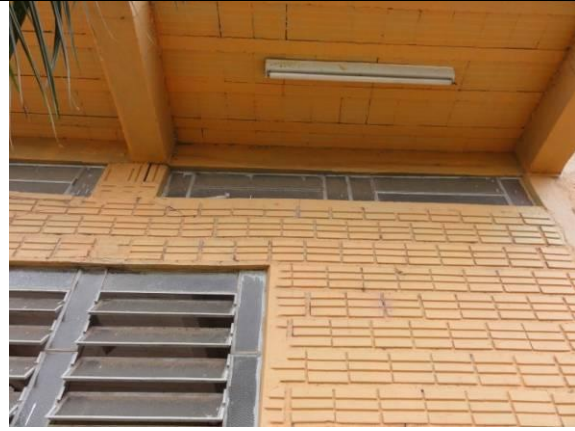
Lateral Esquerda – parede B – Rachaduras no tijolo (DSC02241, 21/02/2011, 15:50h)
