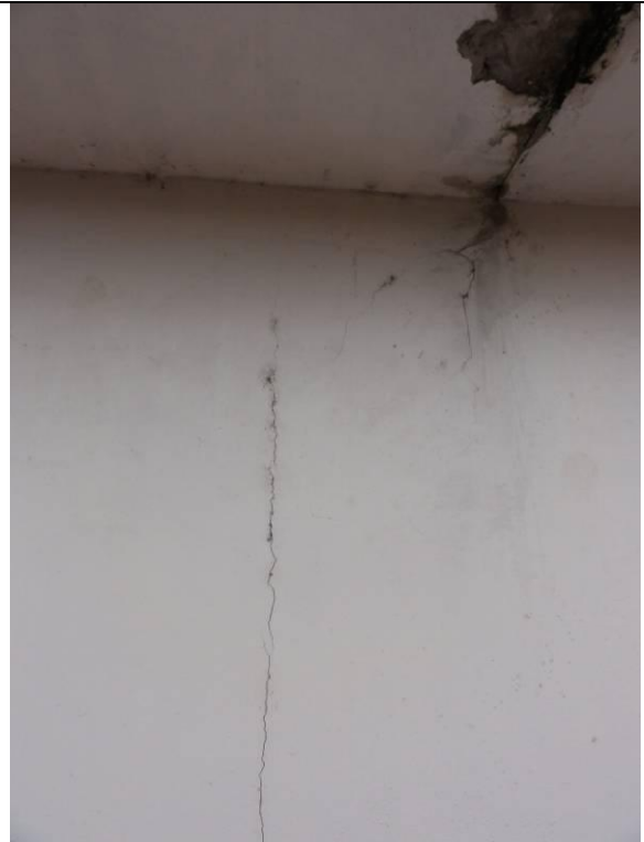
Lateral Direita – Parede D – Marquise com reboco descascando, umidade e rachadura (DSC02794, 22/02/2011, 09:35h)
