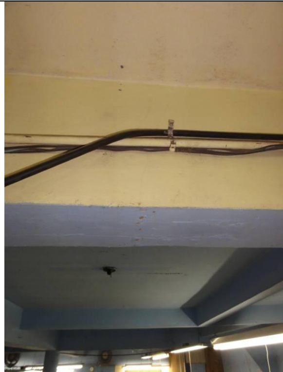
Piso Inferior – Fábrica - Teto (DSC03146, 22/02/2011, 16:39h)
