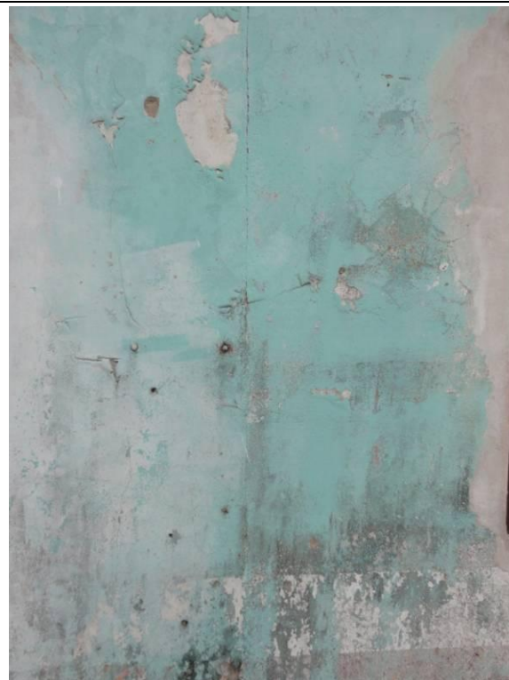
Fachada – Paredes com muito mofo, tinta descascado e fissuras (DSC02618, 21/02/2011, 17:15h)
