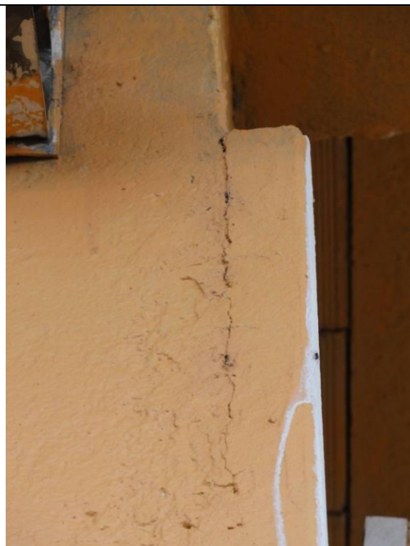
Lateral Direto – Parede D – Fissuras no reboco (DSC02281, 21/02/2011, 15:56h)
