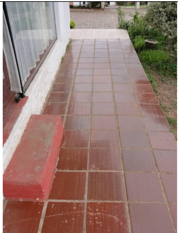
Fachada – Piso cerâmico (DSC02233, 21/02/2011, 15:49h)
