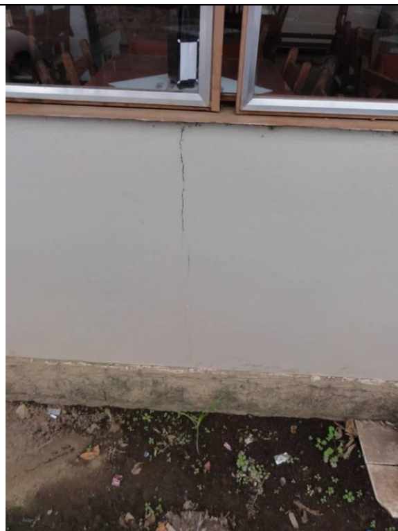
Fachada – Parede A – Fissura no reboco próximo a janela (DSC02774, 22/02/2011, 09:32h)
