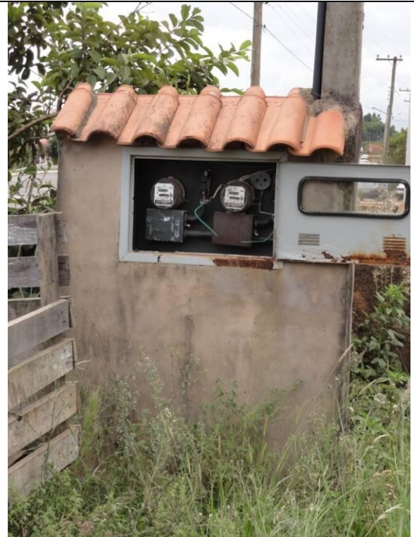
Fachada – Muro com caixa de luz (DSC02598, 21/02/2011, 17:12h)
