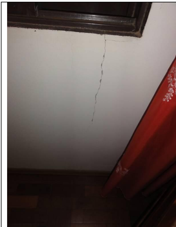
Piso superior - Sala 2 – Rachaduras próximas a janela (DSC02398, 21/02/2011, 16:19h)
