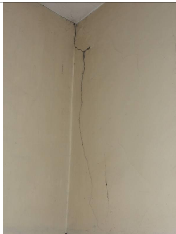
Piso inferior – Cozinha – Rachadura na parede 24 (DSC02864, 22/02/2011, 09:51h)
