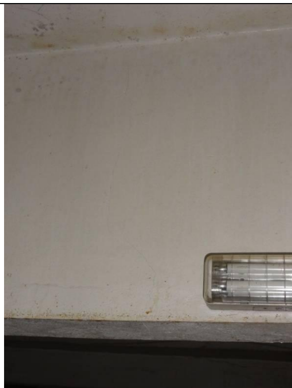
Parte 2 – Piso inferior – Lanchonete – Teto em geral com muita umidade e mofo (DSC02530, 21/02/2011, 16:51h)
