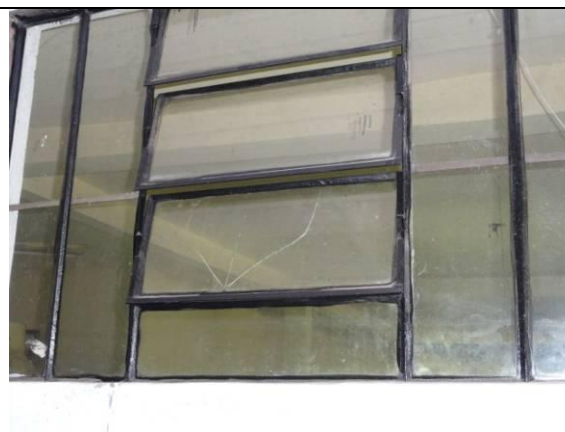
Piso Inferior – Salão 1 – Janela com vidro rachado (DSC03501, 23/02/2011, 09:23h)
