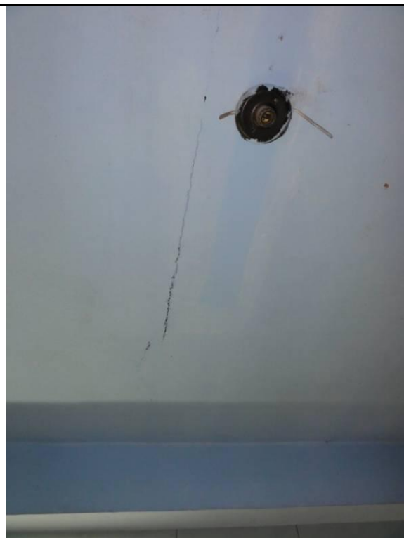
Piso Inferior – Fábrica – Teto (DSC03118, 22/02/2011, 11:29h)
