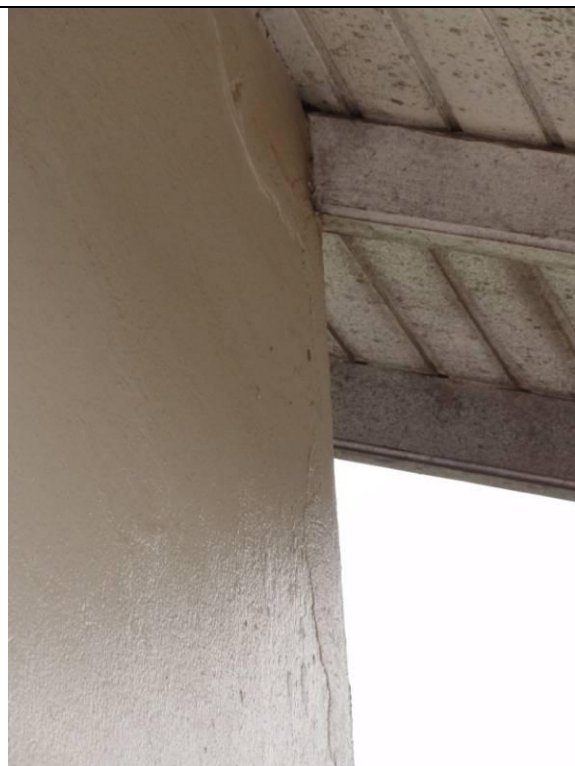
Piso superior - Sacada - Marquise (DSC02907, 22/02/2011, 10:07h)
