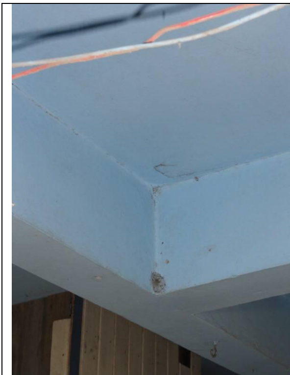
Piso Inferior – Fábrica – Teto com bastante umidade e mofo (DSC03111, 22/02/2011, 11:27h)
