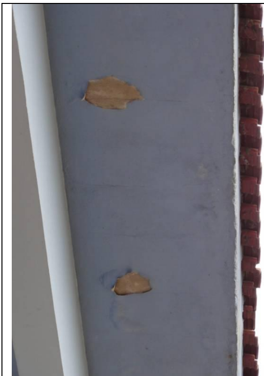
Parte 1 - Marquise (DSC02470, 21/02/2011, 16:39h)
