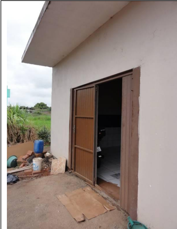
Lateral Direita – Parede D – Portão (DSC02797, 22/02/2011, 09:36h)
