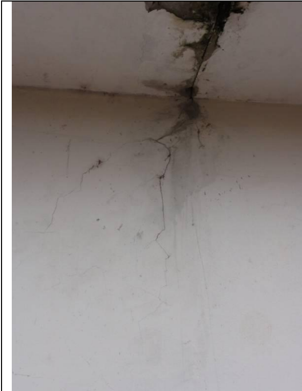
Lateral Direita – Parede D – Marquise com reboco descascando, umidade e rachadura (DSC02793, 22/02/2011, 09:35h)
