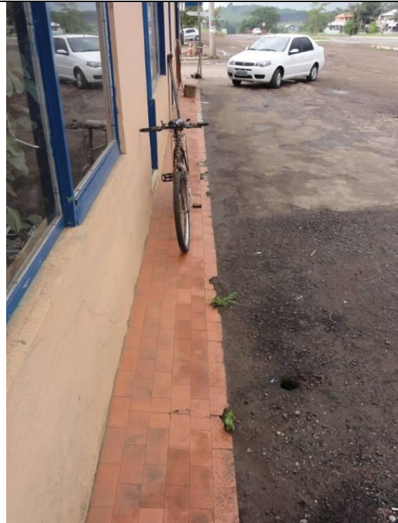
Fachada – Calçada de piso cerâmico com alguns pisos quebrados (DSC03027, 22/02/2011, 10:56h)
