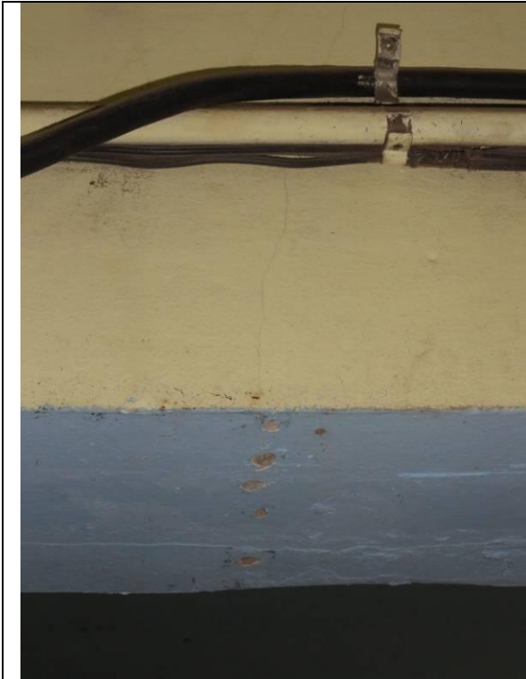
Piso Inferior – Fábrica - Teto (DSC03147, 22/02/2011, 16:39h)
