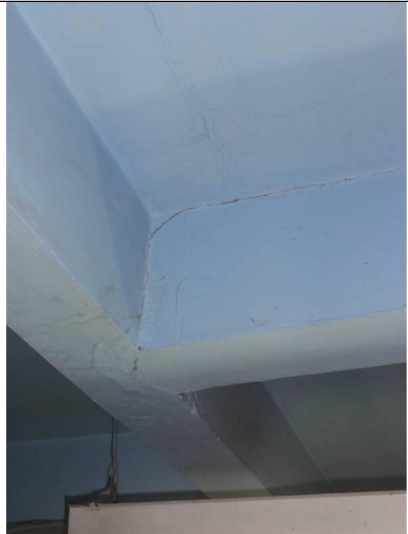
Piso Inferior – Fábrica – Teto (DSC03120, 22/02/2011, 11:29h)
