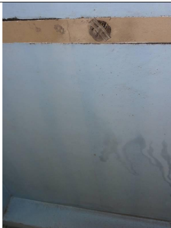
Piso Inferior – Fábrica – Teto com bastante umidade e mofo (DSC03102, 22/02/2011, 11:25h)
