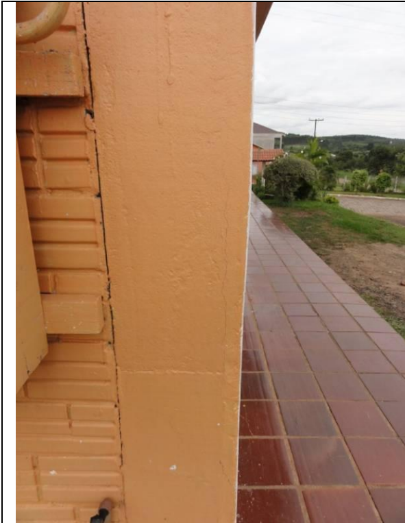
Lateral Direto – Parede D – Fissuras no reboco (DSC02279, 21/02/2011, 15:56h)
