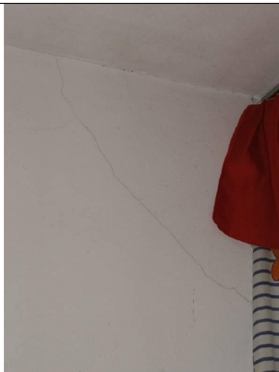
Piso superior - Quarto 3 – Fissura no reboco próximo (DSC02387, 21/02/2011, 16:17h)
