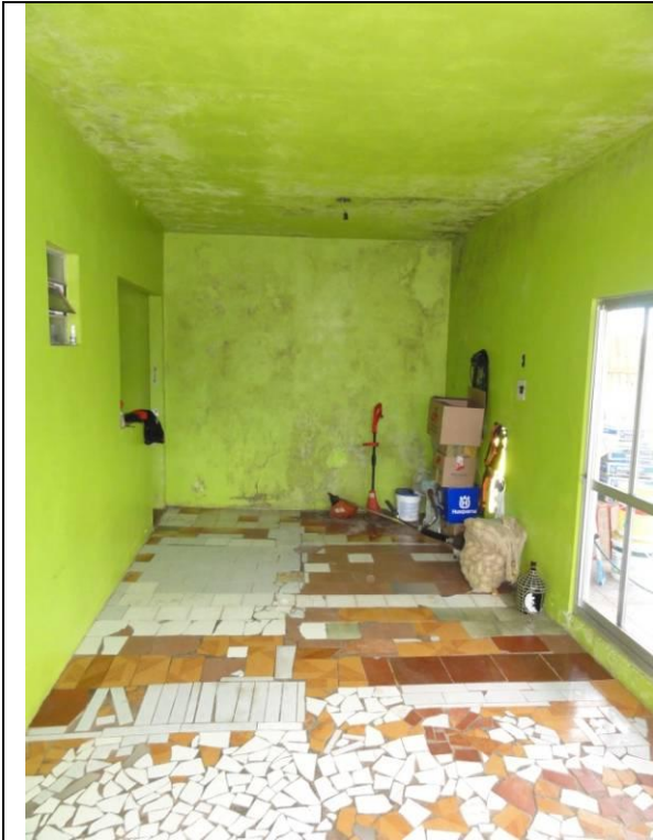
Parte 2 – Piso inferior – Parede 1 com muita umidade e mofo (DSC02522, 21/02/2011, 16:49h)
