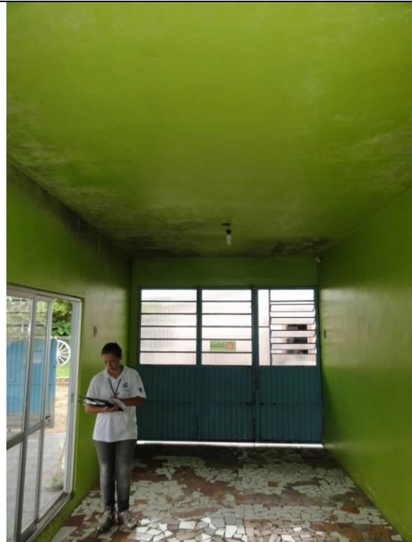
Parte 2 – Piso inferior – Parede 1 com muita umidade e mofo (DSC02523, 21/02/2011, 16:49h)
