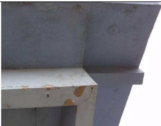
Parte 1 - Marquise (DSC02472, 21/02/2011, 16:40h)
