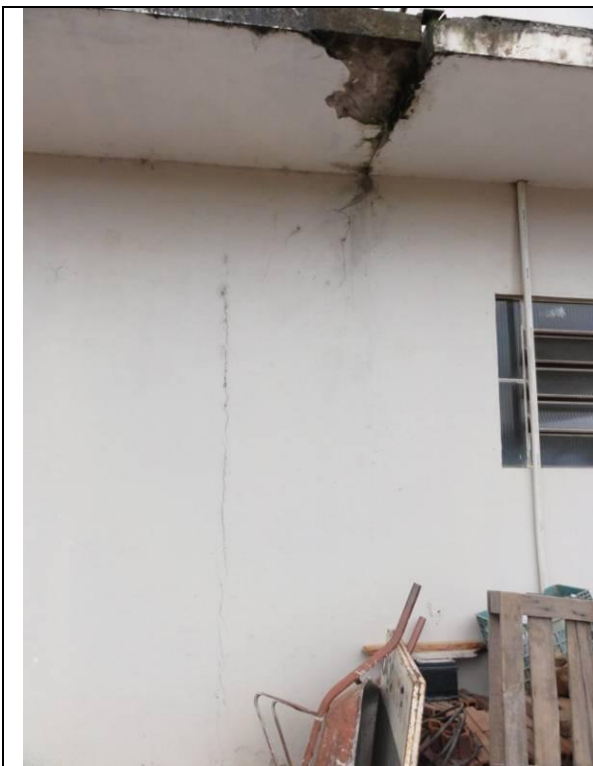
Lateral Direita – Parede D – Marquise com reboco descascando, umidade e rachadura (DSC02791, 22/02/2011, 09:35h)
