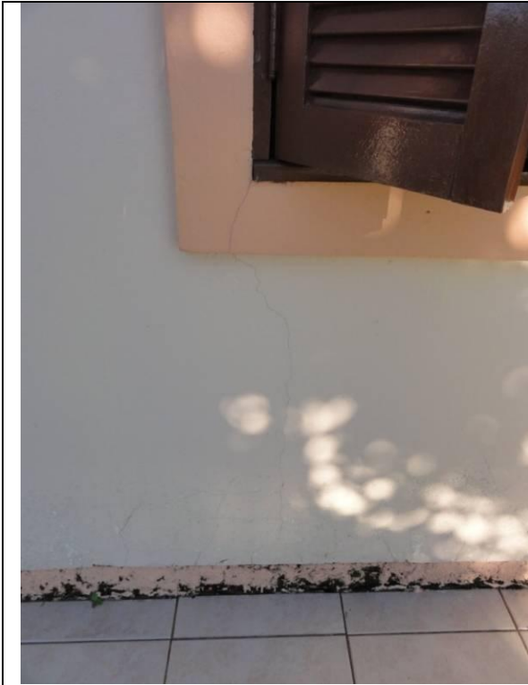
Lateral B – Fissuras no reboco próximas a janela (DSC01176, 17/02/2011, 07:47h)
