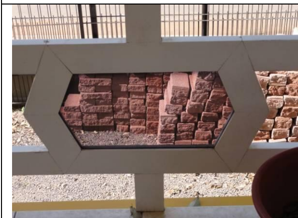
Sacada – Vidro quebrado (DSC01654, 17/02/2011, 15:51h)
