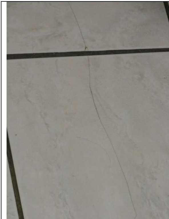
Piso superior – Cozinha – Piso cerâmico rachado (DSC00714, 16/02/2011, 09:46h)
