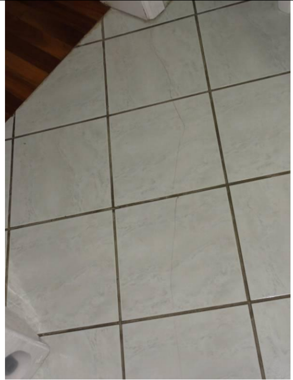
Piso superior – Cozinha – Piso cerâmico rachado (DSC00711, 16/02/2011, 09:46h)
