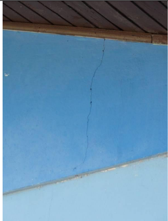
Fundos – Fissura no reboco próximo ao teto (DSC01500, 17/02/2011, 10:43h)
