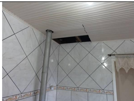
Cozinha – Teto com forro PVC com buraco (DSC01681, 17/02/2011, 15:55h)
