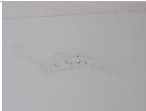
Piso superior – Sacada – Parede e teto com fissura (DSC00947, 16/02/2011, 13:36h)
