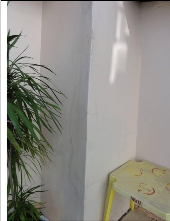
Lateral B – Fissuras no reboco da churrasqueira (DSC01184, 17/02/2011, 07:49h)
