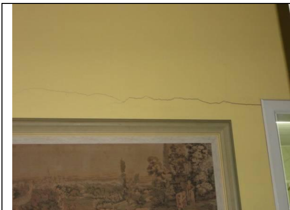
Piso superior – Corredor – Fissura no reboco (DSC00742, 16/02/2011, 09:52h)
