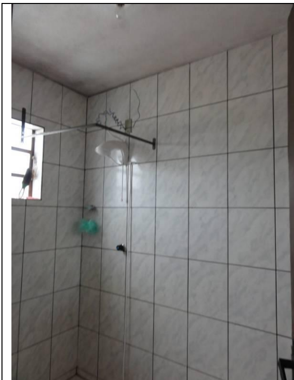
Piso superior – Apto 2 - Banheiro (DSC00888, 16/02/2011, 10:46h)
