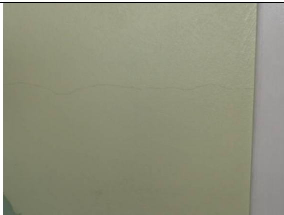
3º Piso – Quarto – Fissuras no reboco (DSC01067, 16/02/2011, 14:19h)
