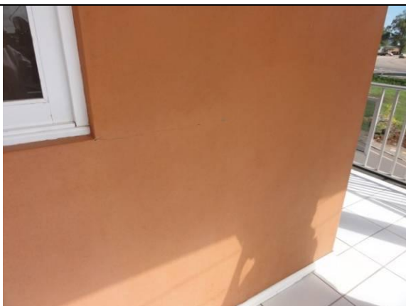
Piso superior – Sacada – Fissuras no reboco (DSC00690, 16/02/2011, 09:39h)
