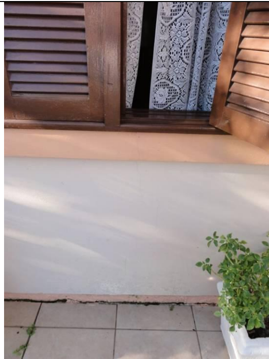
Fachada - Rachadura na divisória parede e piso (DSC01163, 17/02/2011, 07:46h)
