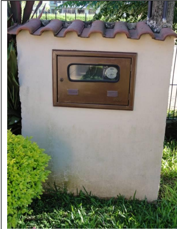
Muro com caixa de luz (DSC01178, 17/02/2011, 07:48h)
