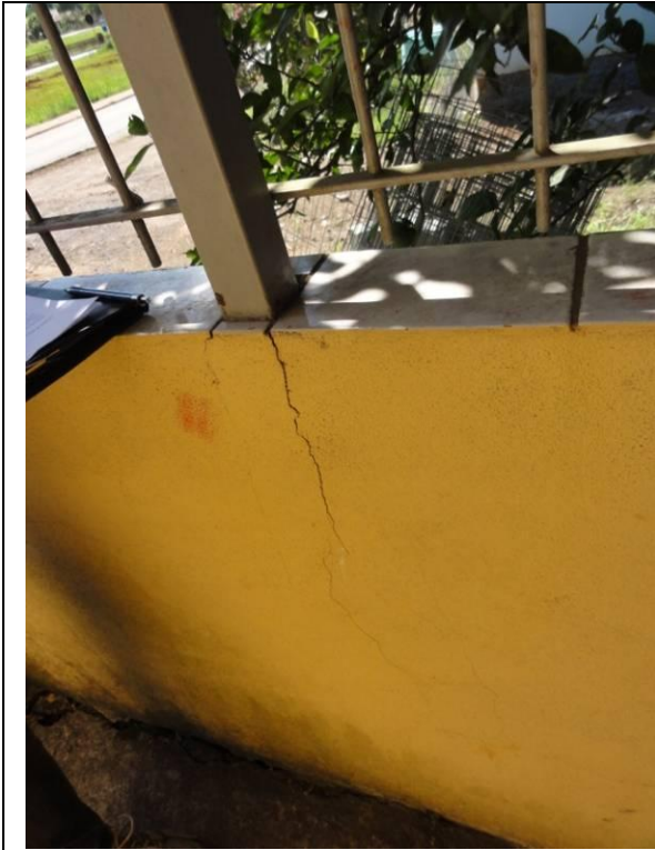
Lateral D – Muro com fissura no reboco (DSC01417, 17/02/2011, 10:03h)
