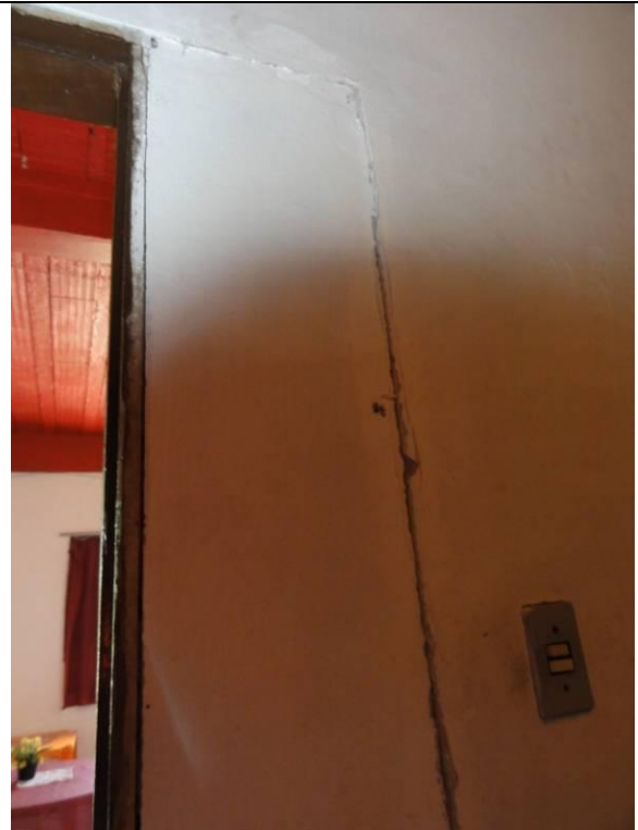
Bar - Rachadura (DSC00835, 16/02/2011, 10:24h)
