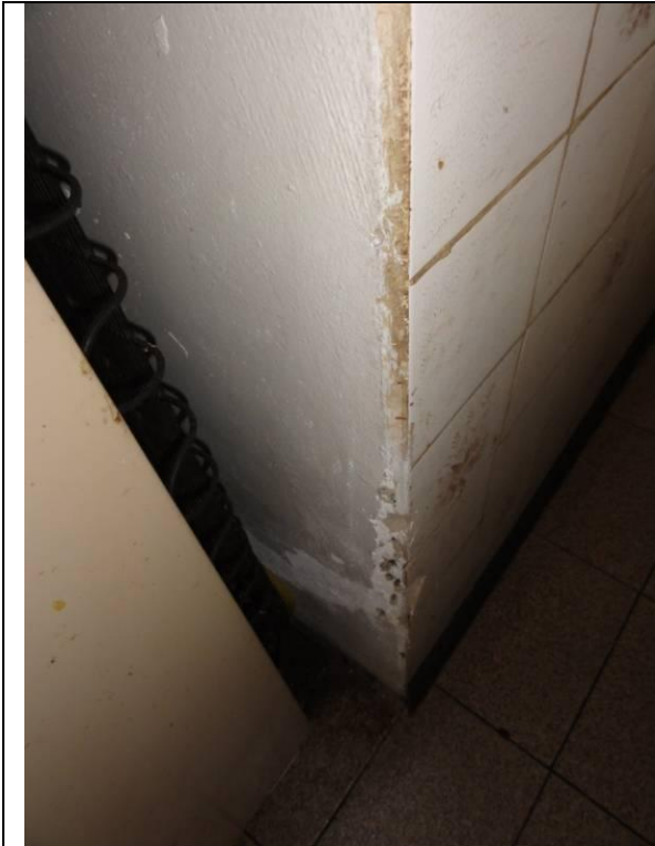
Bar – Banheiro – Parede com reboco rachado (DSC00846, 16/02/2011, 10:28h)
