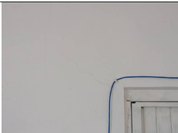
Piso superior – Sala – Parede com fissuras (DSC01117, 17/02/2011, 07:26h)
