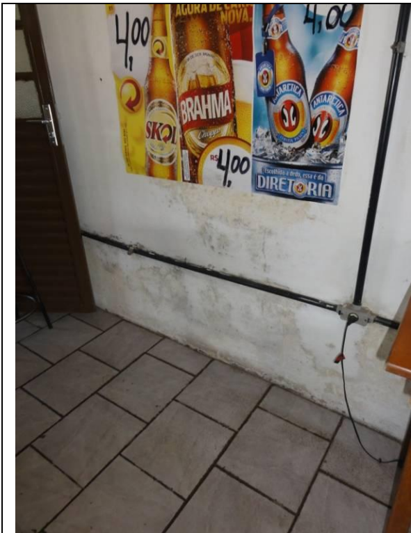
Bar – Parede com muita umidade (DSC00816, 16/02/2011, 10:19h)
