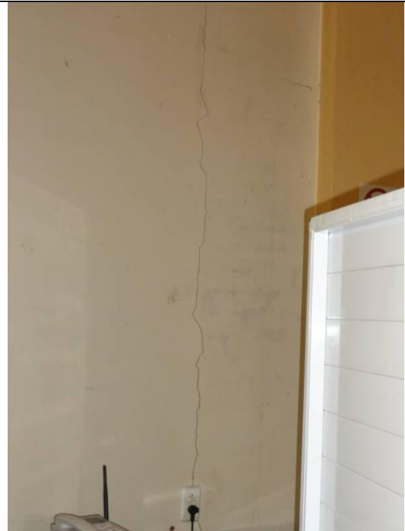
Piso inferior – Padaria – Parede 1 com fissuras no reboco (DSC00991, 16/02/2011, 13:59h)
