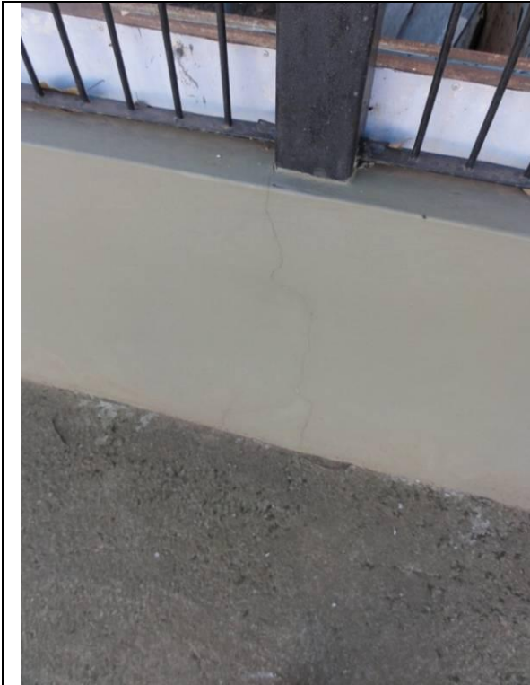
Fachada – Muro e portão – fissuras no reboco (DSC01689, 17/02/2011, 16:05h)
