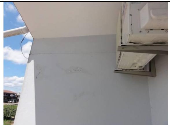
Piso superior – Sacada – Parede e teto com fissura (DSC00944, 16/02/2011, 13:36h)
