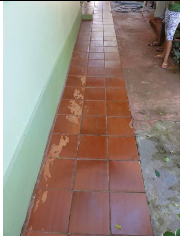
Parede B – Lateral Esquerda (DSC01458, 17/02/2011, 10:27h)
