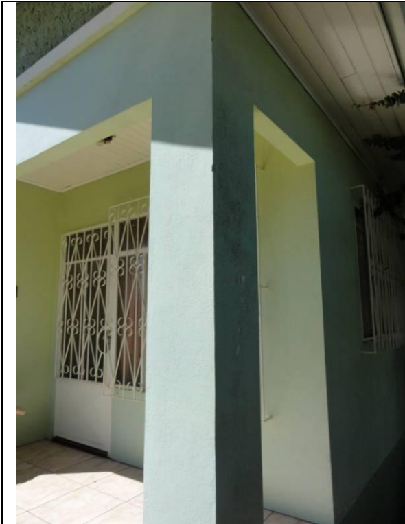
Parede B – Lateral Esquerda (DSC01457, 17/02/2011, 10:27h)
