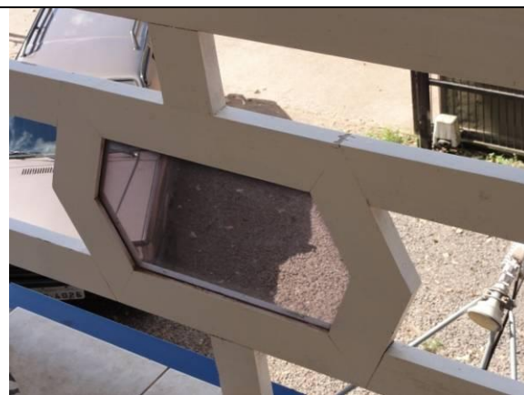
Sacada – Vidro quebrado (DSC01655, 17/02/2011, 15:51h)
