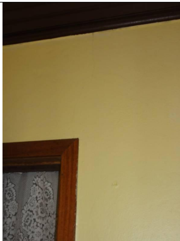
Quarto 1 – Fissura no reboco próximo a porta com 206 cm (DSC01376, 17/02/2011, 09:42h)
