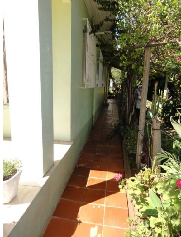
Parede B – Lateral Esquerda (DSC01456, 17/02/2011, 10:27h)
