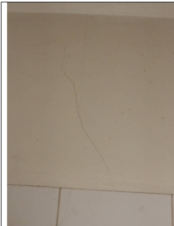
Piso inferior – Padaria – Parede 1 com fissuras no reboco (DSC00996, 16/02/2011, 14:00h)
