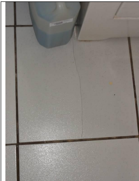
Piso superior – Area de Serviço – Piso cerâmico rachado (DSC00720, 16/02/2011, 09:47h)
