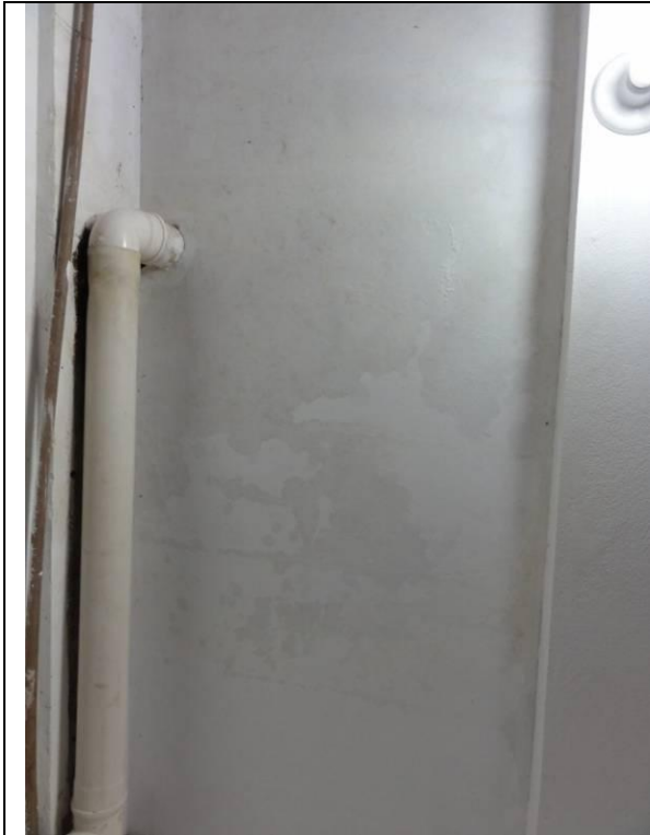
Piso inferior - Loja – Banheiro - Umidade (DSC00618, 16/02/2011, 09:03h)
