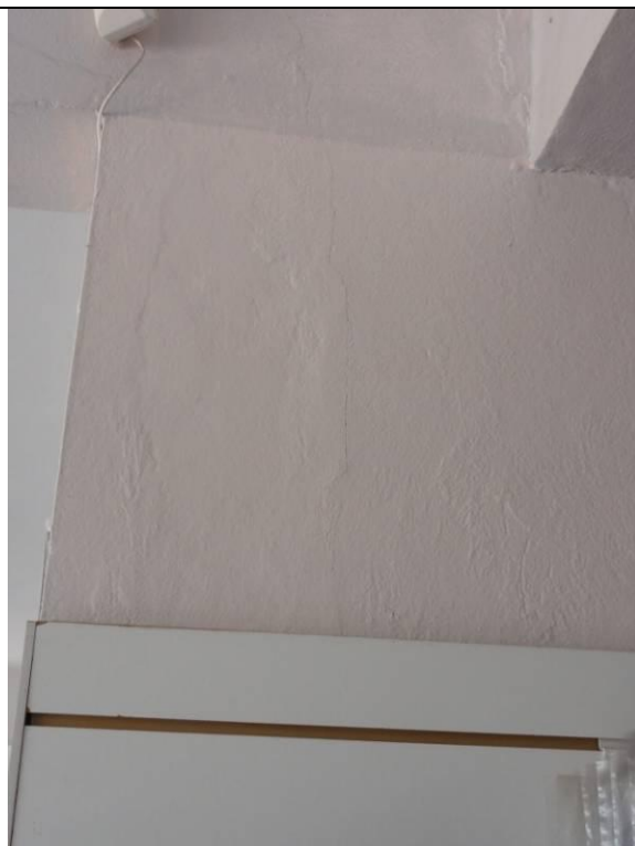
Loja – Parede com algumas fissuras no reboco (DSC00920, 16/02/2011, 13:24h)
