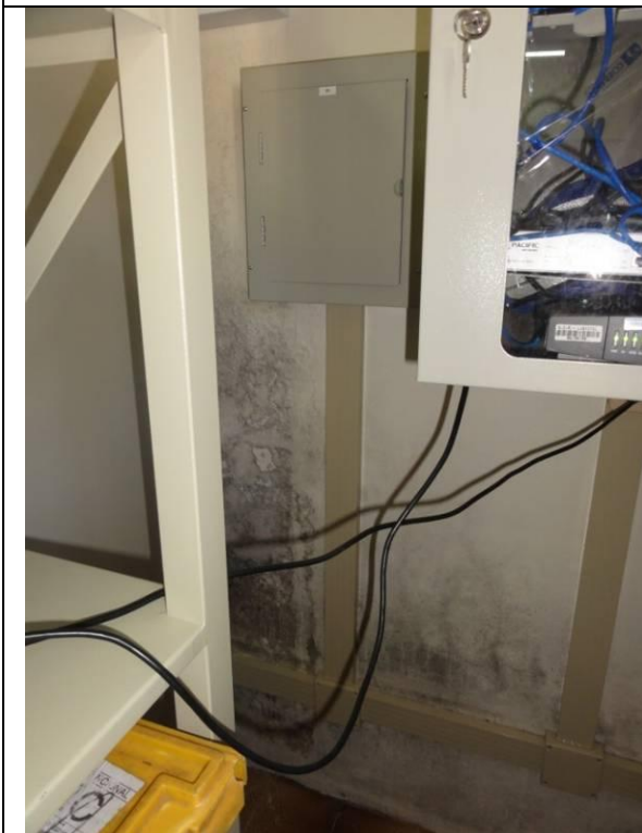
Correio – Parede com bastante umidade e mofo (DSC02212, 18/02/2011, 10:05h)
