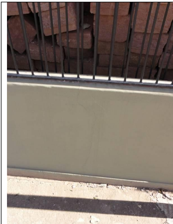
Fachada – Muro e portão – Fissuras no reboco (DSC01566, 17/02/2011, 15:35h)
