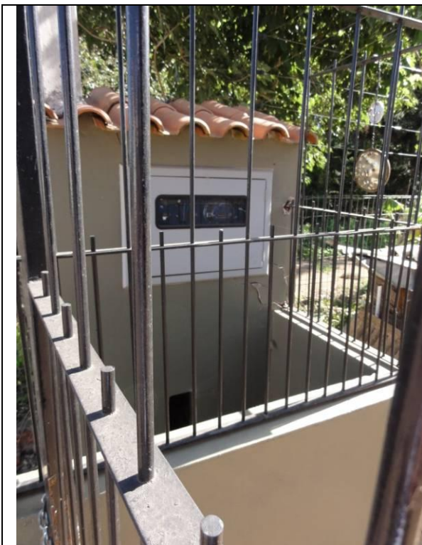
Fachada – Muro e portão – fissuras no reboco (DSC01693, 17/02/2011, 16:05h)
