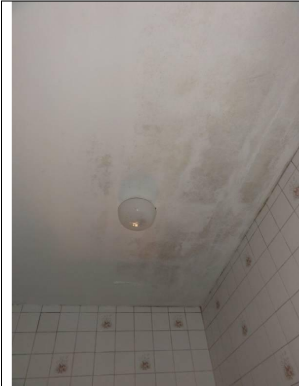
Correio – WC – Teto com umidade (DSC02206, 18/02/2011, 10:04h)
