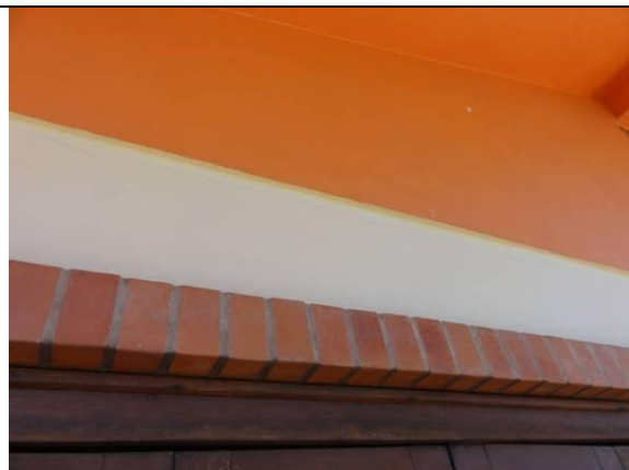
Piso superior – Entrada casa – Parede A – Fissura (DSC01322, 17/02/2011, 08:59h)
