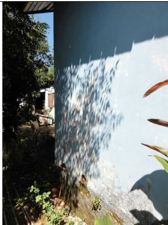
Lateral D – Reboco descascando, muita umidade (DSC01498, 17/02/2011, 10:42h)
