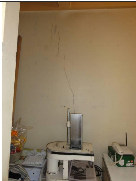
Piso inferior – Padaria – Parede 1 com fissuras no reboco (DSC00993, 16/02/2011, 14:00h)
