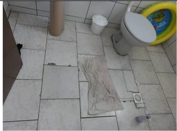
Piso superior – Apto 1 - Banheiro (DSC00873, 16/02/2011, 10:39h)
