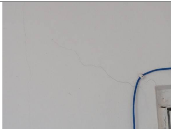
Piso superior – Sala – Parede com fissuras (DSC01118, 17/02/2011, 07:26h)
