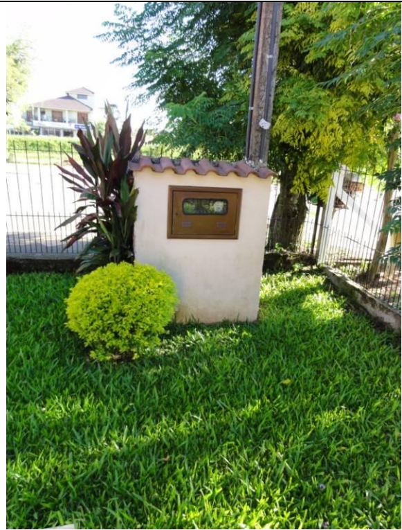
Muro com caixa de luz (DSC01177, 17/02/2011, 07:48h)
