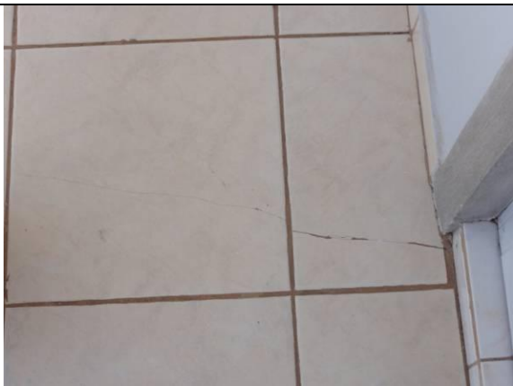
Piso superior – Sacada – Piso cerâmico rachado (DSC00943, 16/02/2011, 13:36h)
