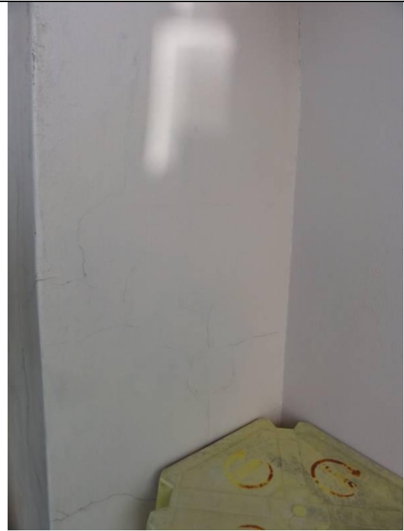
Lateral B – Fissuras no reboco da churrasqueira (DSC01185, 17/02/2011, 07:49h)
