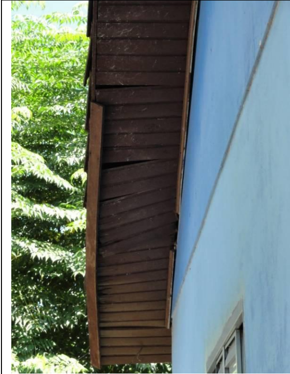
Fundos – Marquise forro cedendo (DSC01503, 17/02/2011, 10:43h)
