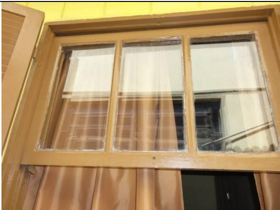
Lateral B – Janela com vidro rachado (DSC01355, 17/02/2011, 09:36h)
