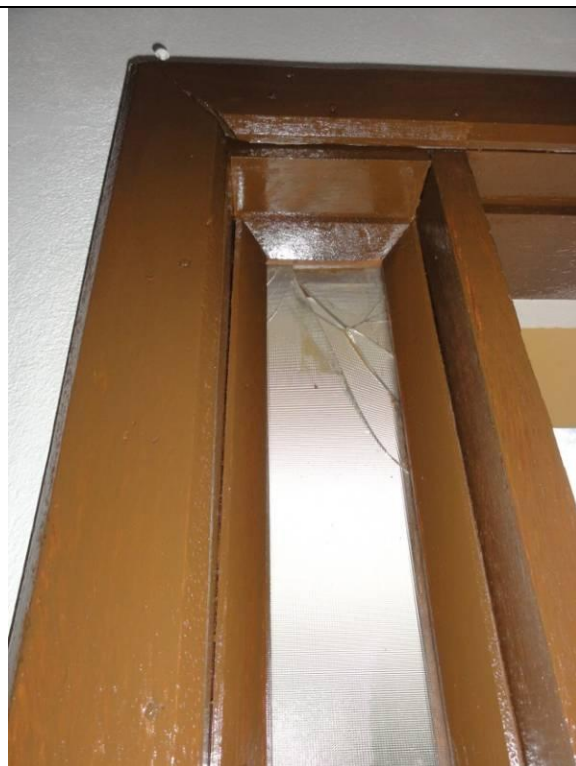
Piso superior – Apto 2 – Sala – vidro rachado (DSC00885, 16/02/2011, 10:45h)
