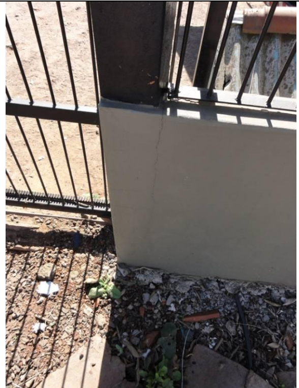
Fachada – Muro e portão – fissuras no reboco (DSC01692, 17/02/2011, 16:05h)
