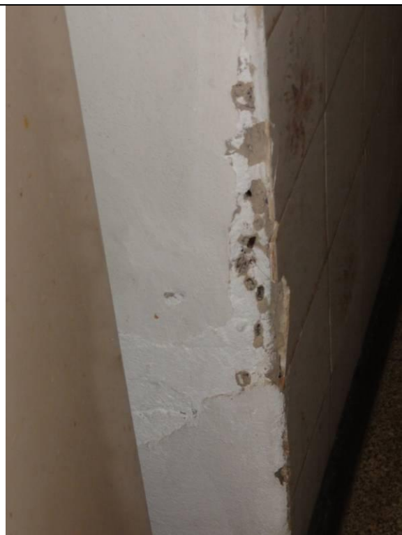
Bar – Banheiro – Parede com reboco rachado (DSC00845, 16/02/2011, 10:27h)
