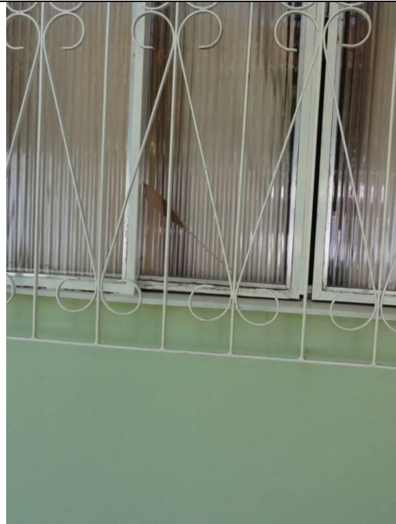
Parede B – Lateral Esquerda – vidro quebrado (DSC01460, 17/02/2011, 10:27h)
