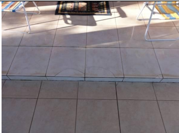
Calçada em torno da casa – Piso cerâmico quebrado (DSC01158, 17/02/2011, 07:45h)
