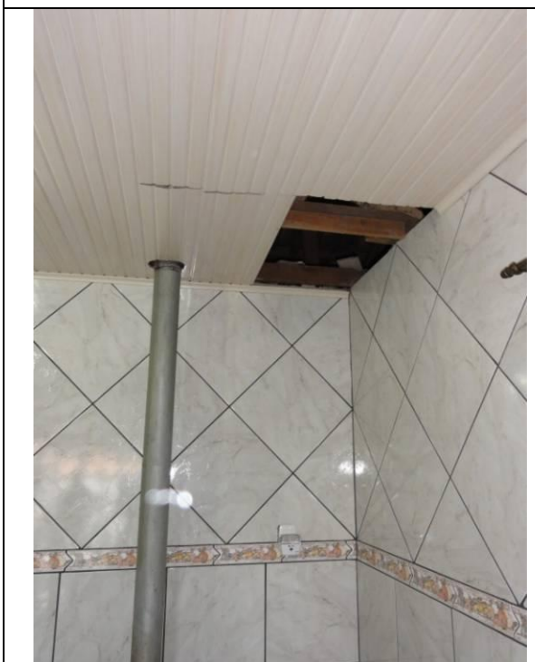
Cozinha – Teto com forro PVC com buraco (DSC01682, 17/02/2011, 15:56h)
