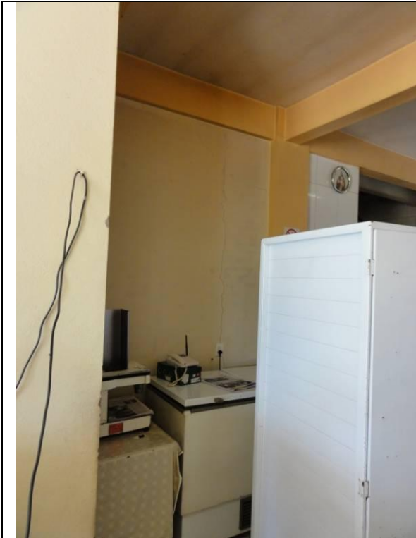
Piso inferior – Padaria – Parede 1 com fissuras no reboco (DSC00990, 16/02/2011, 13:59h)
