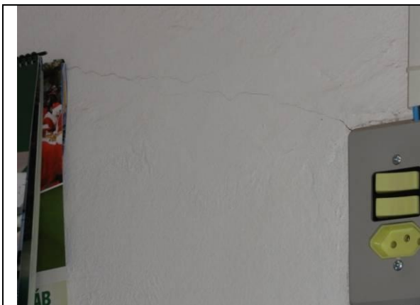
Subida da escada – Parede com algumas fissuras no reboco (DSC01092, 17/02/2011, 07:15h)
