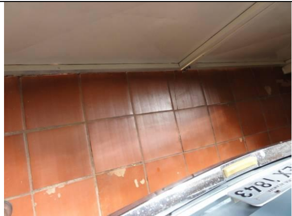
Garagem (DSC01472, 17/02/2011, 10:30h)
