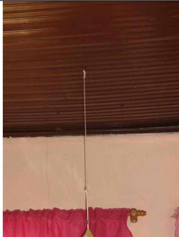
Quarto 2 – Fissura no reboco com 27cm próximo a janela (DSC01370, 17/02/2011, 09:39h)
