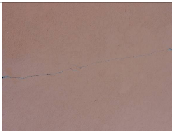
Piso superior – Sacada – Fissuras no reboco (DSC00691, 16/02/2011, 09:39h)
