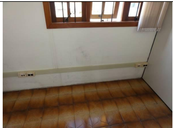
Correio – Parede com bastante umidade (DSC02211, 18/02/2011, 10:05h)
