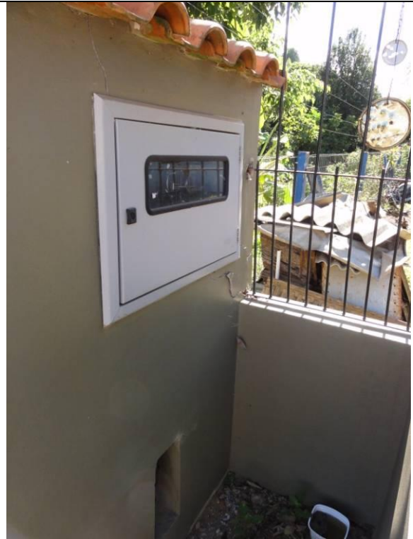
Fachada – Muro com caixa de luz com rachaduras e reboco caindo (DSC01696, 17/02/2011, 16:06h)
