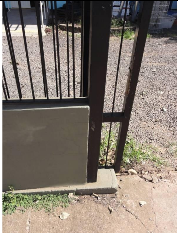
Fachada – Muro e portão – Fissuras no reboco (DSC01569, 17/02/2011, 15:36h)
