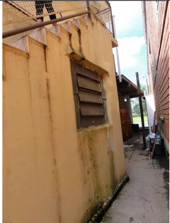
Entrada Piso superior – Parede com muita umidade e mofo (DSC00861, 16/02/2011, 10:35h)
