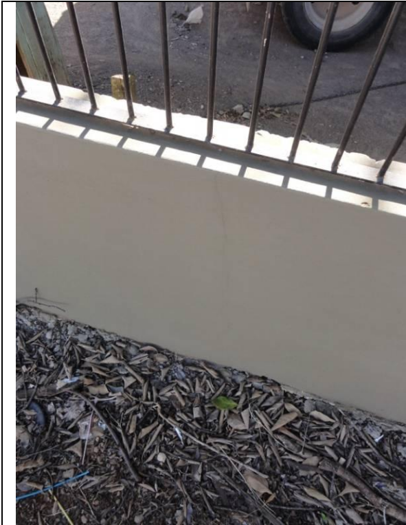
Fachada – Muro e portão – fissuras no reboco (DSC01691, 17/02/2011, 16:05h)
