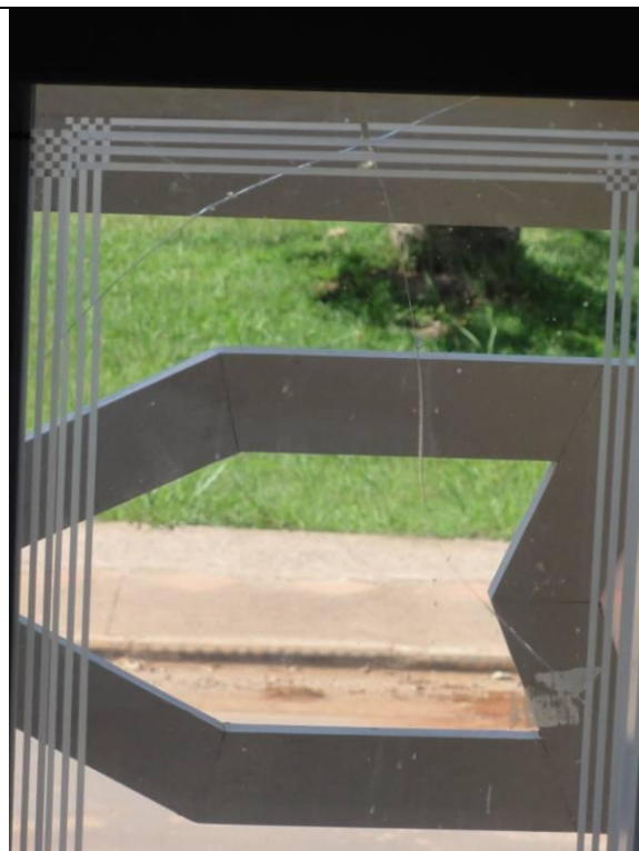
Sala – Porta para sacada com vidro rachado (DSC01627, 17/02/2011, 15:47h)
