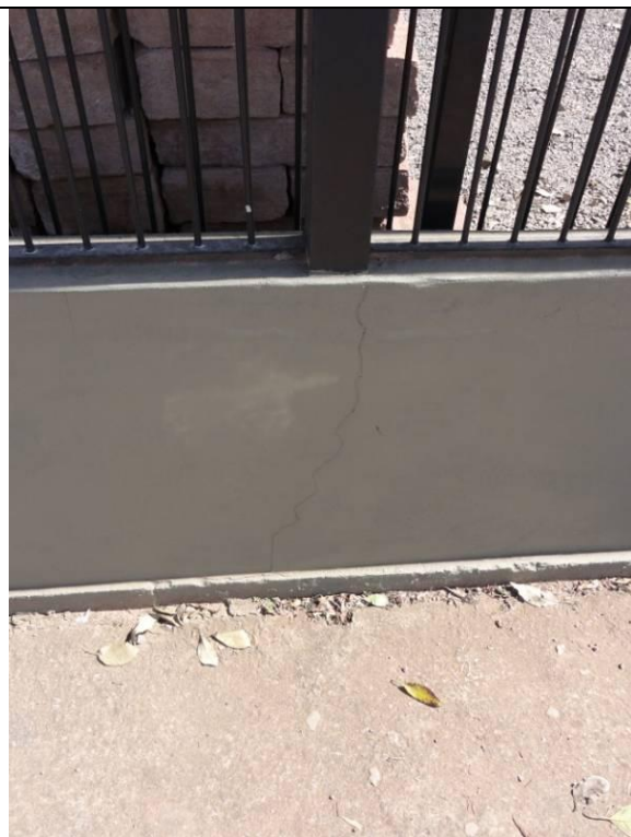
Fachada – Muro e portão – Fissuras no reboco (DSC01567, 17/02/2011, 15:36h)
