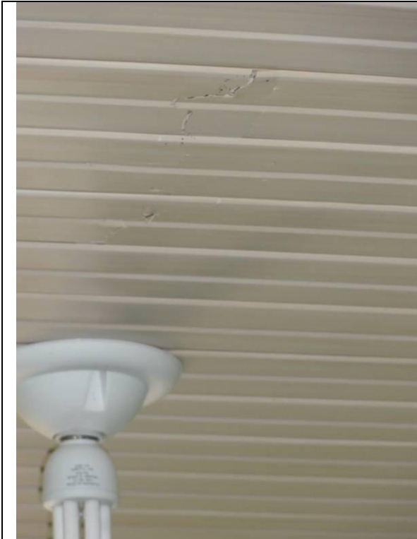
Sala – Teto com forro PVC riscado (DSC01628, 17/02/2011, 15:47h)
