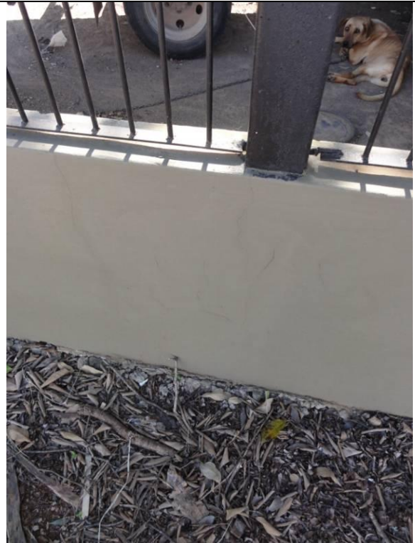
Fachada – Muro e portão – fissuras no reboco (DSC01690, 17/02/2011, 16:05h)
