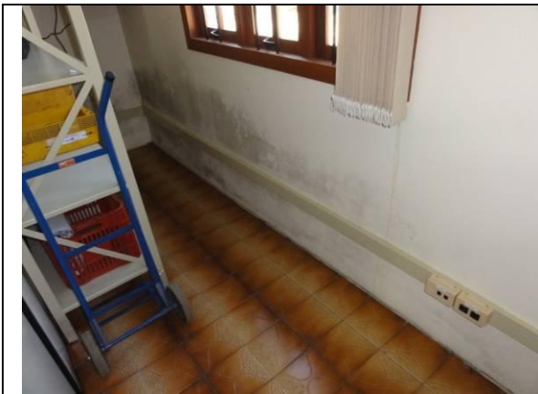
Correio – Parede com bastante umidade e mofo (DSC02210, 18/02/2011, 10:05h)
