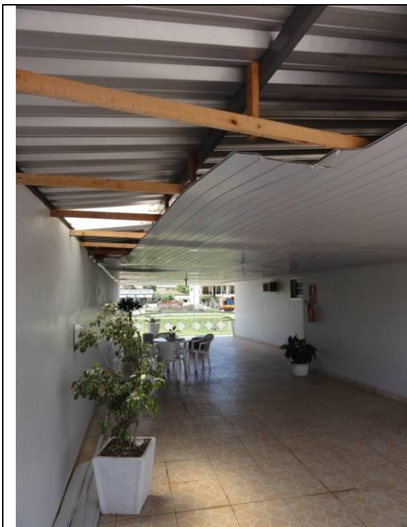
Piso superior – Sacada – Teto com forro pvc cedendo e com partes faltantes (DSC00954, 16/02/2011, 13:38h)
