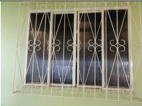
Parede B – Lateral Esquerda (DSC01461, 17/02/2011, 10:28h)
