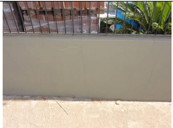
Fachada – Muro e portão – Fissuras no reboco (DSC01571, 17/02/2011, 15:36h)
