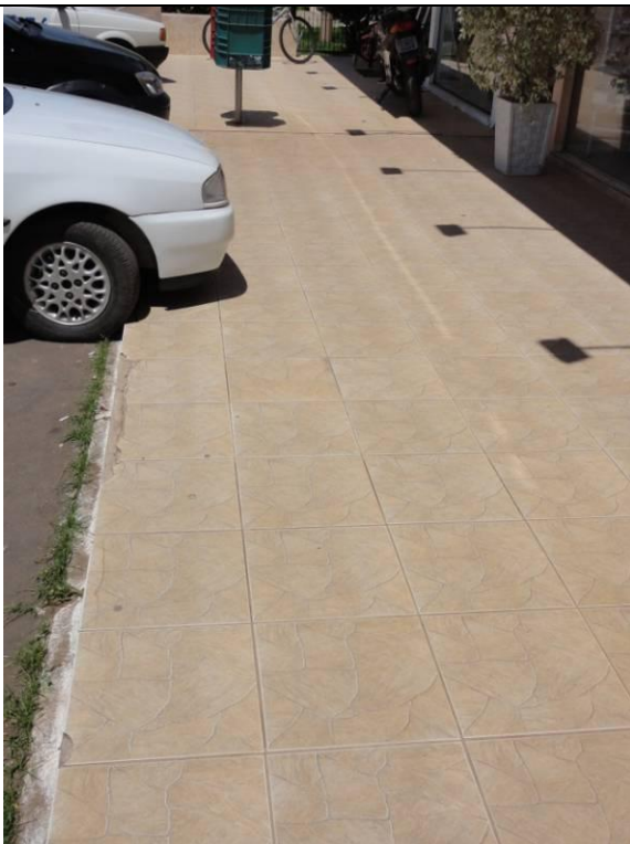
Calçada de piso cerâmico com algumas rachadura (DSC00976, 16/02/2011, 13:53h)
