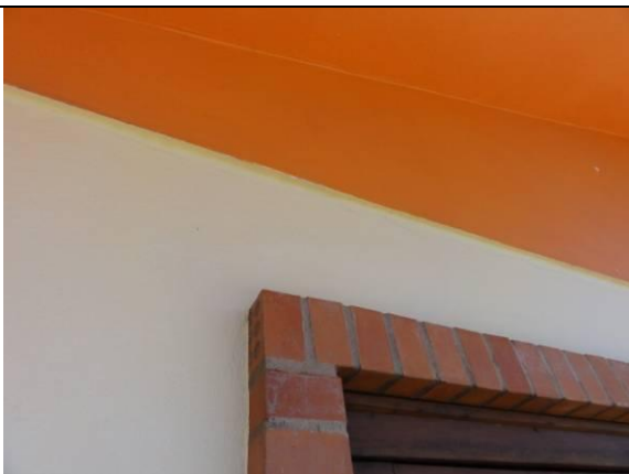
Piso superior – Entrada casa – Parede A – Fissura (DSC01321, 17/02/2011, 08:59h)
