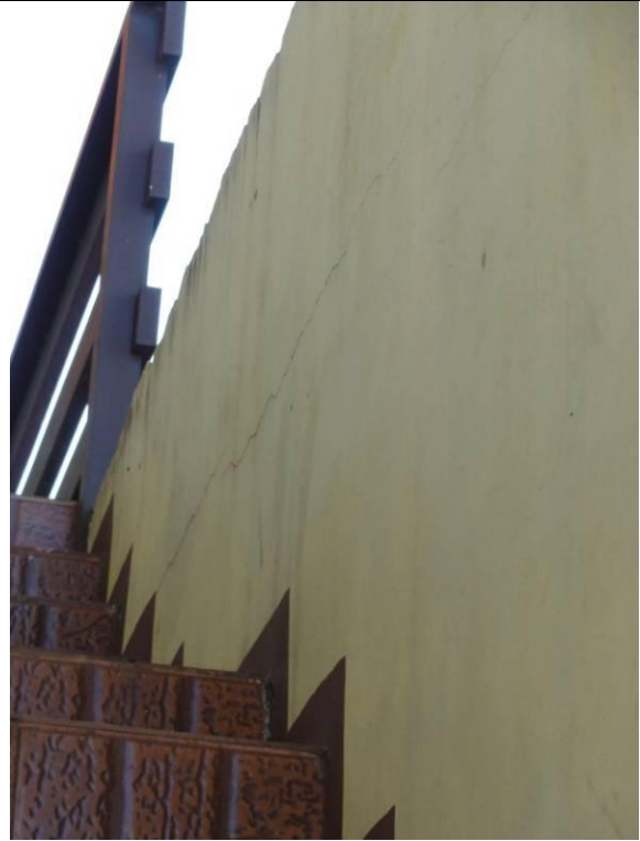
Piso inferior - Escada Fundos – Fissura no reboco (DSC01318, 17/02/2011, 08:57h)
