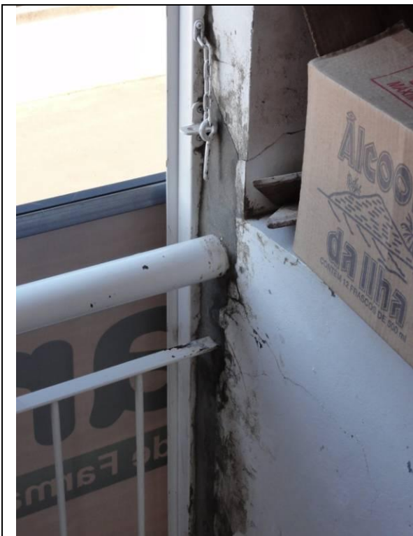
Piso superior – Fundos – Churrasqueira com várias fissuras no reboco (DSC01127, 17/02/2011, 07:29h)
