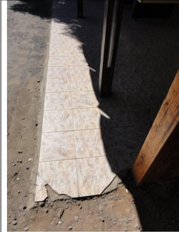
Entrada Bar - Piso cerâmico quebrado (DSC01349, 17/02/2011, 09:34h)
