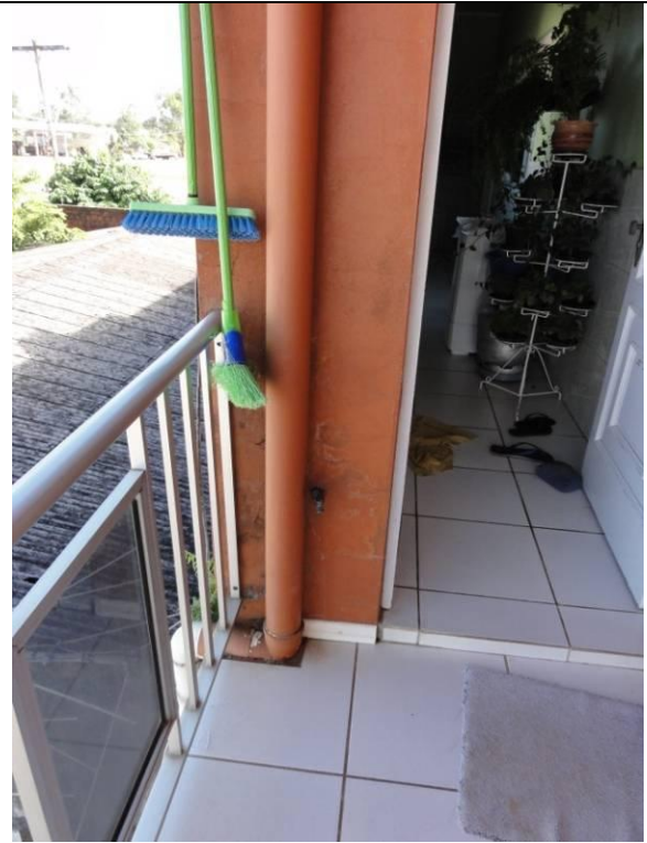
Piso superior – Sacada – Reboco com mofo e tinta descascando (DSC00701, 16/02/2011, 09:42h)
