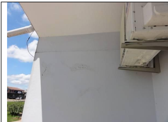
Piso superior – Sacada – Parede e teto com fissura (DSC00945, 16/02/2011, 13:36h)
