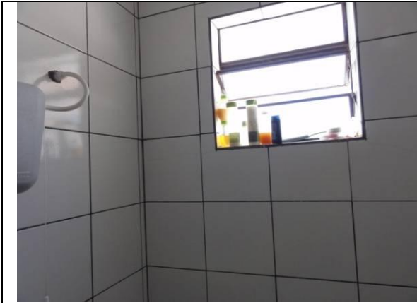
Piso superior – Apto 1 - Banheiro (DSC00872, 16/02/2011, 10:38h)
