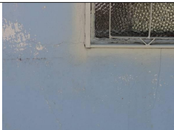
Lateral B – Janela – Fissura no reboco próximo a janela (DSC01509, 17/02/2011, 10:45h)
