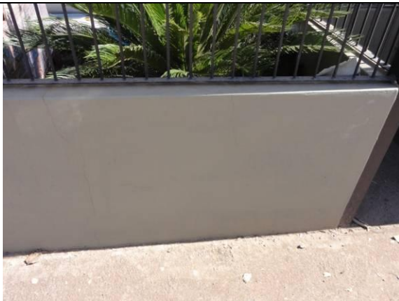
Fachada – Muro e portão – Fissuras no reboco (DSC01570, 17/02/2011, 15:36h)
