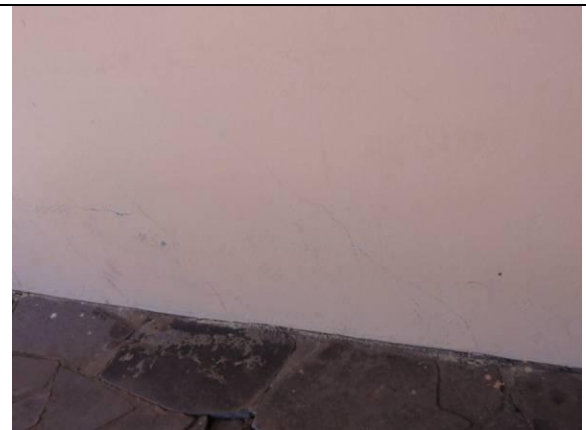
Fachada – Bar – Parede externa com várias fissuras no reboco (DSC00807, 16/02/2011, 10:18h)
