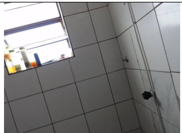
Piso superior – Apto 1 – Banheiro (DSC00871, 16/02/2011, 10:38h)
