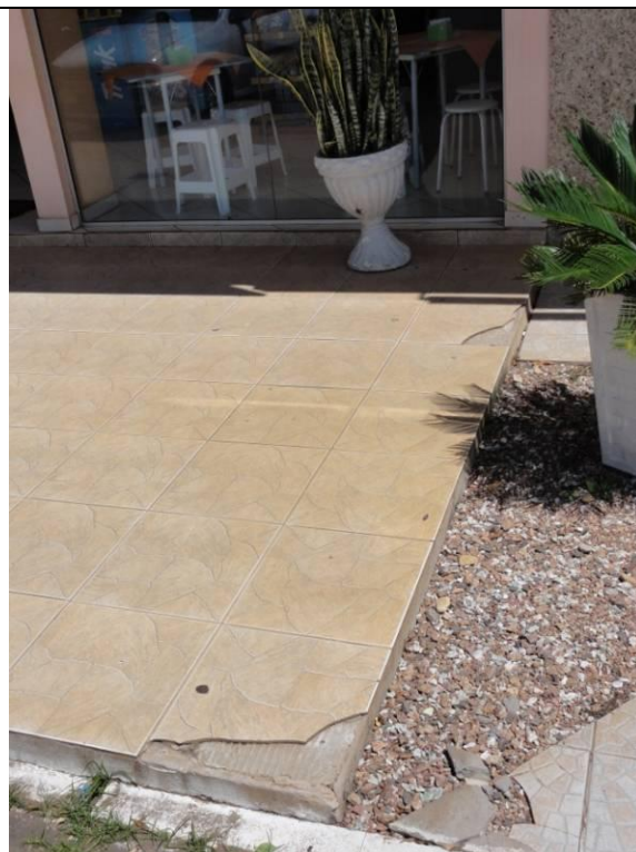
Calçada de piso cerâmico com algumas rachaduras (DSC00975, 16/02/2011, 13:52h)
