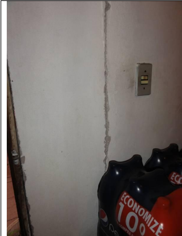
Bar - Rachadura (DSC00834, 16/02/2011, 10:22h)
