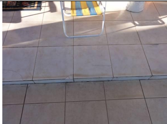
Calçada em torno da casa – Piso cerâmico quebrado (DSC01159, 17/02/2011, 07:45h)
