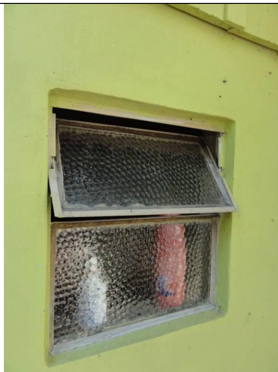
Parede B – Lateral Esquerda (DSC01466, 17/02/2011, 10:28h)
