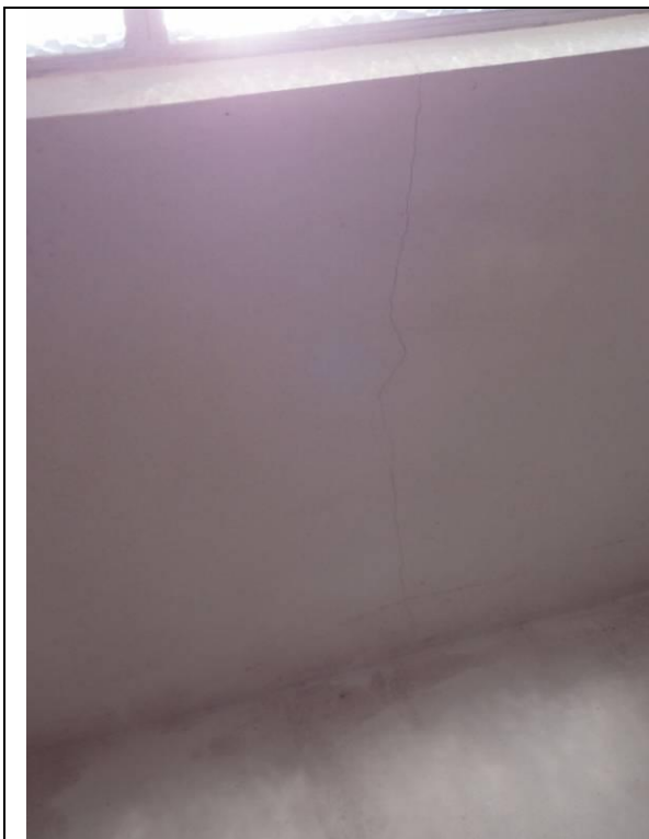
Piso superior – Cozinha – Fissuras no reboco próximo a janela (DSC01109, 17/02/2011, 07:22h)
