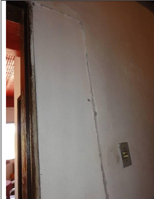
Bar - Rachadura (DSC00836, 16/02/2011, 10:24h)
