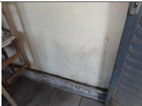
Bar – Sala fundos – Parede com bastante umidade (DSC00856, 16/02/2011, 10:29h)
