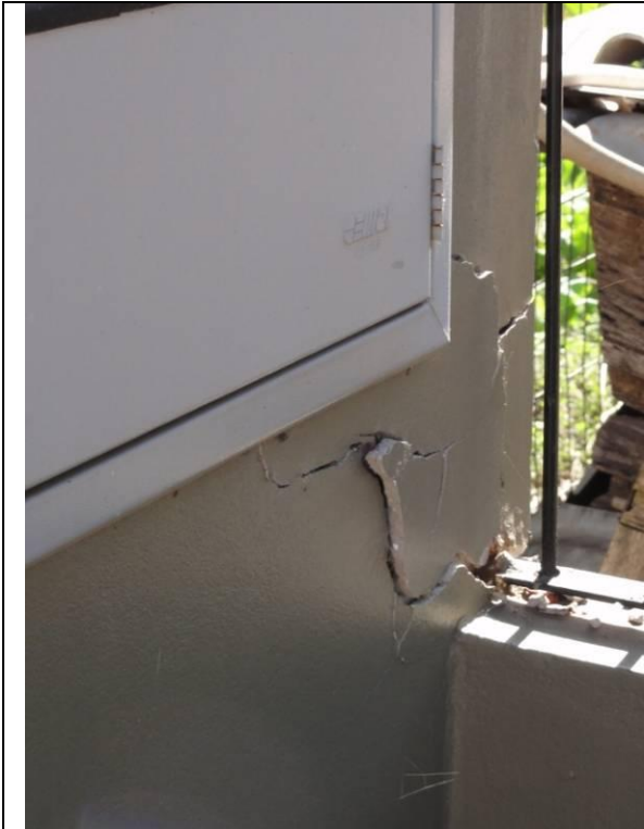
Fachada – Muro com caixa de luz com rachaduras e reboco caindo (DSC01695, 17/02/2011, 16:06h)
