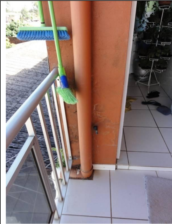
Piso superior – Sacada – Reboco com mofo e tinta descascando (DSC00700, 16/02/2011, 09:42h)
