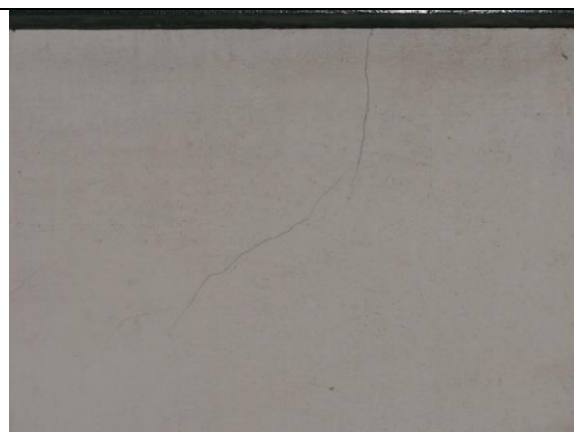
Sala 6 – Fissura no reboco próximo à janela (DSC01985, 18/02/2011, 08:40h)
