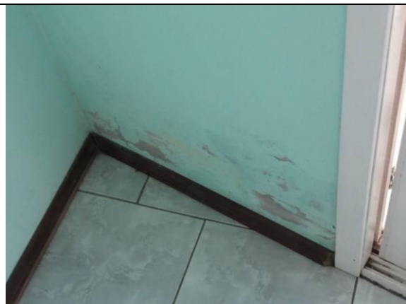
Apto 307 – Cozinha – Reboco descascando (DSC00297, 15/02/2011, 15:13h)
