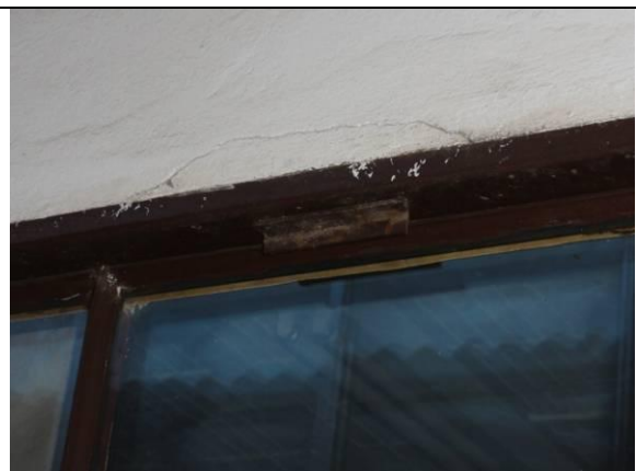
Lateral D – Fissura no reboco próximo a janela (DSC00546, 16/02/2011, 08:29h)
