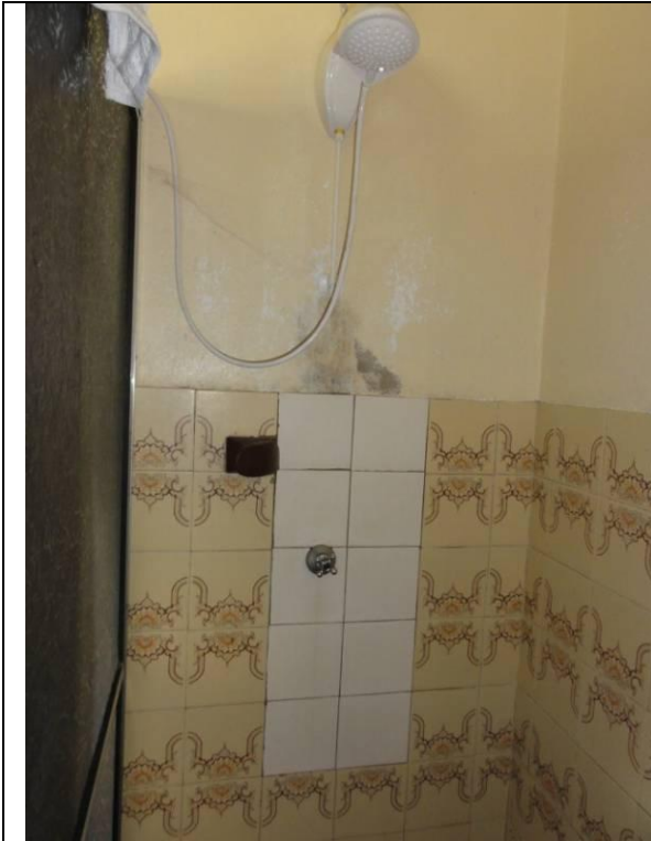
Banheiro – parede com umidade (DSC00163, 15/02/2011, 14:01h)
