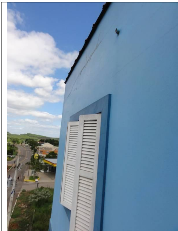
Apto 307 – Sacada – Parede com rachadura no reboco (DSC00254, 15/02/2011, 15:02h)
