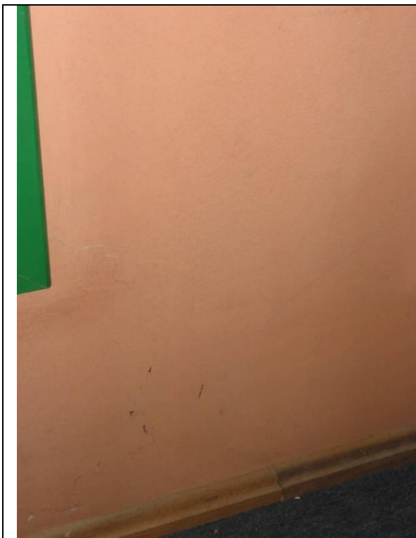
Sala de eventos – umidade e fissura no reboco (DSC01952, 18/02/2011, 08:32h)
