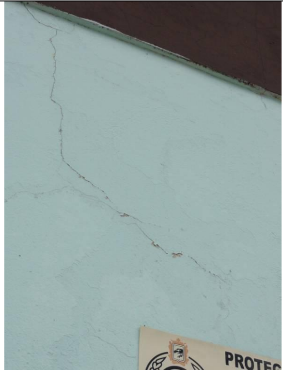
Fissura no reboco – Parede A (DSC00133, 15/02/2011, 13:54h)
