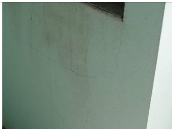
Apto 307 – Churrasqueira com fissura no reboco (DSC00315, 15/02/2011, 15:17h)
