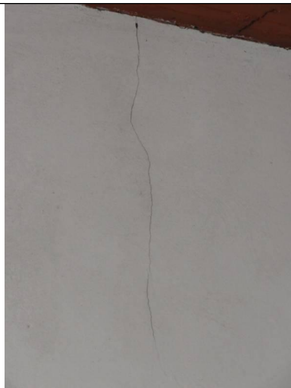
Garagem – Fundos – Fissura no reboco próximo ao teto (DSC00584, 16/02/2011, 08:37h)
