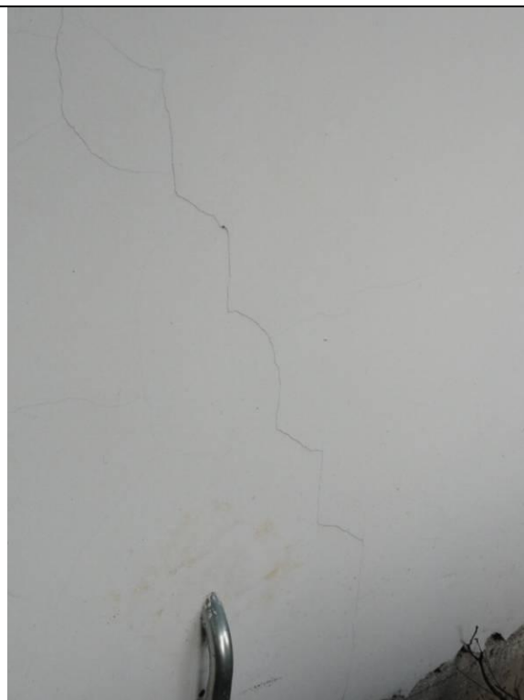
Lateral B – Leves fissuras no reboco (DSC00522, 16/02/2011, 08:22h)
