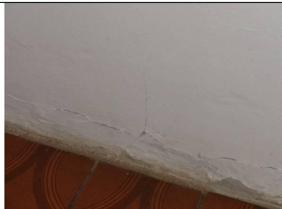
Sala - Parede 10 – umidade e reboco descascando (DSC00598, 16/02/2011, 08:43h)
