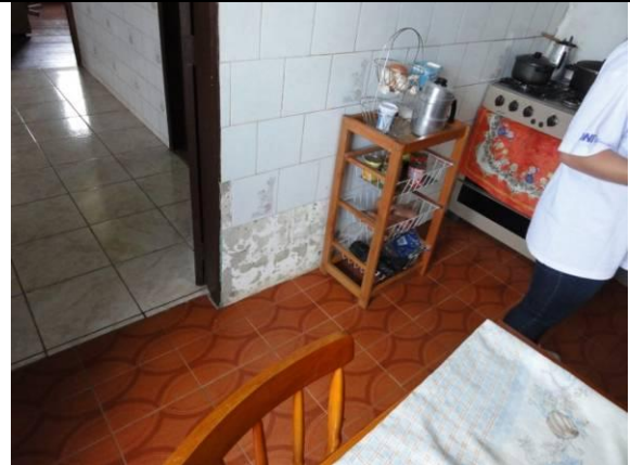
Azulejos faltantes (DSC00153, 15/02/2011, 13:59h)
