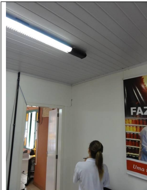
Sala 2 – Rachadura próximo a porta (DSC01852, 18/02/2011, 08:01h)
