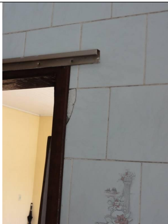
Cozinha - Rachadura no azulejo próximo a porta (DSC00149, 15/02/2011, 13:58h)
