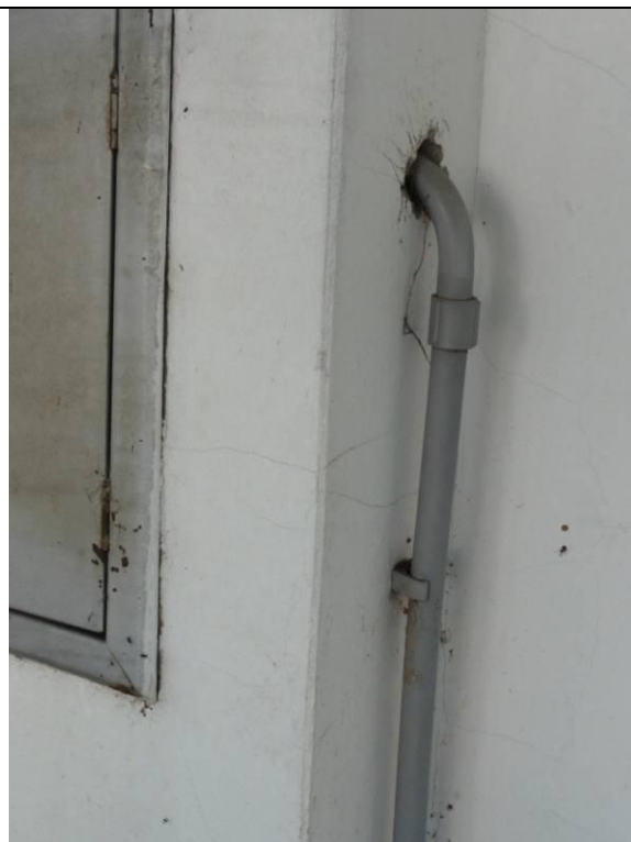
Lateral B – Leves fissuras no reboco (DSC00520, 16/02/2011, 08:22h)
