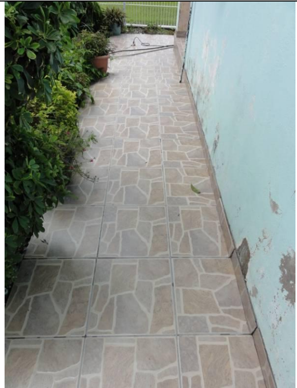
Tinta e reboco descascando (DSC00111, 15/02/2011, 13:51h)
