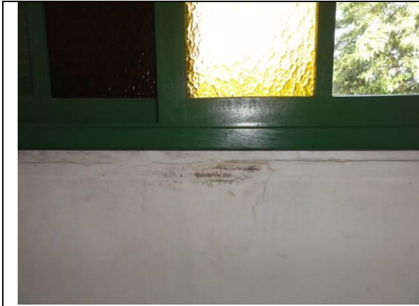
Sala 4 – Paredes com umidade, mofo próximo a janela (DSC01890, 18/02/2011, 08:13h)
