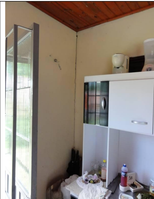
Rachadura divisória parede 2 e 3 (DSC00039, 15/02/2011, 13:29h)
