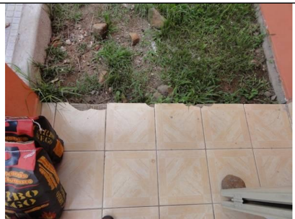
Entrada com piso cerâmico, alguns rachados (DSC00213, 15/02/2011, 14:19h)
