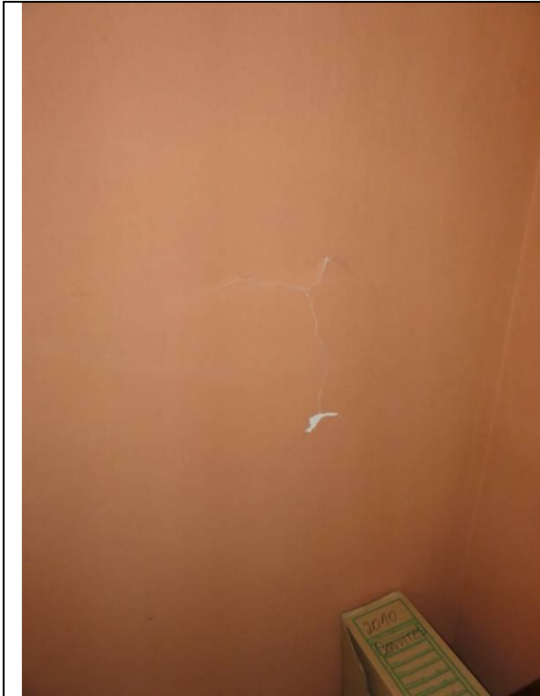
Parte Superior – Sala 3 - Fissura no reboco (DSC02058, 18/02/2011, 08:58h)
