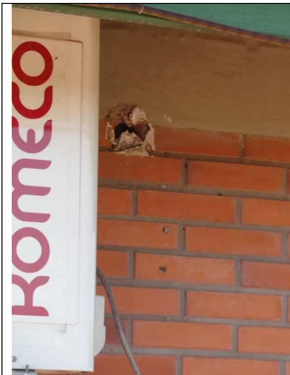
Parte Superior – Sacada- Parede com buraco próximo ao ar condicionado (DSC02044, 18/02/2011, 08:53h)
