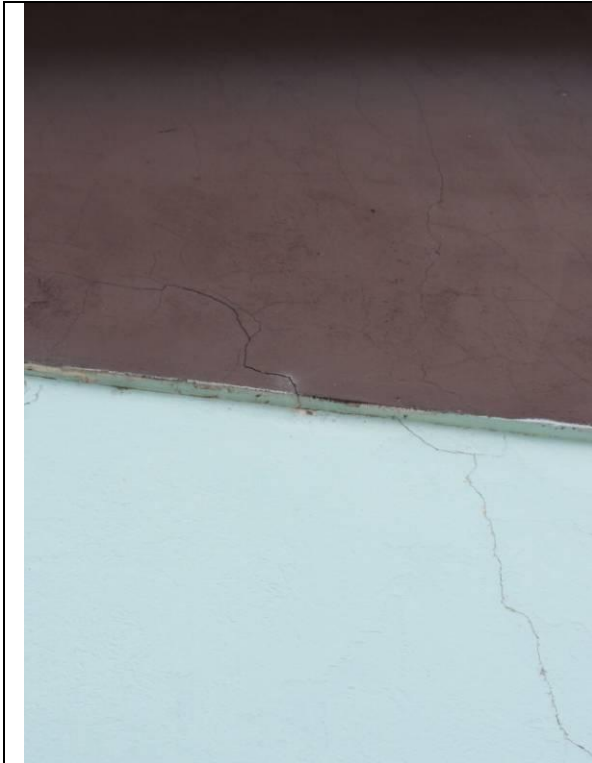
Fissura no reboco – Parede A (DSC00132, 15/02/2011, 13:54h)
