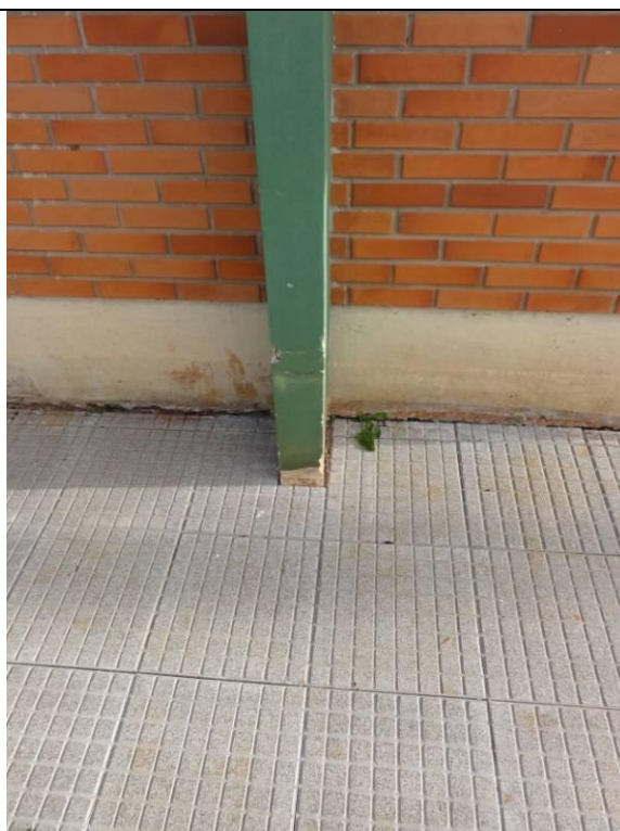
Coluna ruptura da estrutura (DSC01799, 18/02/2011, 07:50h)
