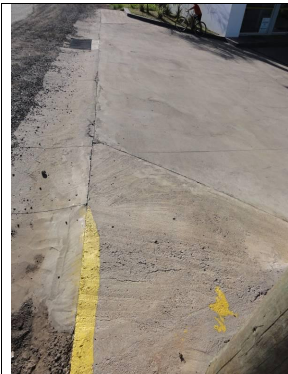
Calçada pavimentada com cimento com algumas rachaduras (DSC00441, 16/02/2011, 07:52h)
