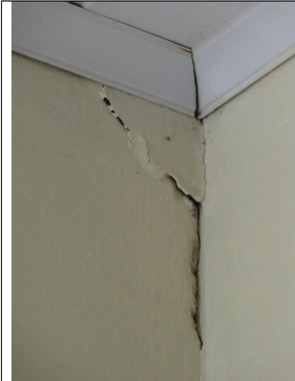
Sala 6 – Parede com reboco rachado e caindo (DSC01996, 18/02/2011, 08:42h)
