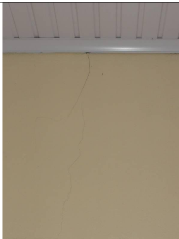
Quarto 3 – Fissura no reboco próximo ao teto (DSC00188, 15/02/2011, 14:06h)
