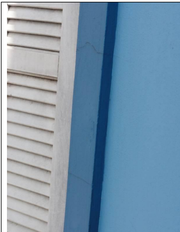
Apto 307 – Sacada – Parede com rachadura no reboco (DSC00259, 15/02/2011, 15:03h)
