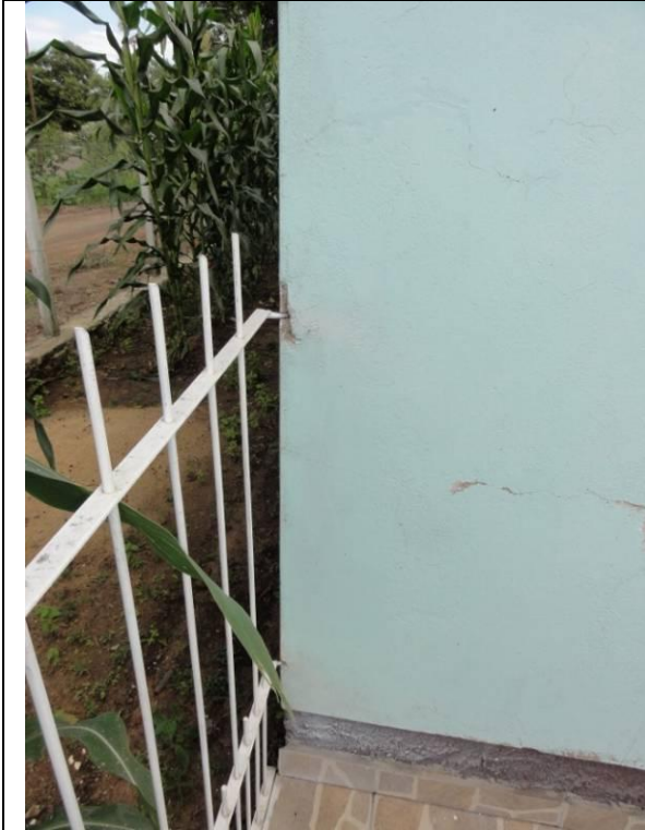
Parede externa – fissuras no reboco (DSC00124, 15/02/2011, 13:53h)
