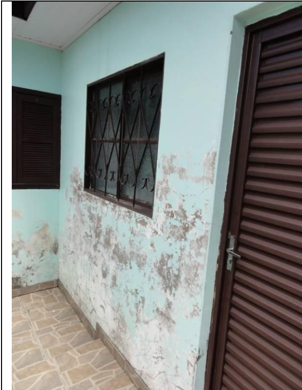
Parede A – Umidade , mofo e tinta descascando (DSC00100, 15/02/2011, 13:50h)
