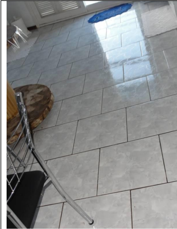
Apto 303 – Piso cerâmico (DSC01729, 17/02/2011, 16:37h)
