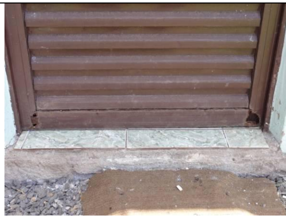
Buraco Porta de entrada – fachada (DSC00037, 15/02/2011, 13:29h)
