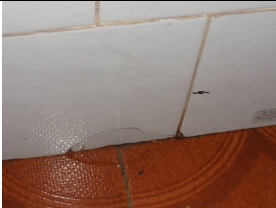
Rachadura no azulejo da cozinha (DSC00152, 15/02/2011, 13:59h)
