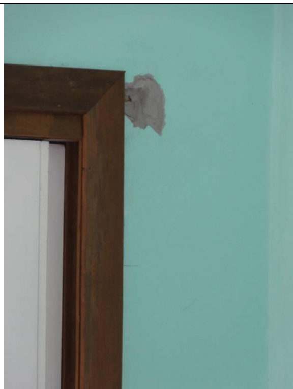
Apto 307 – Quarto – Buraco no reboco próximo a porta (DSC00275, 15/02/2011, 15:10h)
