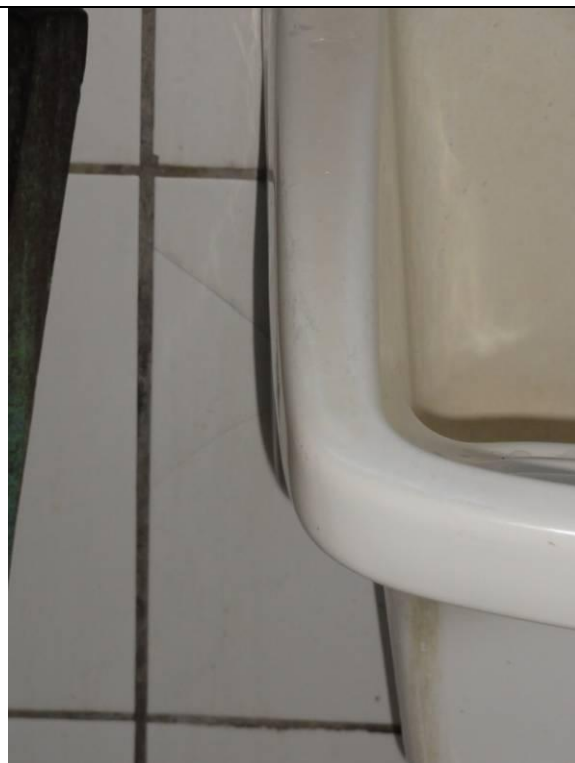
Cozinha – azulejo rachado (DSC01935, 18/02/2011, 08:28h)
