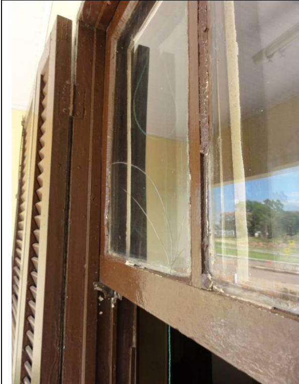
Janela com vidro trincado (DSC00136, 15/02/2011, 13:55h)
