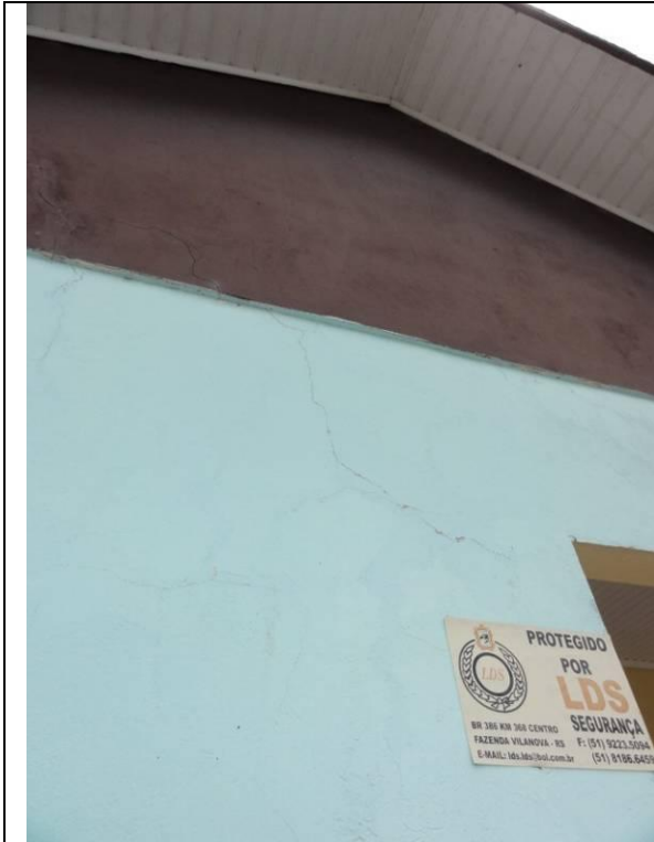
Fissura no reboco – Parede A (DSC00130, 15/02/2011, 13:54h)
