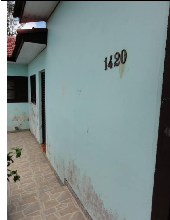
Fachada com bastante umidade (DSC00098, 15/02/2011, 13:50h)
