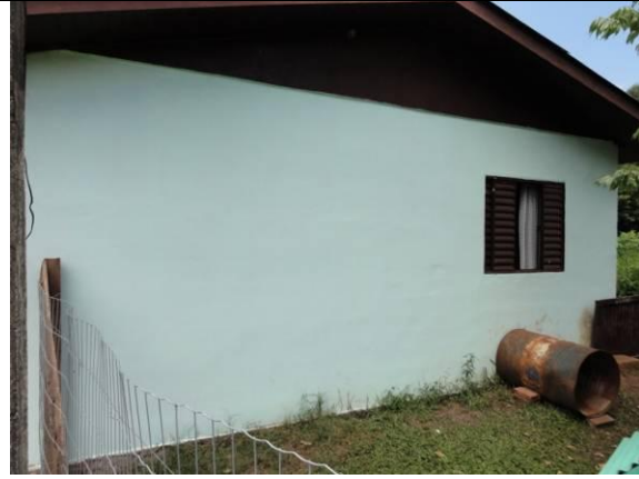
Lateral externa – parede B (DSC00007, 15/02/2011, 14:12h)
