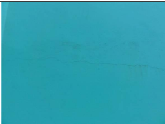
Apto 307 – Fissura no reboco (DSC00290, 15/02/2011, 15:12h)
