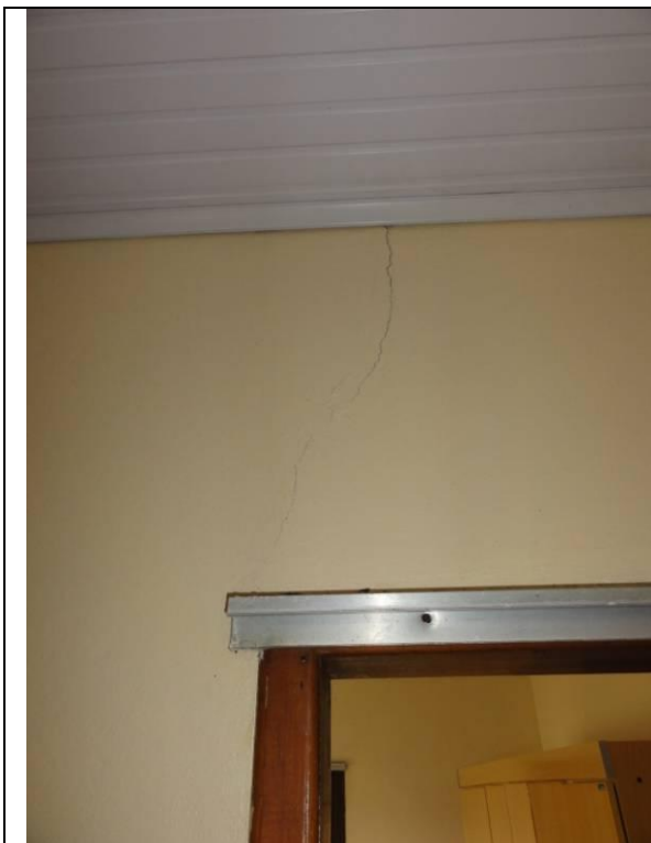
Quarto 2 – Fissura no reboco próximo a porta (DSC00183, 15/02/2011, 14:05h)
