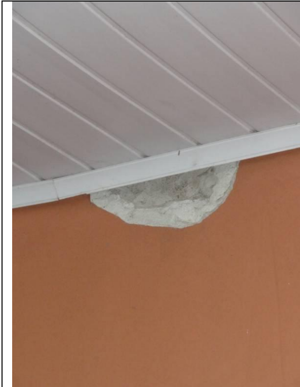
Sala de eventos - Parede com buraco no reboco (DSC01944, 18/02/2011, 08:30h)
