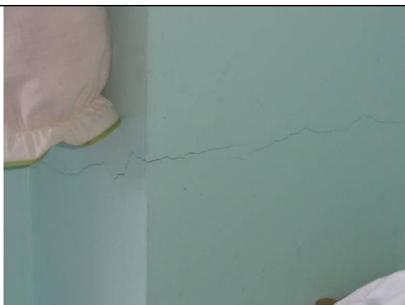
Apto 301 – Cozinha – Fissura no reboco (DSC02084, 18/02/2011, 09:09h)
