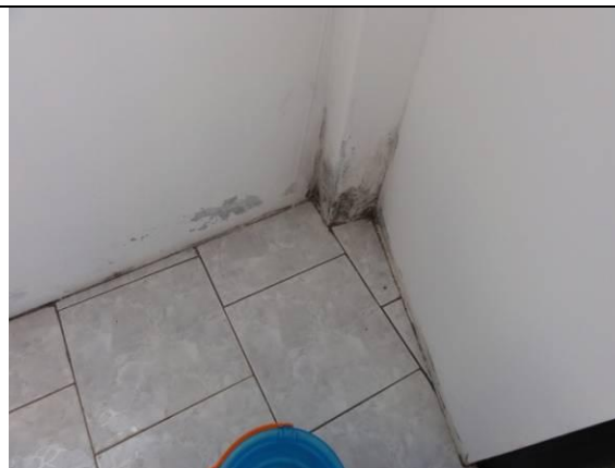
Sala 208 – Umidade, tinta descascado (DSC00344, 15/02/2011, 15:32h)
