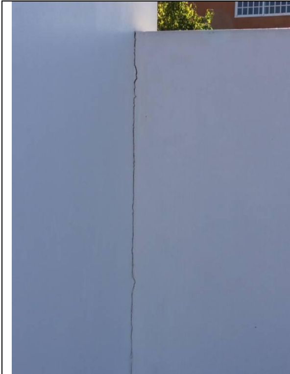
Lateral B – Rachadura para Lateral C (DSC00461, 16/02/2011, 07:57h)
