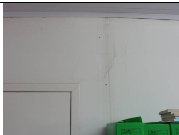
Sala 2 – Fissura no reboco (DSC01871, 18/02/2011, 08:07h)
