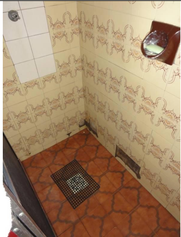
Azulejos faltantes no banheiro (DSC00162, 15/02/2011, 14:01h)
