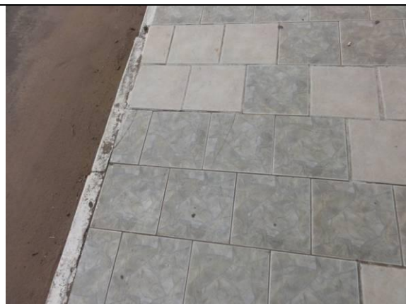
Calçada em torno do prédio – Piso cerâmico quebrado (DSC00394, 15/02/2011, 15:51h)
