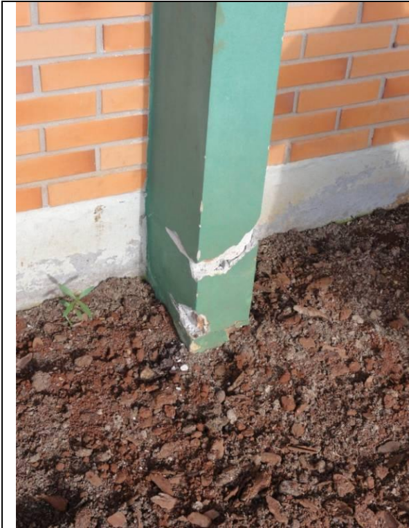
Coluna ruptura da estrutura (DSC01802, 18/02/2011, 07:50h)
