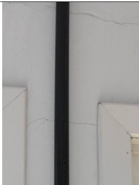
Parte Superior – Sala 3 - Fissura no reboco próximo a porta (DSC02053, 18/02/2011, 08:56h)
