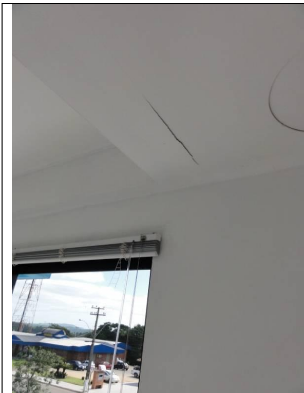
Sala 208 – Fissuras no teto com reboco e tinta descascando (DSC00339, 15/02/2011, 15:31h)
