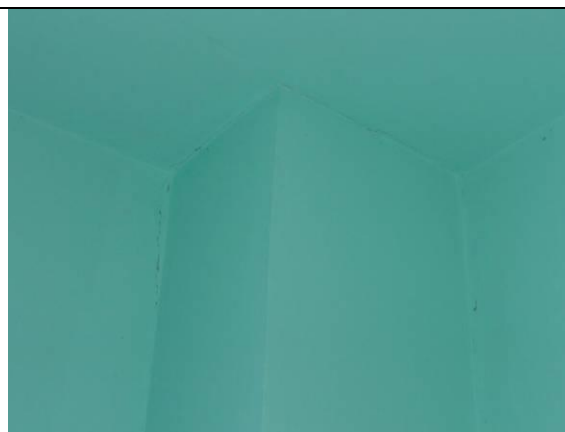
Apto 301 – Cozinha – Fissura no reboco (DSC02085, 18/02/2011, 09:09h)
