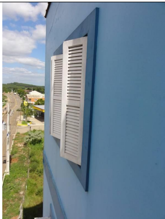
Apto 307 – Sacada – Parede com rachadura no reboco (DSC00260, 15/02/2011, 15:03h)
