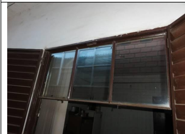
Lateral D – Fissura no reboco próximo a janela (DSC00545, 16/02/2011, 08:28h)
