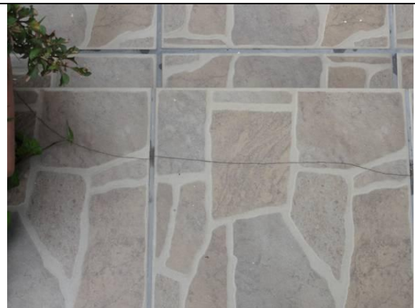
Calçada de piso cerâmico rachado (DSC00115, 15/02/2011, 13:52h)
