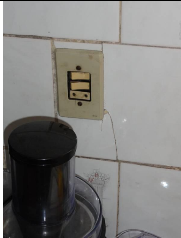
Leve rachadura no azulejo da cozinha (DSC00151, 15/02/2011, 13:59h)
