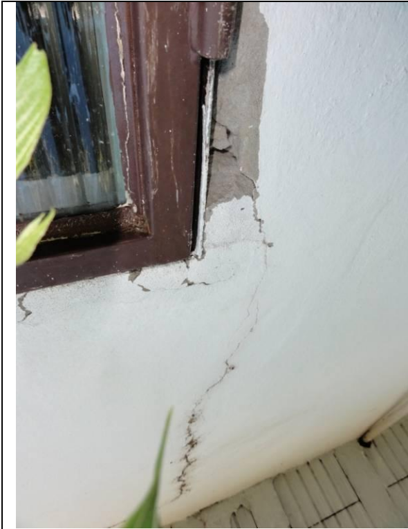
Fundos – Portão – Fissura no reboco (DSC00531, 16/02/2011, 08:26h)
