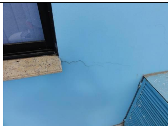
Sala 201 – Sacada – Fissura no reboco (DSC00374, 15/02/2011, 15:45h)
