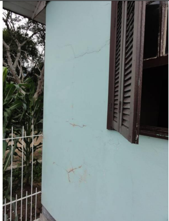
Parede externa – algumas fissuras no reboco (DSC00123, 15/02/2011, 13:53h)
