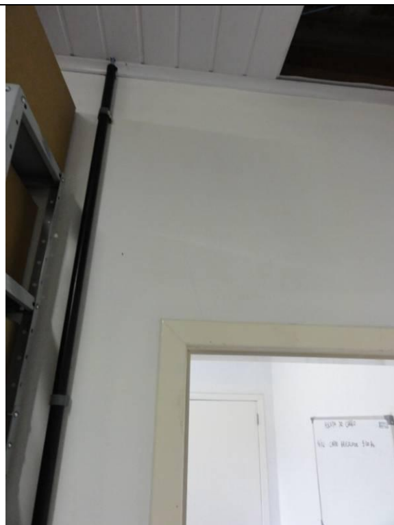
Sala 3 – Fissura no reboco da parede próximo a porta (DSC01885, 18/02/2011, 08:12h)
