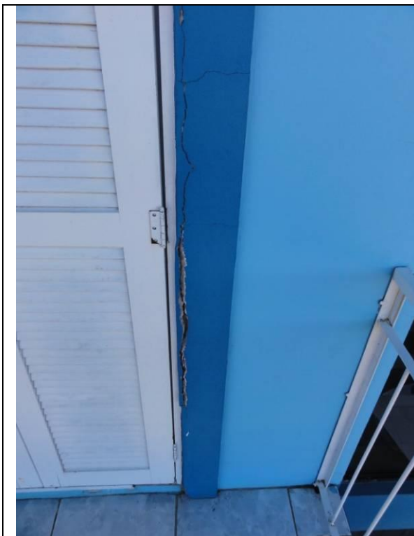
Apto 304 – Sacada – Rachadura no reboco próxima a porta (DSC02179, 18/02/2011, 09:33h)
