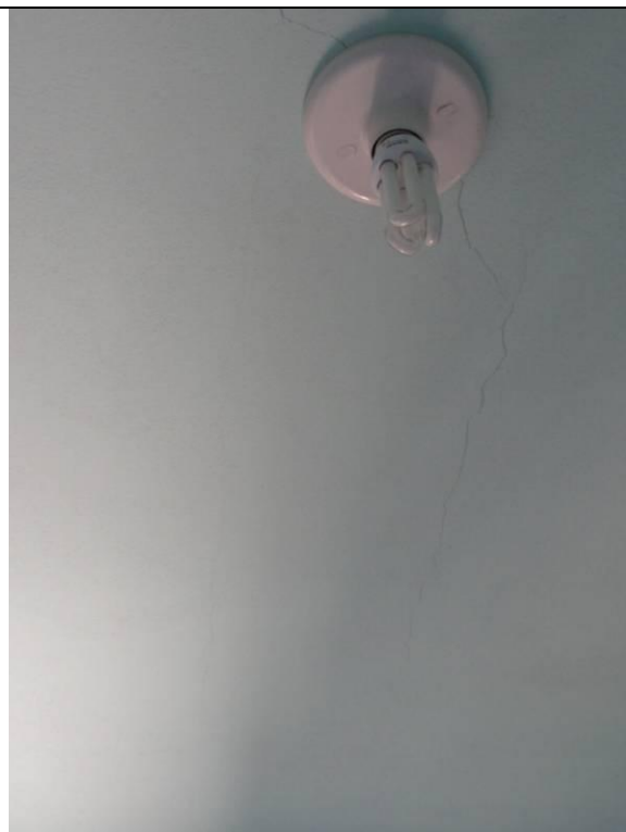
Apto 301 – Quarto – Teto com fissura no reboco (DSC02113, 18/02/2011, 09:15h)
