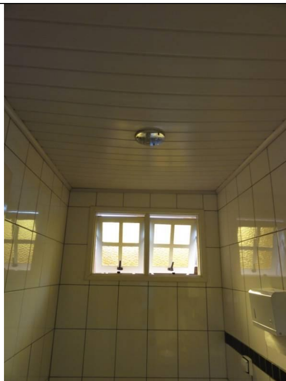
Parte superior – Sala 1 - Banheiro (DSC02019, 18/02/2011, 08:47h)
