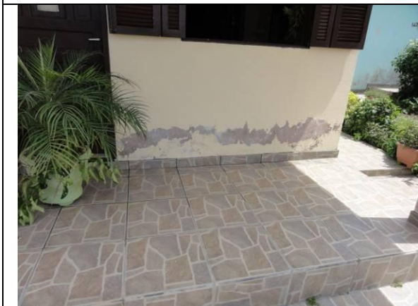
Tinta descascando- Varanda (DSC00134, 15/02/2011, 13:54h)
