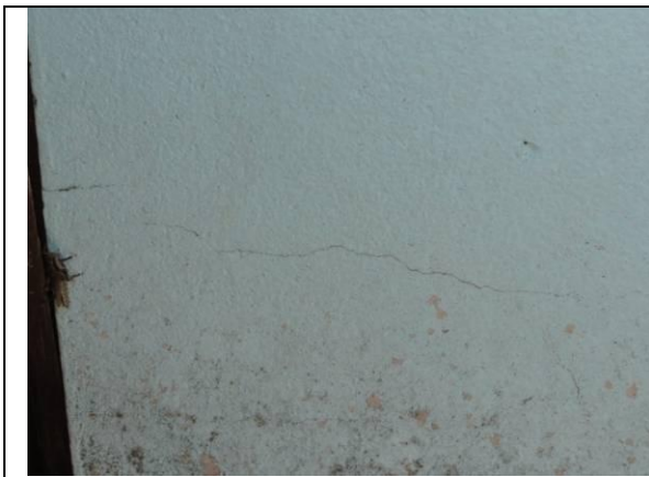
Parede Externa C - fissura no reboco (DSC00022, 15/02/2011, 14:17h)
