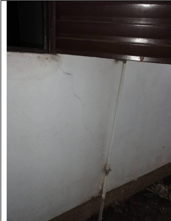
Lateral D – Fissuras no reboco próximo a janela (DSC00551, 16/02/2011, 08:30h)
