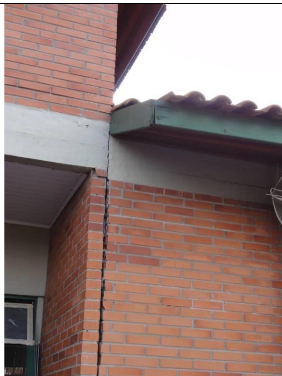
Rachadura nos tijolos entre a divisória das construções - Lateral esquerda (DSC01783, 18/02/2011, 07:46h)
