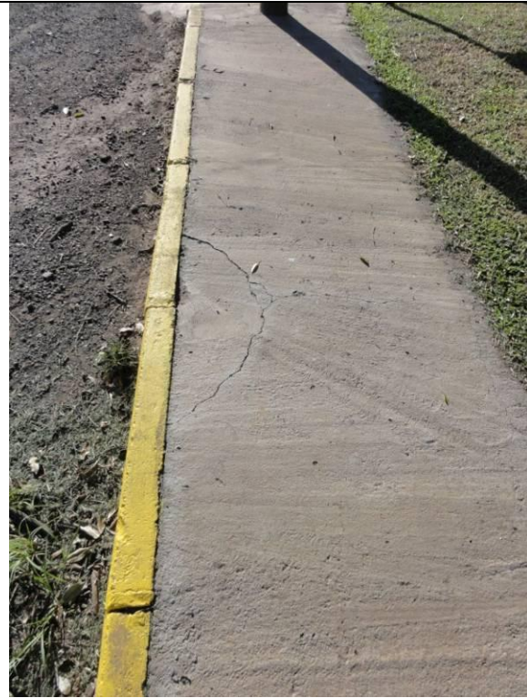
Calçada pavimentada com cimento com algumas rachaduras (DSC00438, 16/02/2011, 07:51h)
