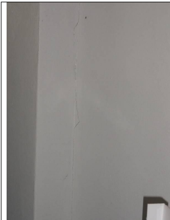
Sala 3 – Térreo – Fissura no reboco próximo a janela (DSC00418, 15/02/2011, 16:00h)
