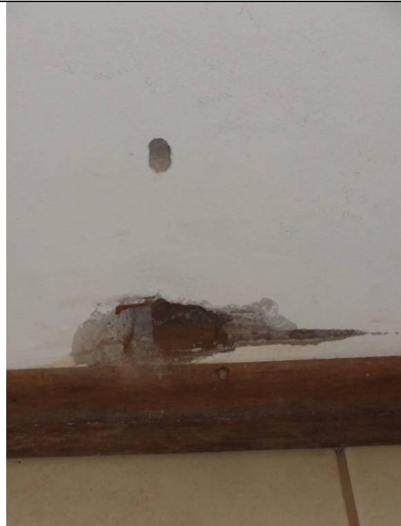
Sala 6 – buraco no reboco (DSC01961, 18/02/2011, 08:34h)
