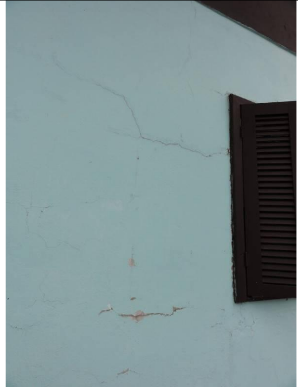
Parede externa – fissuras no reboco (DSC00125, 15/02/2011, 13:53h)
