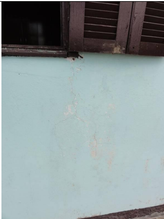
Umidade e tinta descascando – Parede externa (DSC00128, 15/02/2011, 13:54h)
