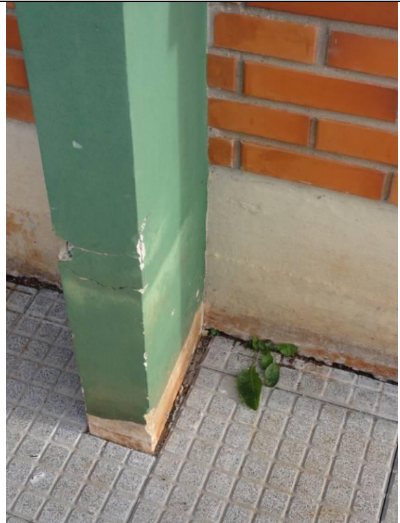
Coluna ruptura da estrutura (DSC01801, 18/02/2011, 07:50h)
