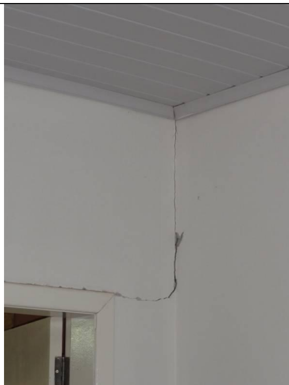
Sala 2 – Rachadura próximo a porta (DSC01853, 18/02/2011, 08:01h)
