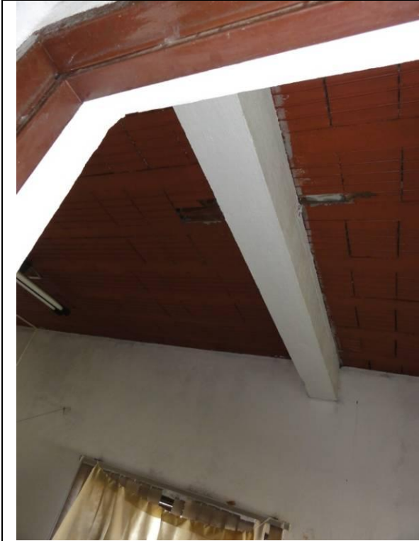
Teto cedendo (DSC00587, 16/02/2011, 08:39h)
