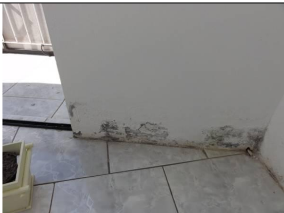
Sala 208 – Umidade, tinta descascado (DSC00343, 15/02/2011, 15:32h)
