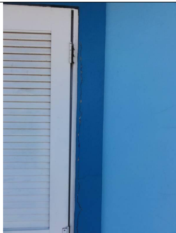
Apto 304 – Sacada – Rachadura no reboco próxima a porta (DSC02180, 18/02/2011, 09:33h)
