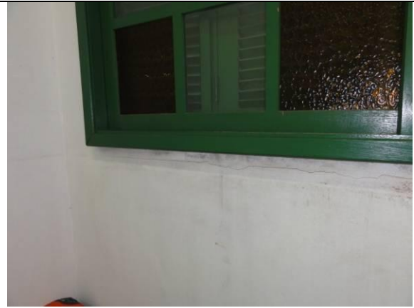
Sala 4 – Paredes com umidade, mofo próximo a janela (DSC01891, 18/02/2011, 08:13h)
