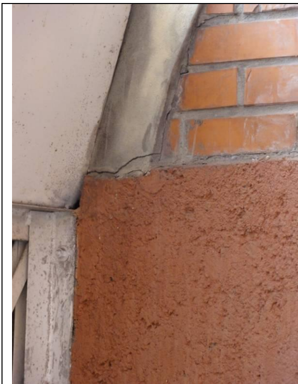
Parte superior – Fissura no reboco (DSC02012, 18/02/2011, 08:45h)
