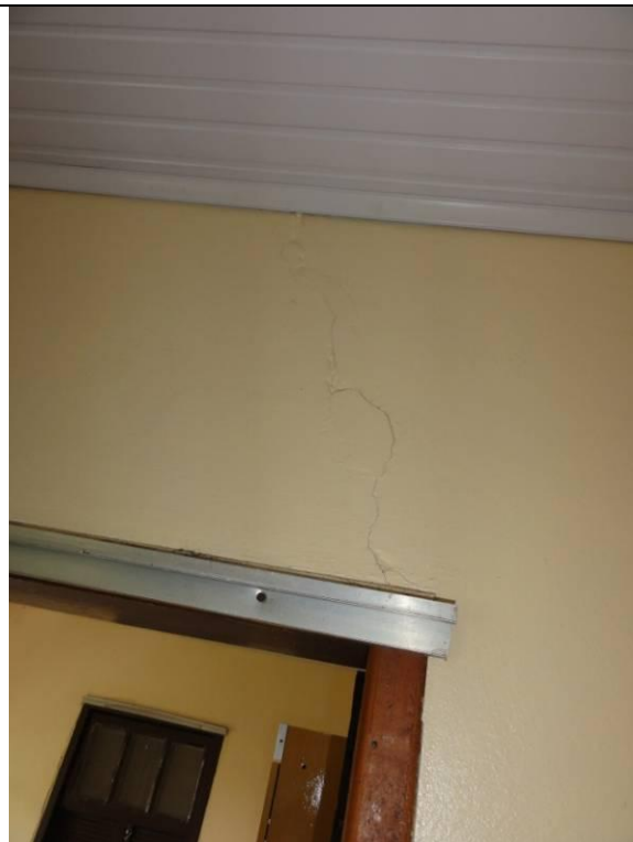
Quarto 2 – Fissura no reboco próximo a porta (DSC00182, 15/02/2011, 14:05h)
