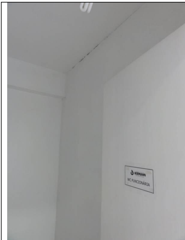
Sala 208 – Banheiro – Fissura no reboco na divisão das paredes (DSC00335, 15/02/2011, 15:30h)
