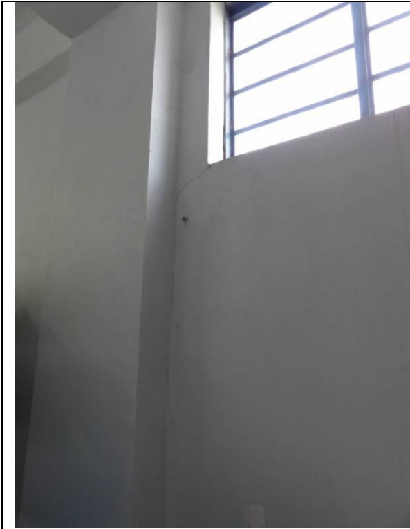
Sala 3 – Térreo – Fissura no reboco próximo a janela (DSC00416, 15/02/2011, 16:00h)
