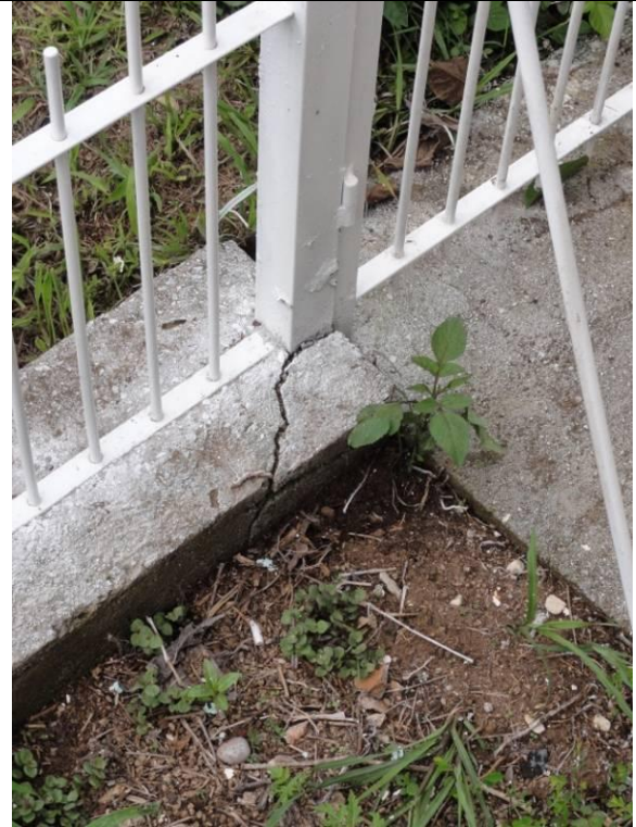
Reboco rachada – portão de entrada (DSC00119, 15/02/2011, 13:52h)
