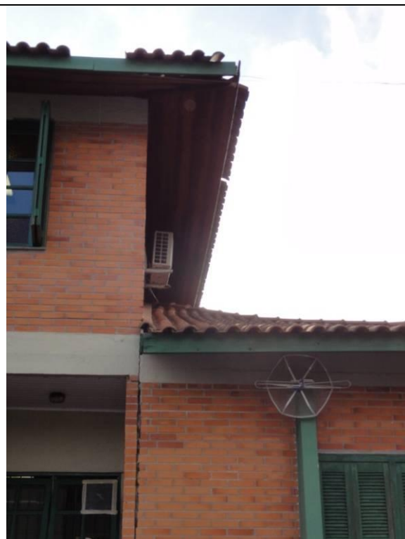
Rachadura nos tijolos entre a divisória das construções - Lateral esquerda (DSC01783, 18/02/2011, 07:46h)
