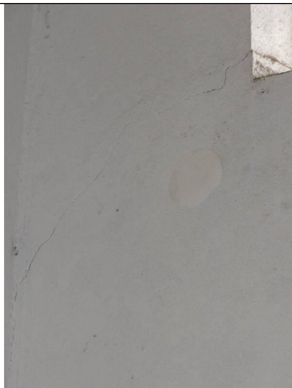
Sala 3 – Térreo – Fissura no reboco (DSC00421, 15/02/2011, 16:01h)
