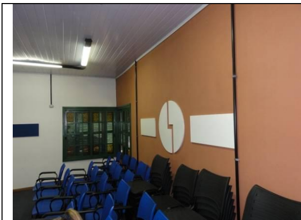
Sala de eventos – forro PVC cedendo (DSC01948, 18/02/2011, 08:31h)
