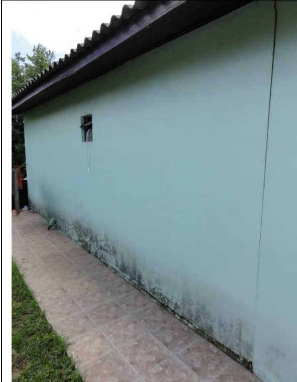
Parede externa fundos – Mofo e umidade (DSC00014, 15/02/2011, 14:15h)
