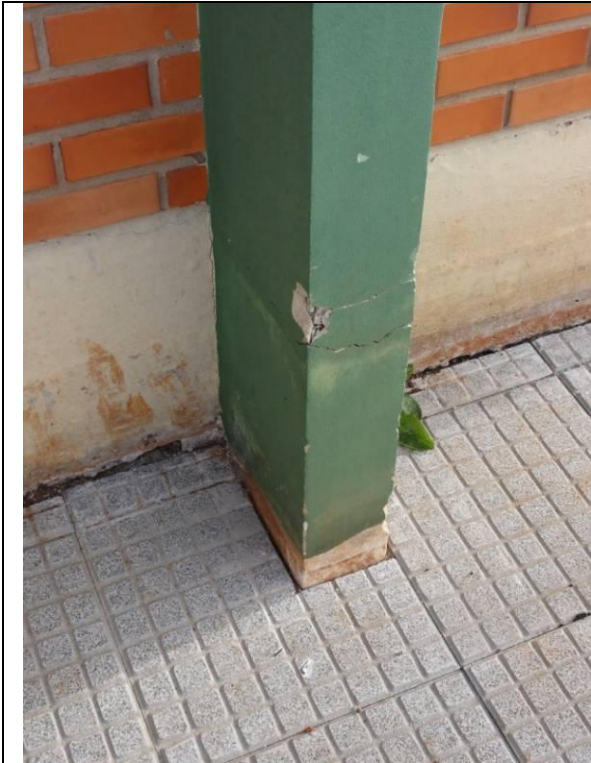
Coluna ruptura da estrutura (DSC01800, 18/02/2011, 07:50h)
