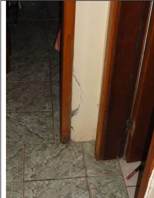
Desgaste no reboco entrada porta banheiro (DSC00060, 15/02/2011, 13:36h)
