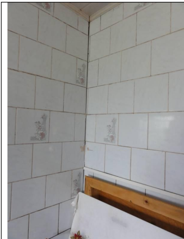
Cozinha – Rachadura na divisória entre as paredes 12 e 13 (DSC00148, 15/02/2011, 13:58h)
