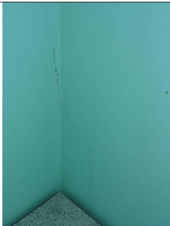
Apto 301 – Cozinha – Fissura no reboco (DSC02087, 18/02/2011, 09:10h)
