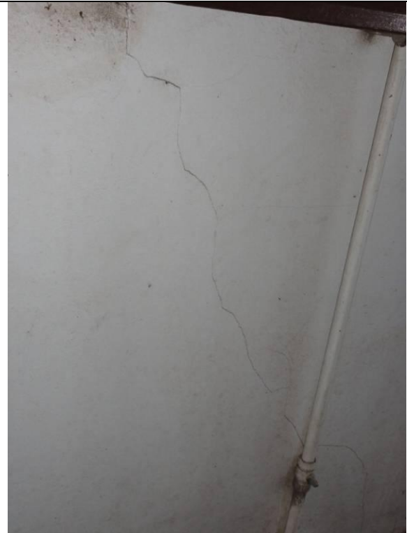
Lateral D – Fissuras no reboco próximo a janela (DSC00552, 16/02/2011, 08:30h)
