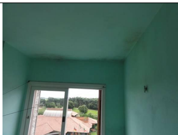
Apto 307 – Banheiro – Teto com umidade e mofo (DSC00313, 15/02/2011, 15:17h)
