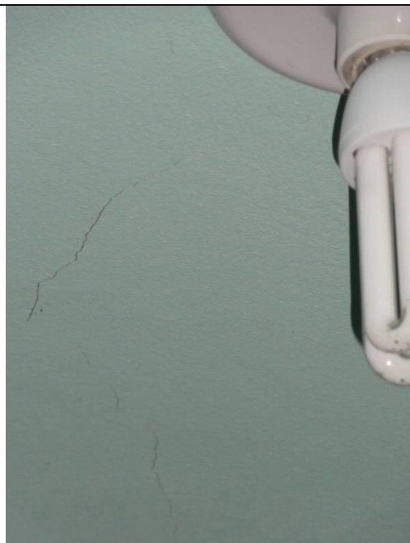
Apto 301 – Sala – Teto com fissuras no reboco (DSC02081, 18/02/2011, 09:08h)
