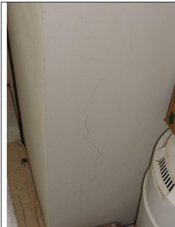
Apto 307 – Area de Serviço – Fissura no reboco (DSC00270, 15/02/2011, 15:07h)
