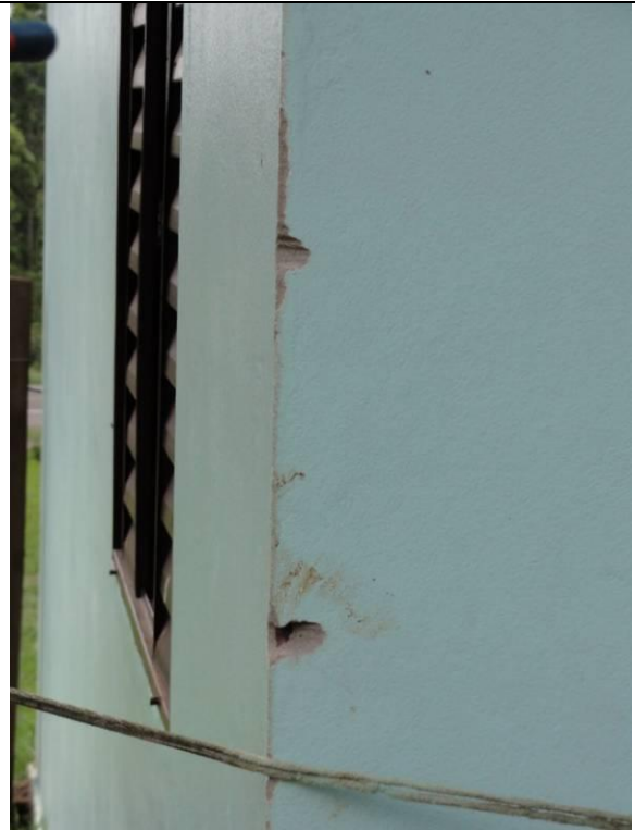
Parede C- reboco com buraco (DSC00017, 15/02/2011, 14:16h)
