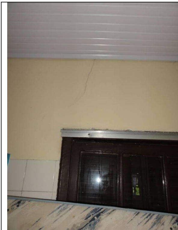
Sala – Fissura no reboco próxima ao teto (DSC00171, 15/02/2011, 14:03h)
