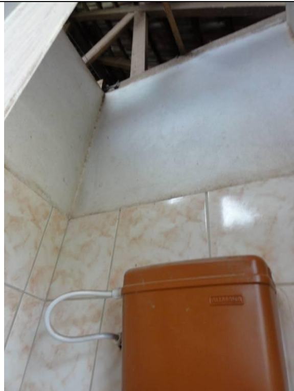
Banheiro (DSC00221, 15/02/2011, 14:21h)
