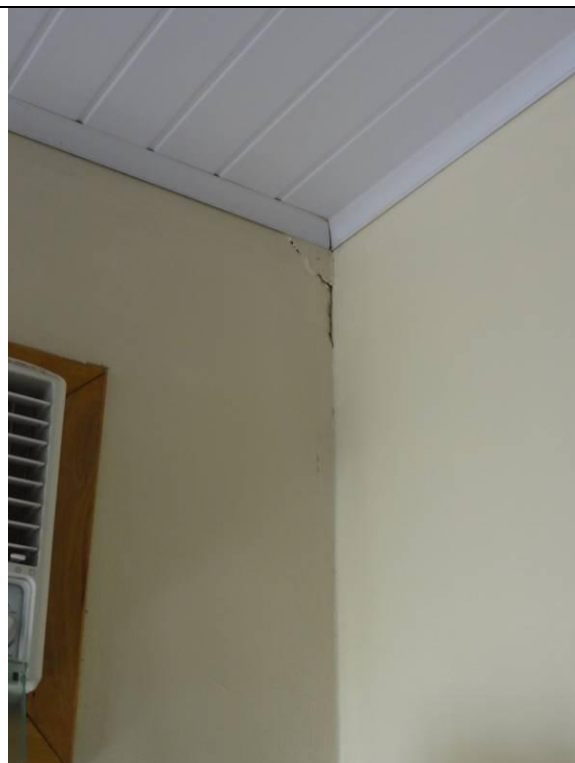
Sala 6 – Parede com reboco rachado e caindo (DSC01995, 18/02/2011, 08:42h)
