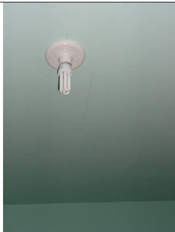
Apto 301 – Sala – Teto com fissuras no reboco (DSC02079, 18/02/2011, 09:08h)
