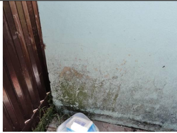
Parede D – umidade e mofo (DSC00021, 15/02/2011, 14:17h)
