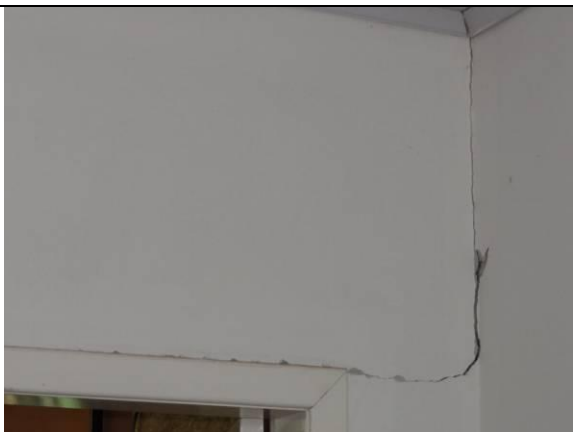
Sala 2 – Rachadura próximo a porta (DSC01854, 18/02/2011, 08:01h)
