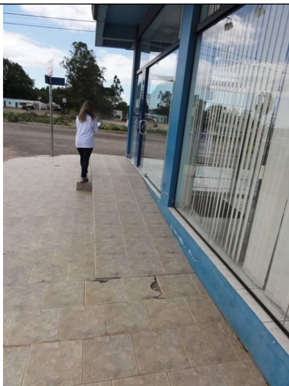
Calçada em torno do prédio – Piso cerâmico quebrado (DSC00395, 15/02/2011, 15:51h)
