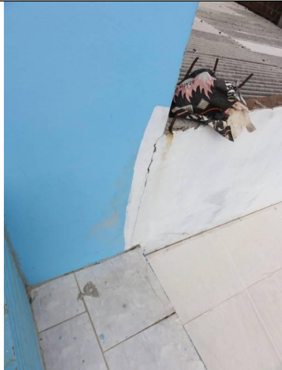
Sala 201 – Sacada – Fissura no reboco (DSC00376, 15/02/2011, 15:45h)
