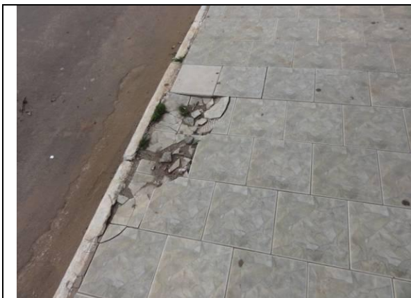
Calçada em torno do prédio – Piso cerâmico quebrado (DSC00393, 15/02/2011, 15:51h)
