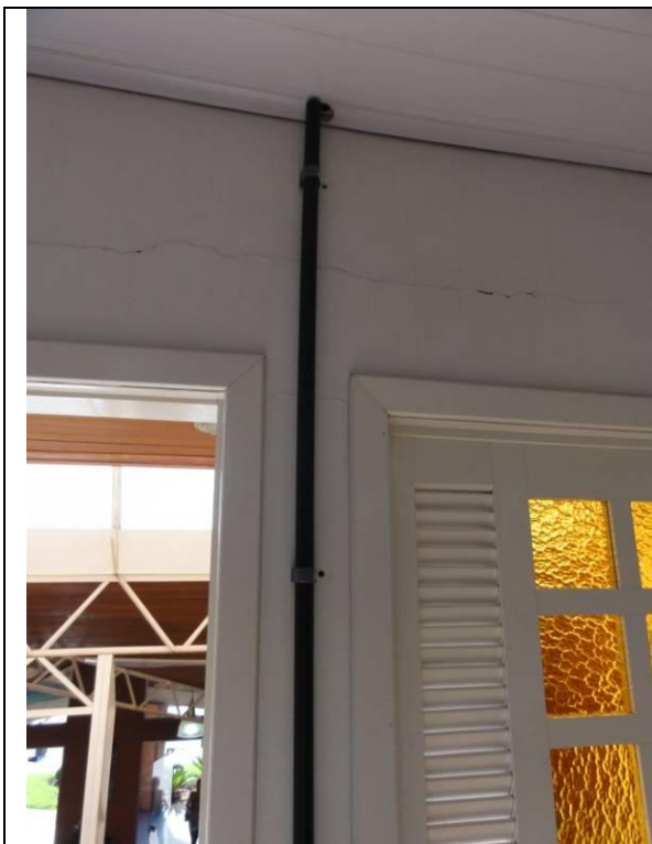
Parte Superior – Sala 3 - Fissura no reboco próximo a porta (DSC02052, 18/02/2011, 08:56h)
