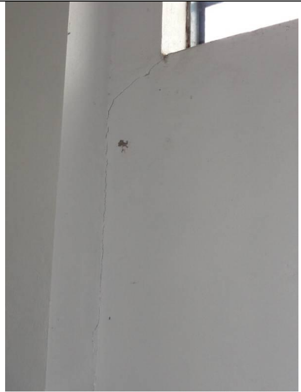
Sala 3 – Térreo – Fissura no reboco próximo a janela (DSC00417, 15/02/2011, 16:00h)
