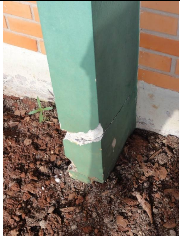
Coluna ruptura da estrutura (DSC01803, 18/02/2011, 07:50h)
