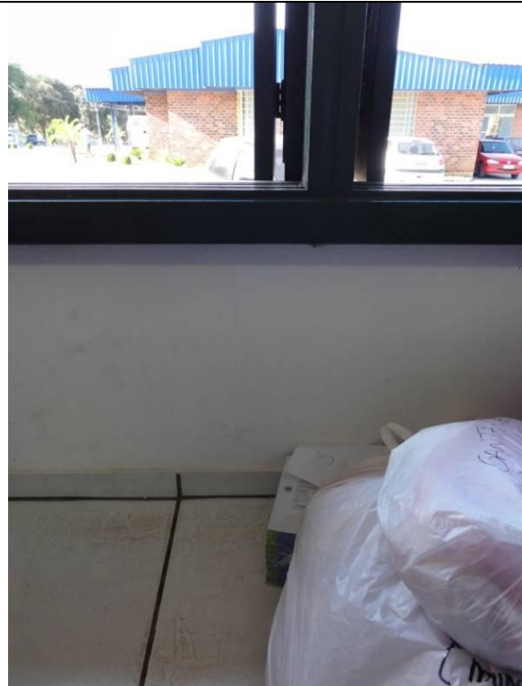
Sala 6 – parede com umidade (DSC01991, 18/02/2011, 08:41h)
