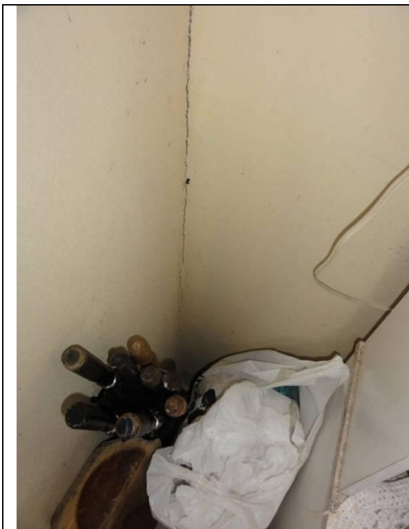
Rachadura divisória entre paredes 2 e 3 (DSC00040, 15/02/2011, 13:30h)
