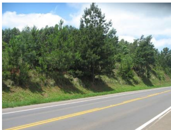
Figura 369 – Deslizamento parcialmente estabilizado
