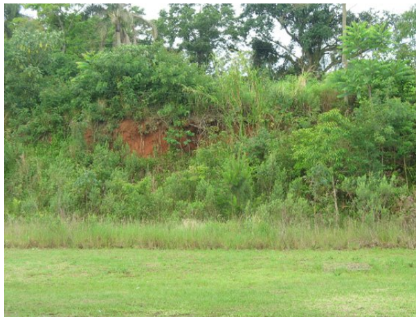
Figura 366 – Encosta com solo exposto na porção erodida
