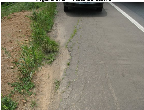
Figura 373 – Detalhe das trincas no asfalto
