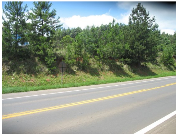
Figura 368 – Passivo nº 04: deslizamento parcialmente estabilizado
