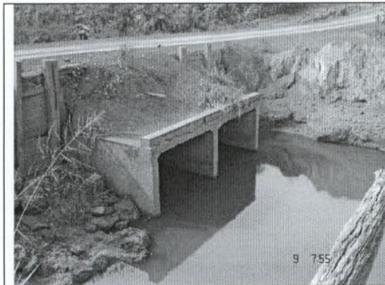
- Foto 03 - Drenagem interceptada pelo eixo da rodovia.
