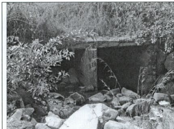
- Foto 05 - Drenagem interceptada pelo eixo da rodovia.
