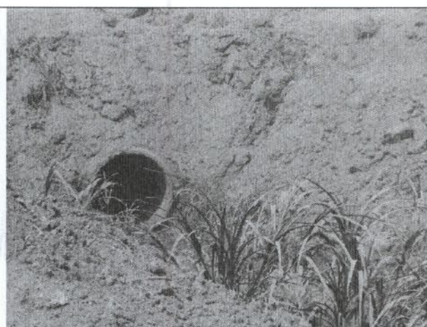
Foto 08 – Obra de arte obstruída por sedimento.
