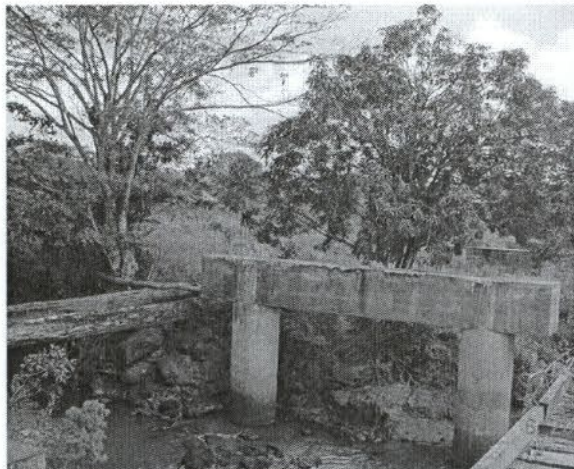
FIGURA 74 – Antiga ponte sobre o Rio Penetecal II à esquerda da rodovia – km 54+900.
