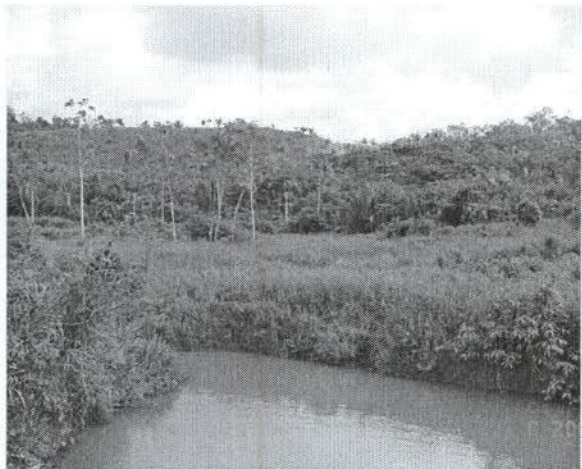
FIGURA 61 – Transposição de curso d'água por bueiro, com alagamento – lado direito – km 37+800 – Ponto 37 GPS.
