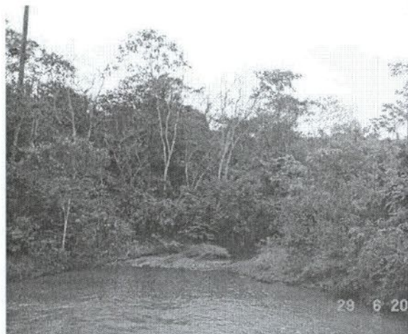
FIGURA 78 – Alagamento à direita da rodovia no local de rompimento de bueiro – km 57+100 – Ponto 52 GPS.
