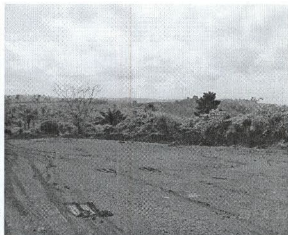
FIGURA 33 – Área de empréstimo utilizada na conserva da rodovia – lado esquerdo – km 12+900 – Ponto 15 GPS.
