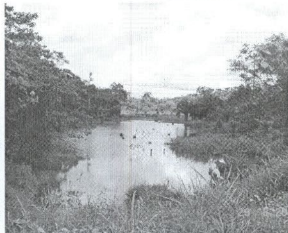
FIGURA 79 – Alagamento à esquerda da rodovia no local de rompimento de bueiro – km 57+100 – Ponto 52 GPS.
