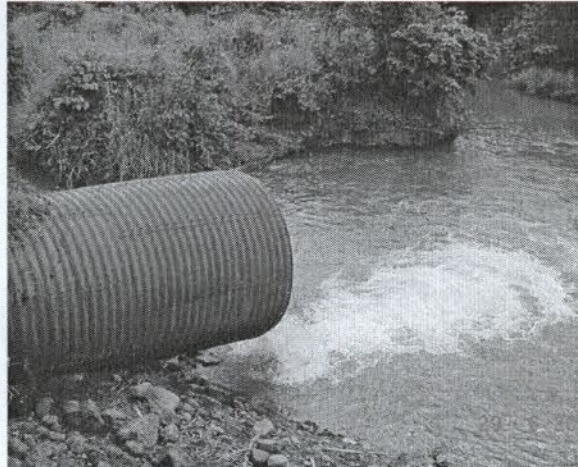
FIGURA 81 – Detalhe grande vazão de água pelo bueiro rompido à direita da rodovia – km 57+100 – Ponto 52 GPS.
