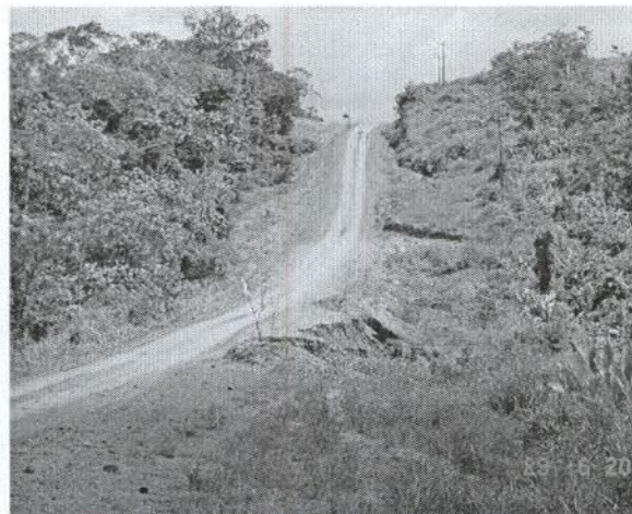
FIGURA 77 – Rompimento de bueiro à direita da rodovia no km 57+100 – Ponto 52 GPS. ←
