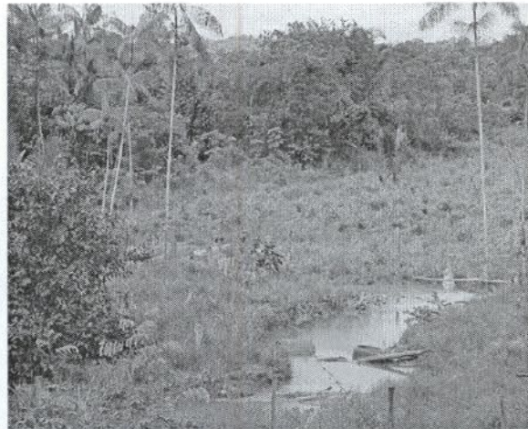
FIGURA 65 – Área onde houve rompimento de bueiro à direita da rodovia – km 43+100 – Ponto 40 GPS.
