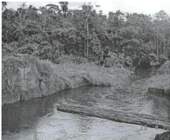
FIGURA 30 – Rio Panelas – lado direito – km 12+200. Notar erosão da margem e parte de estrutura de ponte antiga.
