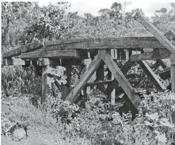
FIGURA 32 – Antiga ponte sobre o Rio Panelas, abandonada, atualmente em solo firme – lado direito.
