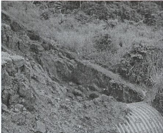
FIGURA 80 – Detalhe do bueiro rompido à direita da rodovia – km 57+100 – Ponto 52 GPS.
