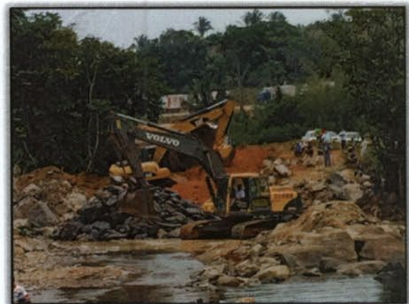
Foto 06 – Procedimentos para a instalação do bueiro armco. Lado Esquerdo. Margem esquerda. S 03°51'45,4" W 050°26'44,0" 17/12/2015
