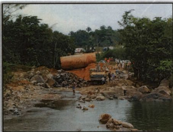
Foto 05 – Bueiro armco que será utilizado no desvio. Lado Esquerdo. Margem esquerda. S 03°51'45,4" W 050°26'44,0" 17/12/2015
