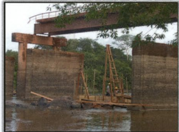
Foto 11 - Reforço da base intermediária da ponte de madeira a ser executada. Lado Direito. Margem esquerda. S 03°51'45,4" W 050°26'44,0" 05/01/2016
