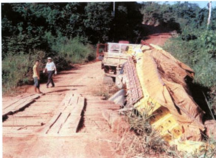
Foto 1 – Acidente causado por erosão nas cabeceiras da ponte envolvendo transporte de carga.
