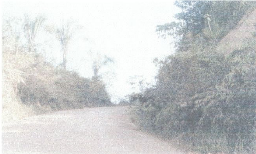
Vegetação nas Encostas dos Taludes.
