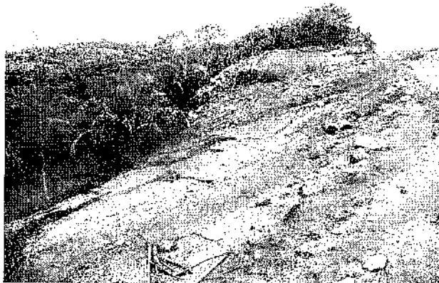
Lote 3: Processos erosivo e de assoreamento em trecho onde houve serviços de terraplenagem
