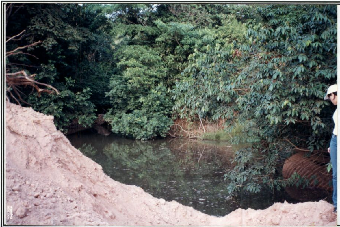
Foto 2 – Igarapé Novilha com fluxo reduzido (entrada) em função de execução de aterro para passagem de equipamento pesado para execução das obras.
