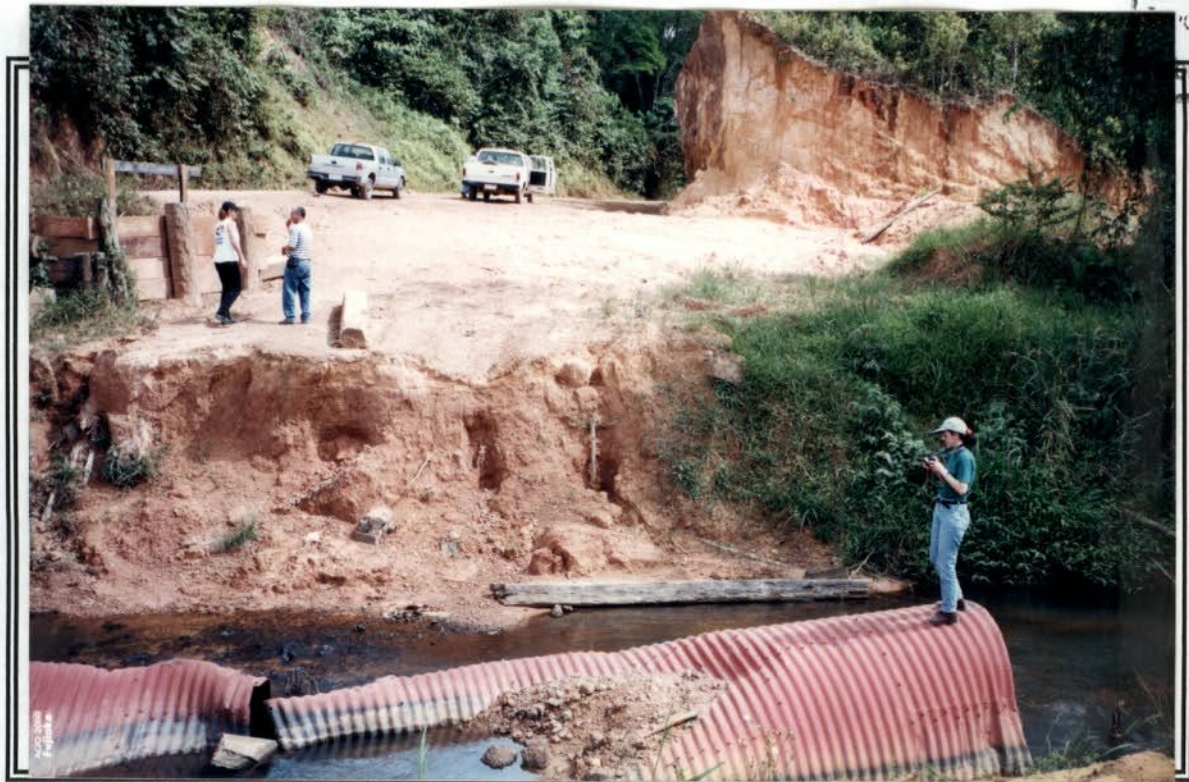
Foto 14 – Situação do leito do Igarapé.
