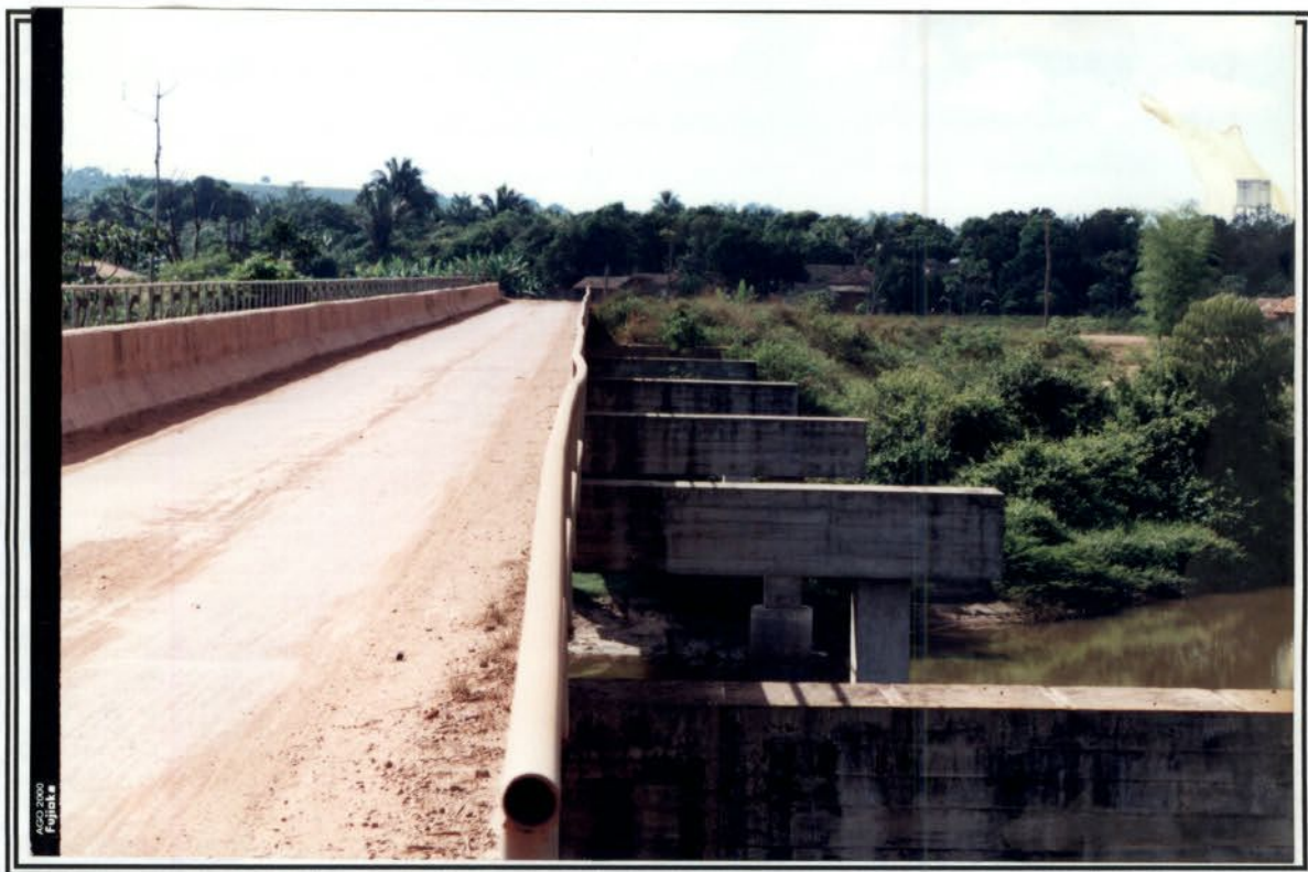
Foto 6 – Trecho entre Marabá e Novo Repartimento. Ponte em concreto, executada somente meia pista, com a estrutura pronta para alargamento.
