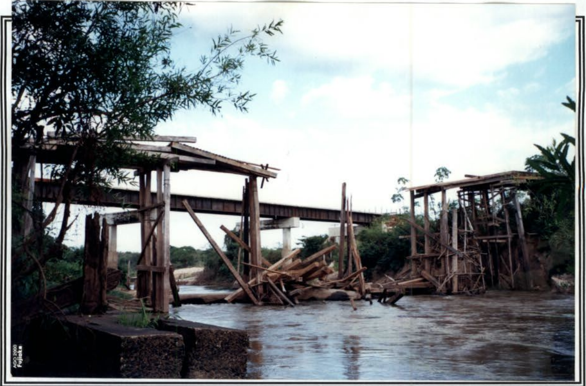
Foto 8 – Ponte de madeira derrubada pela força das águas e por balseiros. Observar ao fundo ponte de concreto em construção.
