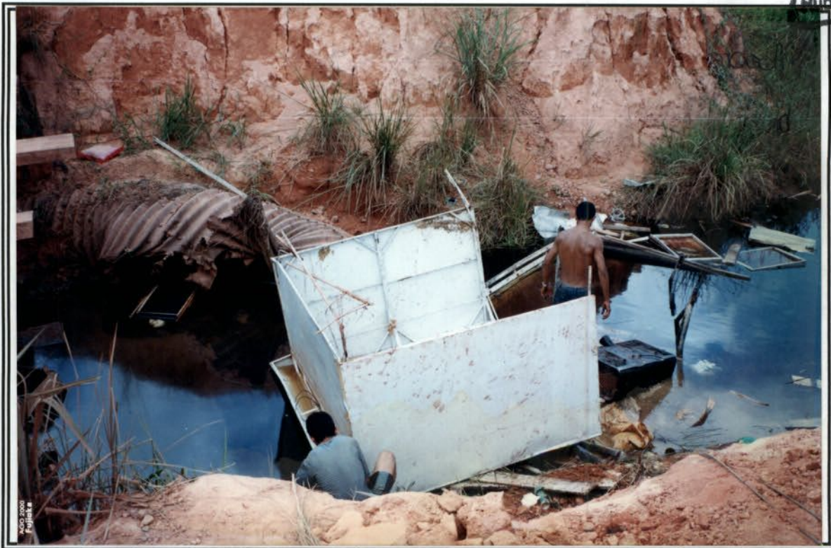
Foto 24 - Situação do leito do igarapé - Observar restos de bueiro ármico e carga de caminhão que tombou no local.
