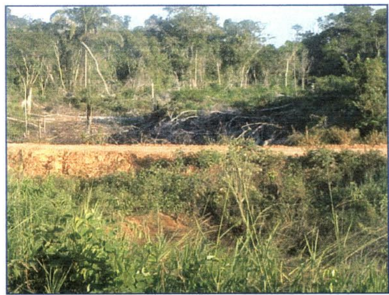
Foto 53: Km 562,80 Desvio feito, quando da reparação de ponte danificada, para transposição do Igarapé São Benedito.
