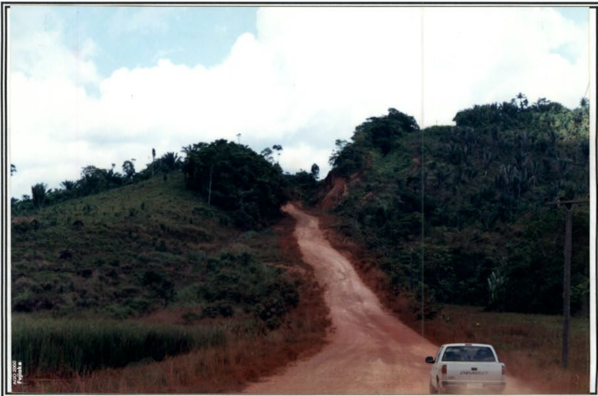
Foto 25 - Erosão na margem da rodovia por falta de direcionamento das águas.
