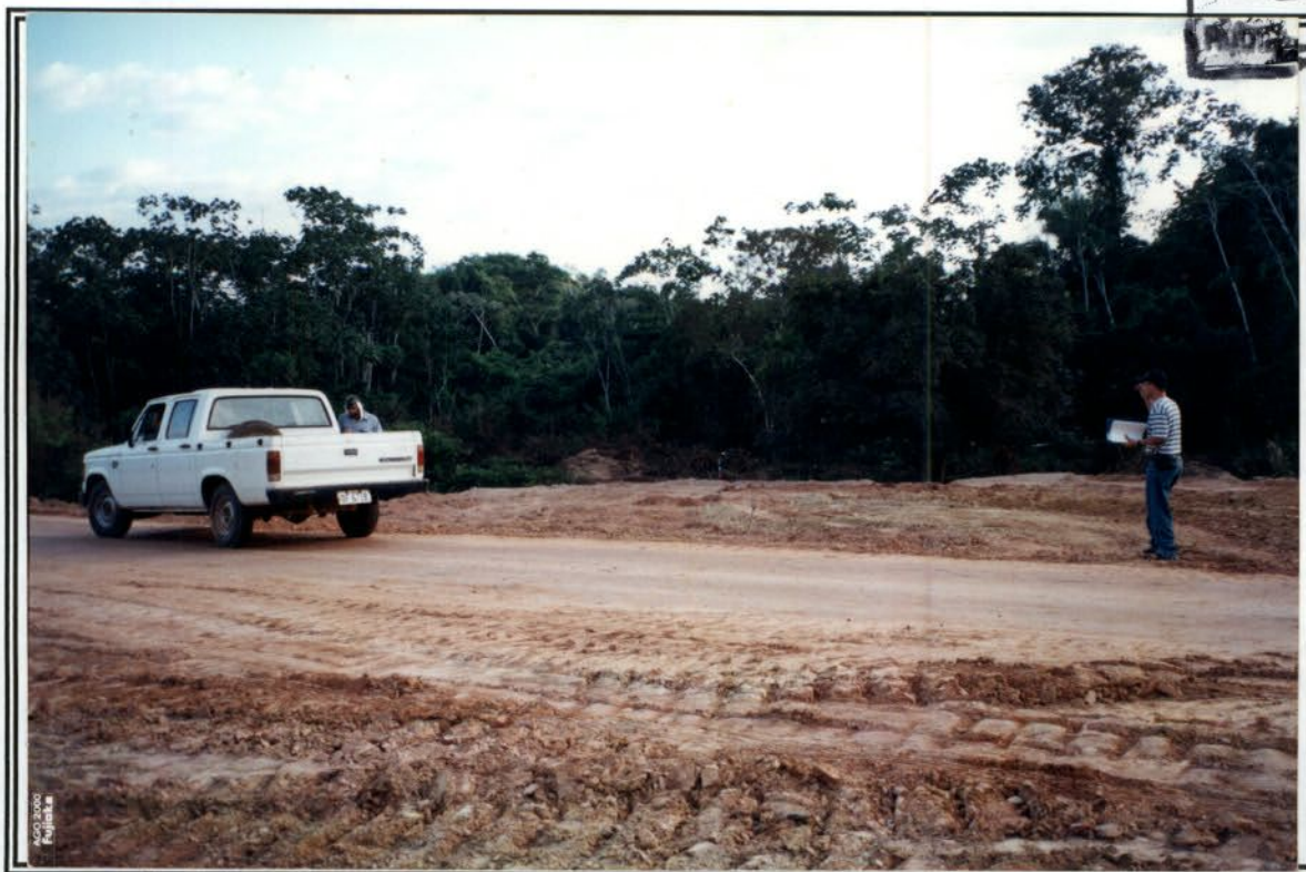
Foto 1 – Área de bota - fora próxima a curso d'água (trecho em obras).
