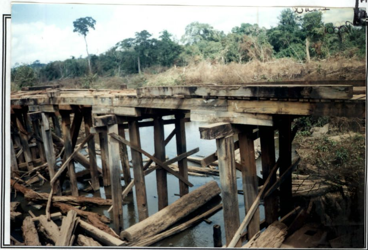
Foto 11 – Situação precária da ponte. Observar acúmulo de madeira no leito do Igarapé.
