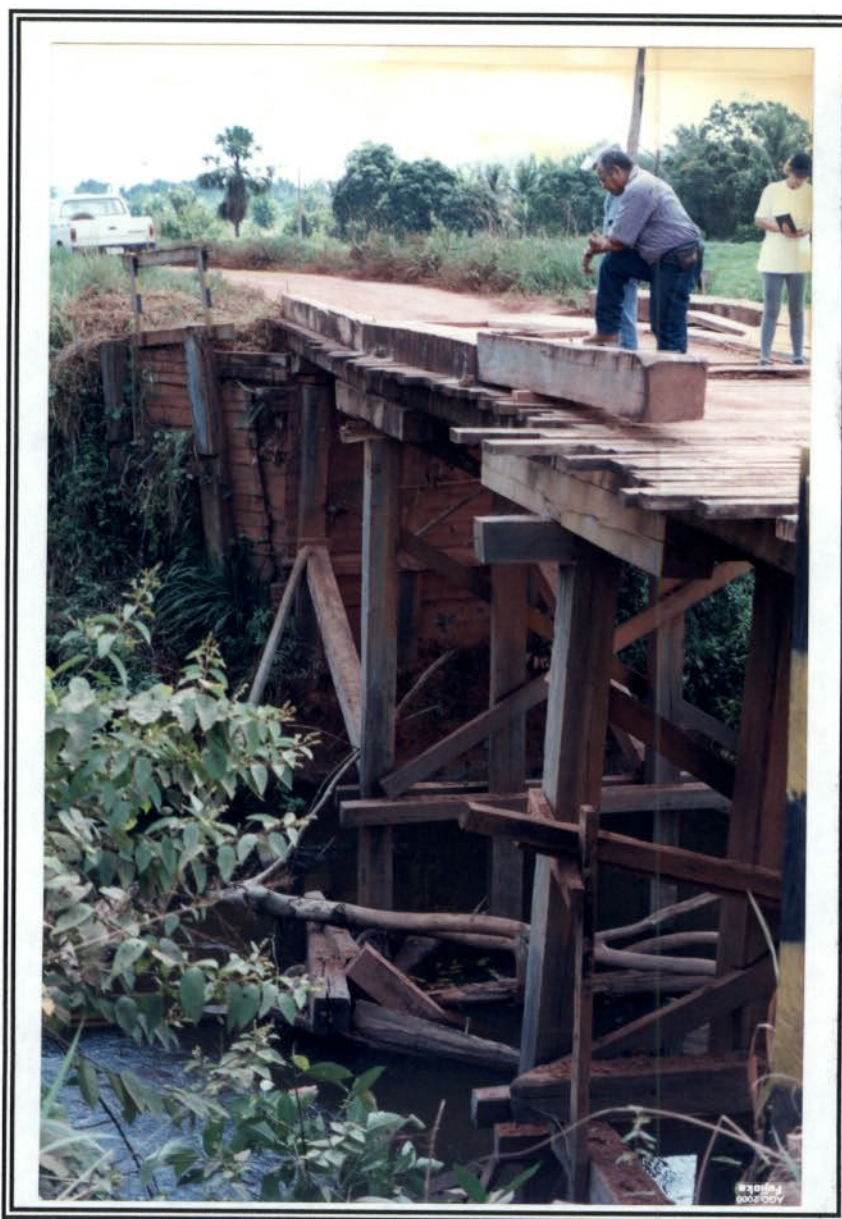
Foto 13 – Situação precária da ponte. Observar acúmulo de madeira no leito do Igarapé.
