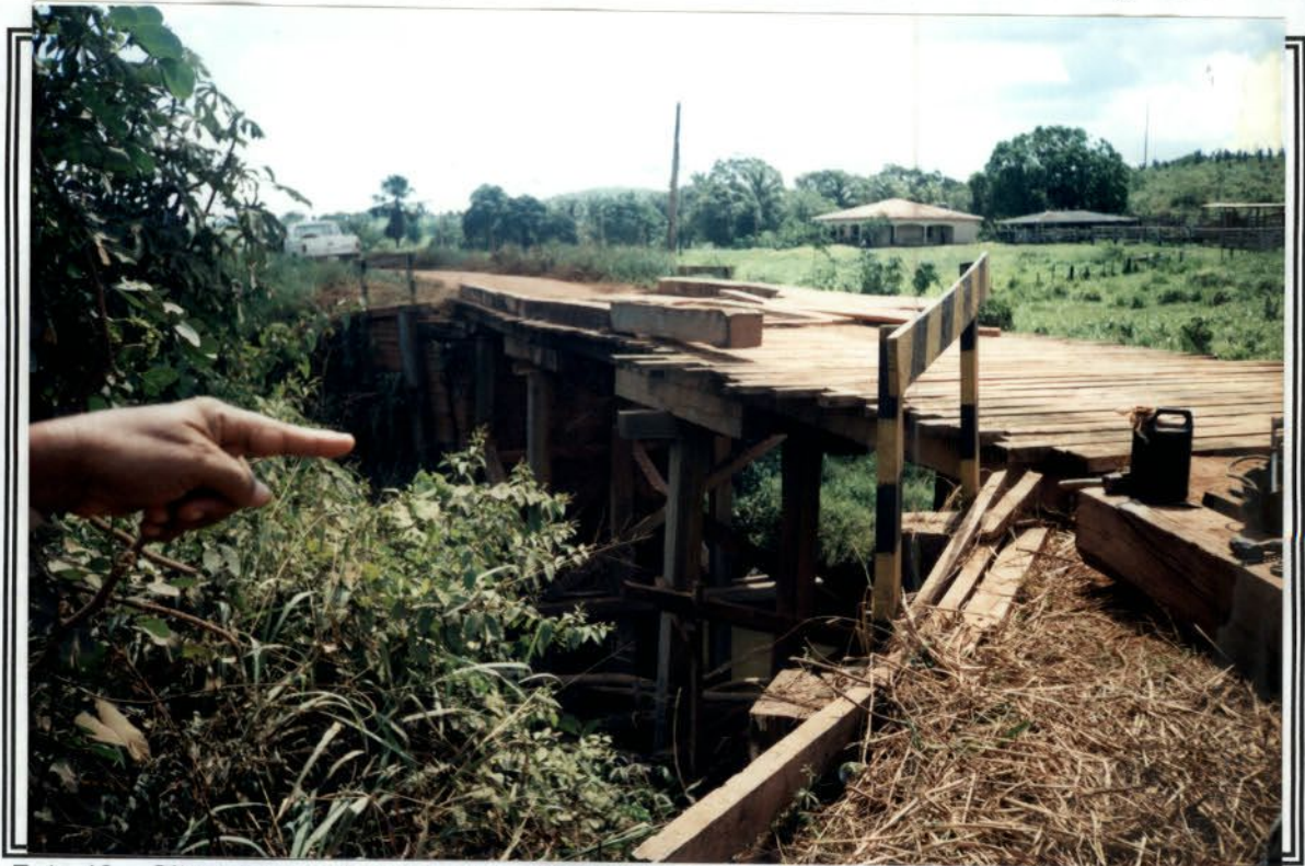
Foto 12 – Situação precária da ponte. Observar acúmulo de madeira no leito do Igarapé.
