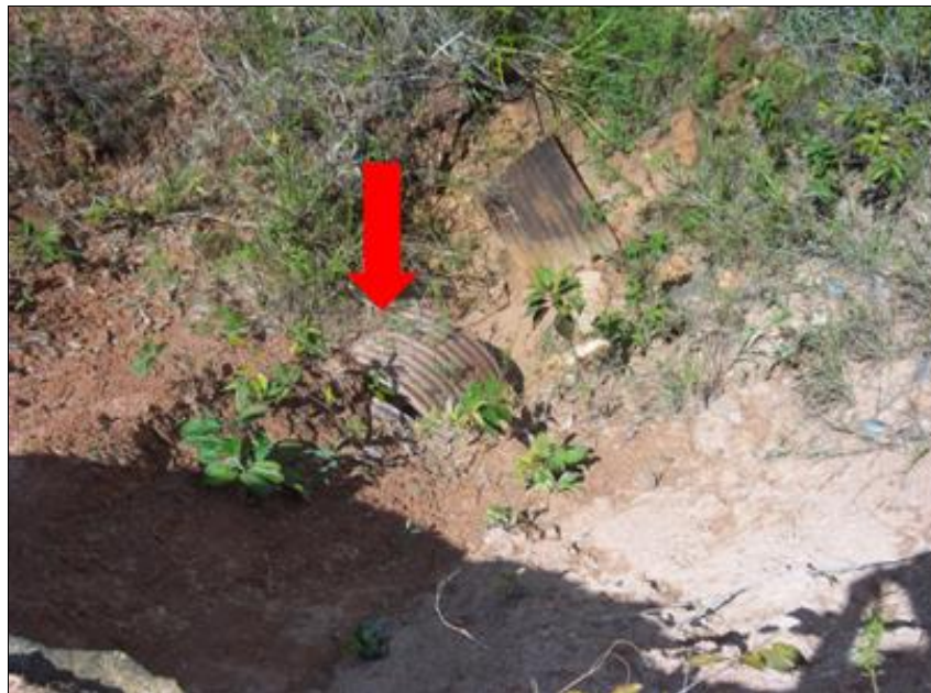
Figura 6.1.27 - Bueiro de drenagem colapsado, causando danos ao corpo estrada. Coordenadas 20 M 632906 9426840. Fonte: Engespro. Data: 23/06/2014.
