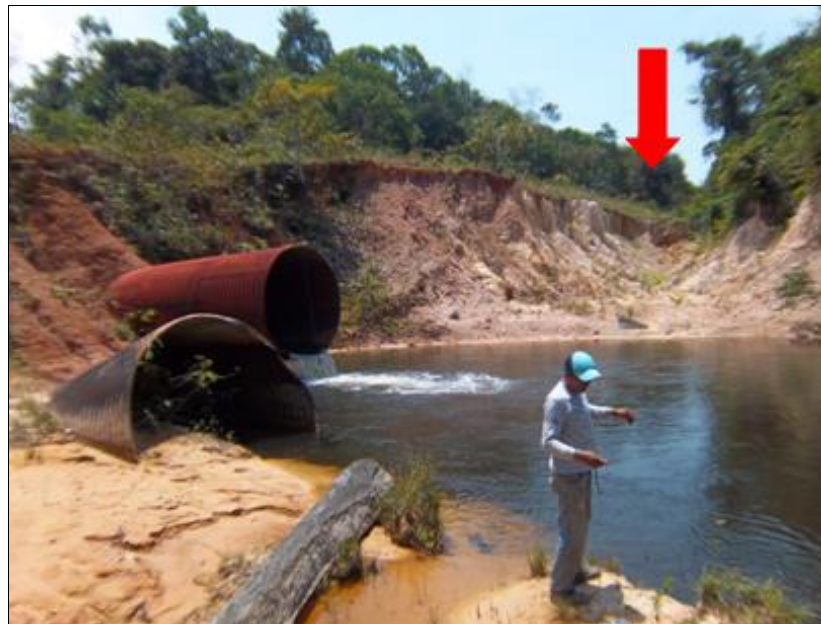
Figura 6.1.28 - Formação de Nível de base local (Nick point) favorecendo o aumento da erosão a jusante, com canal efêmero conectado à drenagem na margem esquerda formado por voçorocamento que avança em direção à pista pela ausência de drenagens. Coordenadas 20 M 623125 9419738. Fonte: Engespro. Data: 23/06/2014.
