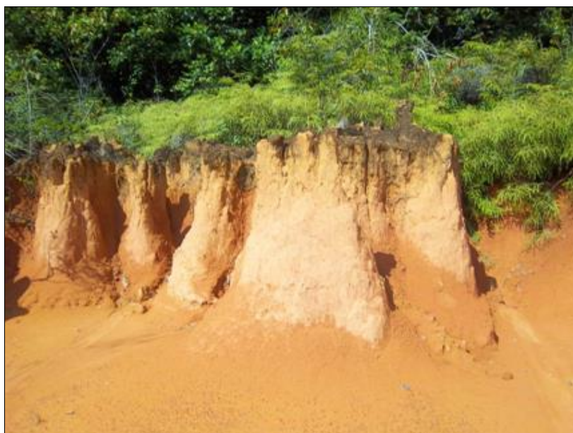
Figura 6.1.60 - Solo submetido a estágio avançado de intemperismo e erosão. Coordenadas 20 M 623125 9419738. Fonte: Engespro. Data: 23/06/2014.
