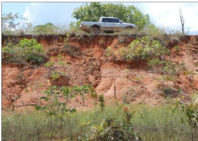
Figura 6.1.26 - Processo erosivo avançando em direção à rodovia BR-319/AM podendo ocasionar o colapso da pista. Coordenadas 20 M 641148 9433162. Fonte: Engespro. Data: 21/06/2014.
