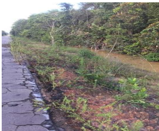
Figura 6.2.3.142 - Margem da BR-319 com solo cascalhoso. Data: maio/2019. Coordenada: 20M 506000/9275063.
