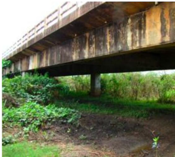
Figura 6.2.3.293 – Vão livre sob a ponte em virtude da extensão no comprimento da ponte (BR-262/MS) para garantir a passagem da fauna. Fonte: Embrapa Pantanal, 2010.
