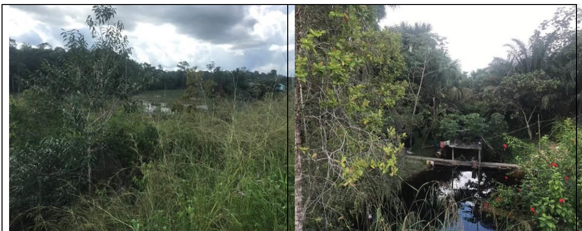
Figura 6.2.221 - Corpo hídrico sem nome com bueiro, onde a Floresta Ombrófila Aluvial foi alagada na ADA e em parte da AE da BR-319/AM, devido à baixa capacidade de escoamento das águas pelo bueiro instalado – lado direito (coordenada de referência 20M 658746/9449799). Data 07/06/2019.
