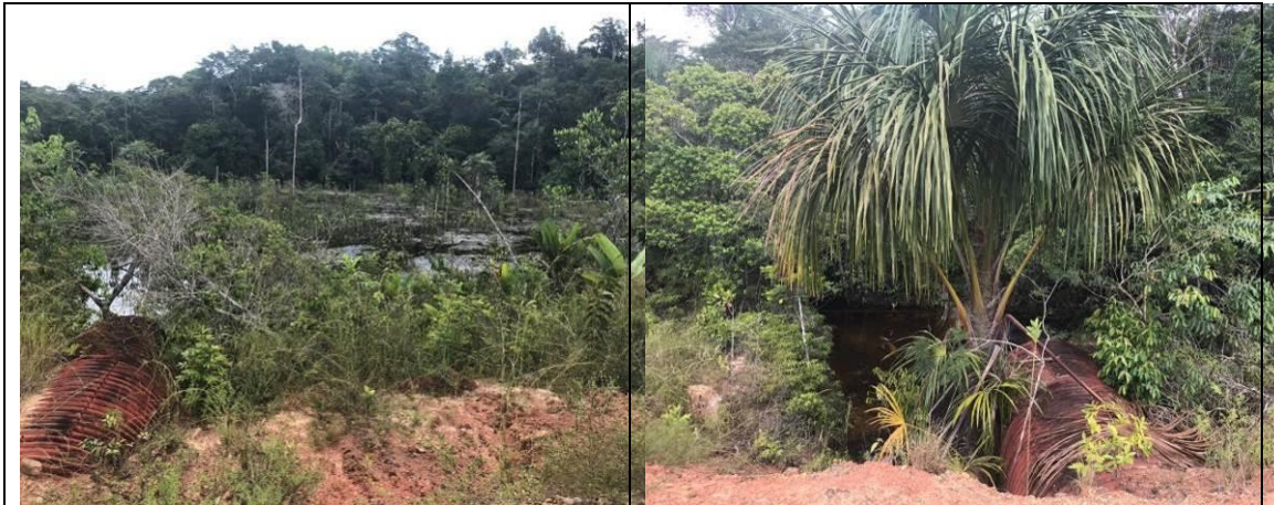
Figura 6.2.203 – Corpo hídrico com bueiro na BR-319/AM, onde a Floresta Ombrófila Aluvial na ADA e na AE foi alagada devido à baixa capacidade de escoamento das águas do Igarapé pelo bueiro instalado, ocasionando a morte de indivíduos arbóreos – lado direito (coordenada de referência 20M 663001/9453138). Data 07/06/2019.
