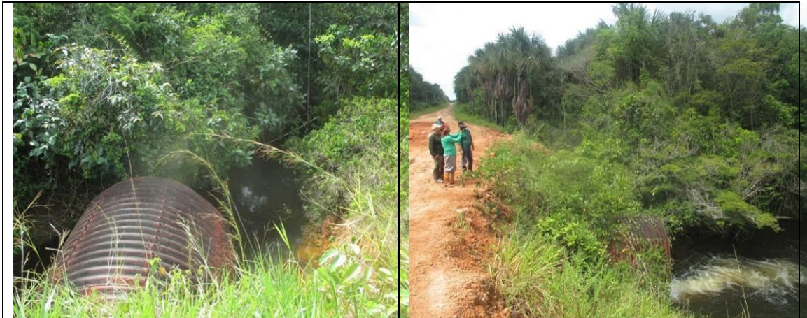
Figura 6.2.321 - Igarapé dos Cachorros com bueiro – lado direito da BR-319/AM, onde a Floresta Ombrófila Aluvial está no estágio inicial de regeneração na maior porção da ADA (coordenada de referência 20M 615087/9413803). Data 10/06/2019.
