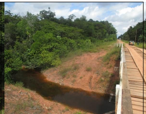
Figura 6.2.296 - Igarapé Roraima com ponte, onde a Floresta Ombrófila Aluvial em parte da ADA da BR-319/AM está no estágio médio de regeneração – lado direito (coordenada de referência 20M 625232/9422455). Data 10/06/2019.
