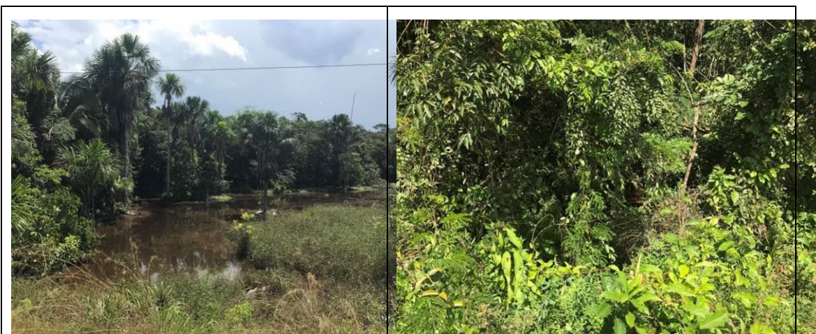
Figura 6.2.195 - Corpo hídrico sem nome, com alagamento ocasionado pela elevação do greide da rodovia e pelo fato do bueiro não conseguir escoar as águas de montante na ADA e AE - lado direito (coordenada de referência 20M 664200/9454045). Data 07/06/2019.
