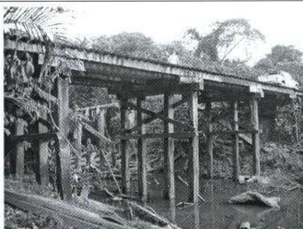
Foto 47: estado precário de ponte de madeira, comum neste trecho.
