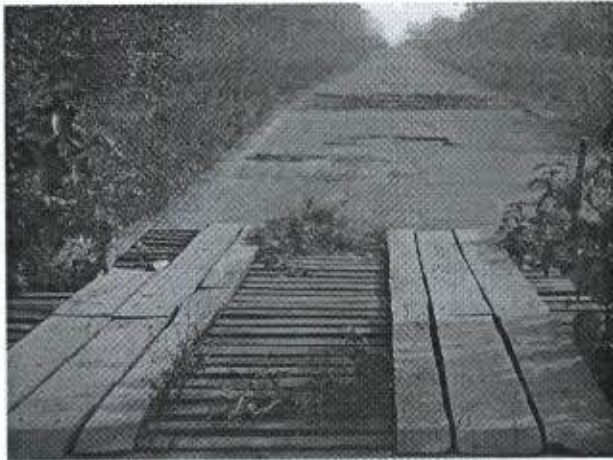
Foto 33: há trechos que alternam falta de cobertura asfáltica, com pavimento em avançada deterioração, com buracos e desmoronamentos de pista, onde está construída a maioria das pontes.
