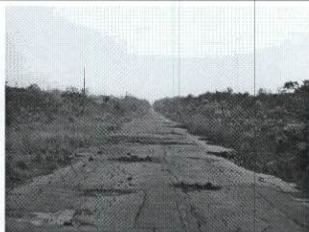
Foto 68: trecho ainda pavimentado em péssima condição, com buracos e desmoronamentos laterais da pista
