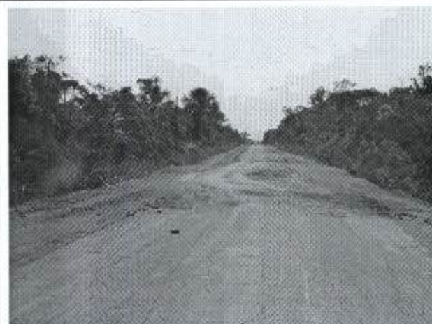
Foto 75: trecho com obras paralisadas
