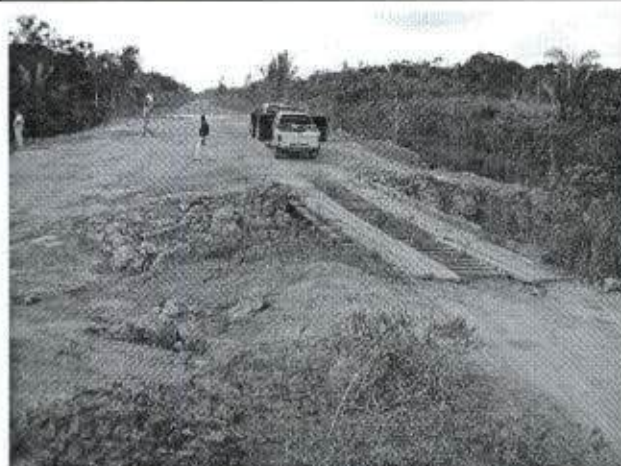
Foto 59: ponte de madeira em trecho com desmoronamento .
