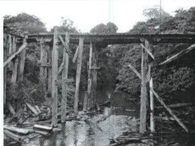
Foto 60: ponte de madeira em péssimas condições.
