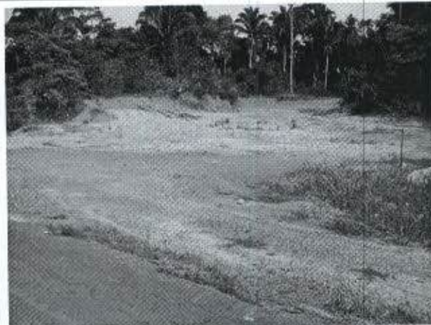
Foto 14: Antiga área de empréstimo utilizada na instalação da rodovia, sem sinais de recuperação natural.
