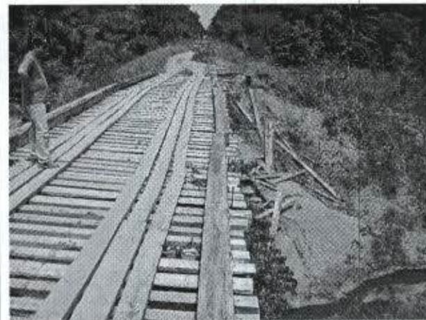
Foto 44: ponte de madeira em local onde houve desmoronamento de pista, podemos observar o bueiro ármico ao lado da ponte.
