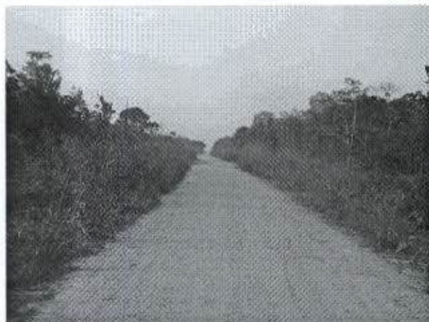
Foto 29: há trechos longos onde a rodovia apresenta-se completamente sem pavimento asfáltico.
