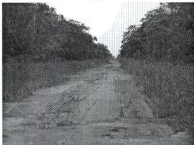
Foto 53: trecho com pequenos resquícios de pavimento.
