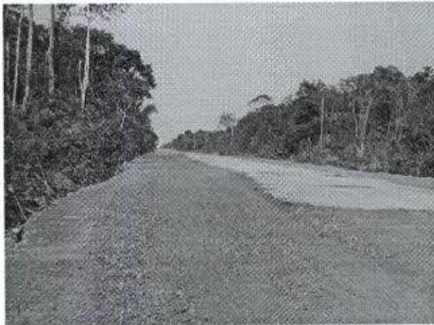
Foto 71: trecho com obras, com recuperação do acostamento, preparando o leito para o novo pavimento asfáltico. Como houve muita movimentação de solo há riscos de danos ambientais relacionados ao assoreamento dos cursos d'água.
