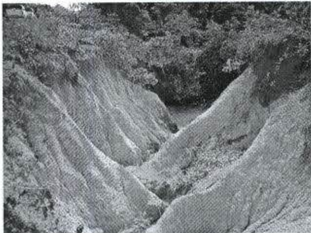
Foto 39: há vários passivos ambientais ao longo deste trecho como esta grande erosão causada pela drenagem da rodovia.
