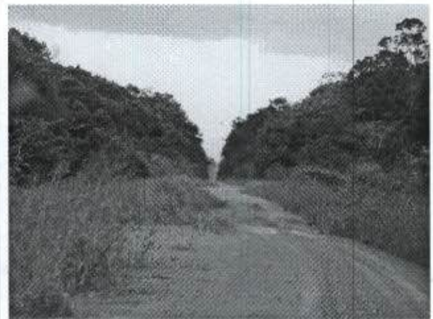
Foto 54: estado de segmento sem cobertura asfáltica.
