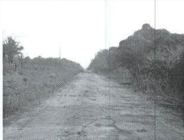
Foto 32: situação do pavimento, quase inexistente, em vários segmentos.
