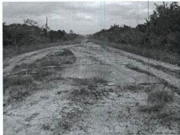
Foto 58: estado de segmento com pequenos resquícios da cobertura asfáltica.
