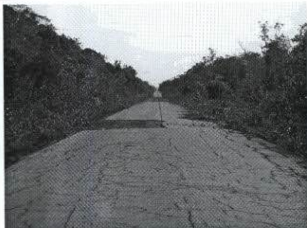
Foto 69: trecho com asfalto regular mas com alguns buracos .
