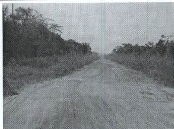
Foto 22: estado de conservação do pavimento começa a ficar precário, com trechos onde a cobertura asfáltica simplesmente desapareceu, ou apresenta elevado estado de deterioração.
