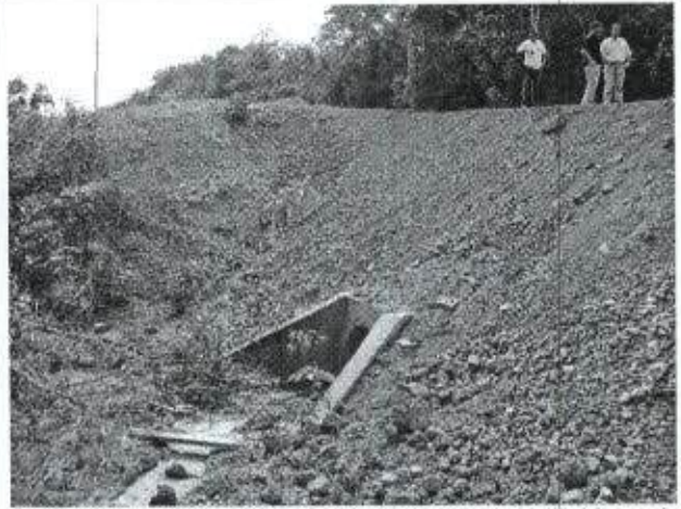
Foto 72: bueiro simples de concreto substituído pela construtora. Há dúvidas quanto à eficiência dos bueiros, visto não ter sido apresentado estudo hidrológico verificando os volumes pluviais e sua relação com a capacidade dos bueiros.
