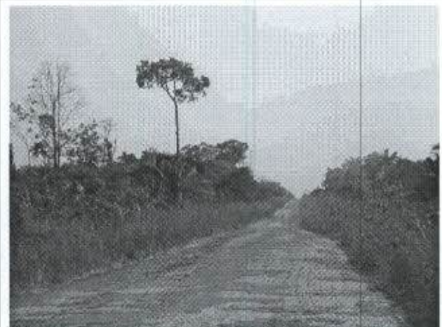
Foto 56: estado de segmento sem cobertura asfáltica.
