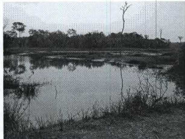
Foto 42: alagamento das margens da rodovia pelo entupimento de bueiro (passivo ambiental).
