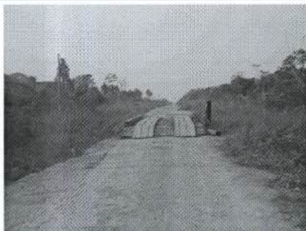
Foto 55: trecho sem pavimentação com ponte de madeira, em área desmazonada da rodovia .
