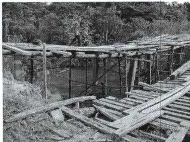
Foto 40: ponte de madeira em local onde houve desmoronamento de pista, podemos observar o bueiro ármico ao lado da ponte.
