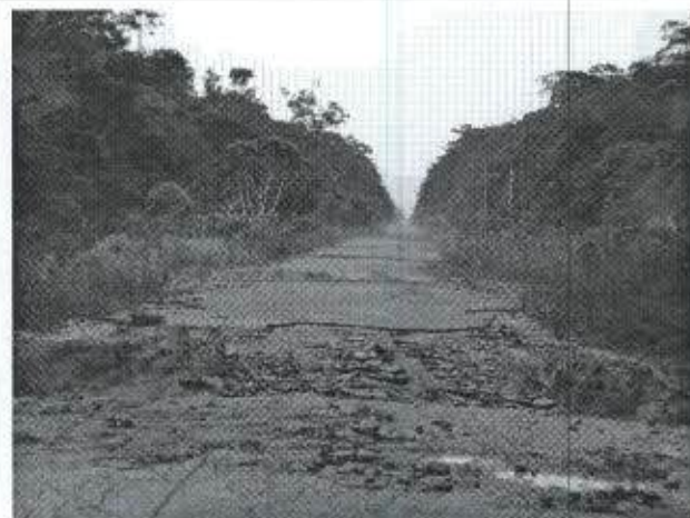
Foto 50: trecho alternando atoleiros, buracos e resquícios do pavimento asfáltico original.
