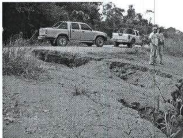
Foto 30: Devido ao sub-dimensionamento dos bueiros, houve seu entupimento, e abatimento do leito estradal em diversos pontos neste Trecho 3.
