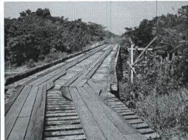
Foto 38: Ponte precária construída em curva, em um desvio da rodovia.
