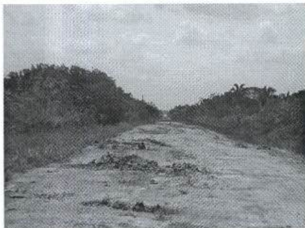
Foto 57: trecho sem pavimentação com ponte de madeira, em área desmoronada da rodovia .
