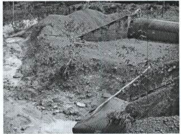
Foto 52: ponto com substituição de bueiros, com obra abandonada, no entanto a boca foi obstruída pela empreiteira, o que pode causar danos no próximo período de chuvas
