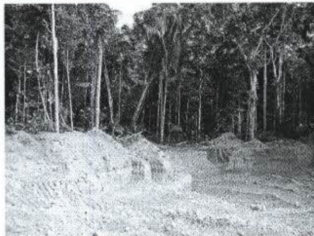
Foto 73: Área de empréstimo reativada, mas no momento inativa devido à paralisação das obras.
