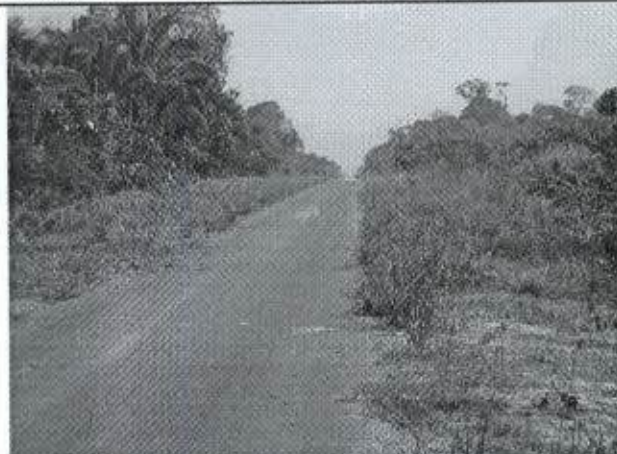
Foto 21: início do Trecho 3, podemos observar o estado de conservação do pavimento reduz-se drasticamente a partir deste ponto.
