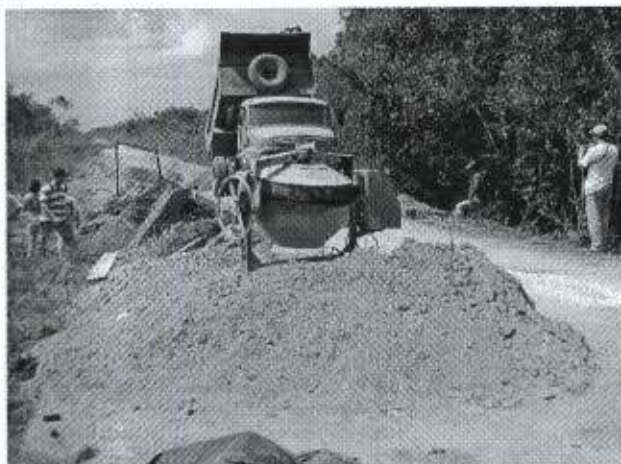
Foto 45: Substituição de bueiro em fase final de obra, a despeito do termo de embargo para as obras na rodovia.
