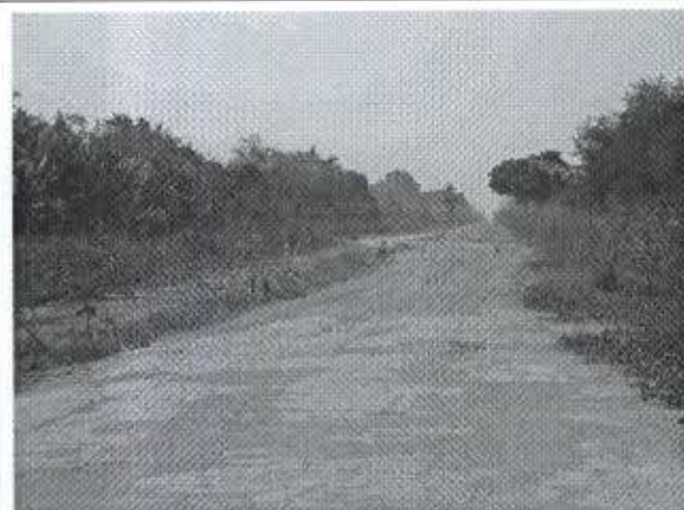
Foto 23: Há trechos com apenas resquícios da outrora pavimentação.
