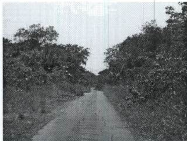
Foto 64: visão de trecho pavimentado em péssimas condições
