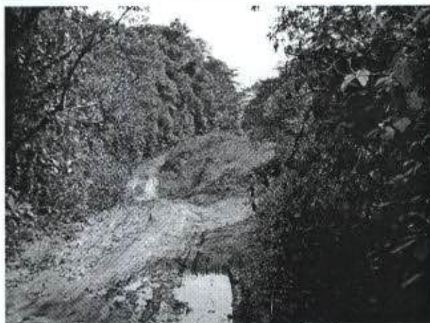
Foto 63: trecho com atoleiros, sem pavimento .
