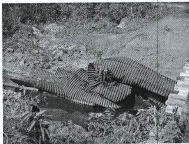
Foto 70: bueiro ármico totalmente deteriorado em local com ponte de madeira e desmoronamento de pista
