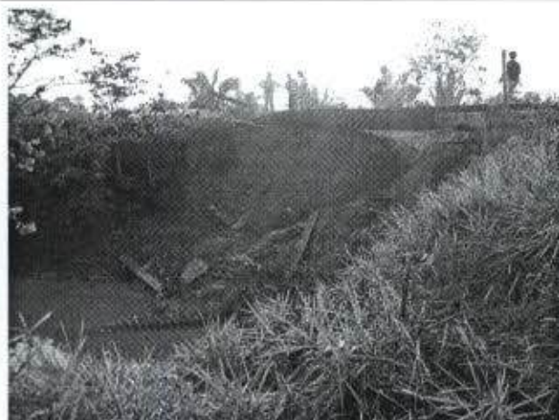
Foto 31: ponte de madeira construída houve desmoronamento de pista devido ao entupimento de bueiro, situação muito comum neste trecho.
