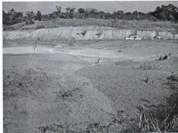
Foto 35: área de empréstimo desativada, da época de abertura da rodovia (passivo ambiental).
