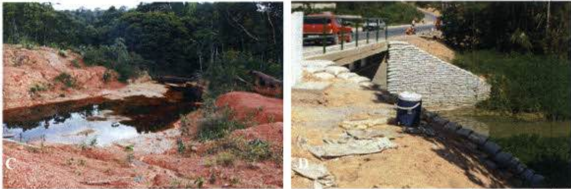
Figura 11. Igarapés assoreados transpostos pela BR-319. Note que em A e C, o assoreamento esta ocupando parte do leito do igarapé. Em B e D, o curso de água quase desapareceu devido ao assoreamento.
