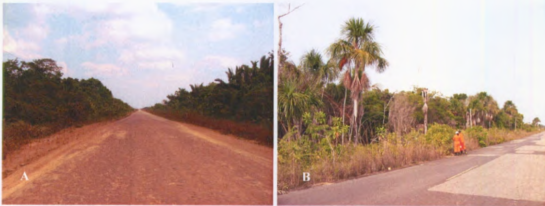
Fig. 2: Trecho terroso em A e, em B, trecho ainda conservado via operação tapa buracos.
