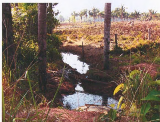
Fig. 17: Vista de um bueiro em que a vegetação natural da lateral direita foi suprimida.
