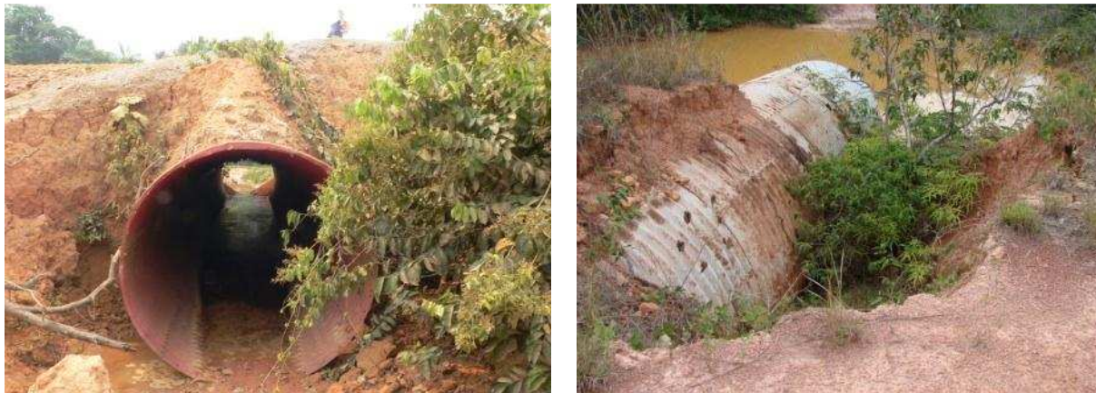
Figura 10 – Bueiros encontrados no corpo estradal da rodovia BR-319.
