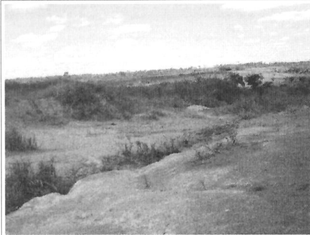
Foto 01: Processo erosivo- Margem esquerda da rodovia
