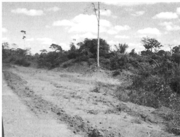
Foto 12: Disposição inadequada de solo- Margem esquerda da rodovia
