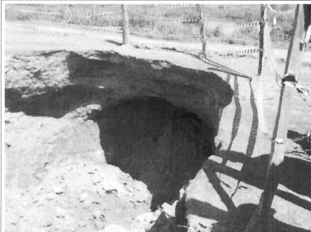
Foto 05: Deslizamento de parte da rodovia ocasionado pelo rompimento de bueiro – Margem esquerda da rodovia
