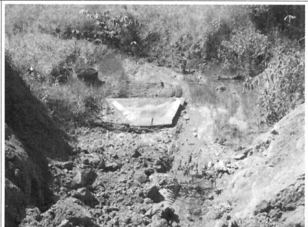
Foto 06: Vista de deslizamento ocasionado pelo rompimento de bueiro – Margem esquerda da rodovia
