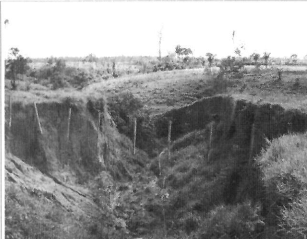
Foto 07: Voçoroca ocasionada por rompimento de bueiro – Margem direita da rodovia
