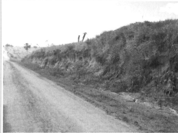
Foto 03: Erosão em talude de corte – Margem esquerda da rodovia
