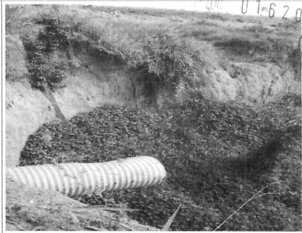
Foto 08: Detalhe do rompimento do bueiro – Margem direita da rodovia
