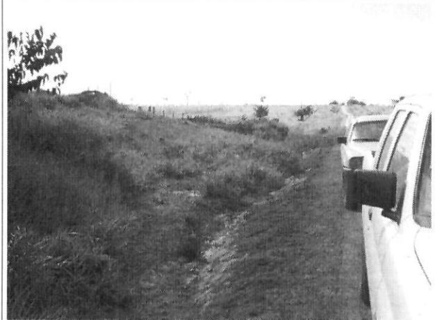
Foto 04: Erosão em talude de corte – Margem direita da rodovia
