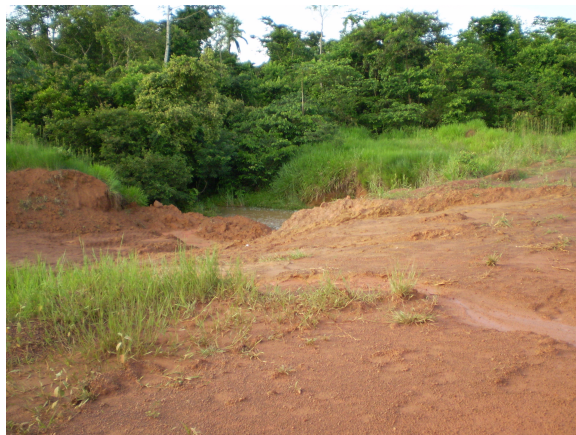
Foto 8-3 –Área de APP com processos erosivos desencadeados.
