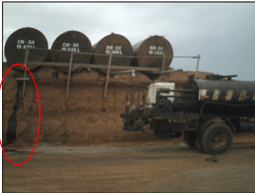
Foto 7-8 – Foto Ilustrativa: Vazamento de material derivado de petróleo (detalhe)
