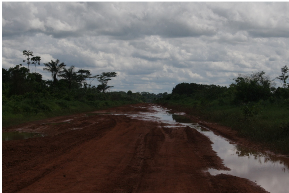
Foto 5.2-155 - A BR 317/AM no trecho que corta a Terra Indígena Apurinã. Observa-se a degradação da vegetação florestal ao longo do seu leito, tornando o habitat inadequado para espécies sensíveis e ampliando o efeito de barreira resultante da rodovia.
