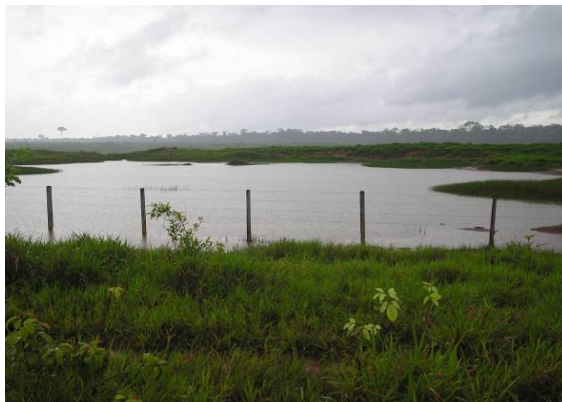
Foto 5.2-26 Passivo - Área de empréstimo sujeito a alagamento; lado esquerdo. Coordenadas: 694.339 / 8.998.980
