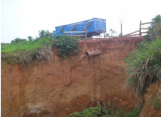
Foto 5.2-36 Passivo - Erosão crítica as margens da BR - 317; lado direito. Coordenadas: 687.928 / 8.956.921
