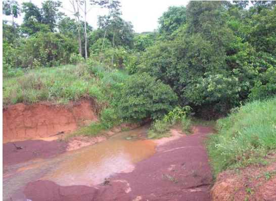
Foto 5.2-24 Aspecto de um curso d'água cortado pela BR - 317, mostrando sinais de erosão e assoreamento com material proveniente da pavimentação da estrada. Coordenadas: 695.477 / 8.999.988
