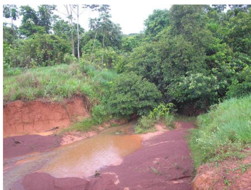
Foto 5.2-154 - Curso d'água cortado pela BR - 317, mostrando erosão e assoreamento com material proveniente da estrada. (Coordenadas: 695.477 / 8.999.988)
