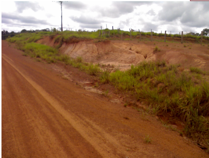
Foto 5.1-1 - Processos erosivos desencadeados pelo escoamento superficial das águas pluviais, no km 94 da rodovia.
