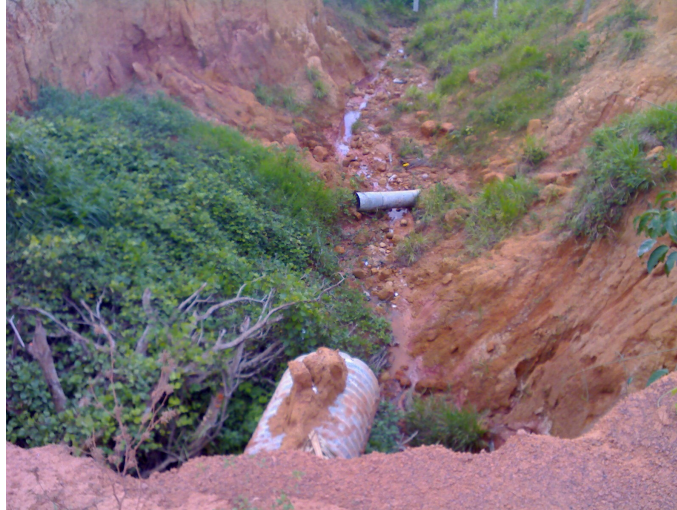
Foto 5.1-5 – Visão aproximada da voçoroca, processo desencadeado pelo mau funcionamento do bueiro ármico, no km 92,8.
