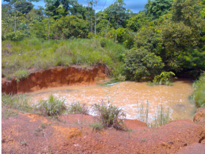
Foto 5.1-10 – Instabilidade de talude, ocasionada pelo escoamento lateral das águas pluviais, no km 37,3.
