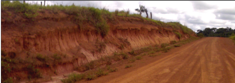
Foto 5.1-24 – Instabilidade do talude de corte em Latossolo Vermelho-Amarelo, no km 94,9.
