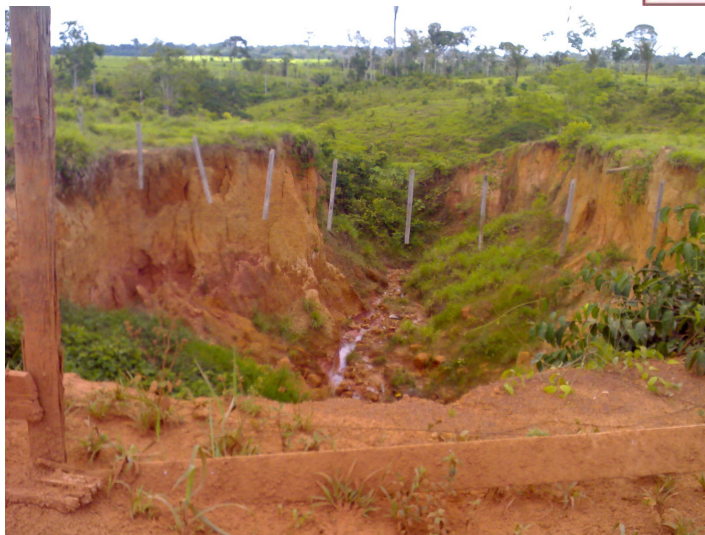
Foto 5.1-4 – Voçoroca instalada, processo desencadeado pelo mau funcionamento do bueiro ármico, no km 92,8.
