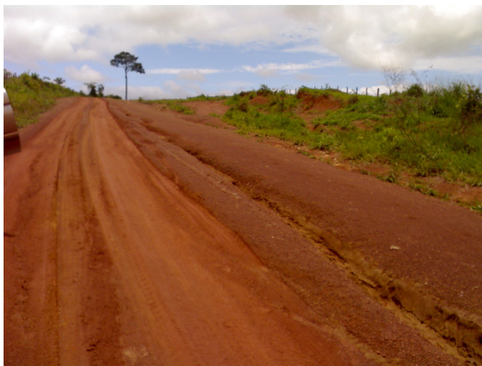
Foto 5.1-3 – Formação de sulcos no leito da estrada, desencadeados pelo escoamento superficial das águas pluviais e pela ausência de drenos laterais, km 61,5.
