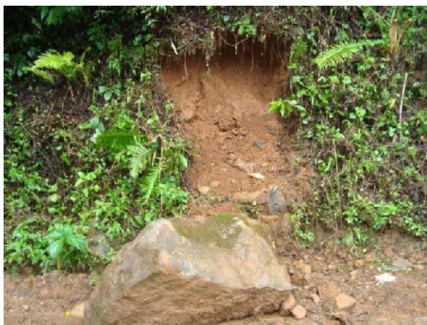
FIGURA 2.6.6 – FOTO: BLOCO DE ROCHA CAÍDO SOBRE A ESTRADA COORDENADAS: LAT.: 6.812.890 N / LONG.:605.334 E / ALTITUDE: 374 M
