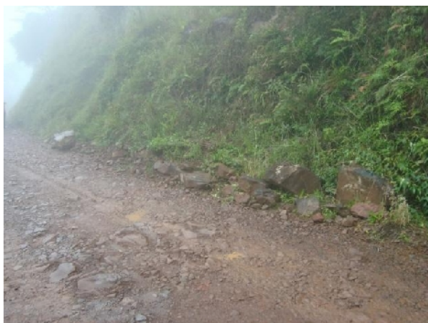
FIGURA 2.6.9 – FOTO: ESCORREGAMENTO DE SOLO E BLOCOS DE ROCHA COORDENADAS: LAT.: 6.813.587 N / LONG.:602.619 E / ALTITUDE: 1.112 M
