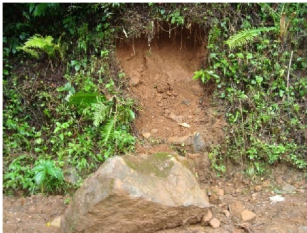
FIGURA 2.6.13 – FOTO: BLOCO DE ROCHA CAÍDO SOBRE A ESTRADA COORDENADAS: LAT.: 6.812.890 N / LONG.:605.334 E / ALTITUDE: 374 M
