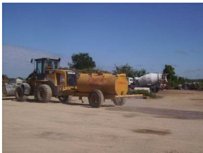
FIGURA 2.5.5 – EXEMPLO DE JATEAMENTO DO SOLO COM CAMINHÃO PIPA PARA REDUÇÃO DE POEIRA DECORRENTE DO TRÁFEGO DE VEÍCULOS FONTE: UFPR / ITTI, 2010.
