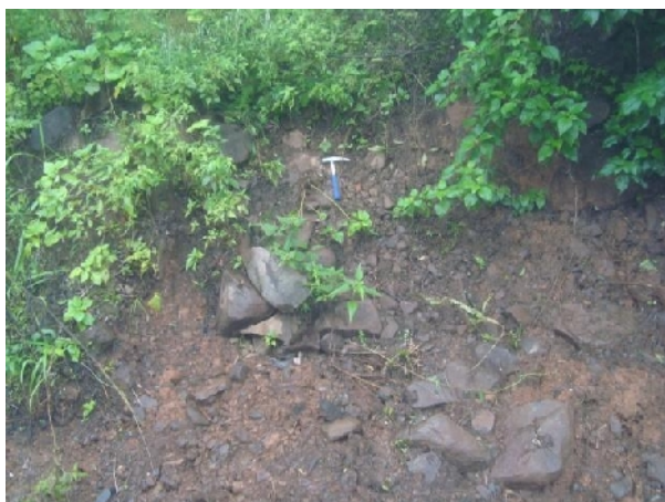
FIGURA 2.6.11 – FOTO: TALUS COM RISCO DE INSTABILIDADE COORDENADAS: LAT.: 6.812.528 N / LONG.:604.664 E / ALTITUDE: 682 M
