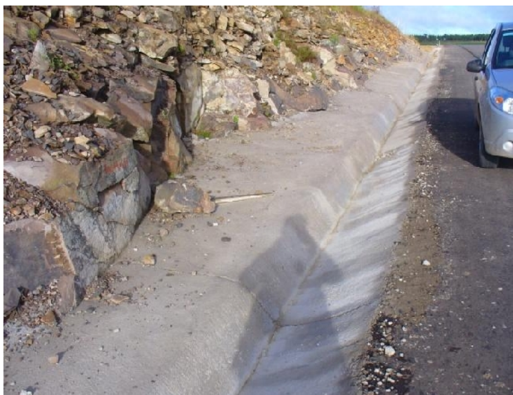
FIGURA 2.6.1 – DESPRENDIMENTO DE BLOCOS ROCHOSOS – ENTRE A SEDE DE SÃO JOSÉ DOS AUSENTES E KM 45+800 M FONTE: UFPR, 2011.
