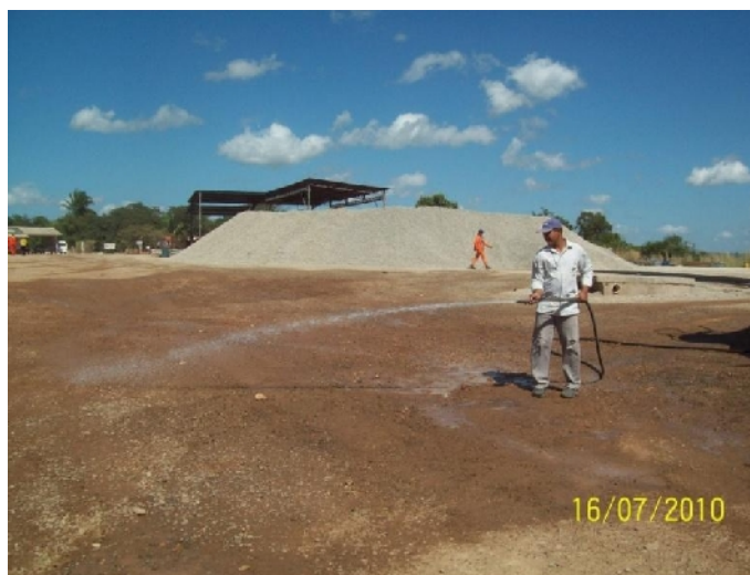
FIGURA 2.5.4 – EXEMPLO DE JATEAMENTO DO SOLO PARA REDUÇÃO DE POEIRA DECORRENTE DO TRÁFEGO DE VEÍCULOS
