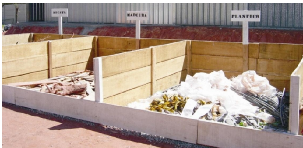
FIGURA 2.4.3 – EXEMPLO DE BAIAS UTILIZADAS PARA O ACONDICIONAMENTO TEMPORÁRIO FONTE: ENGEMIN, 2009.
