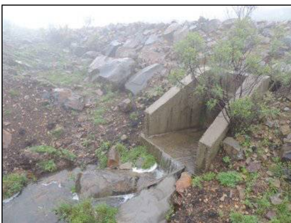
Foto 55. Bueiro funcional em aterro enrocado. km 53+540. Coord. UTM 601723/6814016 22J (Out/2015).
