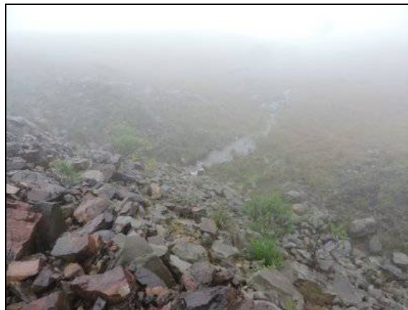
Foto 52. Bueiro funcional em aterro de rocha. km 53+165. Coord. UTM 601423/6814221 22J (Out/2015).
