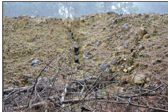
Foto 34. Incidência de processo erosivo em aterro com impacto dentro da faixa de domínio. km 46+885 (LE). Coord. UTM 597283/ 6817544 22J (Nov/2015).
