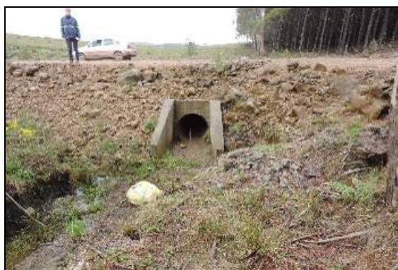
Foto 67. Resíduos dispostos de forma incorreta na faixa de domínio. km 46+380 (LE). Coord. UTM 596924/6817900 22J (Out/2015).
