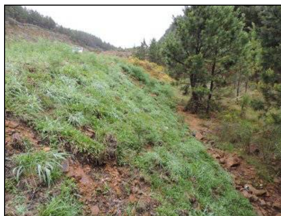
Foto 18. Monitoramento do segmento de aterro reconformado e enleivado, km 46+010. Coord. UTM 596642/6818138 22J (Out/2015).
