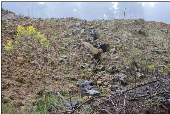
Foto 37. Incidência de processo erosivo em aterro com impacto dentro da faixa de domínio. km 46+900 (LE). Coord. UTM 597293/6817533 22J (Nov/2015).
