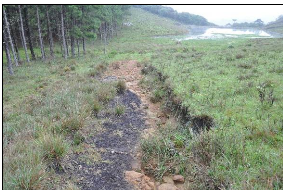
Foto 31. Valeta conduzindo sedimentos para açude lindeiro. km 46+510 (LD). Coord. UTM 597013/6817803 22J (Nov/2015).
