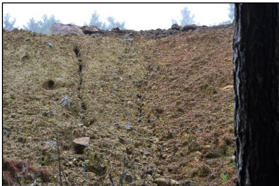
Foto 39. Incidência de processo erosivo em aterro com impacto dentro da faixa de domínio. km 46+950 (LE). Coord. UTM 597327/6817496 22J (Nov/2015).
