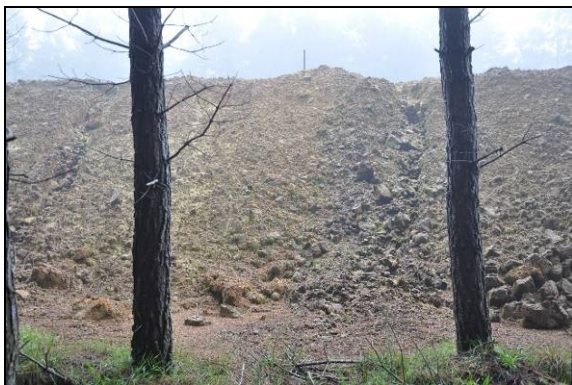
Foto 43. Incidência de processo erosivo em aterro com impacto dentro da faixa de domínio. km 47+000 (LE). Coord. UTM 597362/6817459 22J (Nov/2015).
