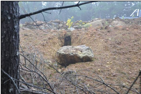
Foto 33. Incidência de processo erosivo em aterro com impacto dentro da faixa de domínio. km 46+880 (LD). Coord. UTM 597268/ 6817534 22J (Nov/2015).
