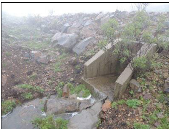
Foto 53. Bueiro funcional em aterro enrocado. km 53+540. Coord. UTM 601723/6814016 22J (Out/2015).
