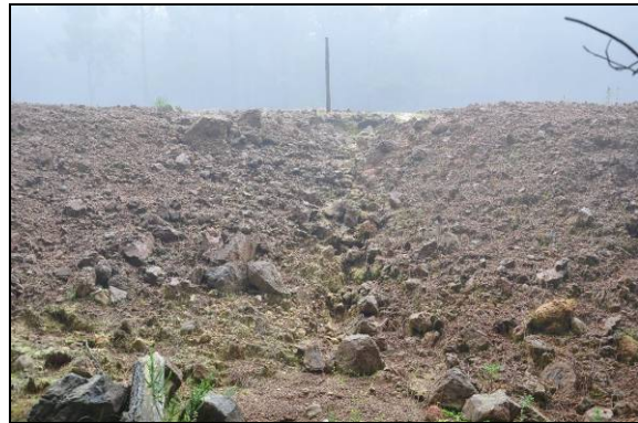
Foto 46. Incidência de processo erosivo em aterro com impacto dentro da faixa de domínio. km 47+020 (LD). Coord. UTM 597371/6817453 22J (Nov/2015).
