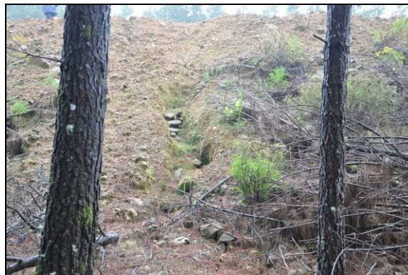
Foto 38. Incidência de processo erosivo em aterro com impacto dentro da faixa de domínio. km 46+940 (LD). Coord. UTM 597312/6817494 22J (Nov/2015).
