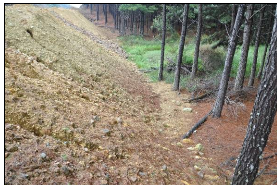
Foto 26. Incidência de processo erosivo próximo ao sistema de drenagem com impacto dentro da faixa de domínio. km 46+260 (LE). Coord. UTM 596834/6817974 22J (Nov/2015).
