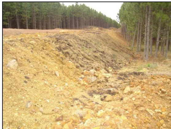
Foto 28. Processo erosivo estabilizado. km 46+520. Coord. UTM 6817791/ 597043 (LD). (Jul/2015)
