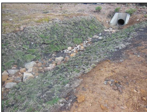
Foto 19. Monitoramento de bueiro com processo erosivo corrigido no mês de maio, km 46+020. Coord. UTM 596647/6818131 22J (Jun/2015).
