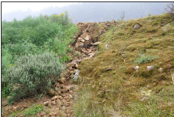
Foto 21. Incidência de processo erosivo em aterro com impacto dentro da faixa de domínio. km 46+000 (LE). Coord. UTM 596627/6818143 22J (Nov/2015).
