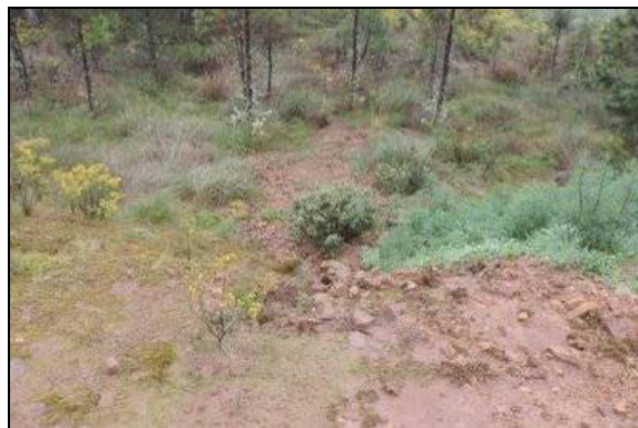
Foto 22. Incidência de processo erosivo em aterro com impacto dentro da faixa de domínio. km 46+000. Coord. UTM 596627/6818143 22J (Out/2015).
