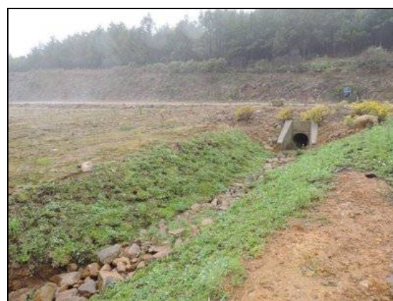
Foto 20. Bueiro (jusante) com talvegu enrocado e aterros de encontro enleivados, km 46+020. Coord. UTM 596647/6818131 22J (Out/2015).
