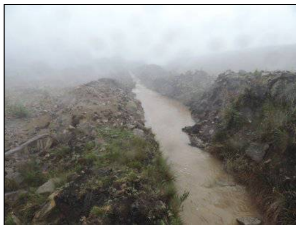
Foto 50. Valeta de drenagem funcional (montante). km 52+500. Coord. UTM 600922/6814594 22J (29/10/2015).
