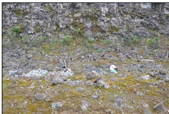
Foto 62. Resíduos dispostos de forma incorreta na faixa de domínio. km 46+070 (LD). Coord. UTM 596665/6818065 22] (Nov/2015).
