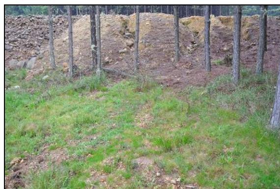
Foto 32. Aterro com incidência de processos erosivos contribuindo para o assoreamento do açude lindeiro. km 46+550 (LE). Coord. UTM 597032/6817771 22J (Nov/2015).
