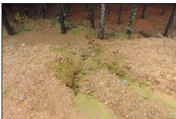
Foto 44. Incidência de processo erosivo em aterro com impacto dentro da faixa de domínio. km 47+010 (LE). Coord. UTM 597370/6817451 22J (Out/2015).
