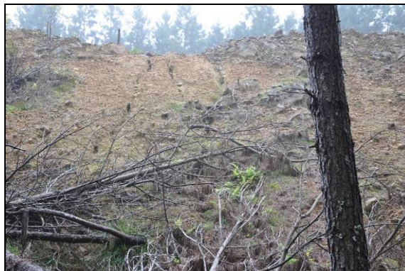
Foto 40. Incidência de processo erosivo em aterro com impacto dentro da faixa de domínio. km 46+960 (LD). Coord. UTM 597326/6817484 22J (Nov/2015).
