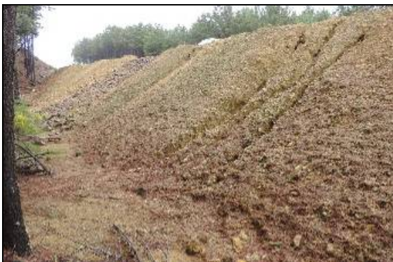
Foto 25. Incidência de processos erosivos próximo ao sistema de drenagem com impacto dentro da faixa de domínio. km 46+225. Coord. UTM 596809/6817980 22J (Out/2015).
