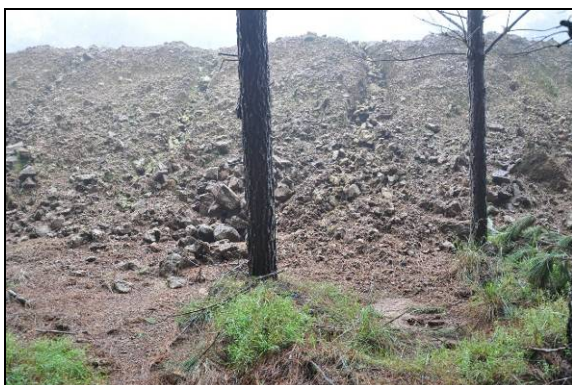
Foto 41. Incidência de processo erosivo em aterro com impacto dentro da faixa de domínio. km 46+980 (LE). Coord. UTM 597348/6817472 22J (Nov/2015).
