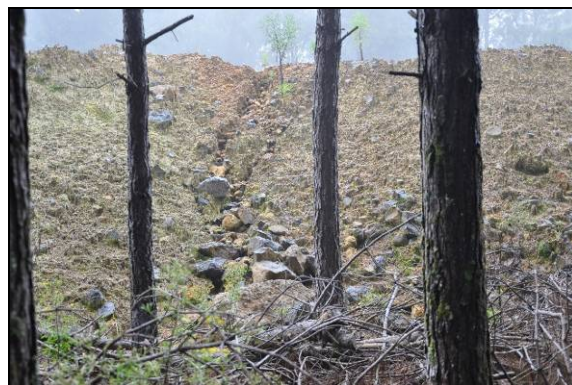
Foto 36. Incidência de processo erosivo em aterro com impacto dentro da faixa de domínio. km 46+895 (LE). Coord. UTM 597290/6817537 22J (Nov/2015).
