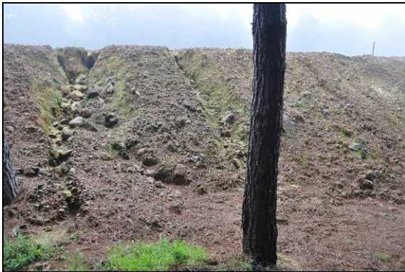
Foto 45. Incidência de processo erosivo em aterro com impacto dentro da faixa de domínio. km 47+010 (LE). Coord. UTM 597370/6817452 22J (Nov/2015).
