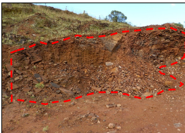
Foto 37 – Evidências de retirada de material.
