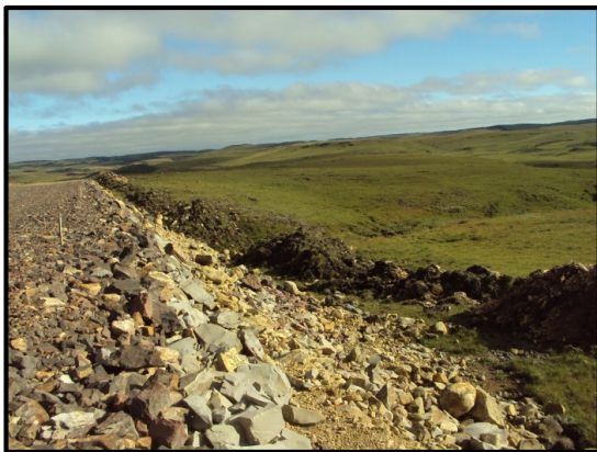
Foto 41 - Material a ser utilizado na recuperação do trecho da estrada existente a ser desativado.
