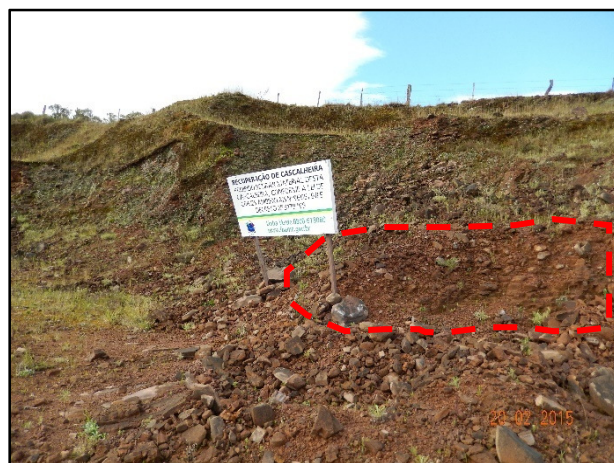
Foto 38 – Deslocamento da placa de advertência.
