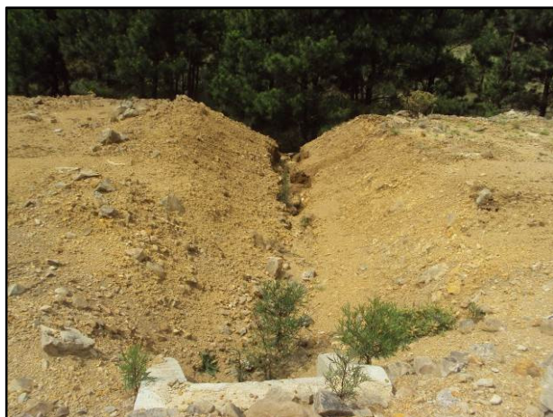
Fotos 7 - KM 46+020 (LE) – Detalhe do processo erosivo - novembro/14.
