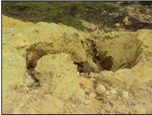
Foto 10 - Erosão severa no material colocado sobre o talude de aterro – novembro/14.
