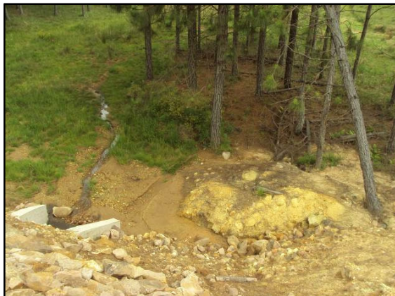
Foto 16 – Material depositado junto ao talvegue resultante da erosão a montante – novembro/14.
