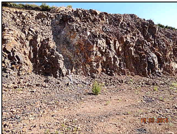
Foto 1 - Talude de corte no km 47+800 (LD). Sulco erosivo implantado sobre a face do talude após eventos pluviométricos de grande intensidade ocorridos em fev-mar/15.
