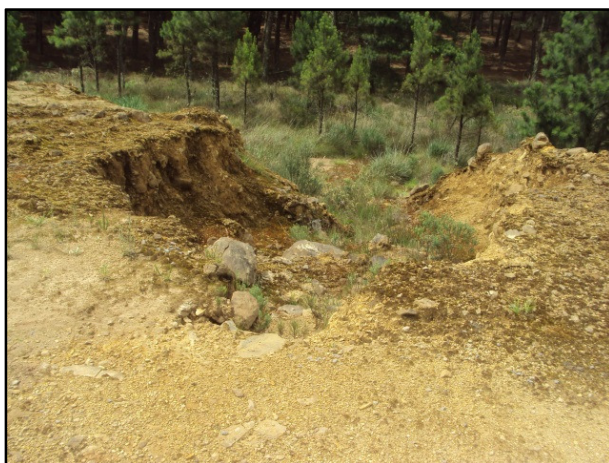
Fotos 4 - Km 45+900 (LE) – Detalhe do talude com processo erosivo - novembro/14.
