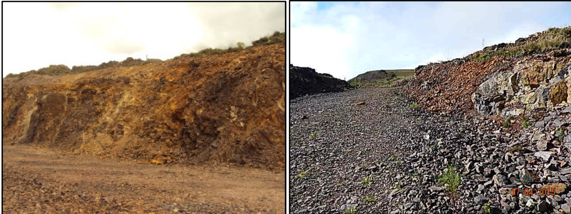
Fotos 2 e 3 - Corte localizado no km 53+900 (LD) executado em rocha muito fraturada. Como os fraturamentos mergulham em direção ao offset, está ocorrendo a queda de placas que se acumulam no pé do corte. A foto da esquerda é de nov/14 e a da direita de mai/15.
