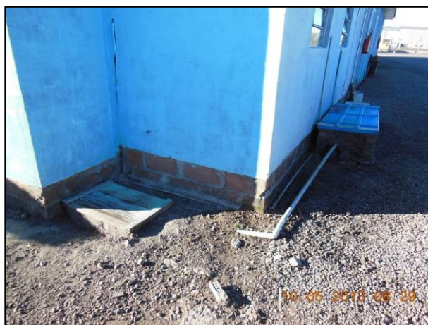
Vista lateral da caixa separadora de gordura.
