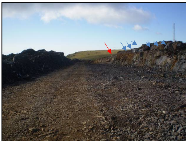
Tomada em 07/05/2013. Corte concluído. Presença de blocos junto à crista do talude (setas azuis) e inclinação negativa da face do talude (seta vermelha).
