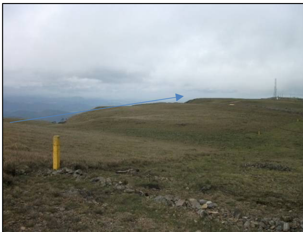
Terreno natural (do km 53+700 até a estrada existente), antes da execução do corte e do aterro adjacente. A seta marca, aproximadamente, o eixo de implantação. As estacas amarelas marcam a borda da faixa de domínio do Gasbol .
