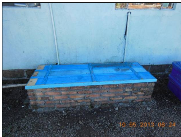
Vista frontal da caixa separadora de gordura.
