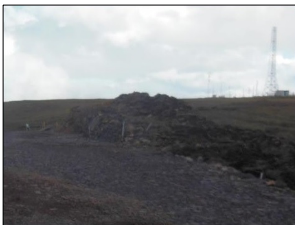
Tomada em 20/05/2013. Blocos sobre a crista do talude foram retirados.
