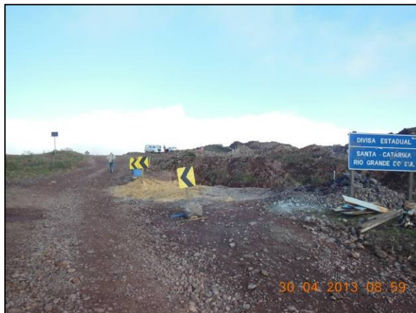
Placas indicando desvio à esquerda.
