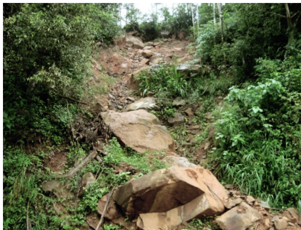
FIGURA 3.17 – GRANDE ESCORREGAMENTO DE BLOCOS DE ROCHA EM CORTE DA RODOVIA EXISTENTE EM DEPÓSITO DE TALUS
