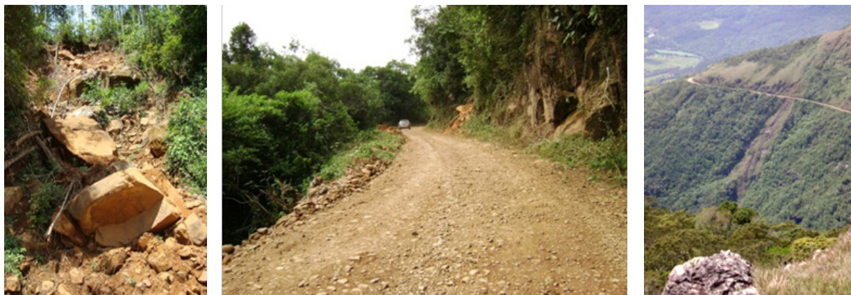
FIGURA 3.45 ALGUNS ESCORREGAMENTOS IDENTIFICADOS NA REGIÃO DAS ENCOSTAS DA BR-285 EM TIMBÉ DO SUL.
