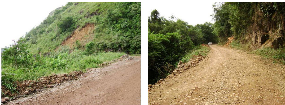
FIGURA 7.3.3 - DUAS ÁREAS DA ENCOSTA, ENTRE OUTRAS, SUJEITAS A ESCORREGAMENTOS NO LOTE 2
