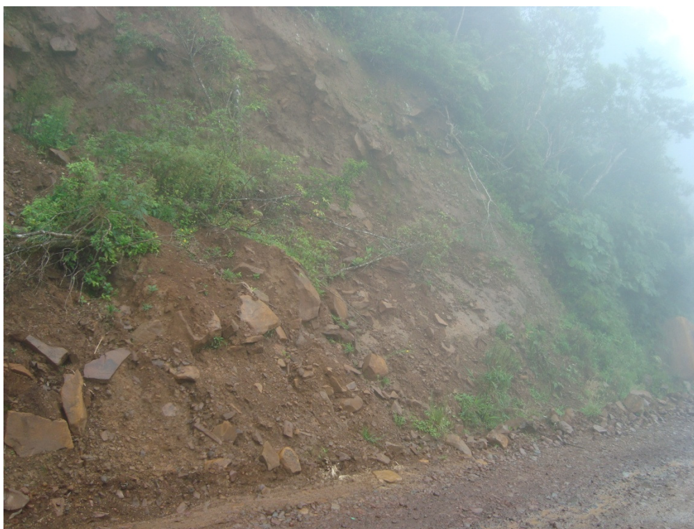
FIGURA 5.1.29 - FOTO: BLOCOS DE ROCHA NA EMINÊNCIA DE CAIR COORDENADAS: LAT.: 6.812.950 N / LONG.:602.800 E / ALTITUDE: 941 M
