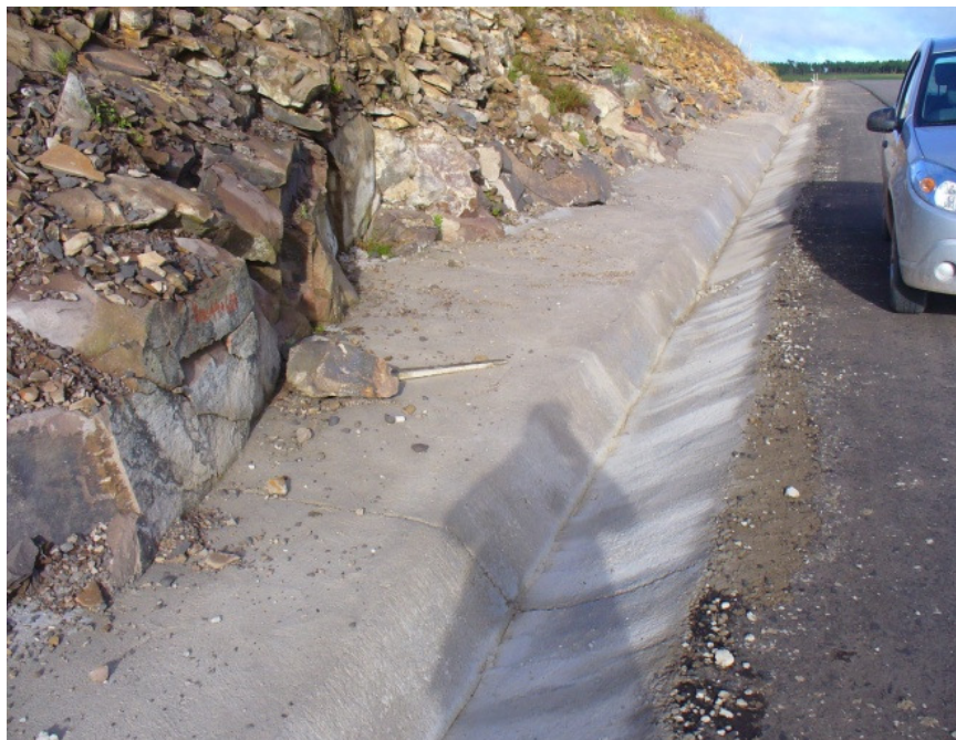
FIGURA 5.1.22 - DESPRENDIMENTO DE BLOCOS ROCHOSOS EM CORTE DE MATERIAL ALTAMENTE FRATURADO E COM CERTO GRAU DE ALTERAÇÃO – ENTRE A SEDE DE SÃO JOSÉ DOS AUSENTES E A PEDREIRA
